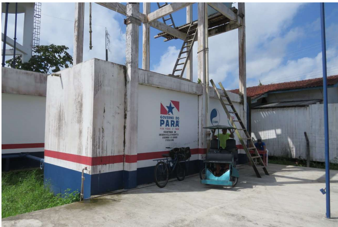
Figura 11. AFU03-RAP (reservatório apoiado).
