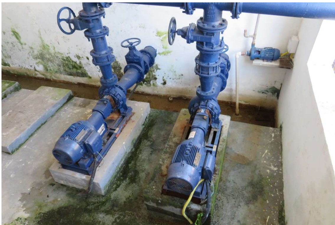
Figura 8. AFU02-EEAT (Estação Elevatória de Água Tratada).
