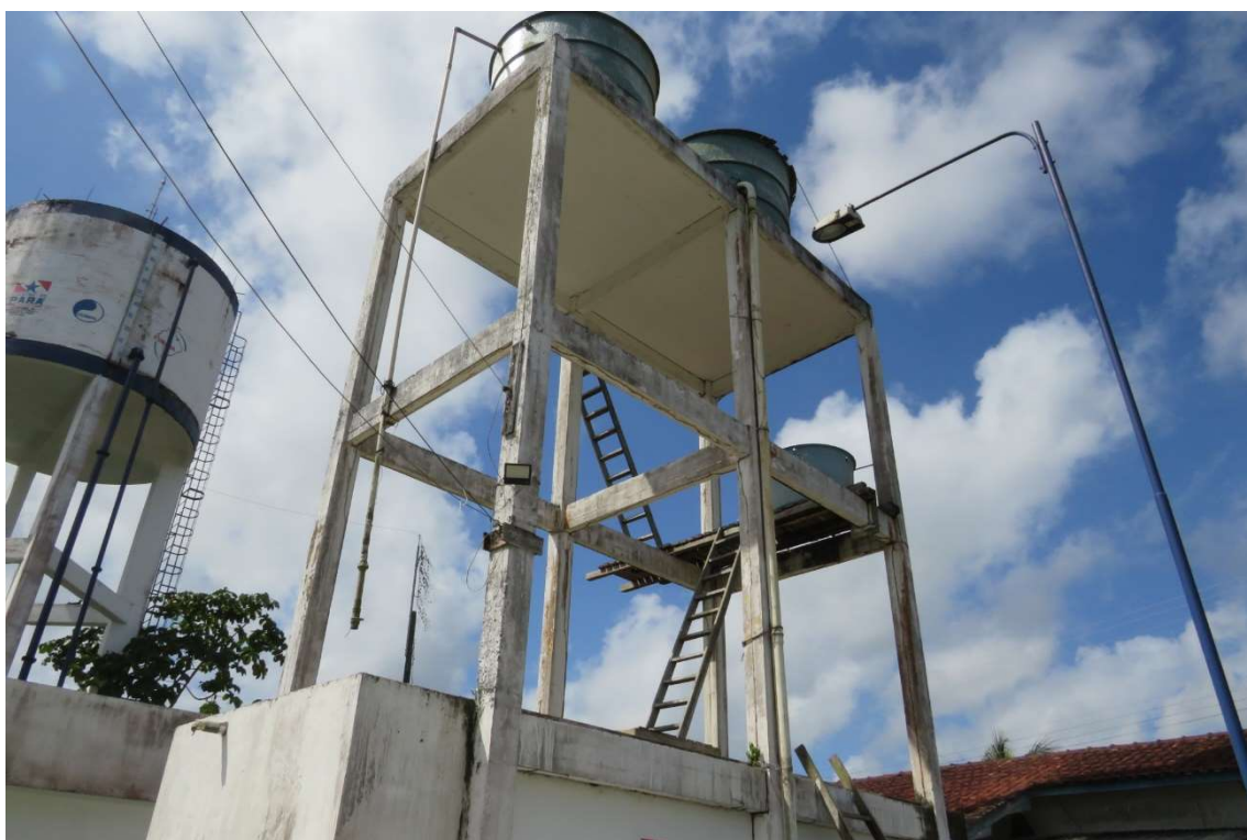
Figura 12. AFU03-REL1 e AFU03-REL2 (reservatórios elevados).
