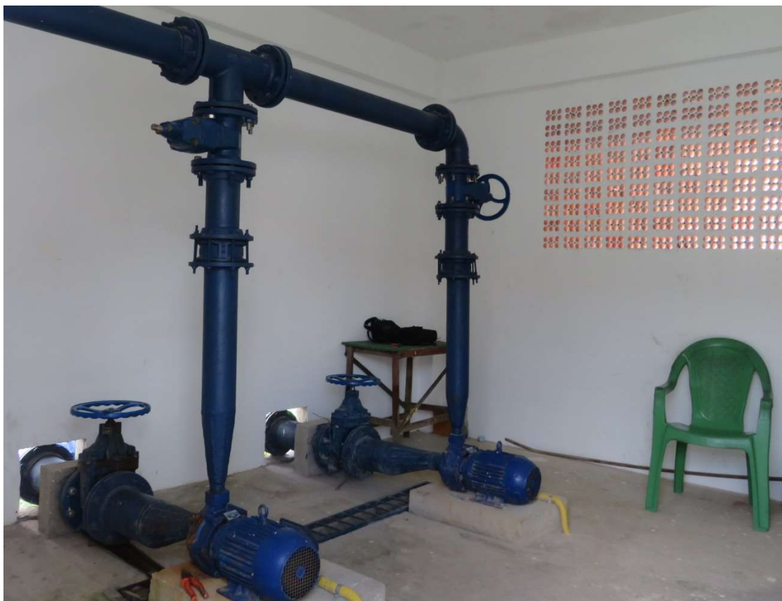
Figura 9. AFU02-EEAT (Estação Elevatória de Água Tratada).
