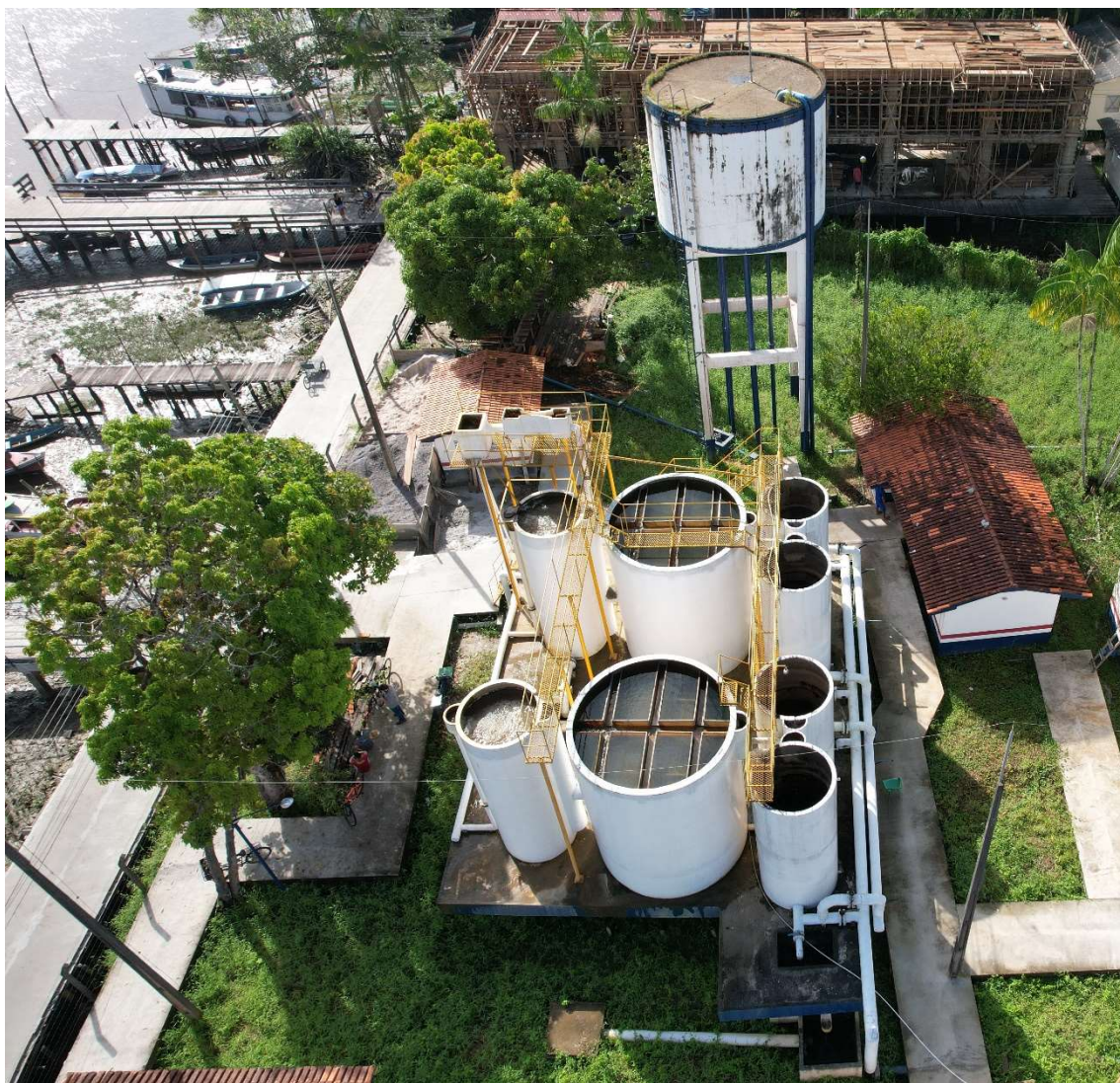
Figura 6. AFU02-ETA - Estação de Tratamento de Água de Afuá.
