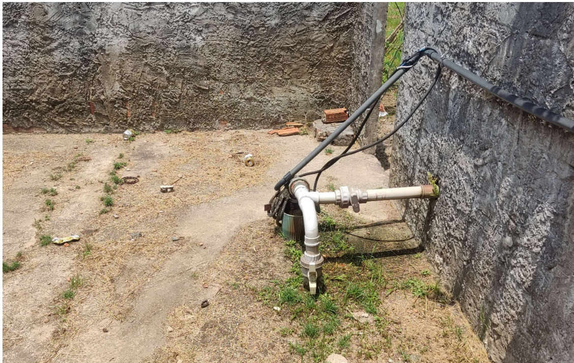
Figura 3. BNV01-CAPTAÇÃO, captação subterrânea (Bairro Maguari). Fonte: Consórcio, 2023.
