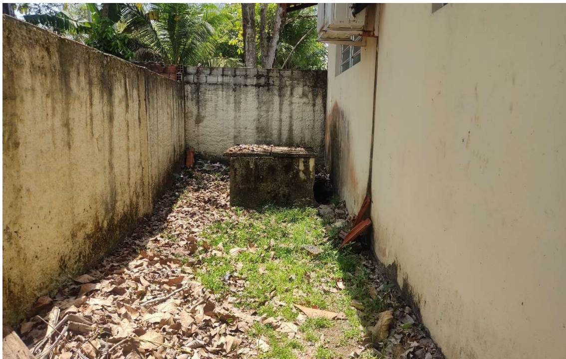
Figura 9. BNV06-CAPTAÇÃO, captação subterrânea (Bairro Liberdade).
