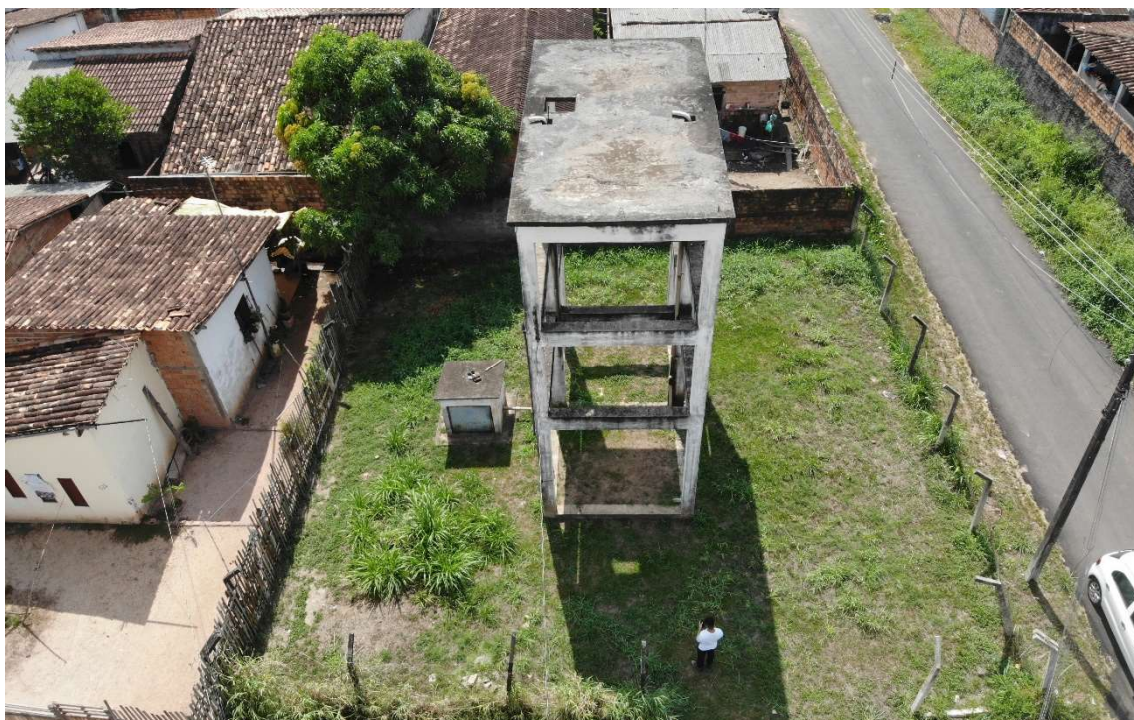
Figura 36. BNV22-REL, reservatório elevado - inoperante (Bairro Independente).
