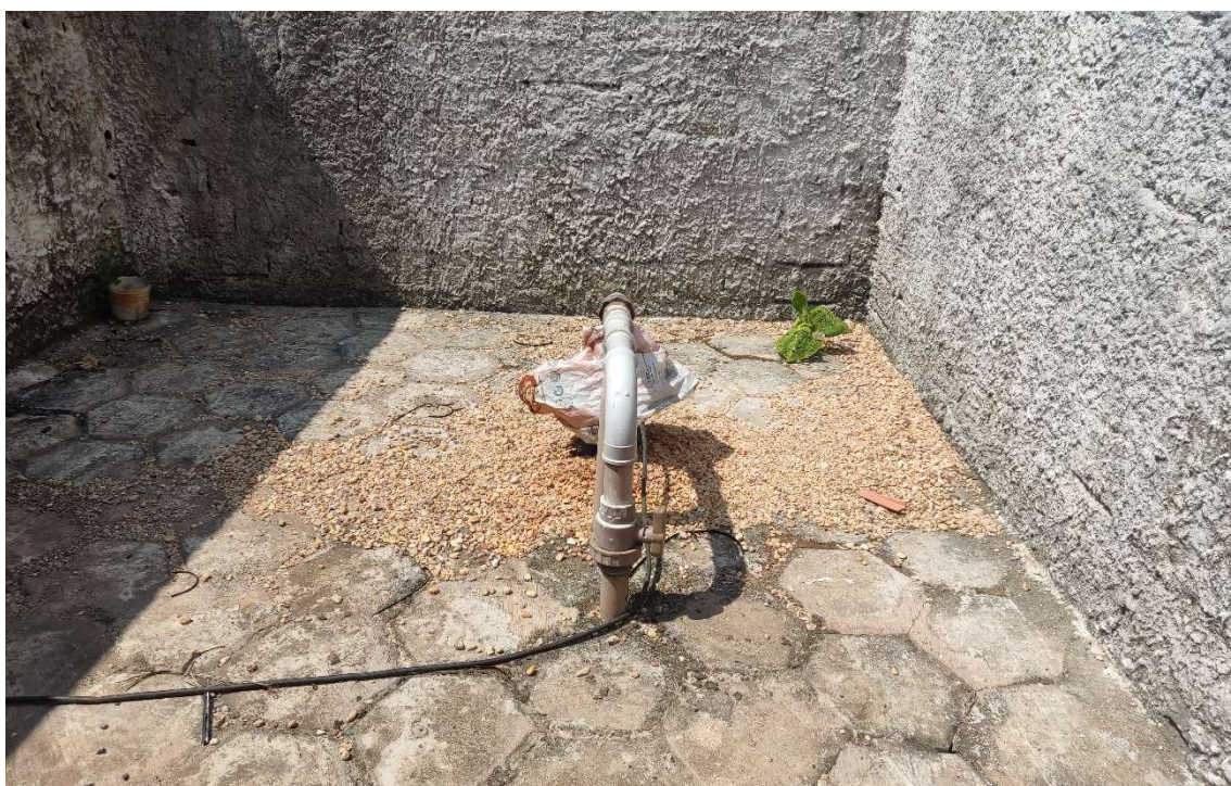
Figura 24. BNV24-CAPTAÇÃO, captação subterrânea (Bairro Independente).
