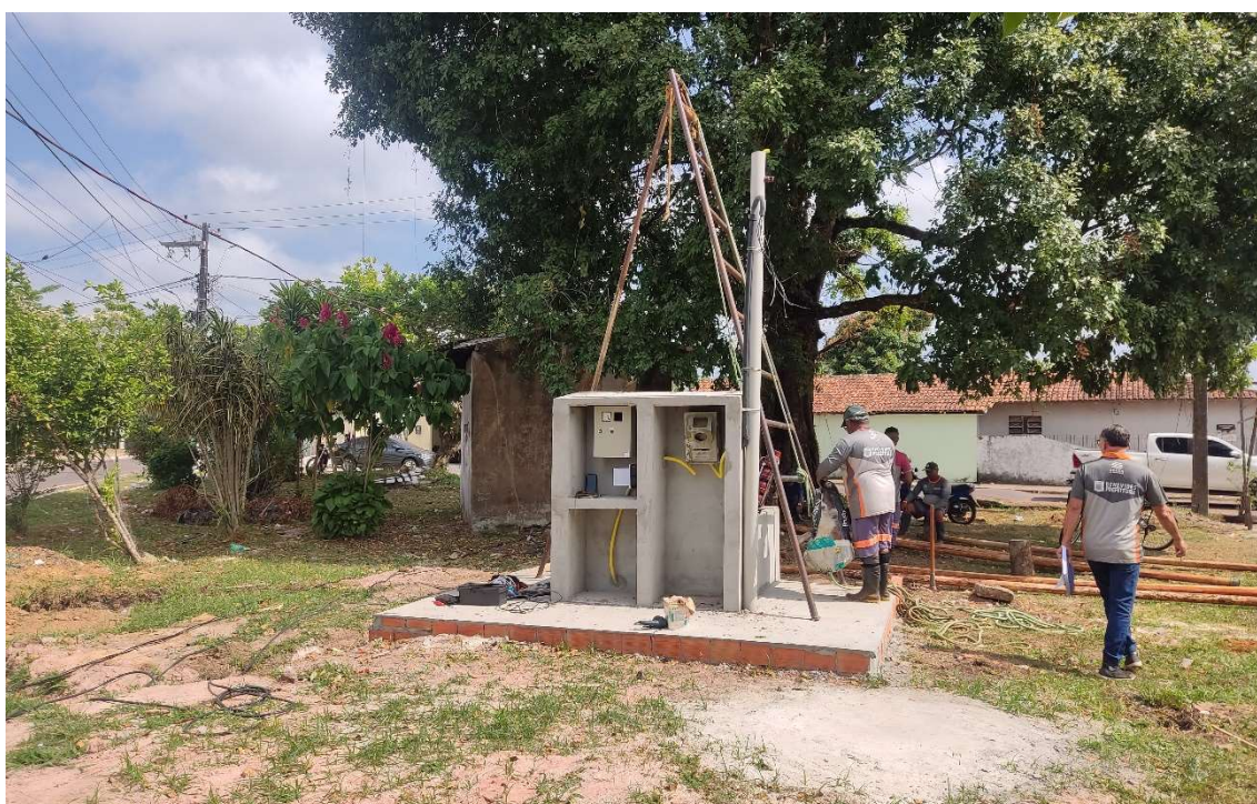
Figura 18. BNV15-CAPTAÇÃO, captação subterrânea (Bairro Médice). Fonte: Consórcio, 2023.
