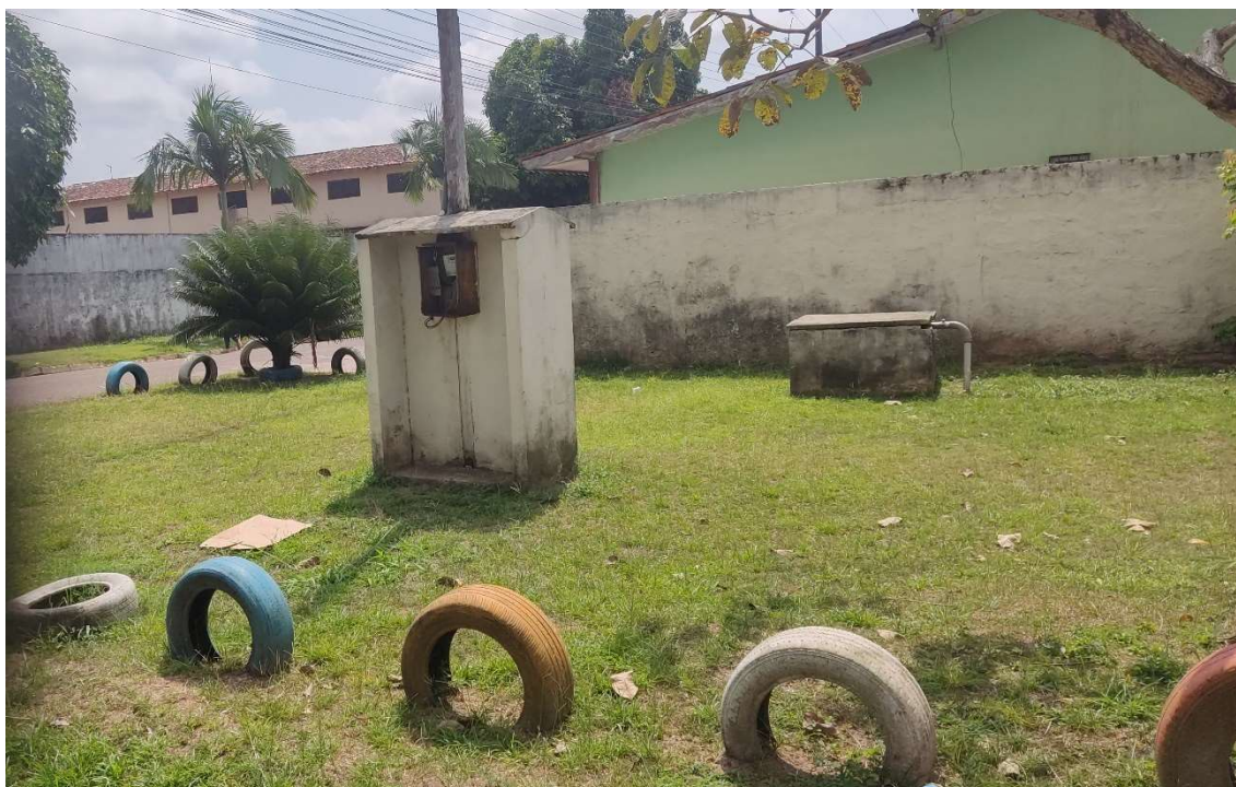
Figura 17. BNV17-CAPTAÇÃO, captação subterrânea (Bairro Médice). Fonte: Consórcio, 2023.
