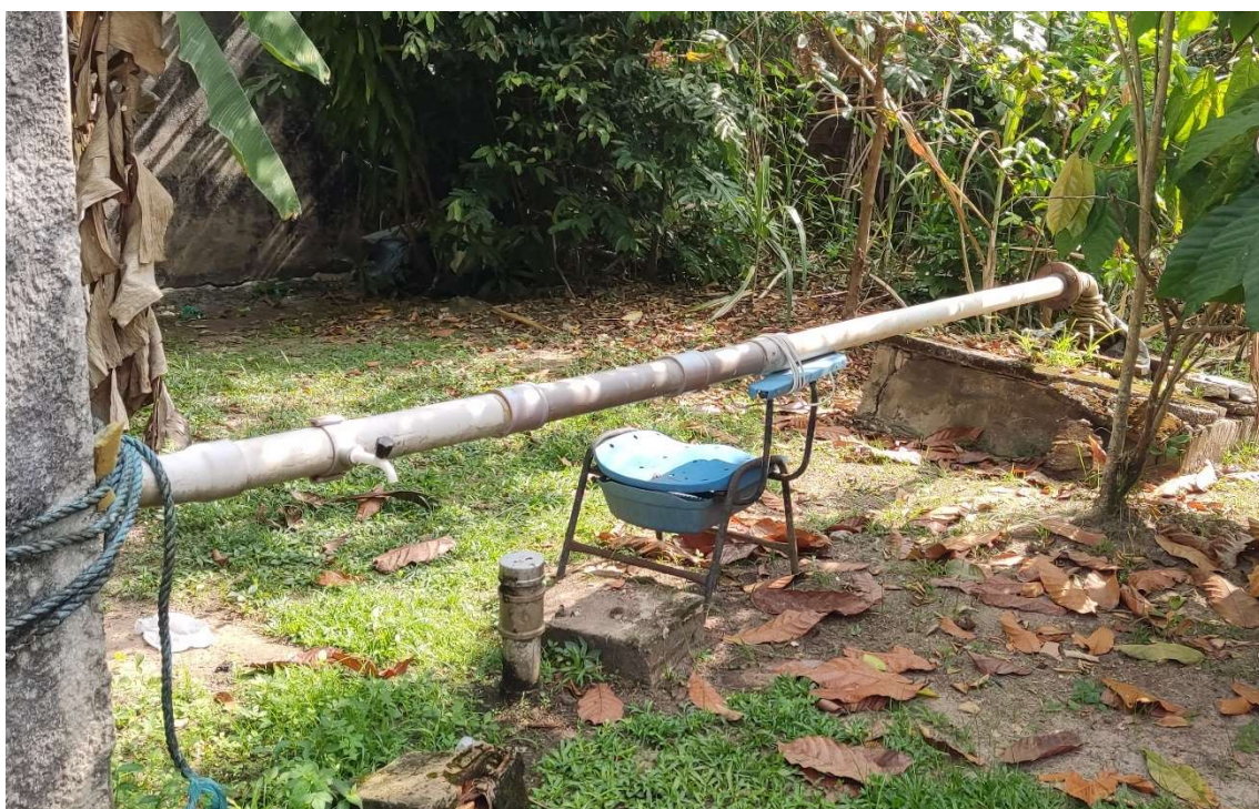
Figura 14. BNV14-CAPTAÇÃO 01, captação subterrânea (Bairro Centro).
