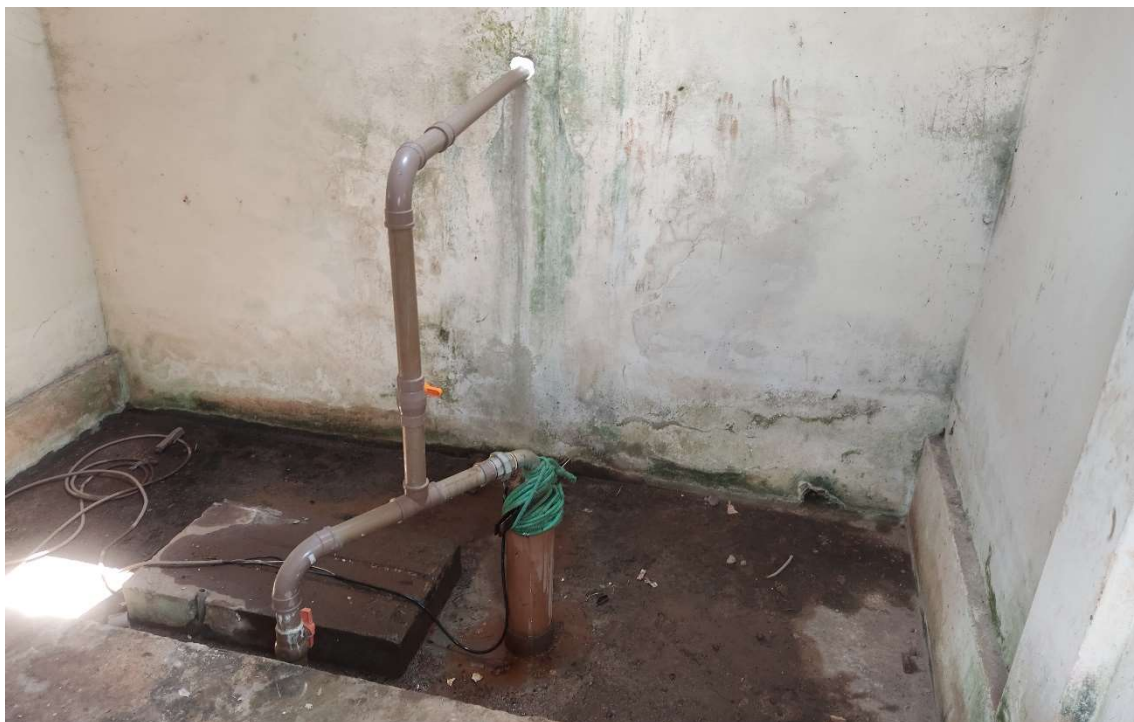
Figura 12. BNV11-CAPTAÇÃO, captação subterrânea (Bairro das Flores).
