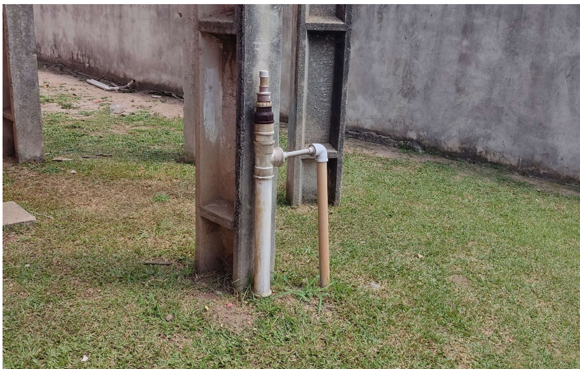
Figura 6. BNV04-CAPTAÇÃO, captação subterrânea (Bairro Maguari).
