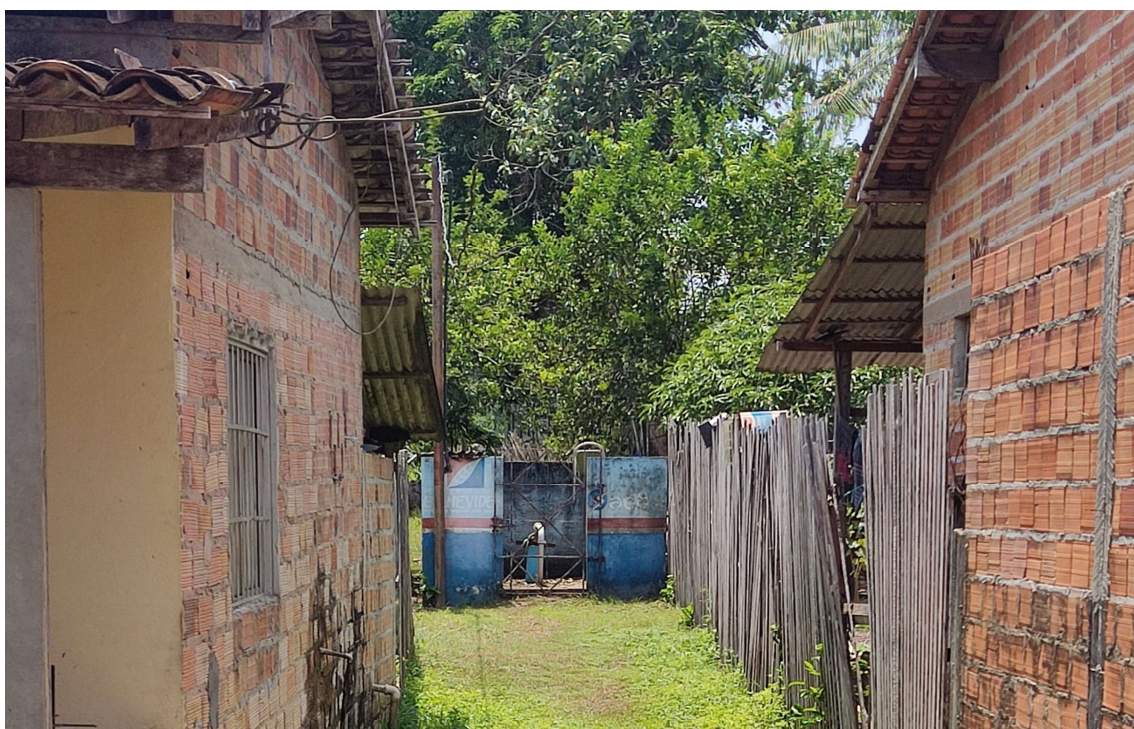
Figura 10. BNV07-CAPTAÇÃO, captação subterrânea (Bairro Liberdade).
