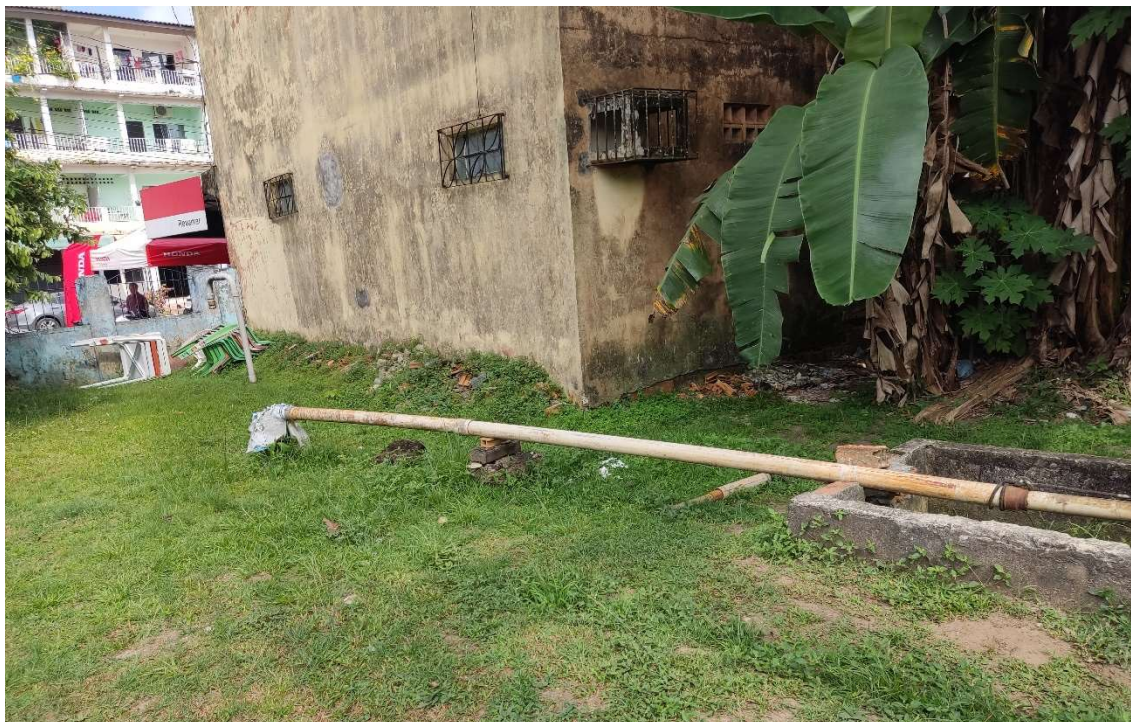
Figura 15. BNV14-CAPTAÇÃO 02, captação subterrânea (Bairro Centro).
