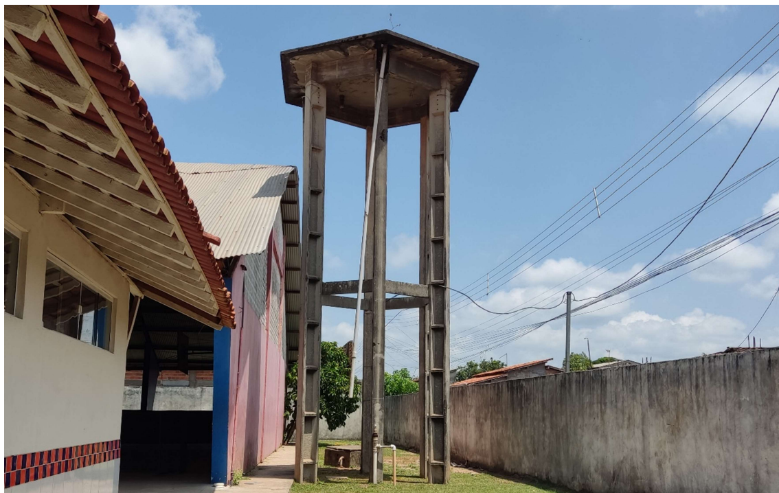
Figura 26. BNV04-REL, reservatório elevado - inoperante (Bairro Maguari).
