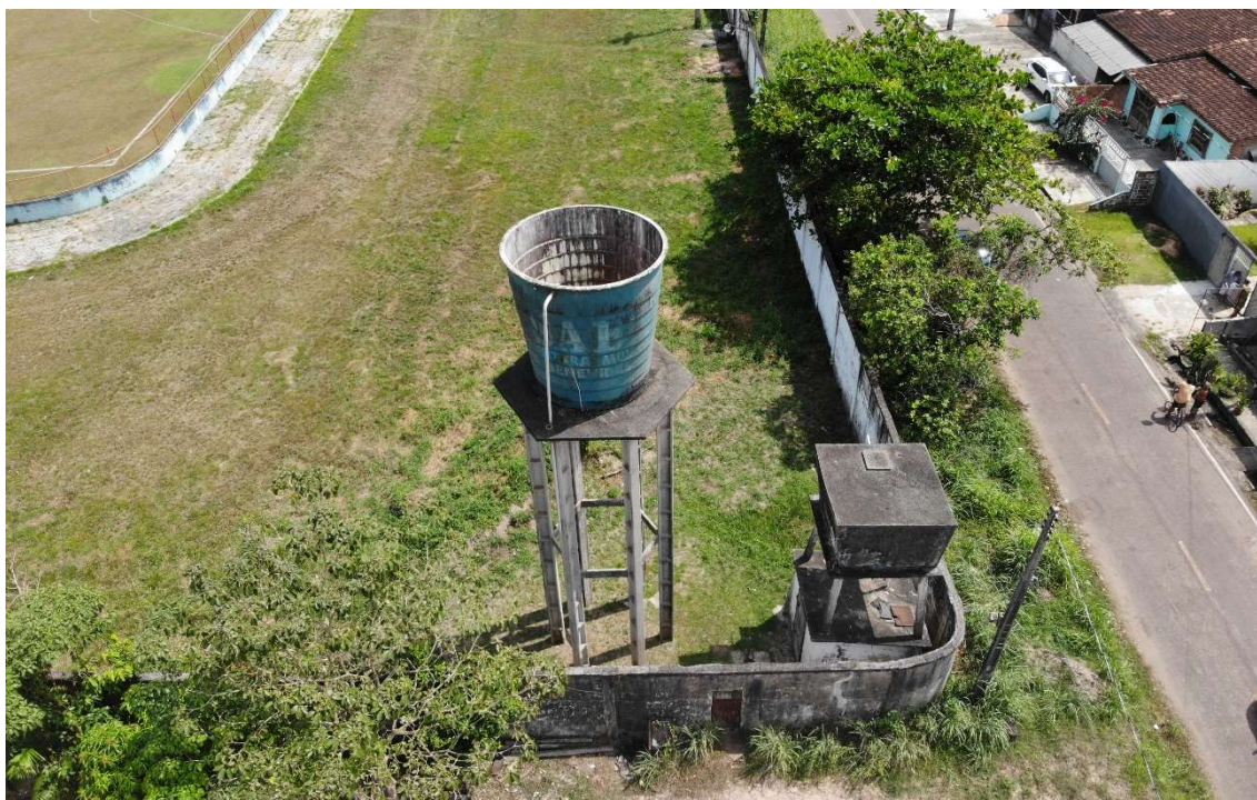
Figura 33. BNV16-REL, reservatório elevado - inoperante (Bairro Bengolândia).
