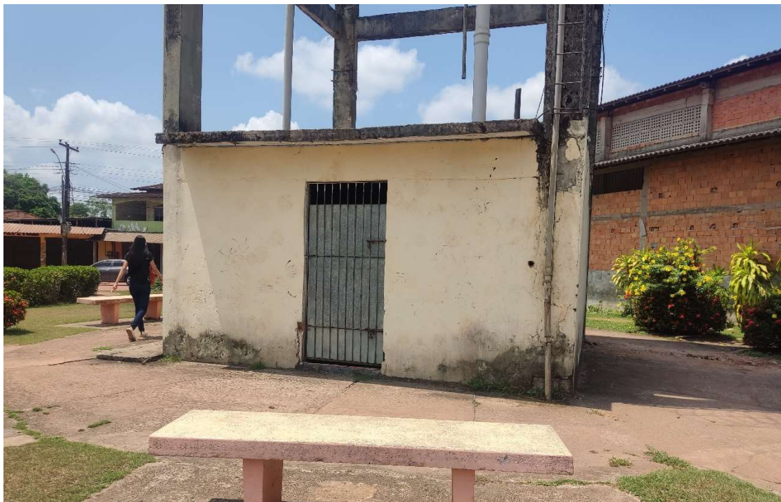
Figura 5. BNV03-CAPTAÇÃO 01 e BNV03-CAPTAÇÃO 02, captações subterrâneas, localizadas na base do REL03 (Bairro Maguari).
