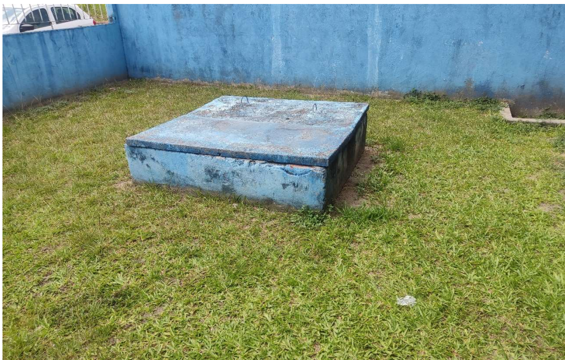
Figura 13. BNV12-CAPTAÇÃO, captação subterrânea (Bairro das Flores).
