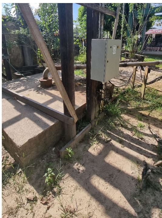
Figura 8. Captação – BRV05, Poço tubular. Fonte: Consórcio, 2023.
