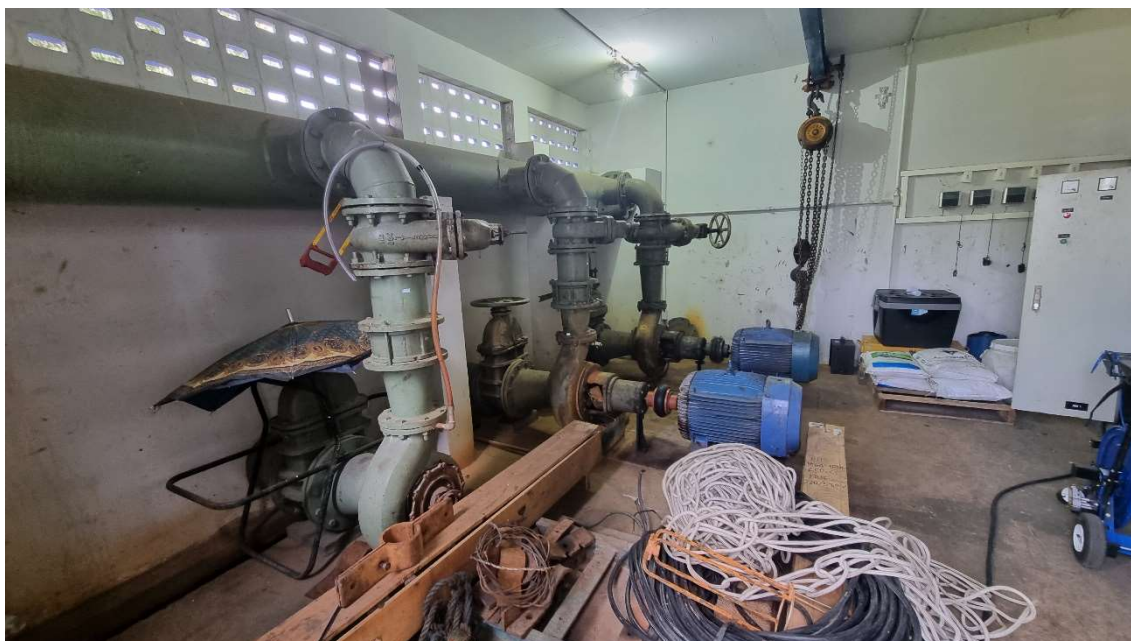
Figura 12. EEAT- BRV01, conjunto de motobombas.
