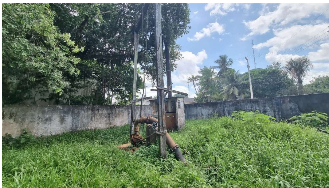
Figura 6. Captação- BRV02, poço tubular.
