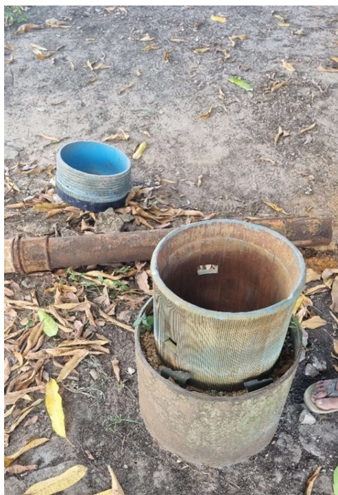
Figura 5. Captação -BRV01, poço 03 (desativado).
