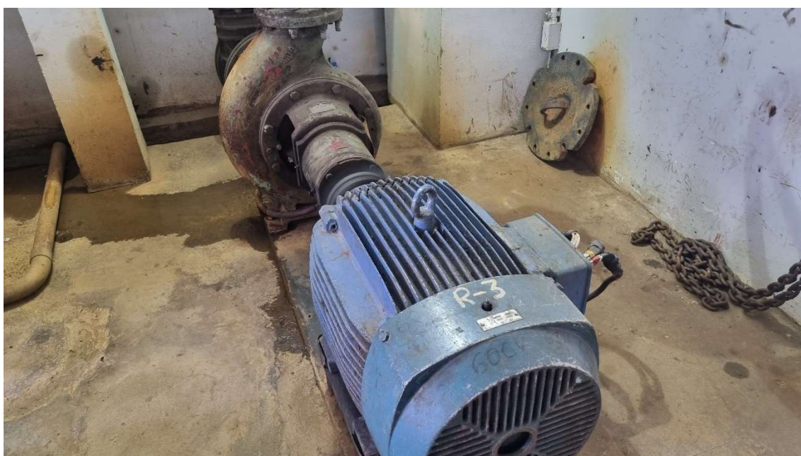
Figura 13. EEAT- BRV01, conjunto de motobomba com patologia.
