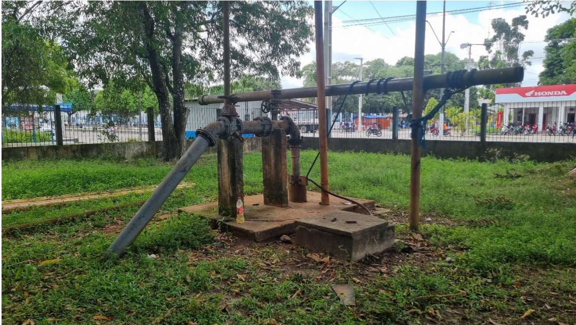
Figura 3. Captação, BRV01- Poço tubular. Fonte: Consórcio, 2023.
