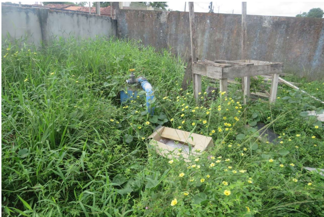
Figura 21. CAS017-CAPTAÇÃO003, poço tubular.
