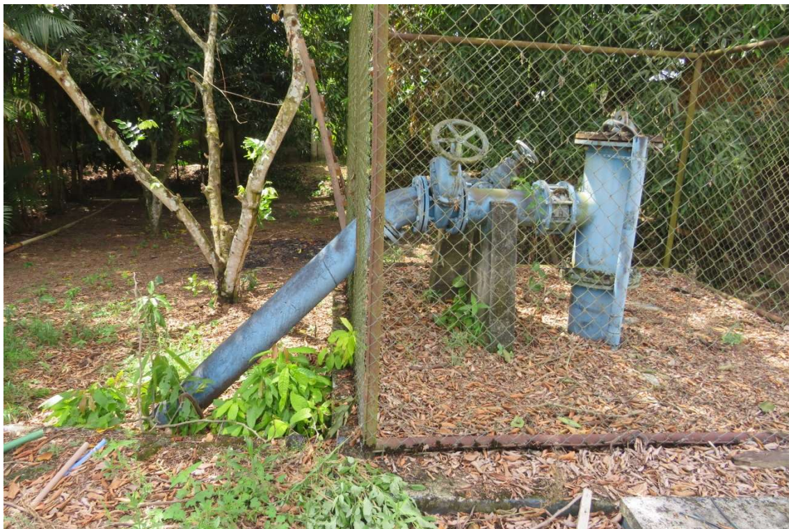
Figura 3. CAS002-CAPTAÇÃO, poços rasos. Fonte: Consórcio, 2023.
