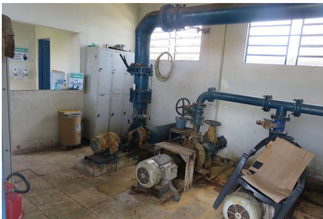
Figura 51. CAS002-EEAT01,02, Estação Elevatória de Água Tratada.
