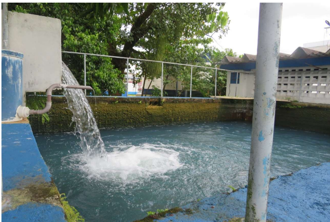
Figura 42. CAS009-TRATAMENTO, Tratamento de desinfecção (cloro pastilha).
