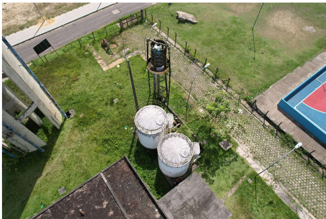
Figura 40. CAS006-ETA, Estação de Tratamento de Água (desferrização). Fonte: Consórcio, 2023.
