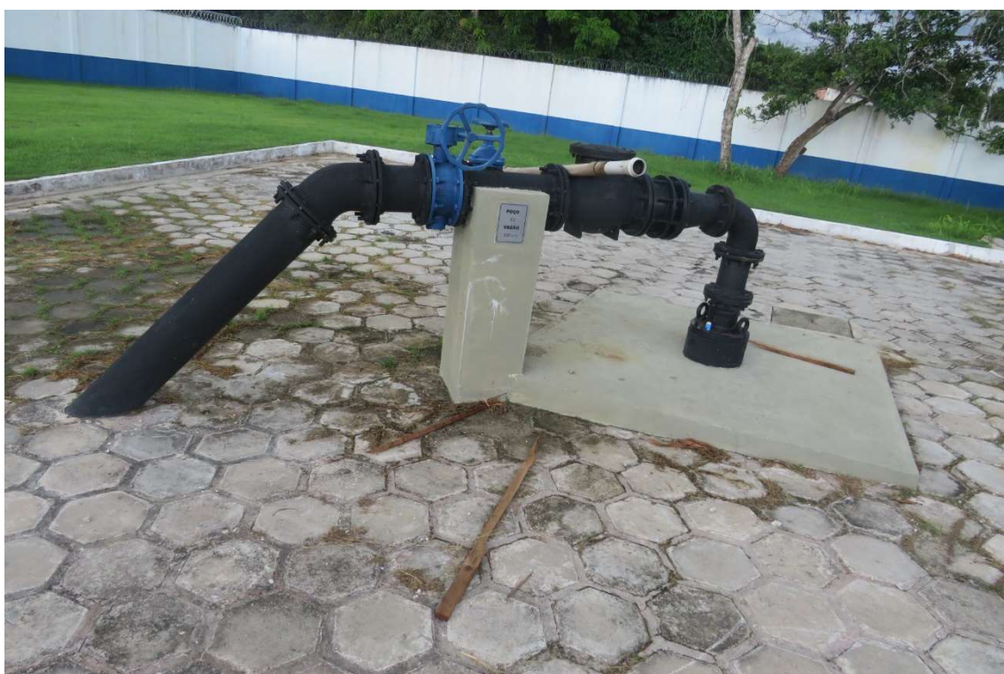
Figura 28. CAS019-CAPTAÇÃO04, poço tubular.
