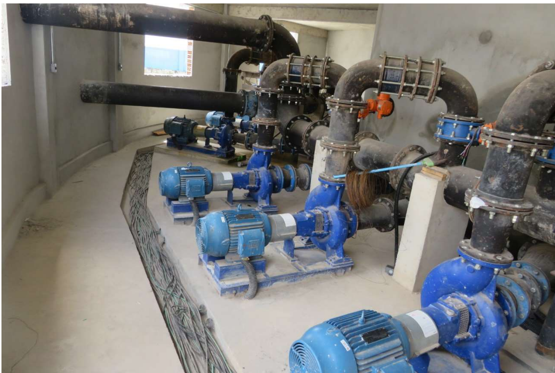
Figura 52. CAS009-EEAT01,EELF, Estação Elevatória de Água Tratada e Lavagem dos Filtros.
