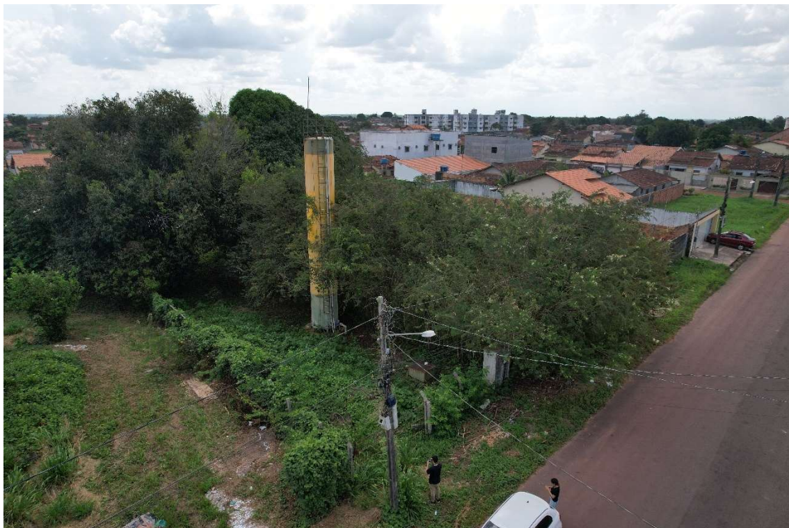
Figura 64. CAS005-RAP, reservatório apoiado.
