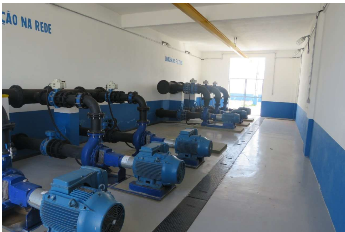
Figura 60. CAS024-EEAT, EELF, Estação Elevatória de Água Tratada e Lavagem dos Filtros.
