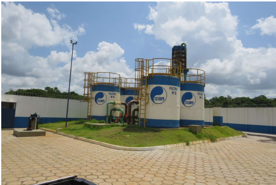
Figura 47. CAS018-ETA, Estação de Tratamento de Água (desferrização).
