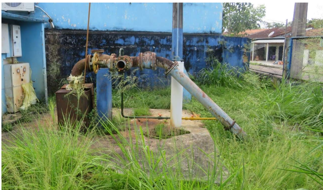
Figura 46. CAS016-TRATAMENTO, Tratamento de desinfecção (cloro pastilha). Fonte: Consórcio, 2023.
