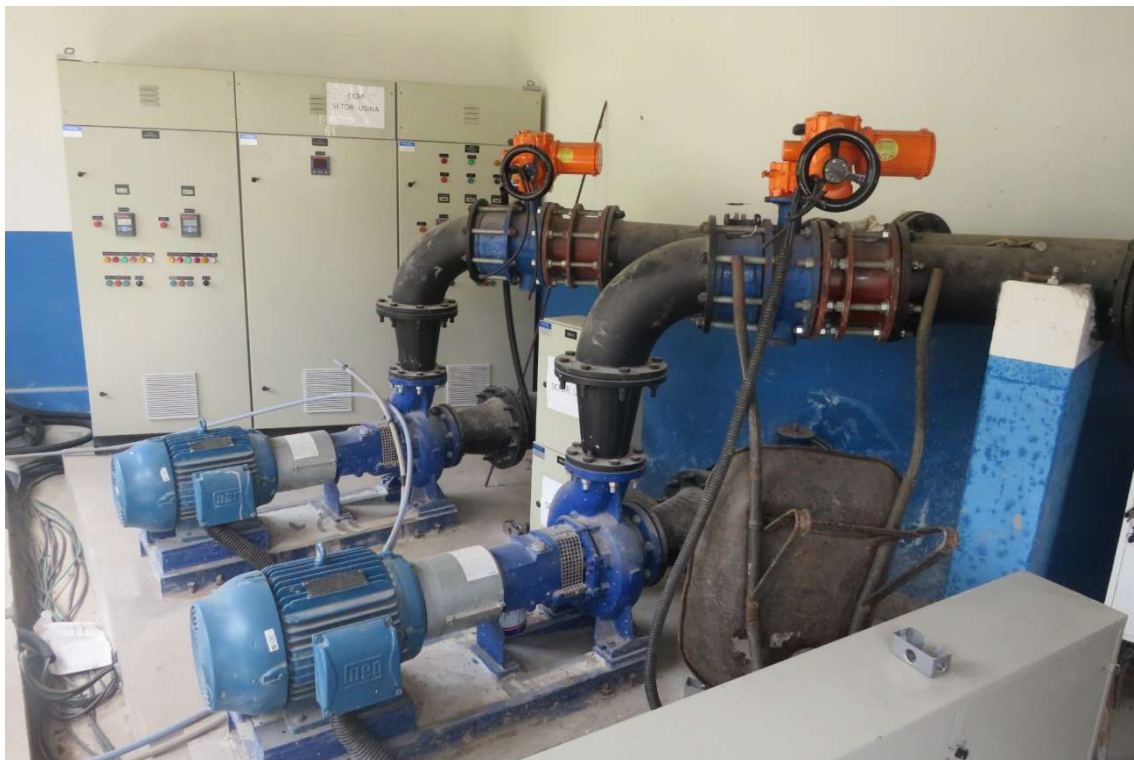
Figura 54. CAS010-EEAB, Estação Elevatória de Água Bruta. Fonte: Consórcio, 2023.
