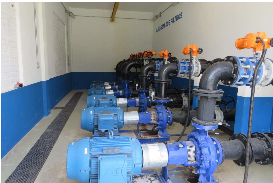
Figura 57. CAS018-EEAT01,EEEF, Estação Elevatória de Água Tratada e Lavagem dos Filtros.
