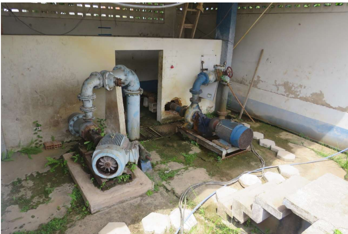
Figura 53. CAS009-EEAT02,03, Estação Elevatória de Água Tratada.
