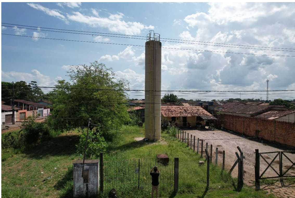
Figura 74. CAS020-RAP, reservatório apoiado.
