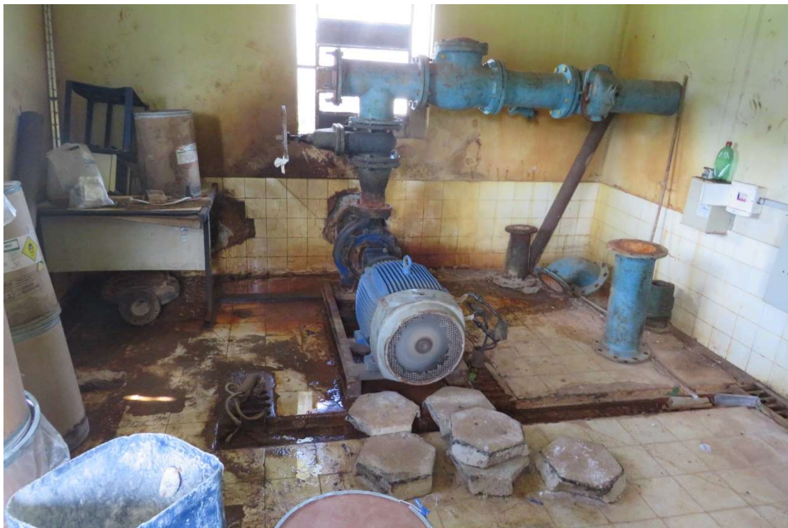
Figura 56. CAS011-EEAT, Estação Elevatória de Água Tratada.
