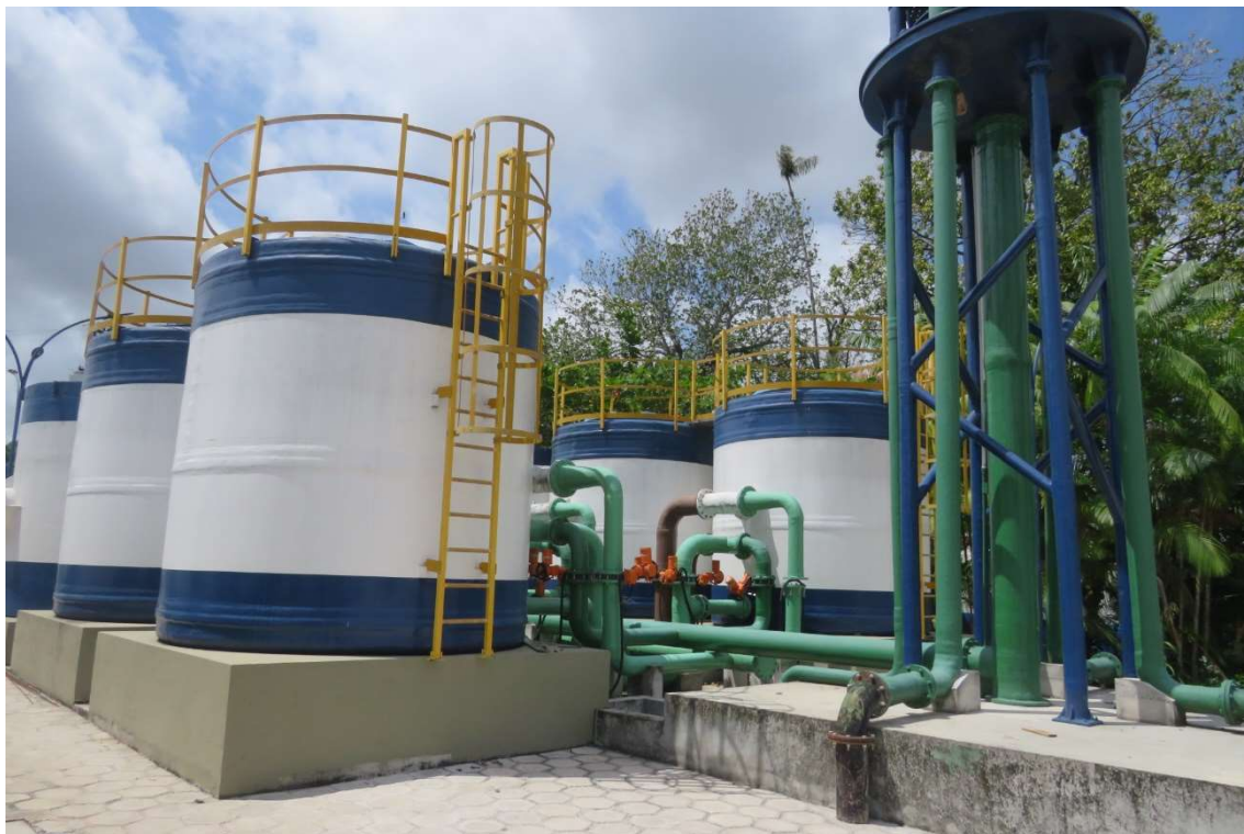
Figura 41. CAS009-ETA, Estação de Tratamento de Água (desferrização).
