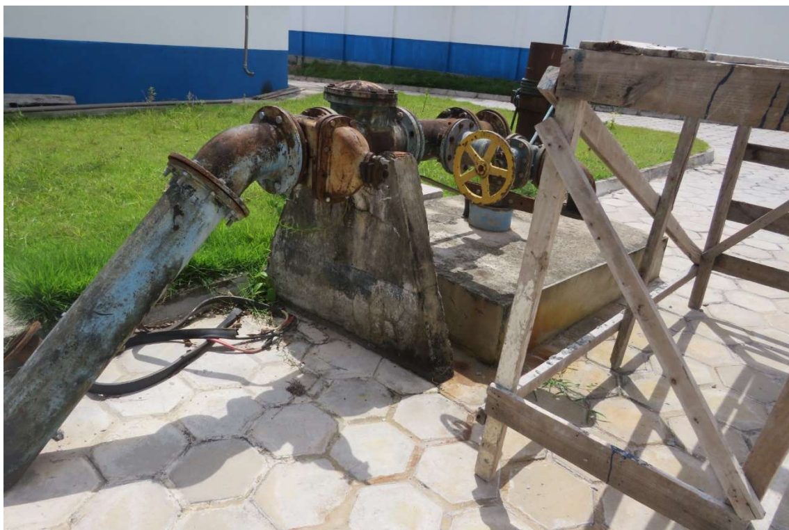
Figura 10. CAS009-CAPTAÇÃO, poço tubular.
