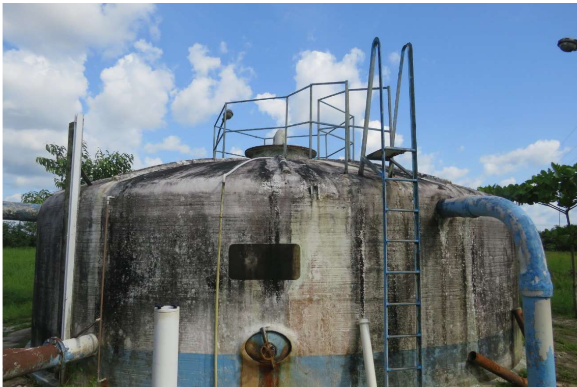
Figura 68. CAS011-RAP, reservatório apoiado.
