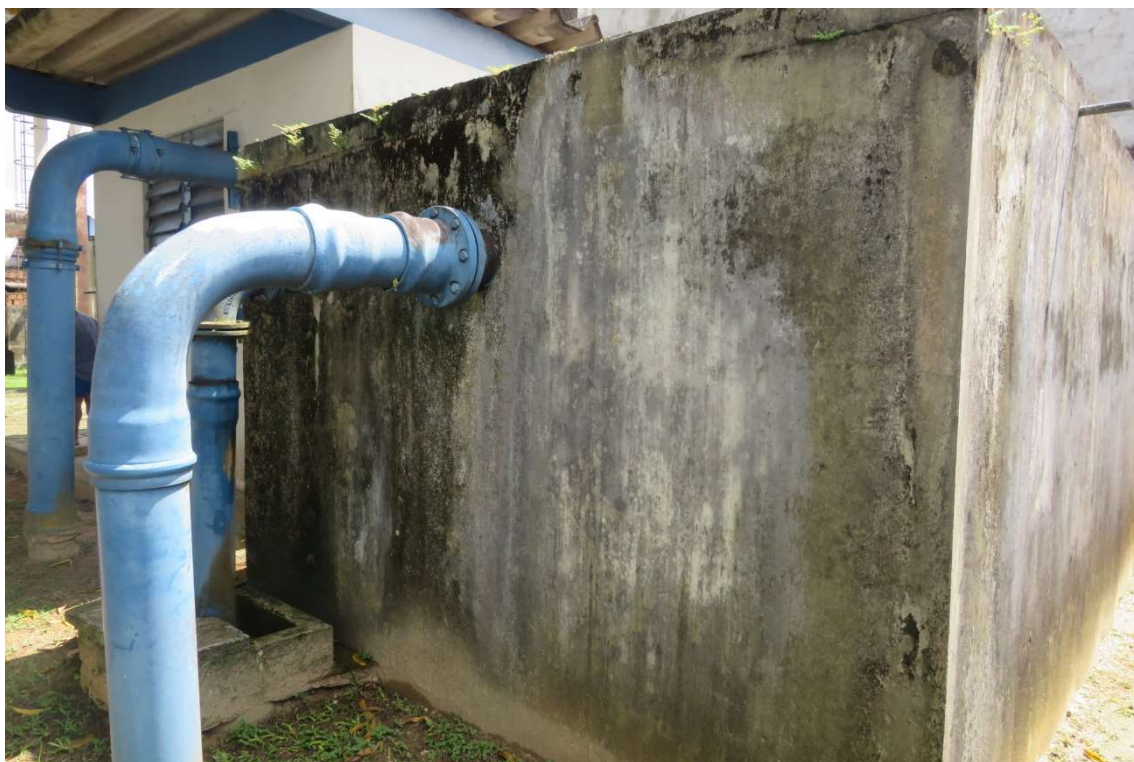
Figura 62. CAS003-RAP reservatório apoiado. Fonte: Consórcio, 2023.
