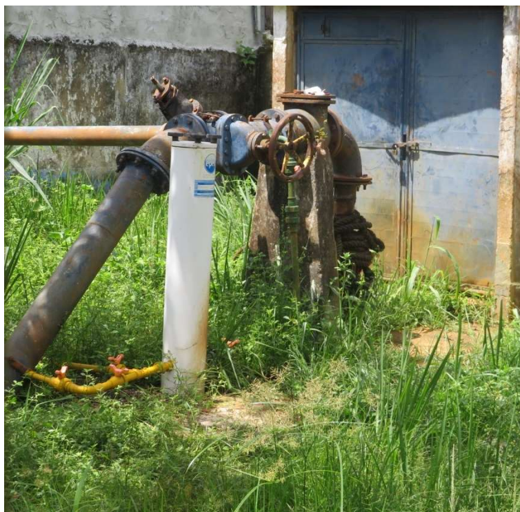
Figura 39. CAS004-TRATAMENTO, Tratamento de desinfecção (cloro pastilha). Fonte: Consórcio, 2023.
