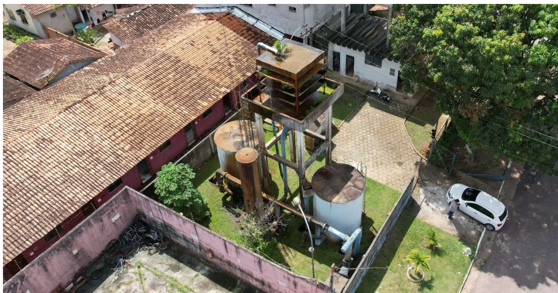
Figura 38. CAS003-ETA, Estação de Tratamento de Água (desferrização).
