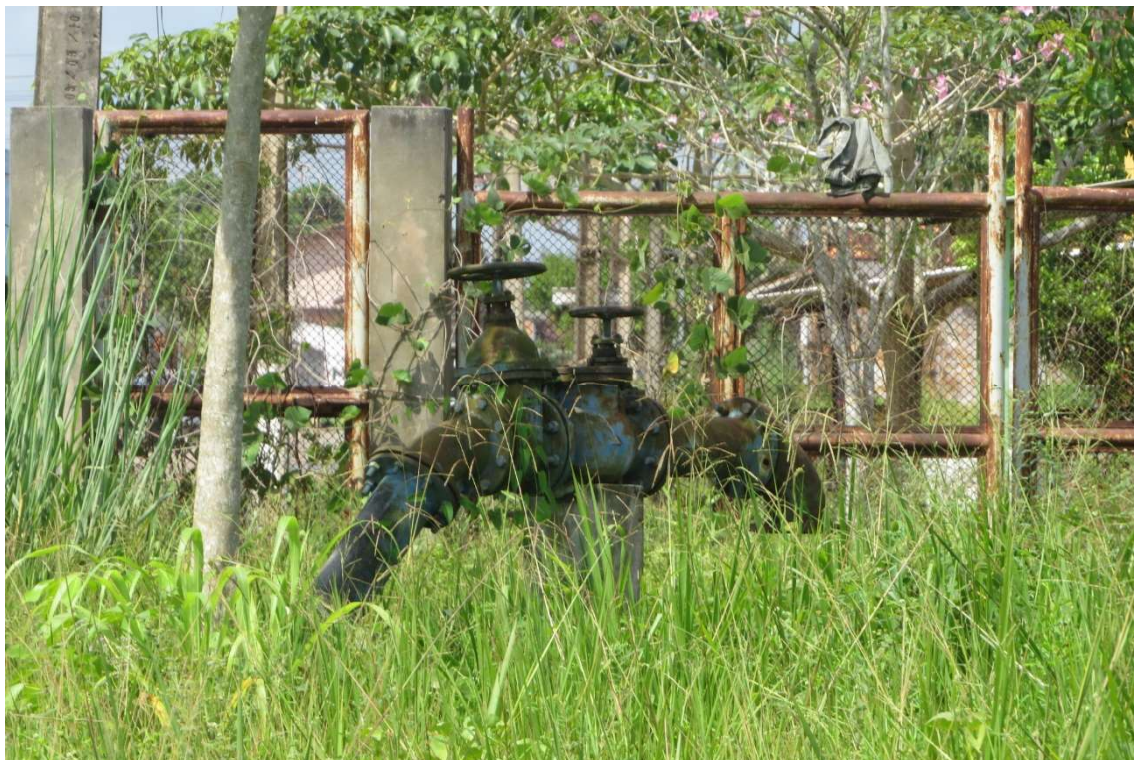
Figura 9. CAS006-CAPTAÇÃO002, poço tubular.
