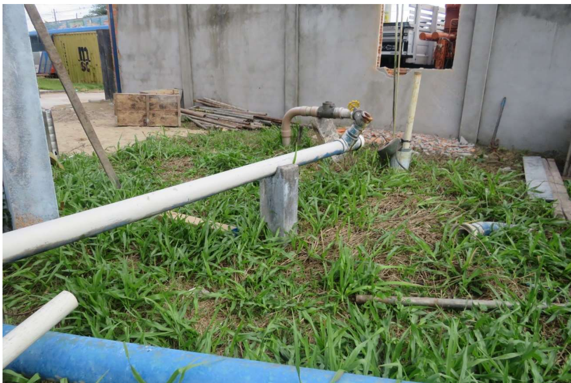
Figura 22. CAS017-CAPTAÇÃO004, poço tubular.
