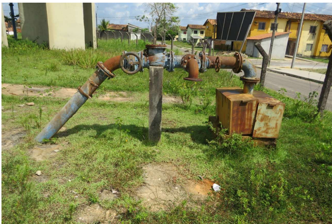
Figura 8. CAS006-CAPTAÇÃO001, poço tubular.
