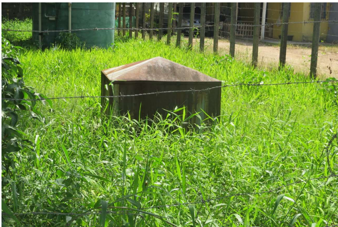
Figura 31. CAS021-CAPTAÇÃO001, poço tubular.
