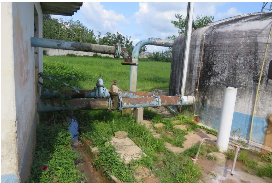
Figura 44. CAS011-TRATAMENTO, Tratamento de desinfecção (cloro pastilha).
