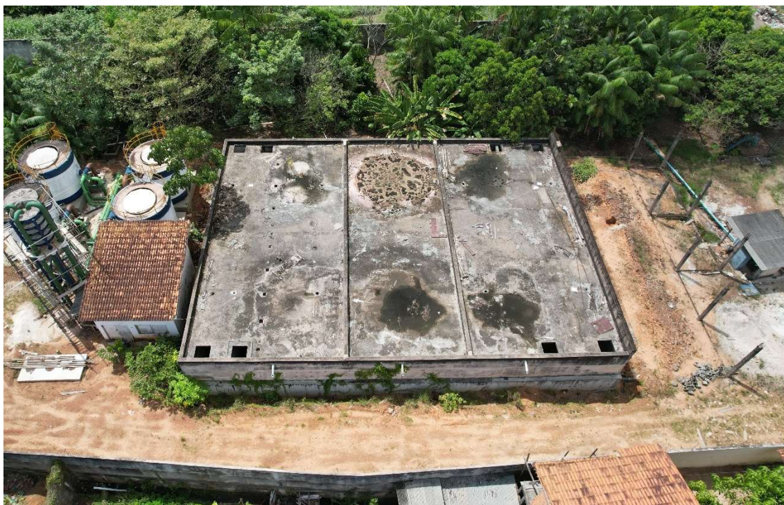
Figura 61. CAS002-RAP01,02, reservatório apoiado.
