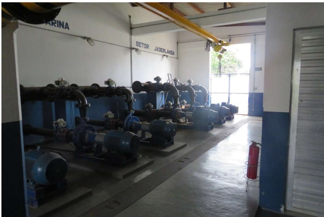
Figura 58. CAS019-EEAT01,02, Estação Elevatória de Água Tratada. Fonte: Consórcio, 2023.
