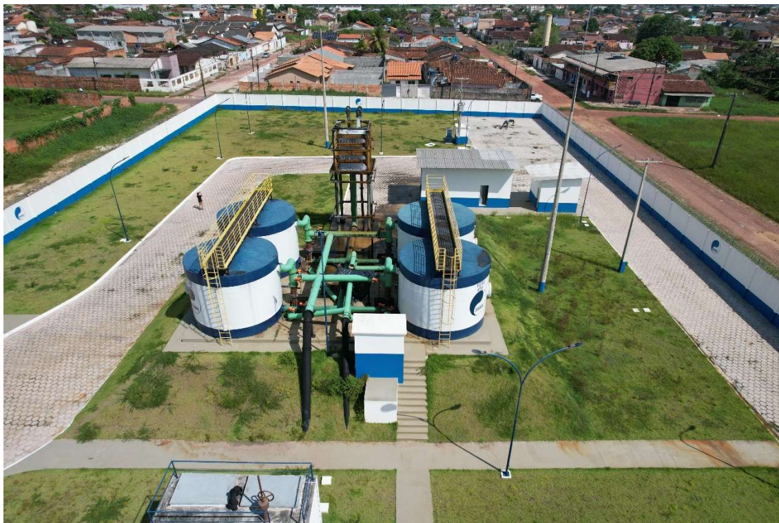
Figura 49. CAS024-ETA, Estação de Tratamento de Água (desferrização).
