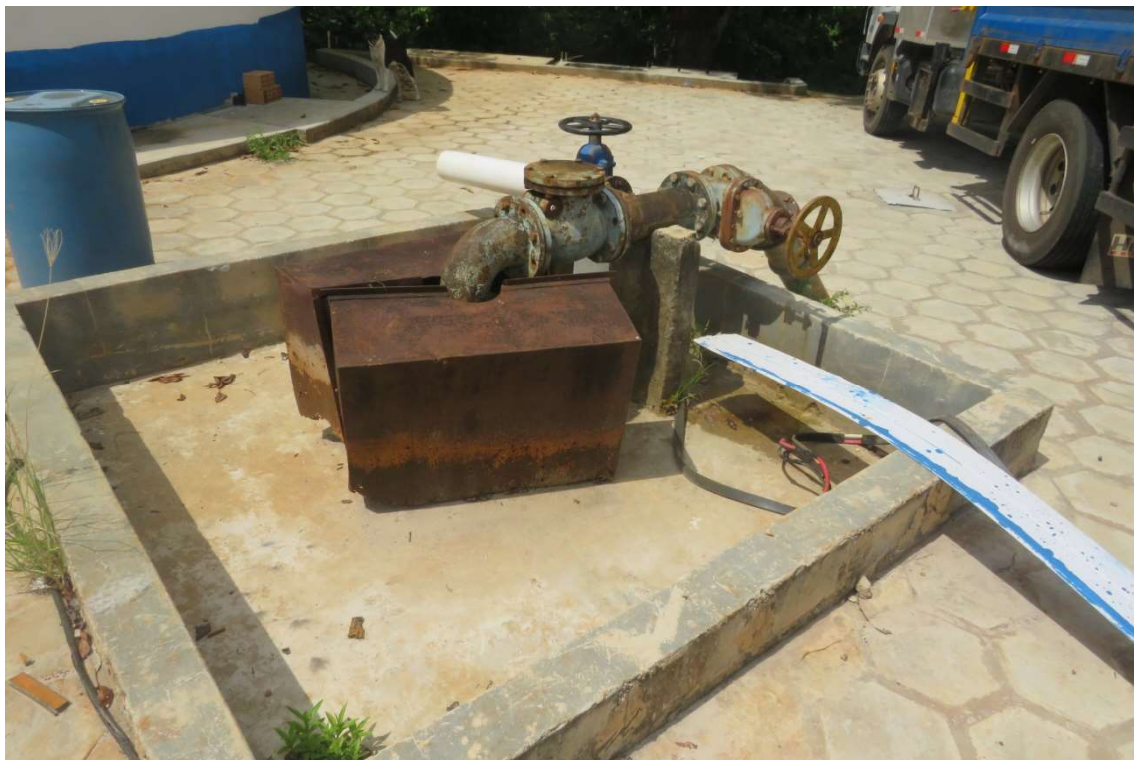
Figura 11. CAS010-CAPTAÇÃO001, poço tubular.
