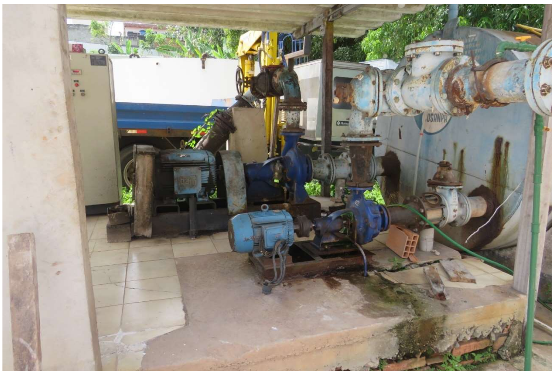
Figura 55. CAS010-EEAT01,02, Estação Elevatória de Água Tratada. Fonte: Consórcio, 2023.
