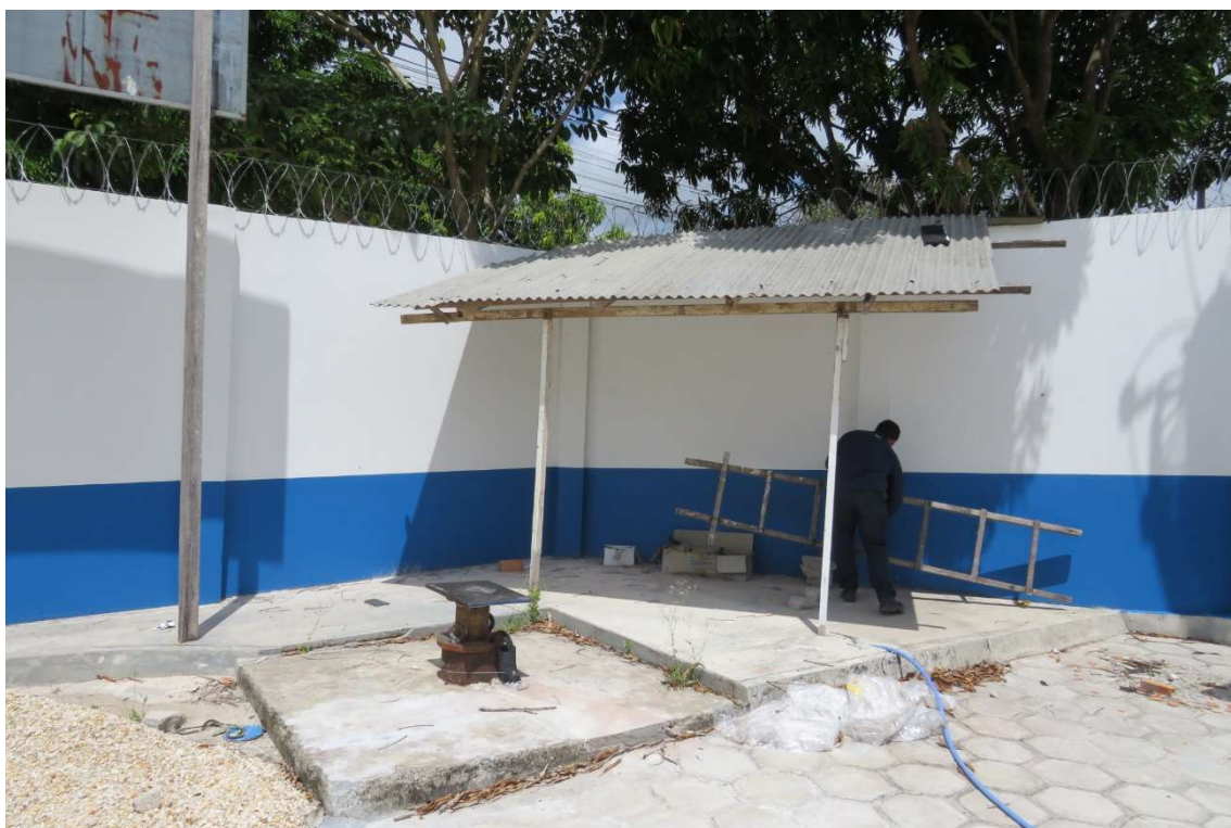
Figura 34. CAS023-CAPTAÇÃO, poço tubular.
