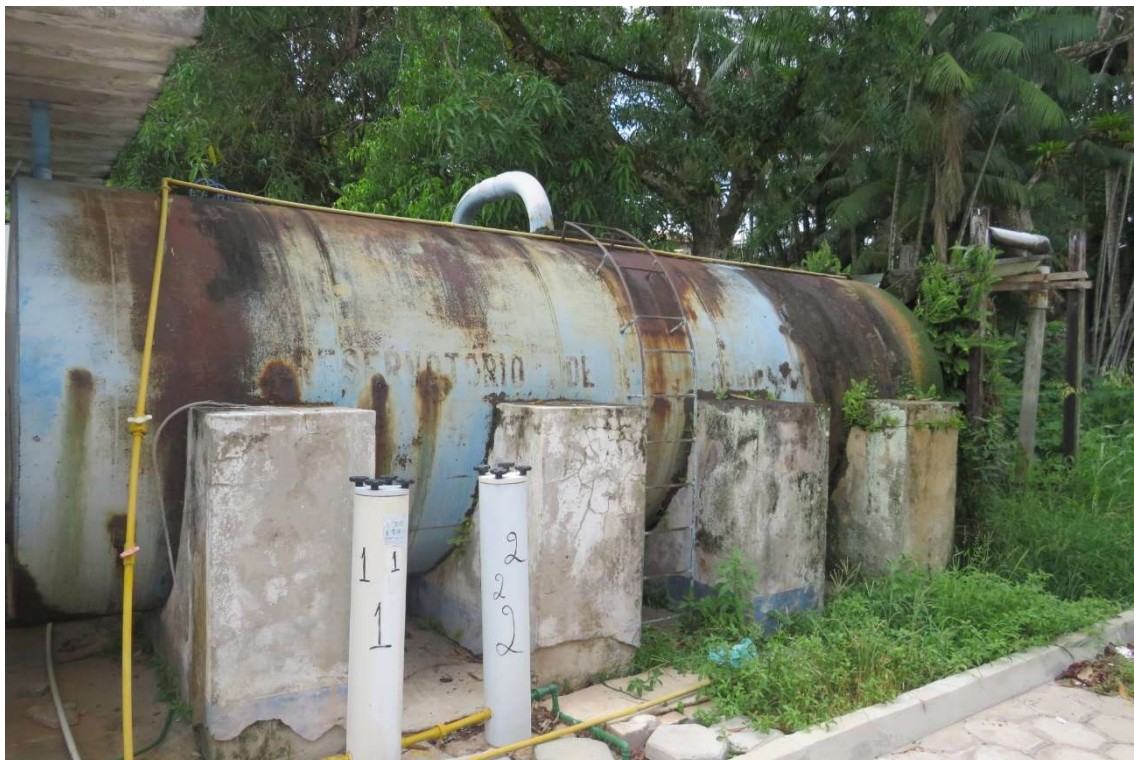
Figura 43. CAS010-TRATAMENTO, Tratamento de desinfecção (cloro pastilha).
