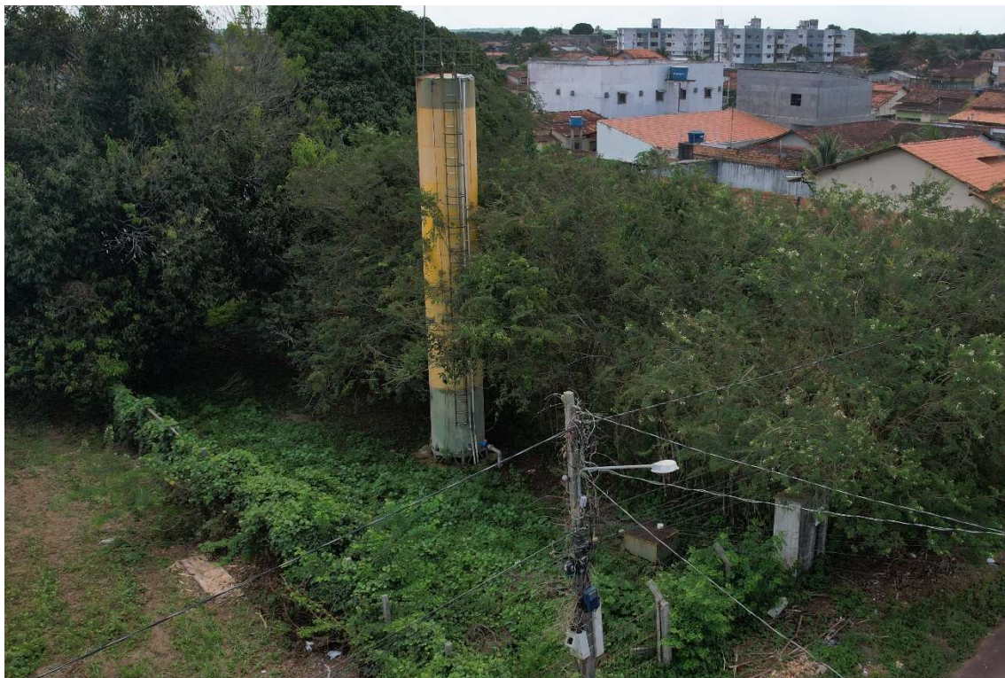
Figura 7. CAS005-CAPTAÇÃO002, poço tubular.
