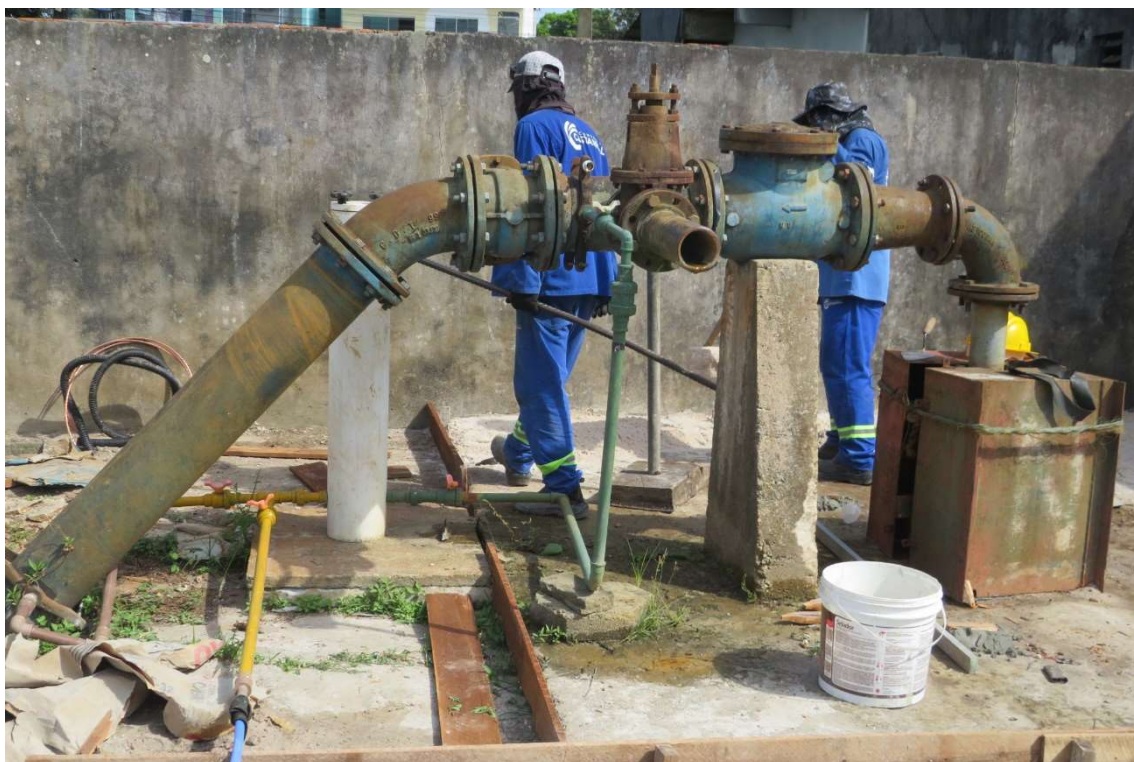
Figura 45. CAS014-TRATAMENTO, Tratamento de desinfecção (cloro pastilha). Fonte: Consórcio, 2023.
