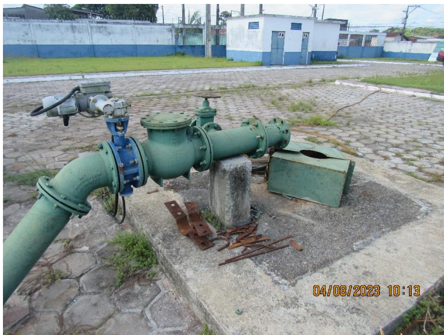
Figura 5. Captação - MAR01, poço 02 (inoperante).
