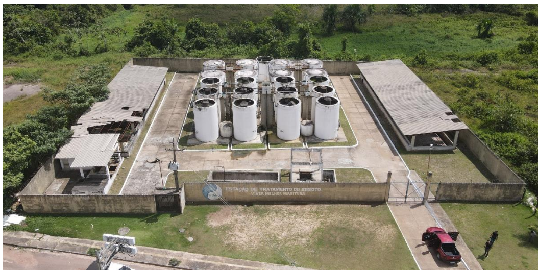
Figura 80. MAR10-ETE, em operação (panorâmica).
