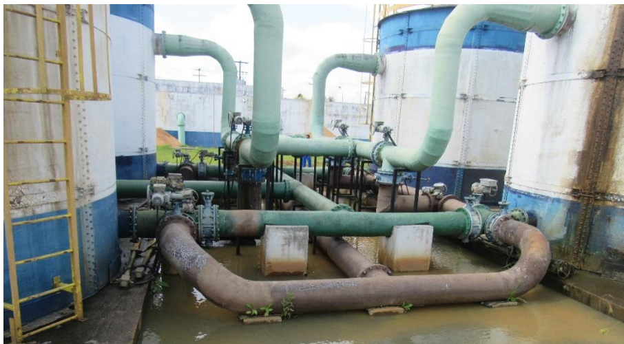
Figura 27. ETA desferrização – MAR01, barrilete.
