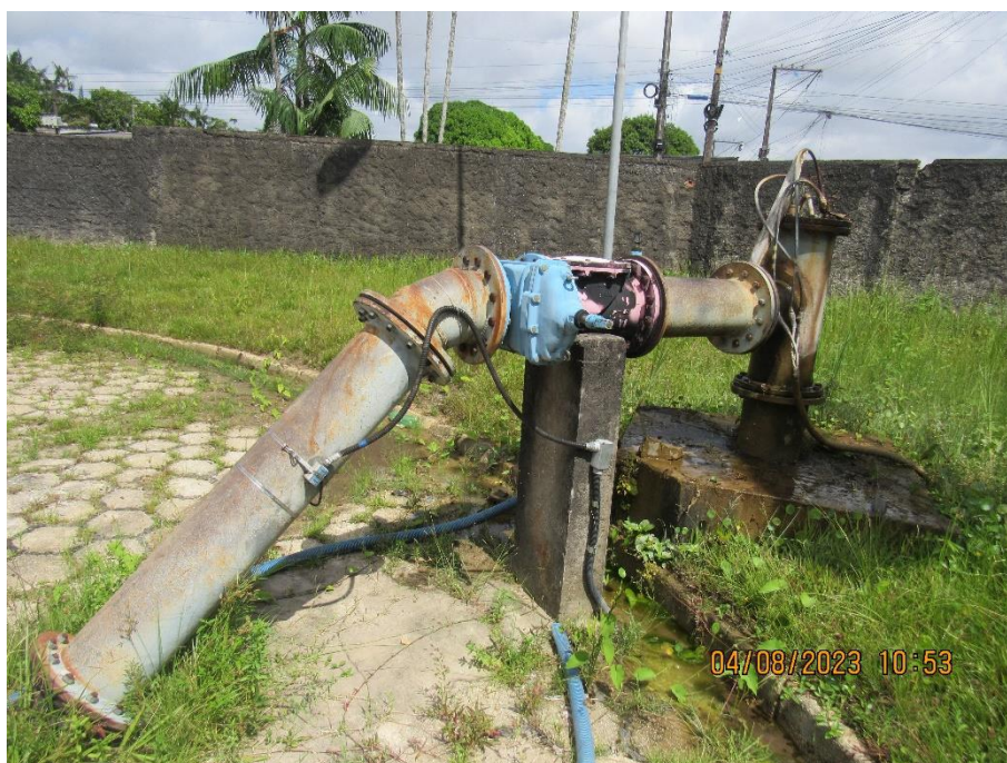
Figura 10. Captação - MAR02, poço 02. Fonte: Consórcio, 2023.
