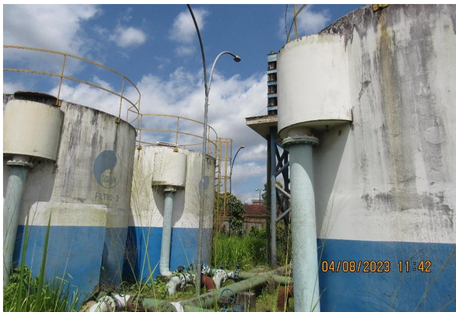
Figura 32. ETA desferrização – MAR04.
