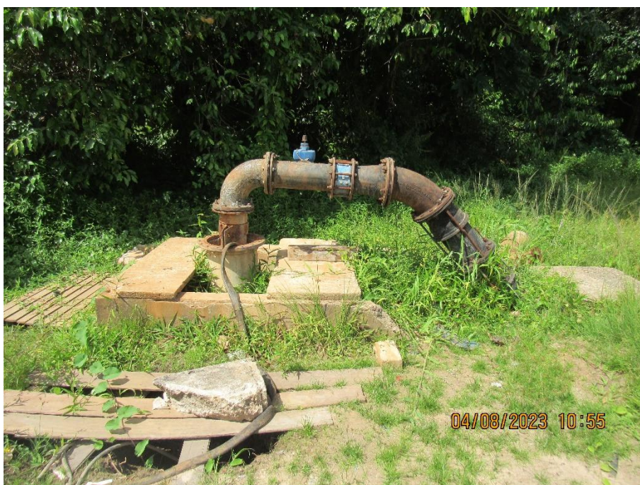
Figura 8. Captação - MAR02, poço 01.
