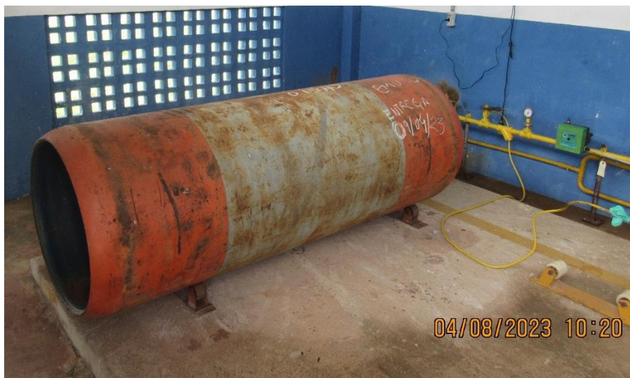
Figura 28. Tratamento Químico – MAR01, cilindro de cloro.
