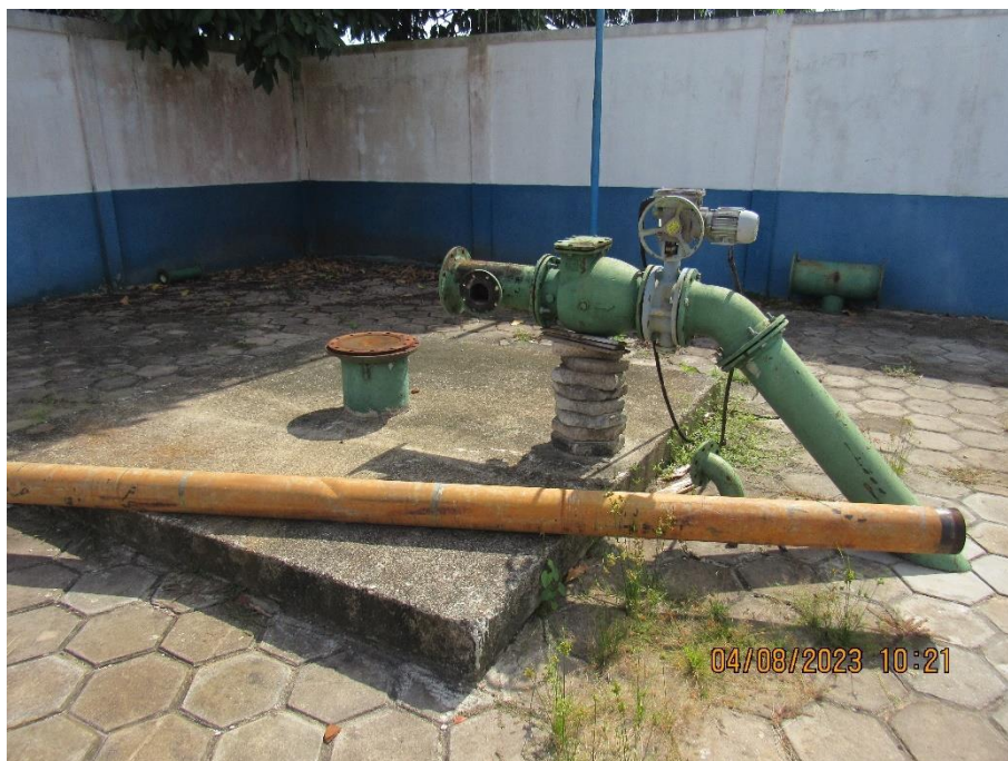
Figura 6. Captação - MAR01, poço 03 (inoperante).
