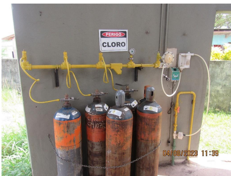
Figura 33. Tratamento Químico – MAR04, clorador.
