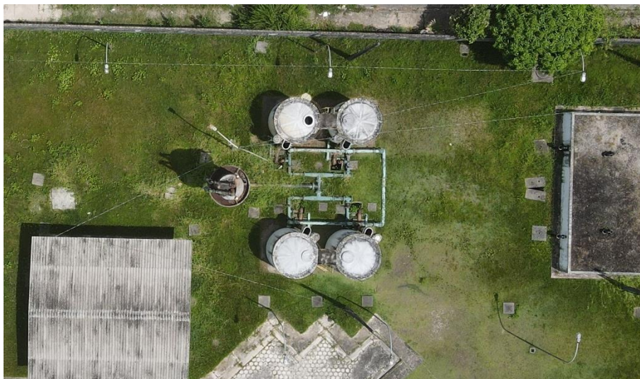
Figura 34. ETA desferrização – MAR05 (panorâmica 01).
