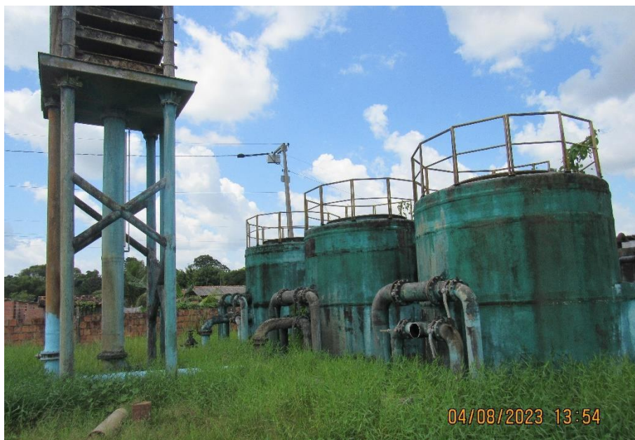
Figura 40. ETA desferrização – MAR06.
