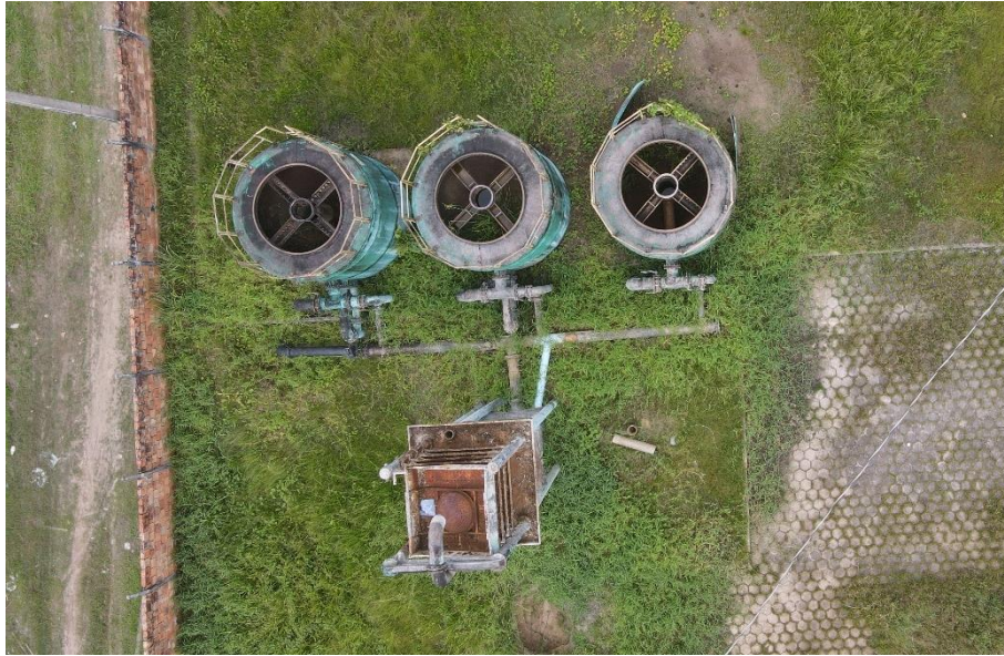
Figura 38. ETA desferrização – MAR06 (panorâmica 01).
