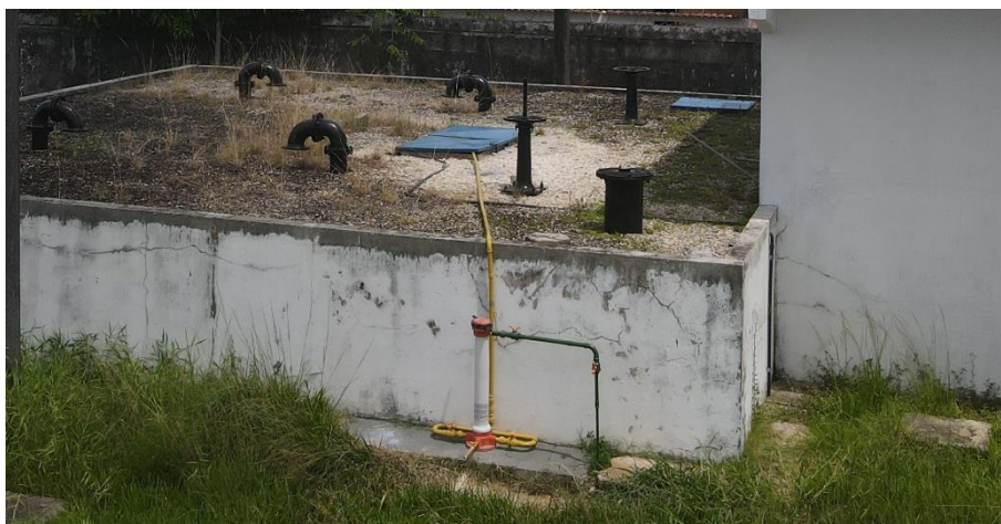
Figura 37. Tratamento Químico – MAR05, clorador.
