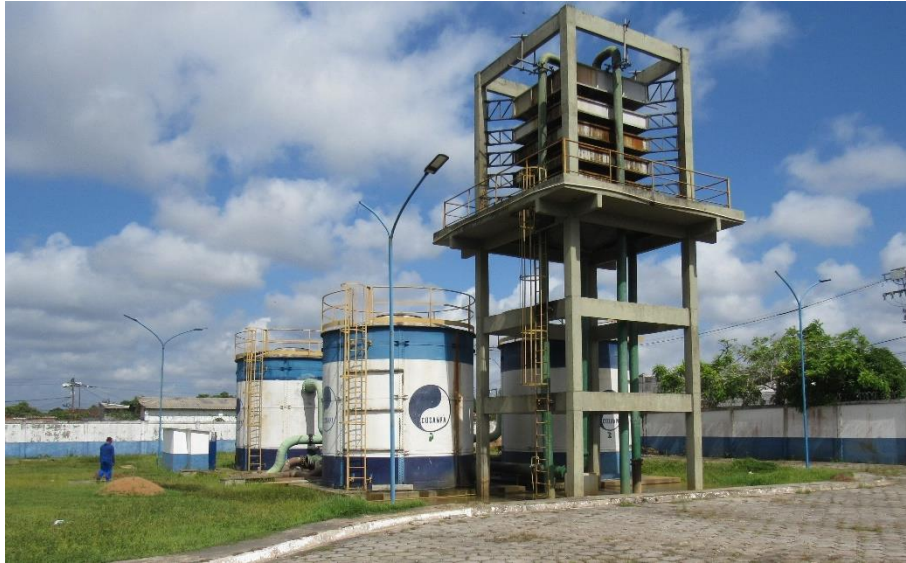
Figura 26. ETA desferrização – MAR01.
