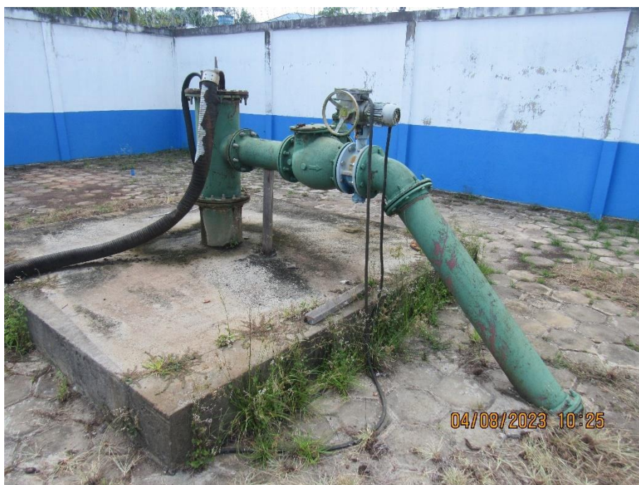
Figura 4. Captação - MAR01, poço 01. Fonte: Consórcio, 2023.
