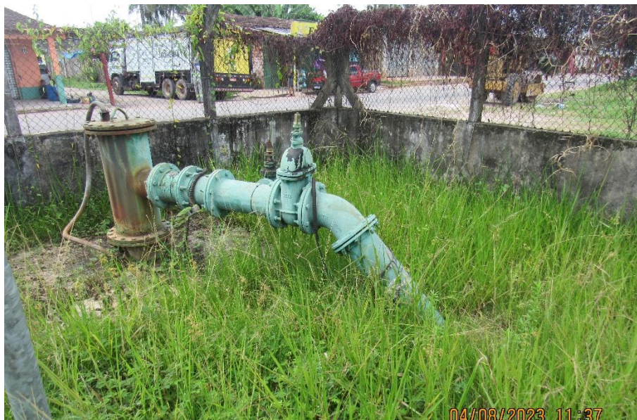
Figura 11. Captação - MAR04, poço 01.
