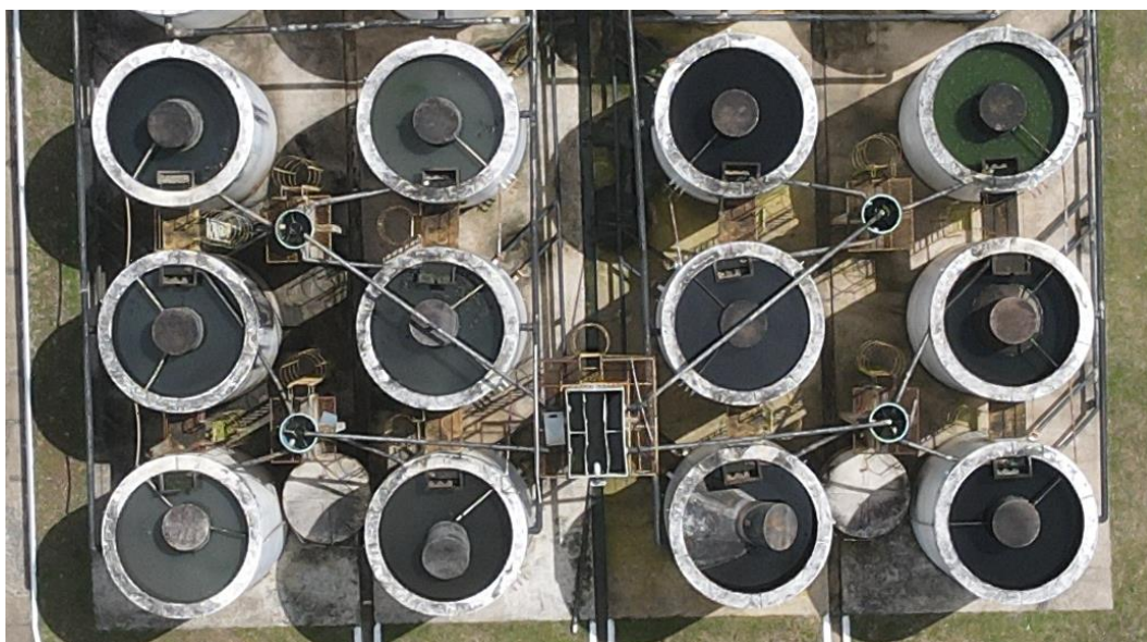
Figura 83. MAR10-ETE, Reatores anaeróbios (UASB).
