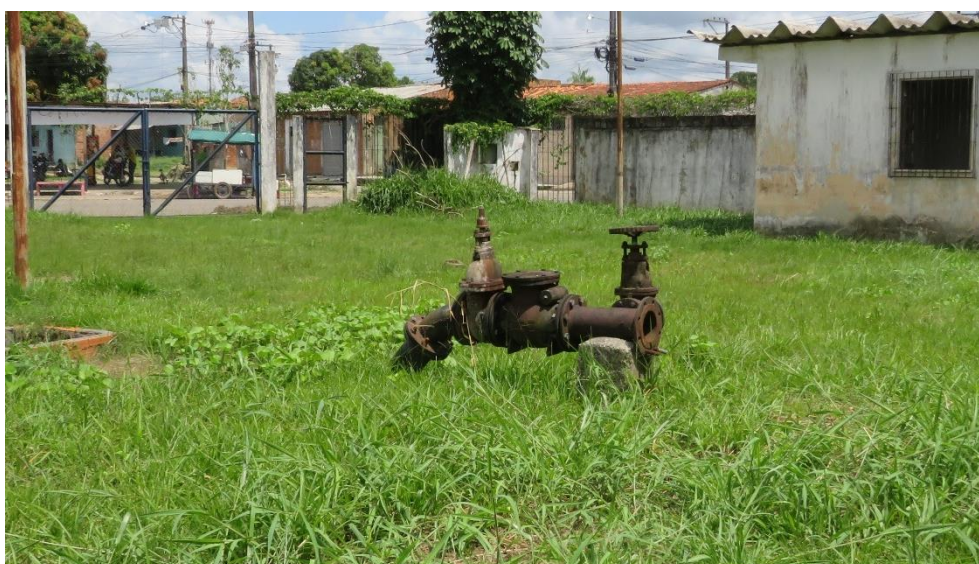
Figura 14. Captação - MAR05, poço 01.
