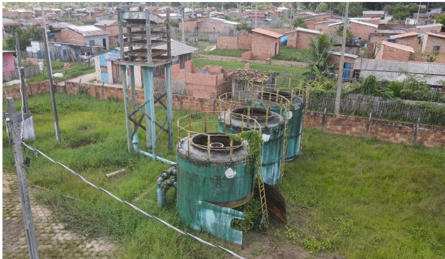
Figura 39. ETA desferrização – MAR06 (panorâmica 02).
