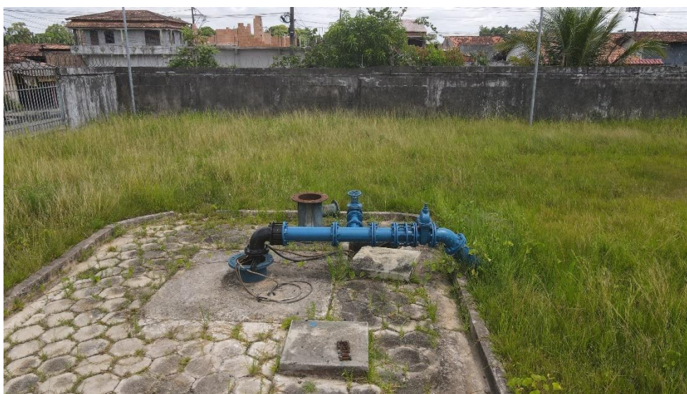
Figura 16. Captação - MAR05, poço 02.
