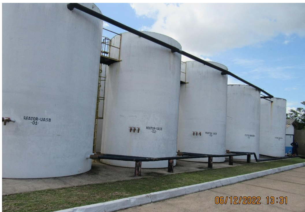
Figura 82. MAR10-ETE, Reatores anaeróbios e filtros anaeróbios.
