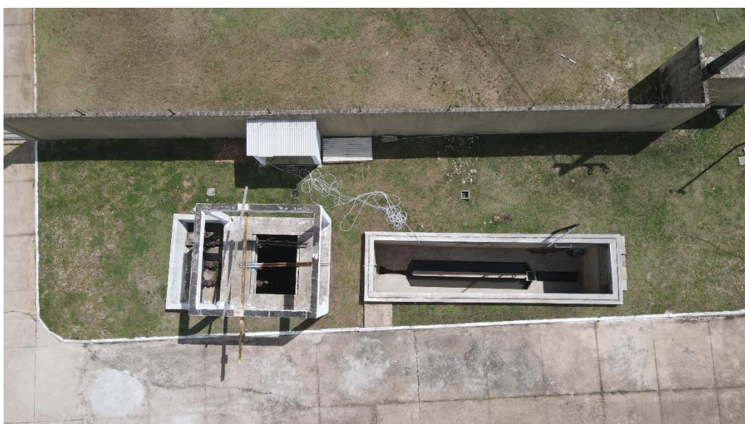
Figura 81. MAR10-ETE, gradeamento e caixa de areia e elevatória.
