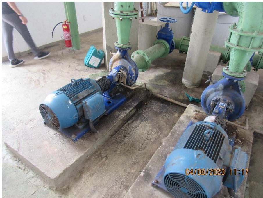
Figura 51. EEAT 01 e 02 – MAR11, casa de bombas. Fonte: Consórcio, 2023.
