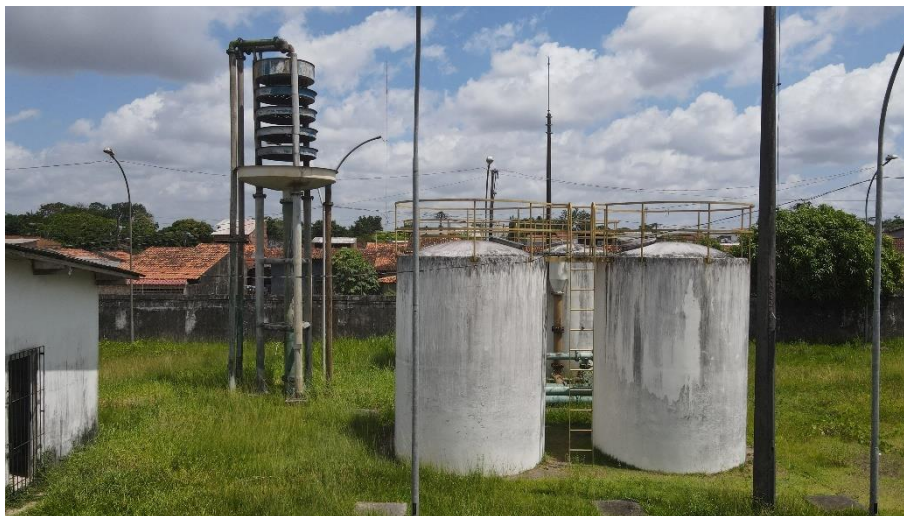
Figura 36. ETA desferrização – MAR05.
