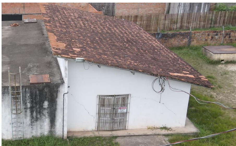
Figura 50. EEAT – MAR06, casa de bombas.
