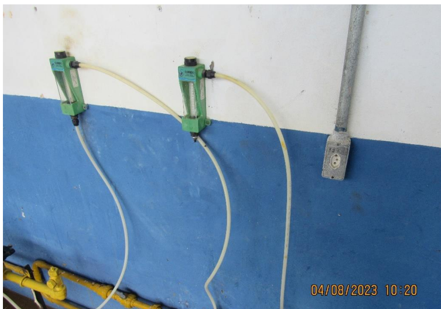
Figura 29. Tratamento Químico – MAR01, clorador.
