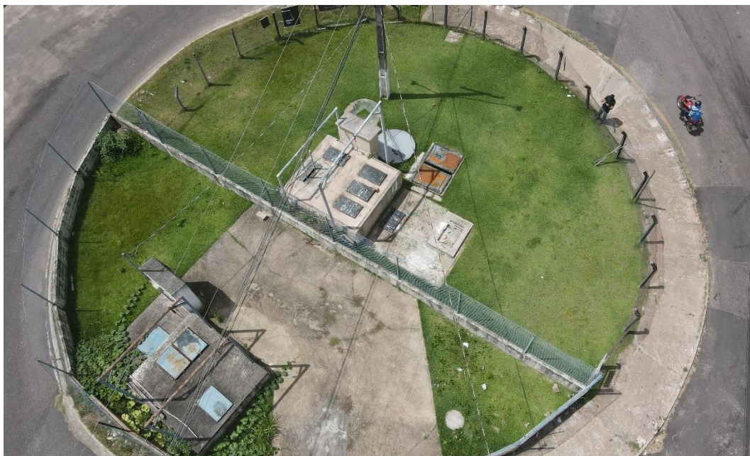
Figura 77. MAR08-EEE, em operação (panorâmica).
