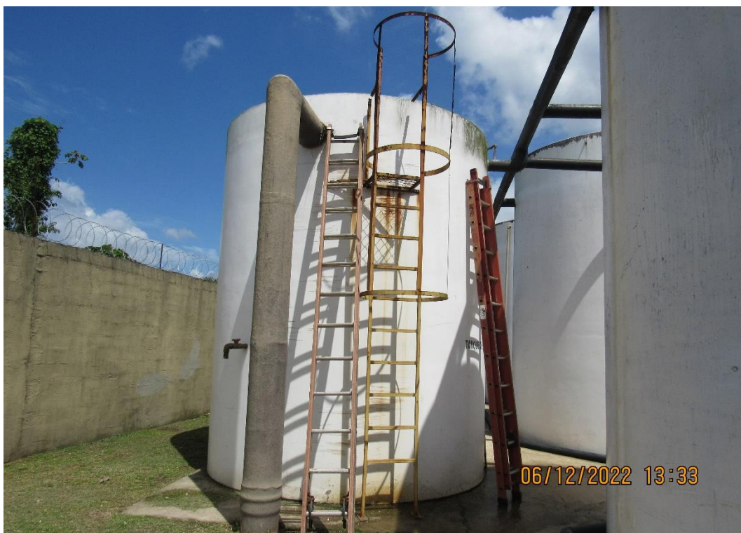
Figura 85. MAR10-ETE, Tanque de contato.
