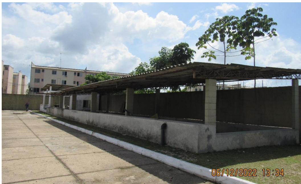
Figura 86. MAR10-ETE, Leitos de secagem. Fonte: Consórcio, 2023.
