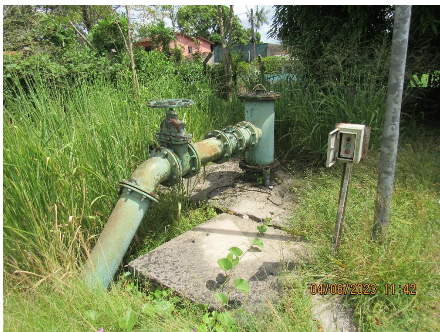
Figura 12. Captação - MAR04, poço 02.
