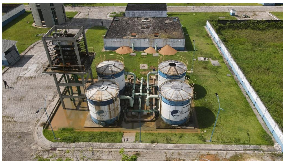
Figura 25. ETA desferrização – MAR01 (panorâmica).
