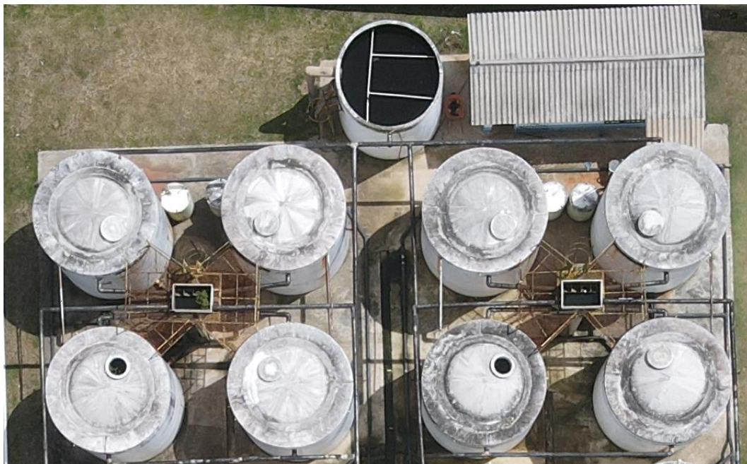
Figura 84. MAR10-ETE, Filtros anaeróbios e tanque de contato.
