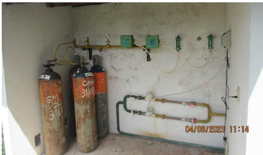
Figura 42. Tratamento Químico – MAR11, clorador.
