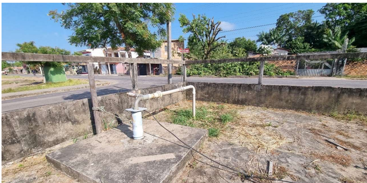
Figura 10. Captação - MUA03, Poço Tubular.
