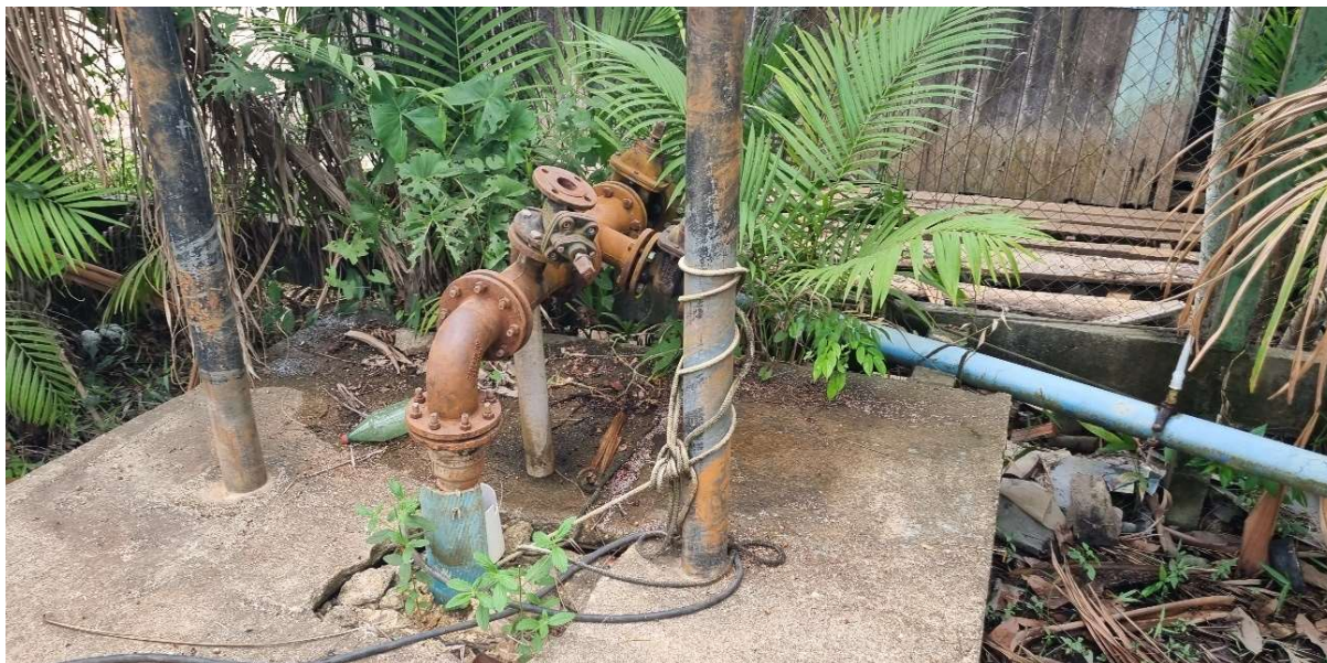
Figura 17. Captação - MUA09, Poço Tubular 01.
