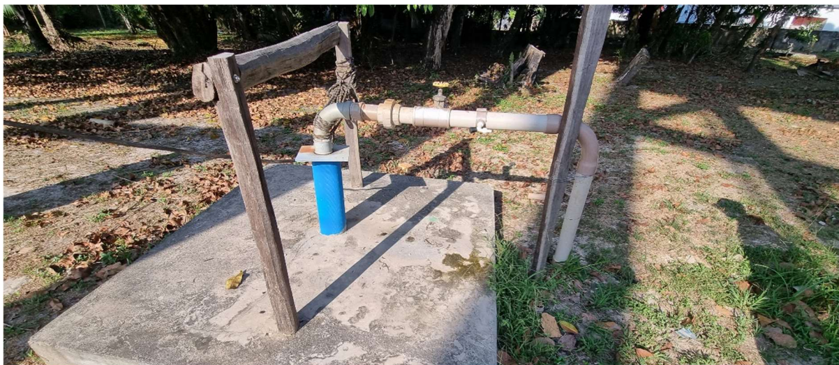
Figura 3. Captação - MUA01, Poço Tubular A.
