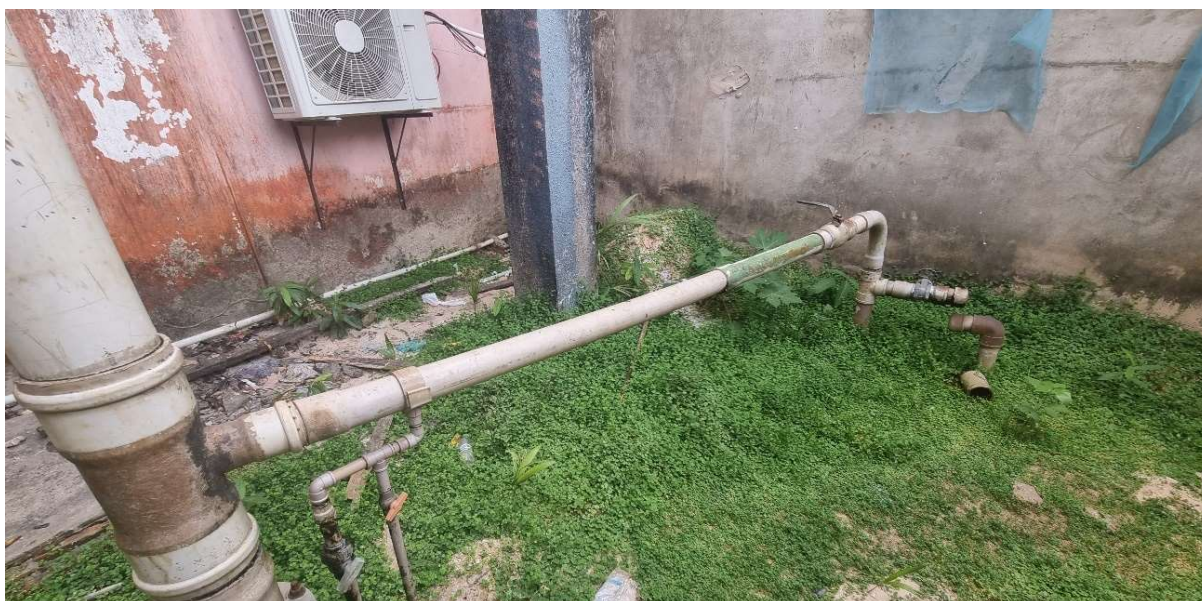
Figura 16. Captação - MUA08, Poço Tubular Desativado.
