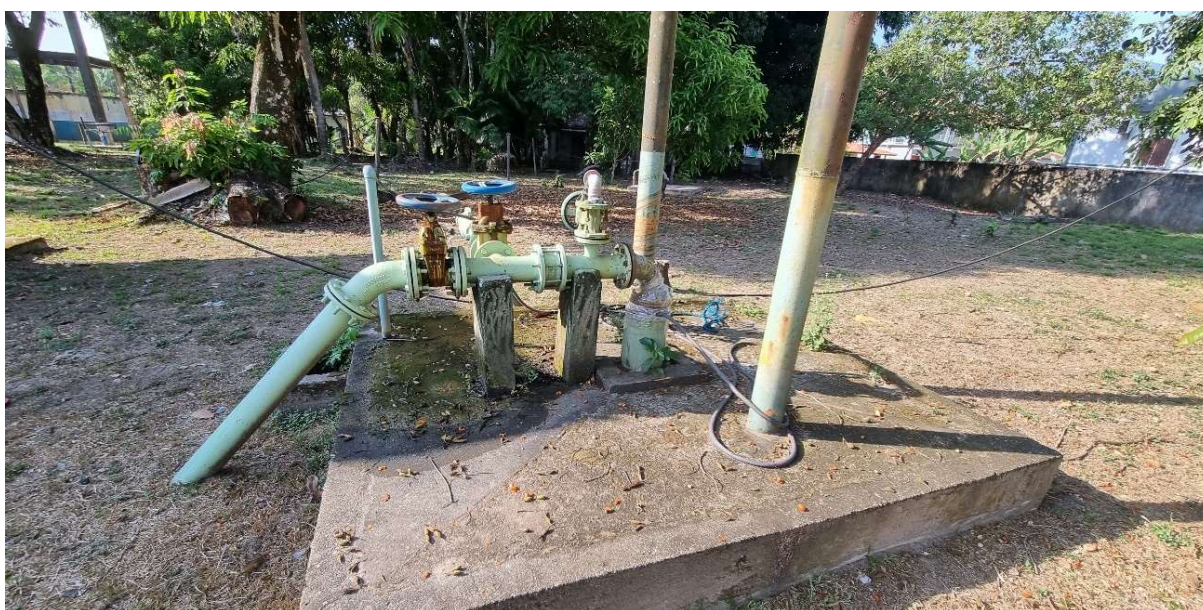
Figura 6. Captação - MUA01, Poço Tubular D.
