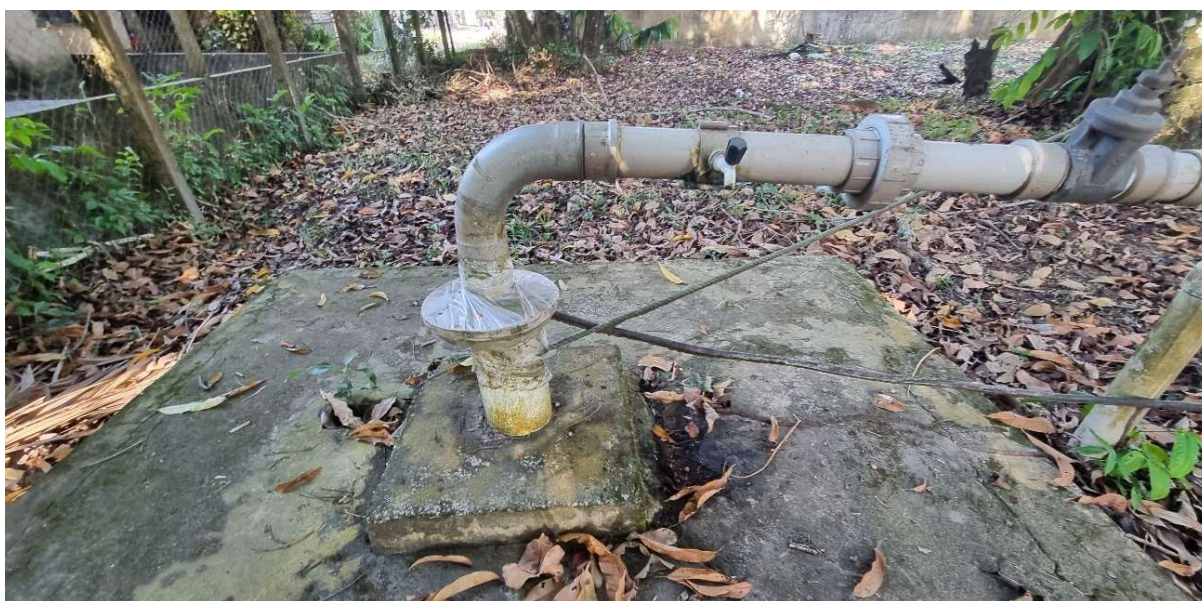
Figura 4. Captação - MUA01, Poço Tubular B.
