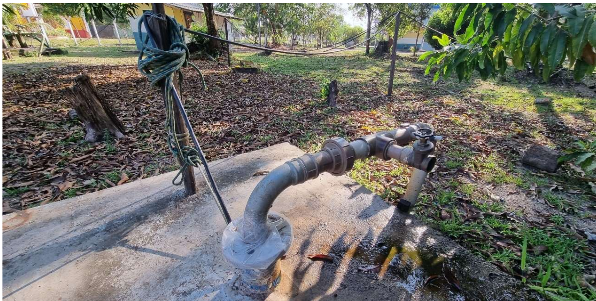
Figura 5. Captação - MUA01, Poço Tubular C.
