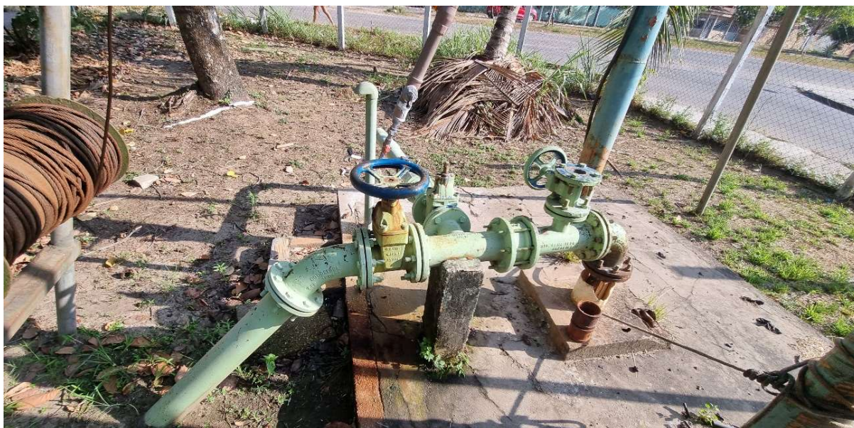
Figura 7. Captação - MUA01, Poço Tubular E. Fonte: Consórcio, 2023.
