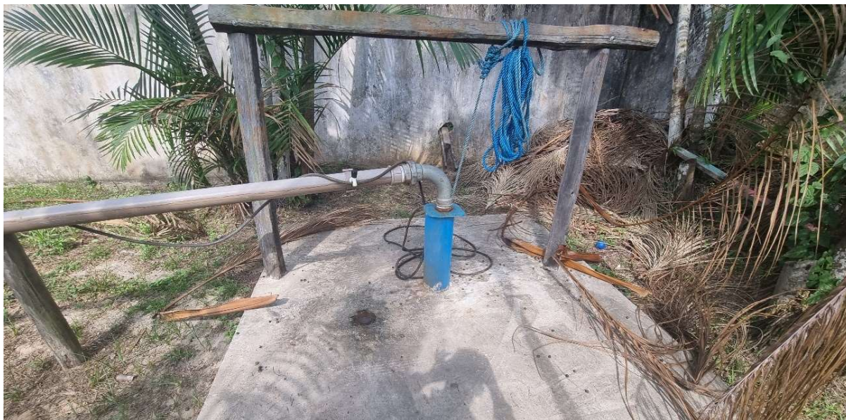
Figura 13. Captação - MUA06, Poço Tubular.
