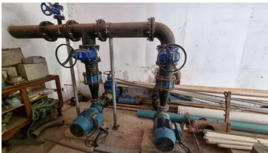
Figura 19. EEAB- MUA01, Conjunto de motobombas.
