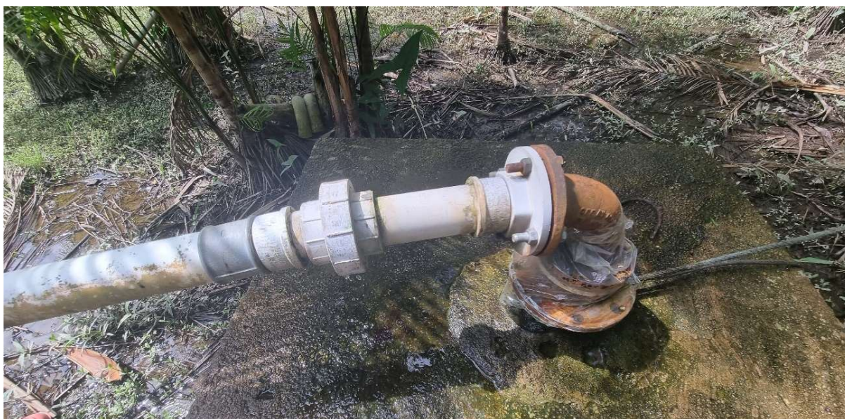
Figura 18. Captação - MUA09, Poço Tubular 02.
