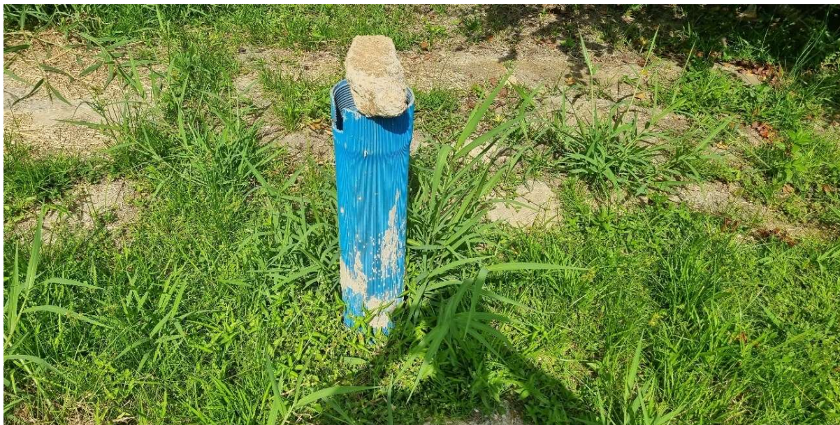
Figura 15. Captação - MUA07, Poço Tubular Desativado.
