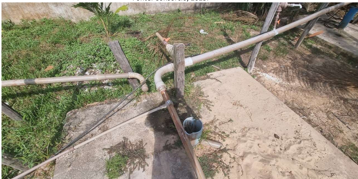
Figura 14. Captação - MUA06, Poço Tubular Desativado.
