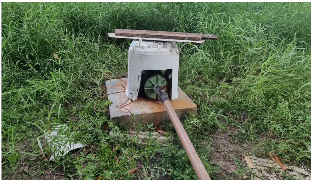
Figura 11. Conjunto Motobomba – POR04, poço tubular 03.
