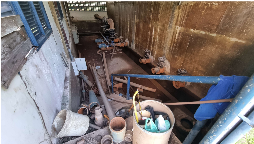
Figura 16. EEAT – POR01, casa de bomba (inoperante).
