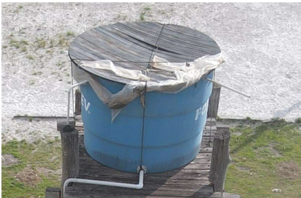
Figura 27. REL – POR03, reservatório (aproximada). Fonte: Consórcio, 2023.
