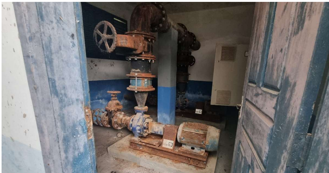
Figura 20. Booster – POR08, conjunto de motobombas (inoperante).
