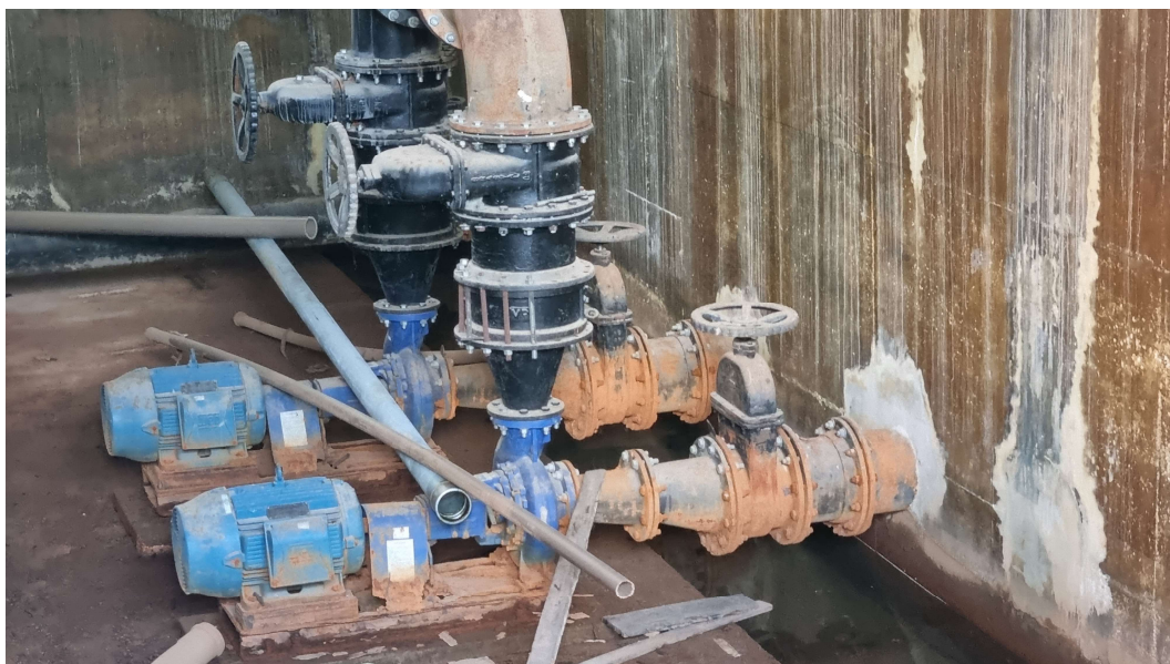
Figura 17. EEAT – POR01, conjunto de motobombas (inoperante).
