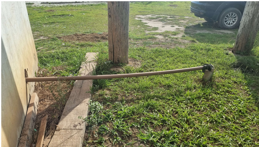
Figura 5. Captação - POR03, poço tubular.
