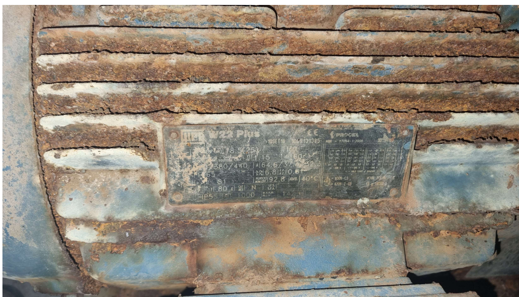
Figura 21. Booster – POR08, especificações do CMB (inoperante).
