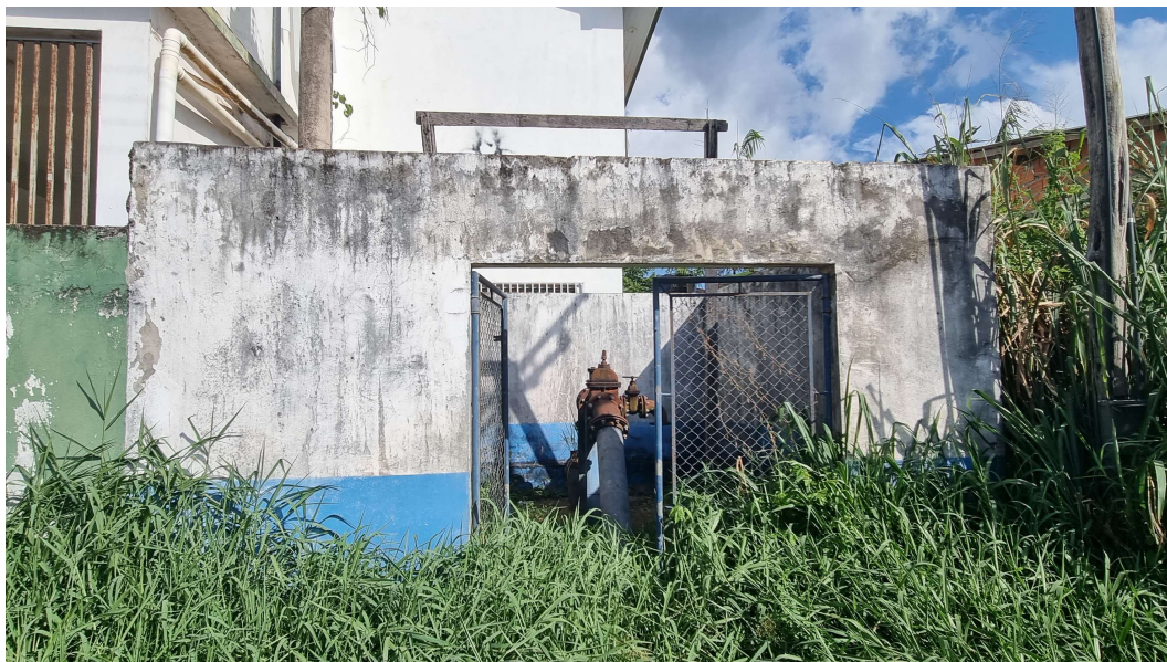
Figura 13. Captação – POR06, poço tubular (aproximada).
