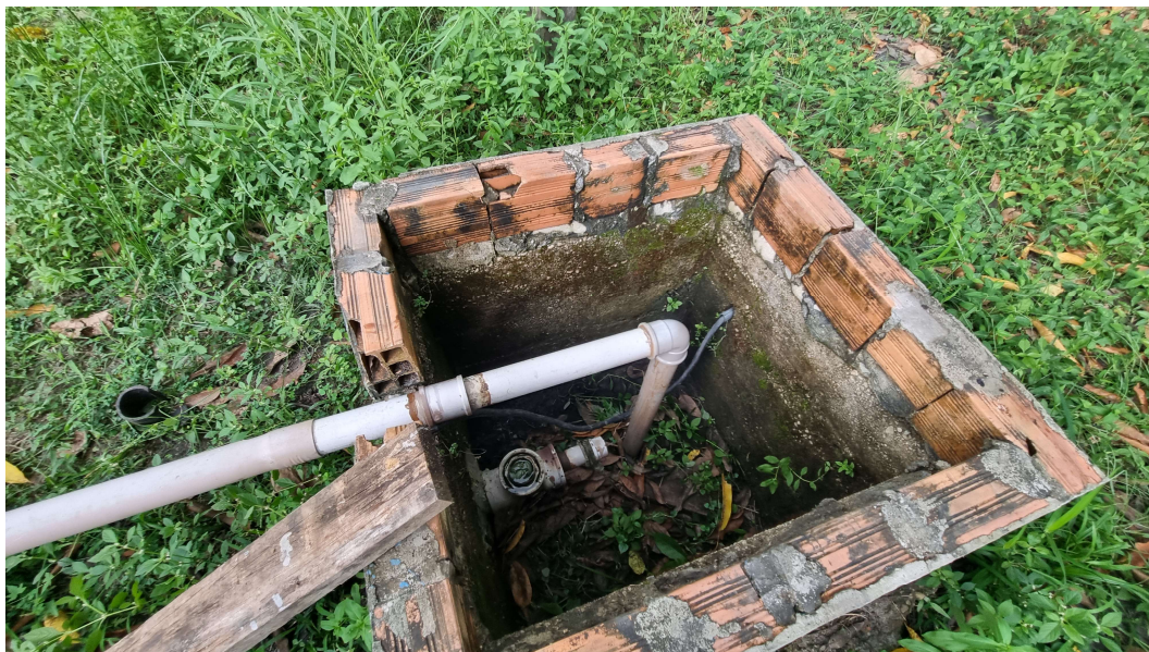
Figura 9. Captação – POR04, poço tubular 03 (aproximada).
