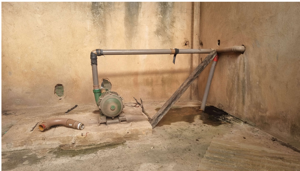
Figura 15. Conjunto Motobomba – POR07, poço tubular 01 e 02.
