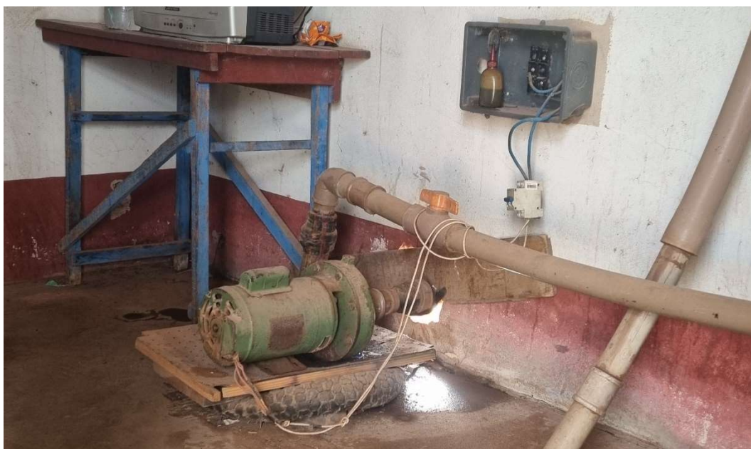
Figura 6. Conjunto Motobomba - POR03, poço tubular.
