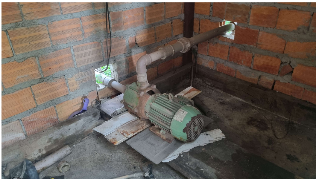
Figura 10. Conjunto Motobomba – POR04, poço tubular 01 e 02.
