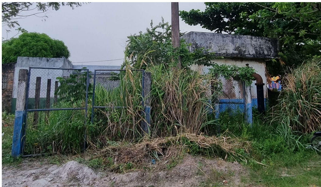
Figura 19. Booster – POR08, casa de bomba (inoperante).
