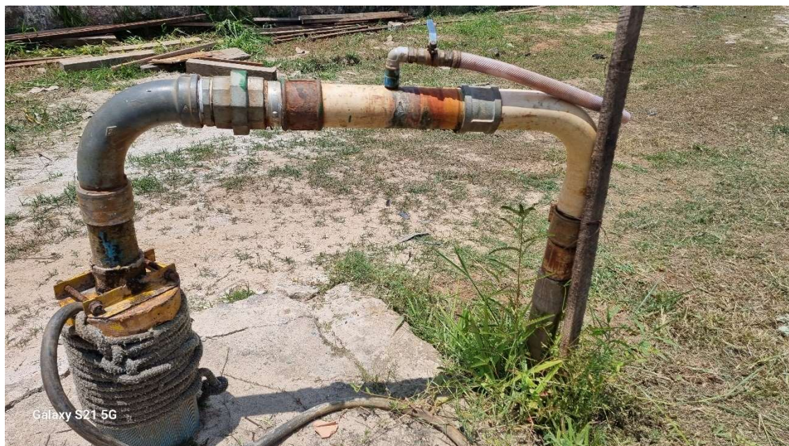
Figura 29. STI16-CAPTAÇÃO001, subterrânea (poço tubular) Fonte: Consórcio, 2023.
