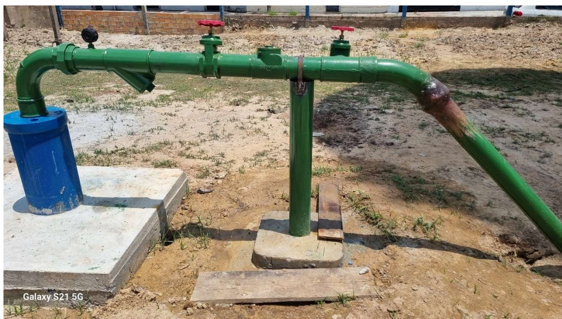
Figura 30. STI16-CAPTAÇÃO002, subterrânea (poço tubular) Fonte: Consórcio, 2023.
