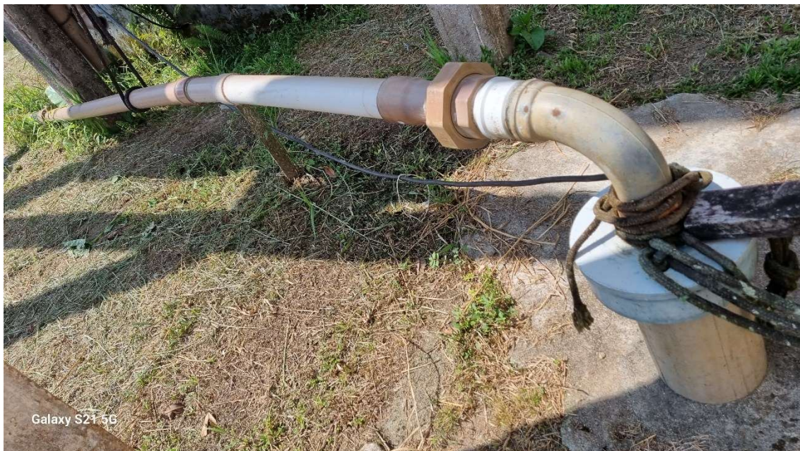
Figura 17. STI09-CAPTAÇÃO02, subterrânea (poço tubular)
