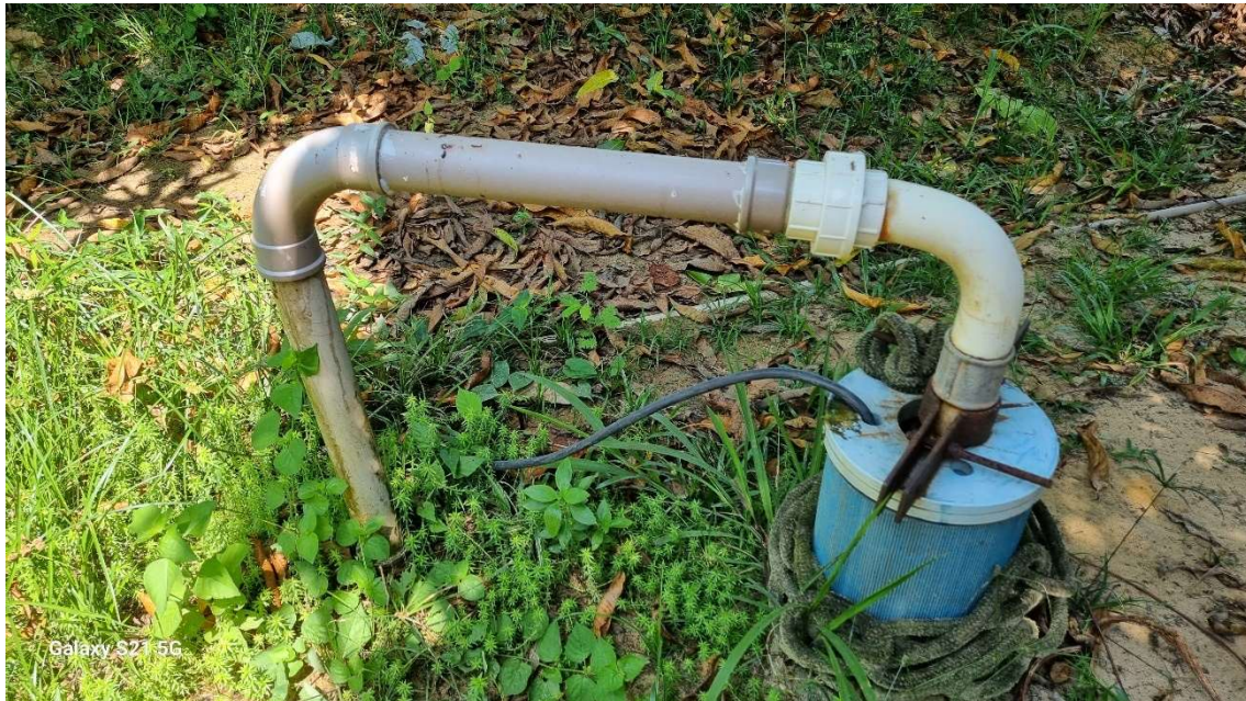
Figura 15. STI08-CAPTAÇÃO, subterrânea (poço tubular)
