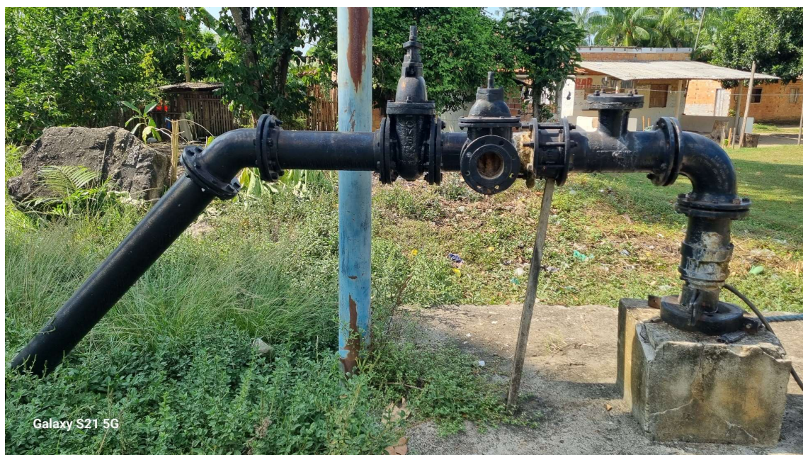
Figura 8. STI02-CAPTAÇÃO005, subterrânea (poço tubular) Fonte: Consórcio, 2023.
