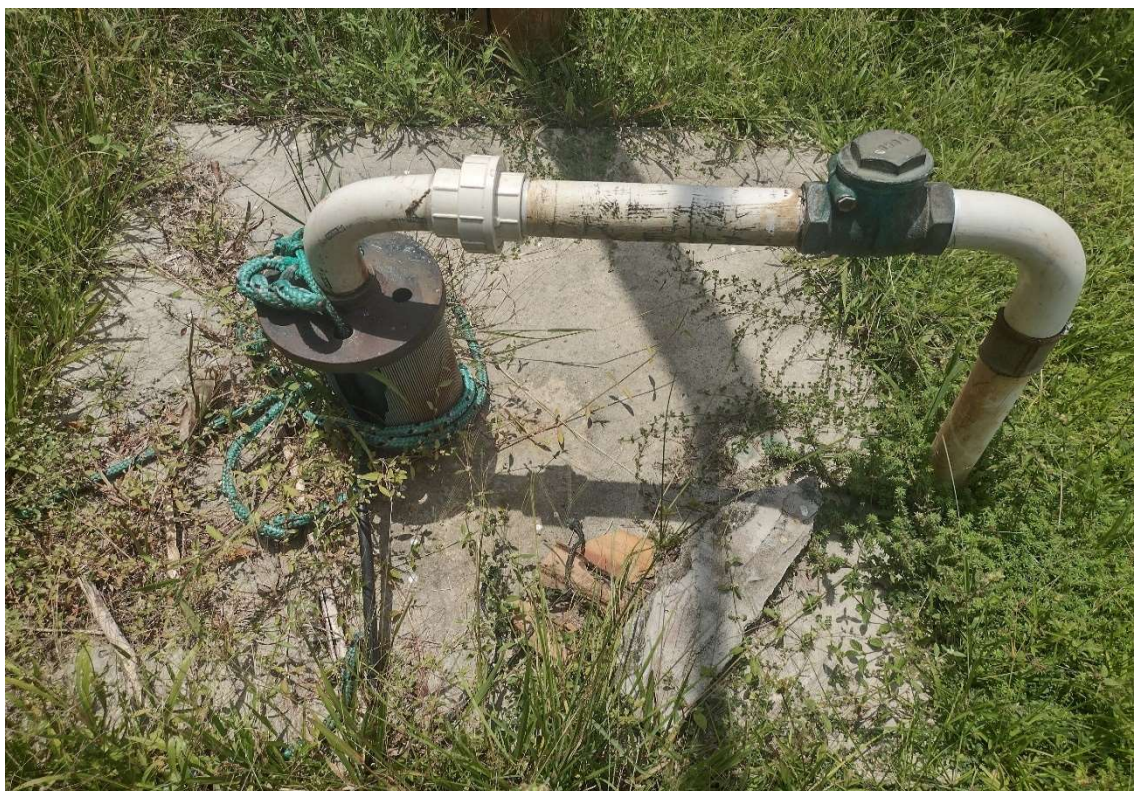
Figura 34. ST120-CAPTAÇÃO, subterrânea (poço tubular) Fonte: Consórcio, 2023
