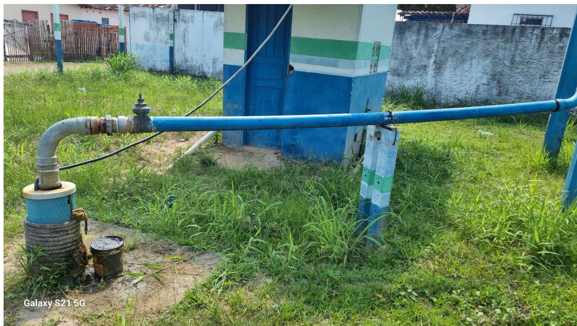
Figura 9. STI03-CAPTAÇÃO, subterrânea (poço tubular)
