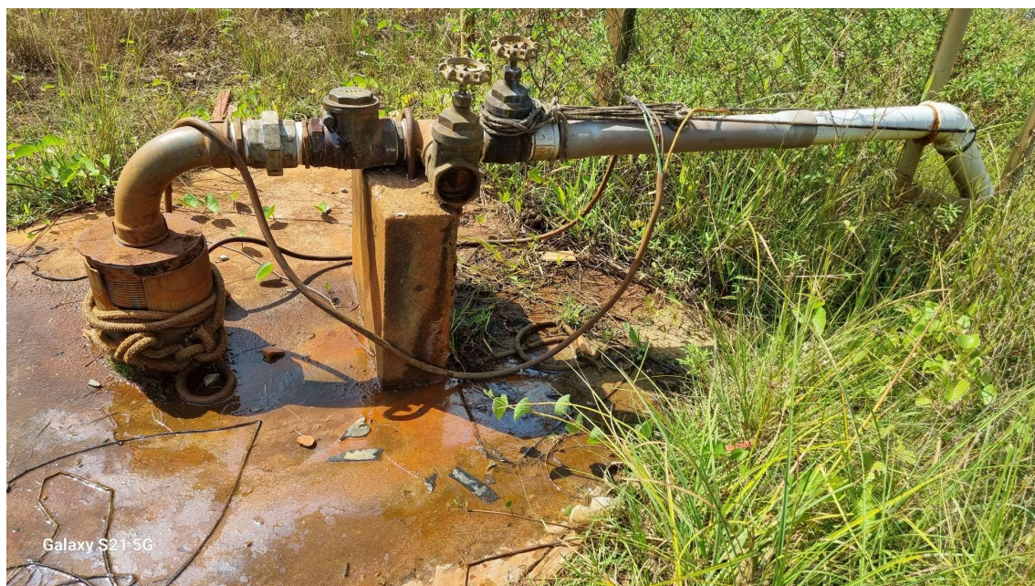
Figura 10. STI04-CAPTAÇÃO, subterrânea (poço tubular)
