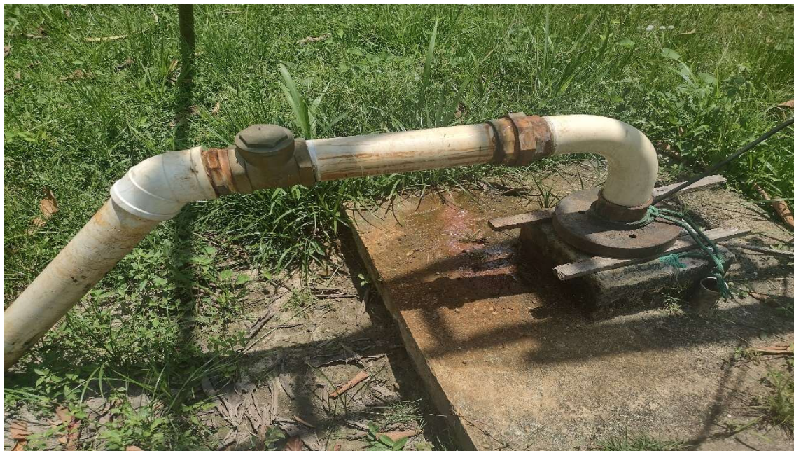
Figura 33. ST119-CAPTAÇÃO, subterrânea (poço tubular) Fonte: Consórcio, 2023
