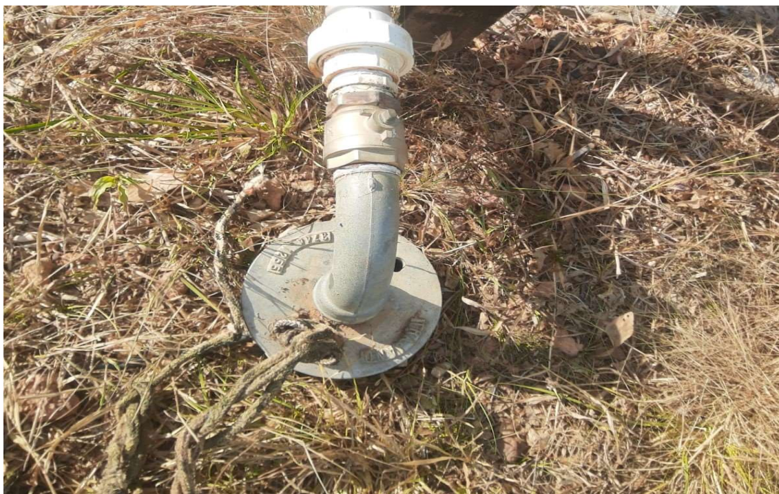
Figura 37. STI23-CAPTAÇÃO, subterrânea (poço tubular)
