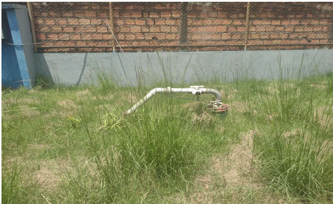
Figura 25. STI14-CAPTAÇÃO, subterrânea (poço tubular)
