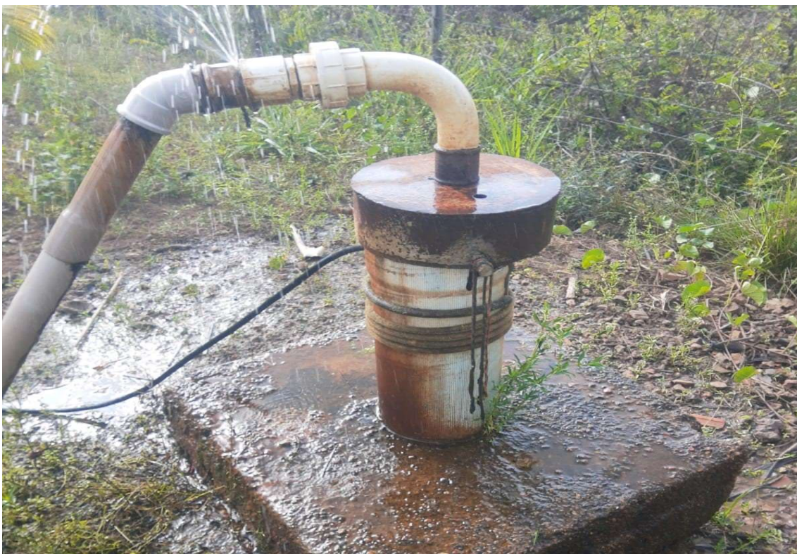
Figura 36. STI22-CAPTAÇÃO, subterrânea (poço tubular)
