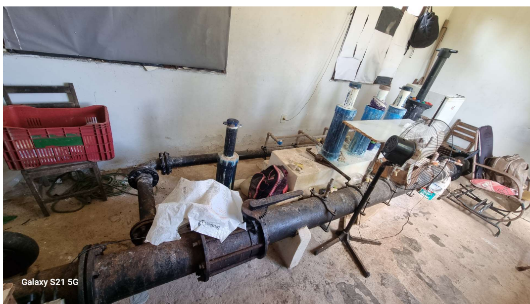
Figura 39. STI02-TRATQUÍMICO, (dosador de cloro)
