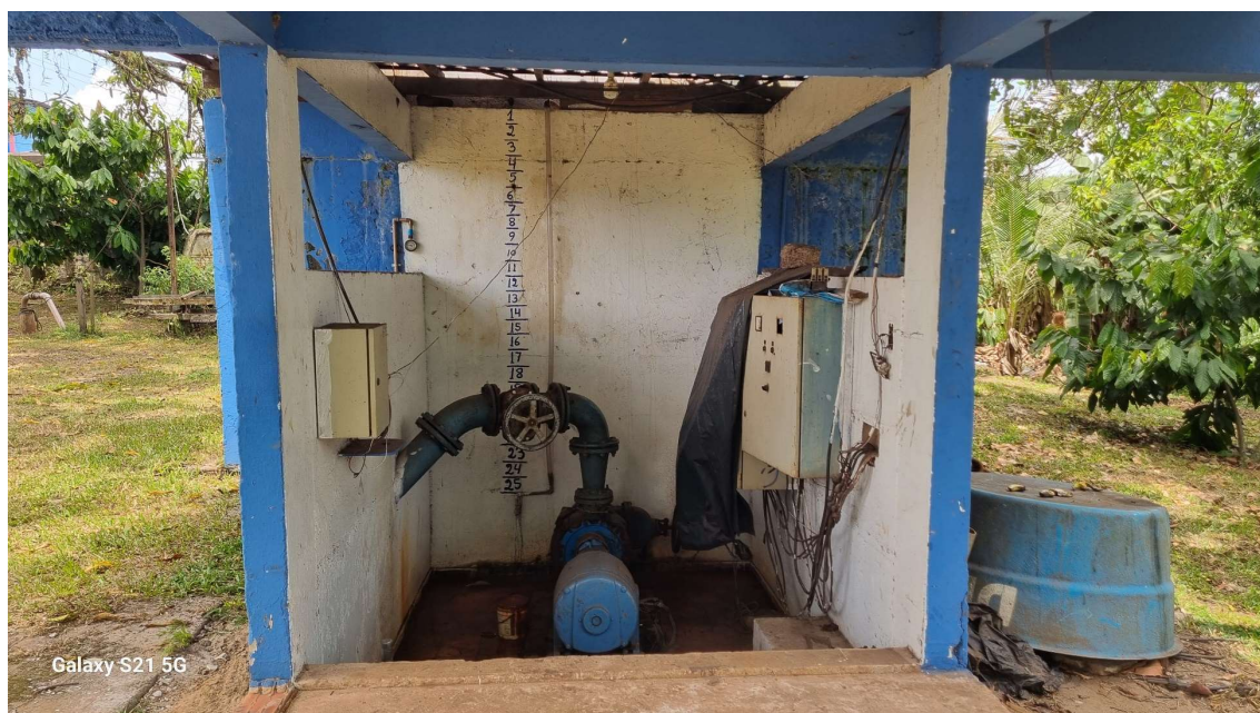
Figura 40. STI15-EEAB, (Estação Elevatória de Água Bruta)
