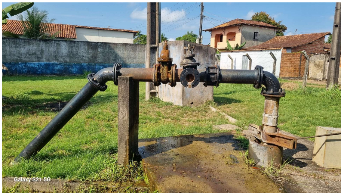
Figura 3. STI01-CAPTAÇÃO, subterrânea (poço tubular) Fonte: Consórcio, 2023.
