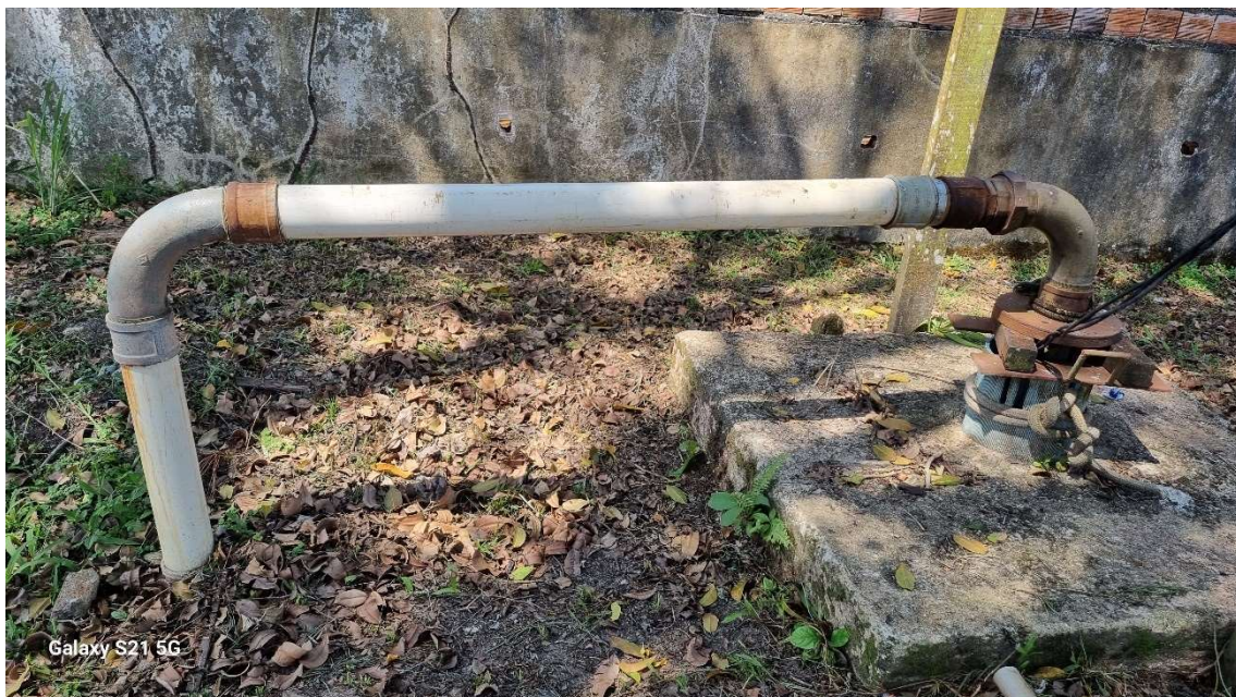
Figura 16. STI09-CAPTAÇÃO01, subterrânea (poço tubular)
