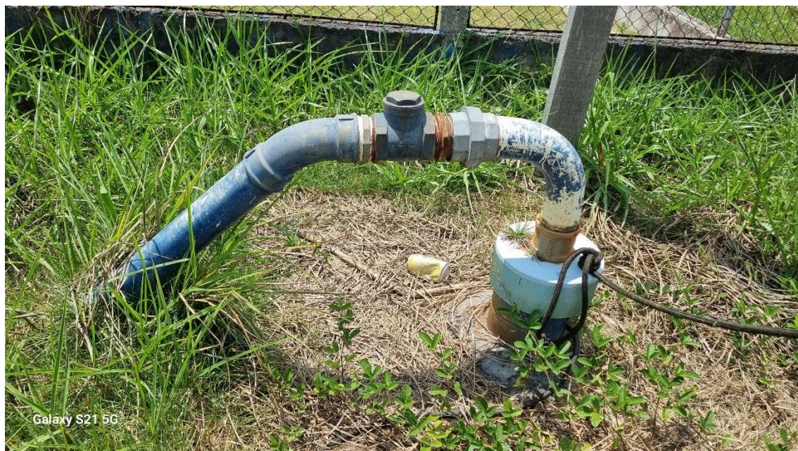
Figura 23. STI13-CAPTAÇÃO001, subterrânea (poço tubular)
