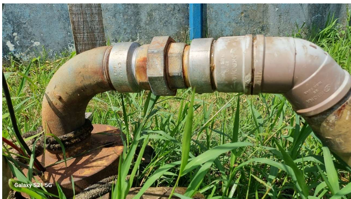
Figura 14. STI07-CAPTAÇÃO002, subterrânea (poço tubular)
