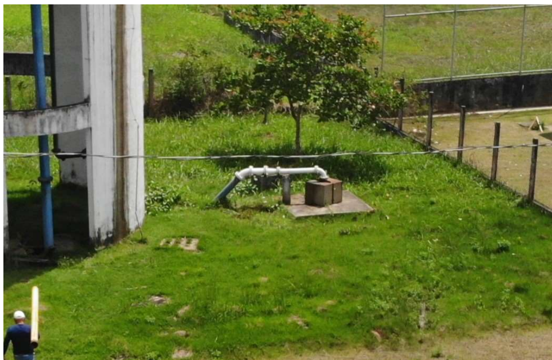
Figura 24. STI13-CAPTAÇÃO002, subterrânea (poço tubular)
