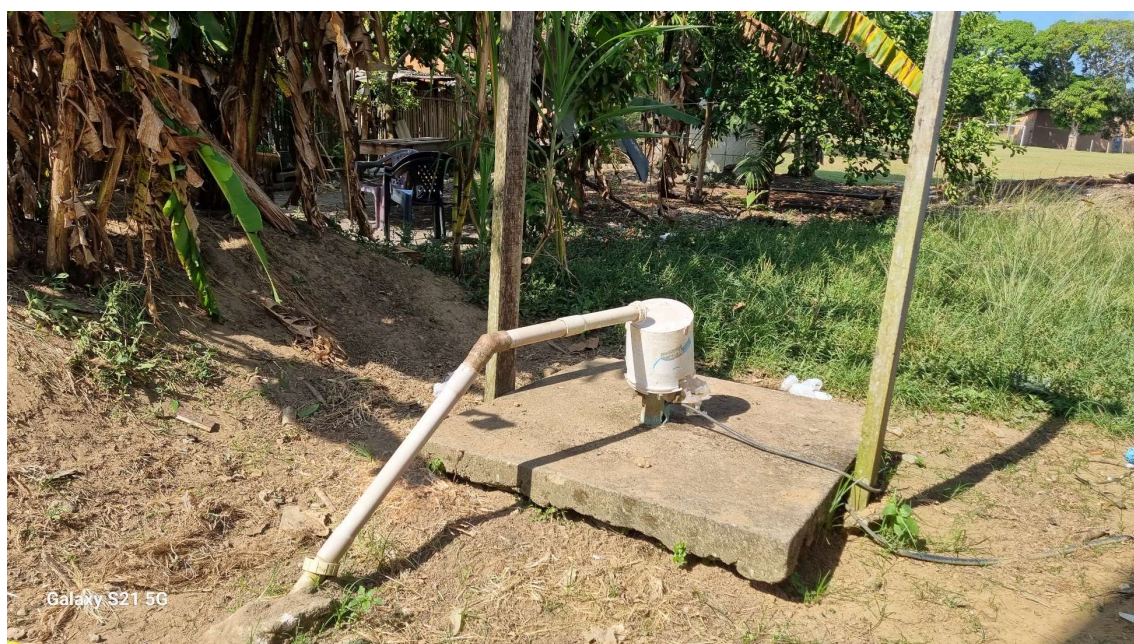
Figura 6. STI02-CAPTAÇÃO03, subterrânea (poço tubular)
