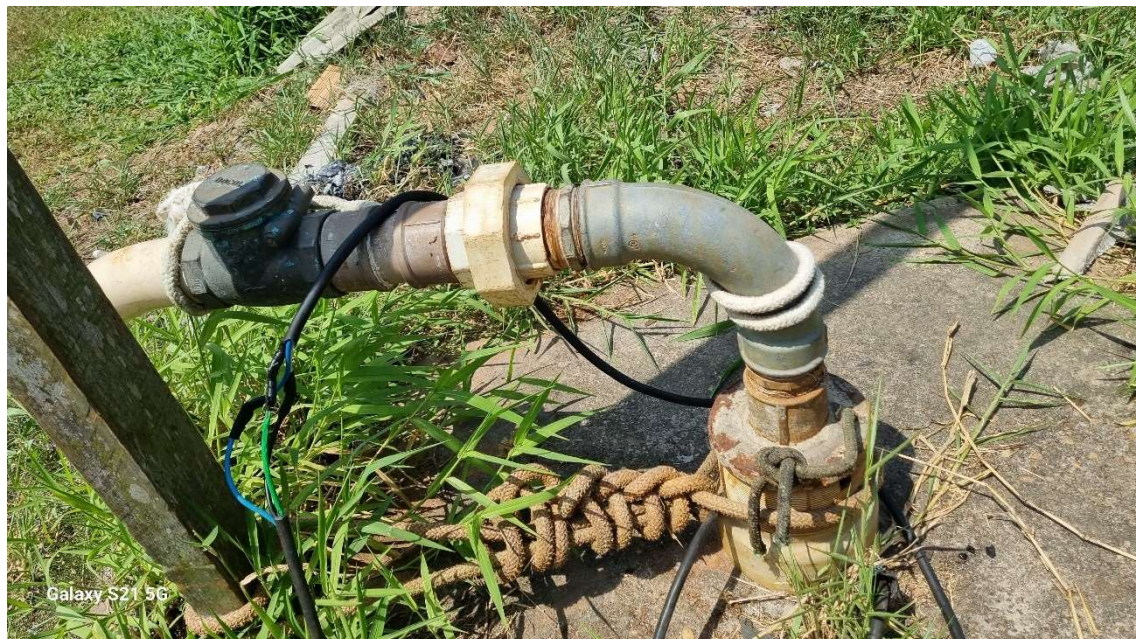
Figura 19. STI10-CAPTAÇÃO02, subterrânea (poço tubular)
