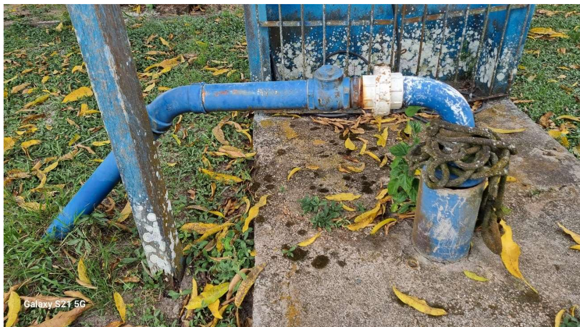
Figura 31. STI17-CAPTAÇÃO, subterrânea (poço tubular)
