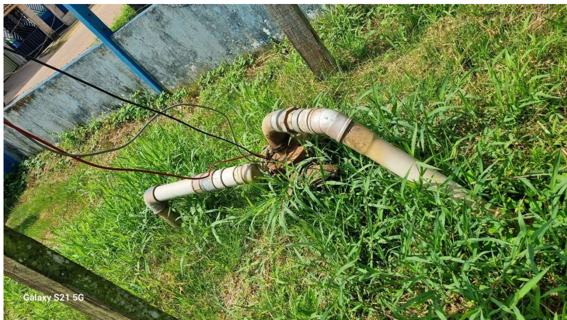
Figura 13. STI07-CAPTAÇÃO001, subterrânea (poço tubular)
