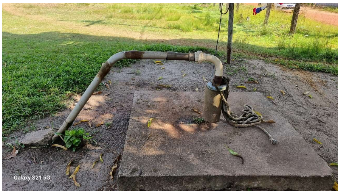
Figura 4. STI02-CAPTAÇÃO001, subterrânea (poço tubular) Fonte: Consórcio, 2023.
