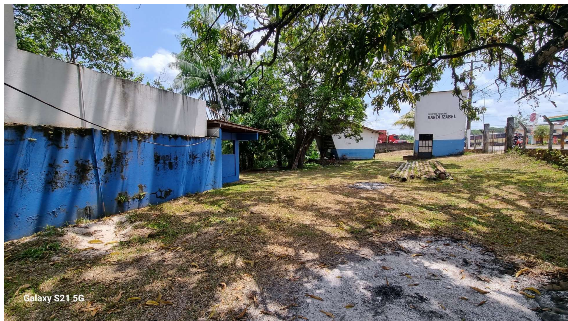
Figura 52. STI15-RAP, (reservatório apoiado)
