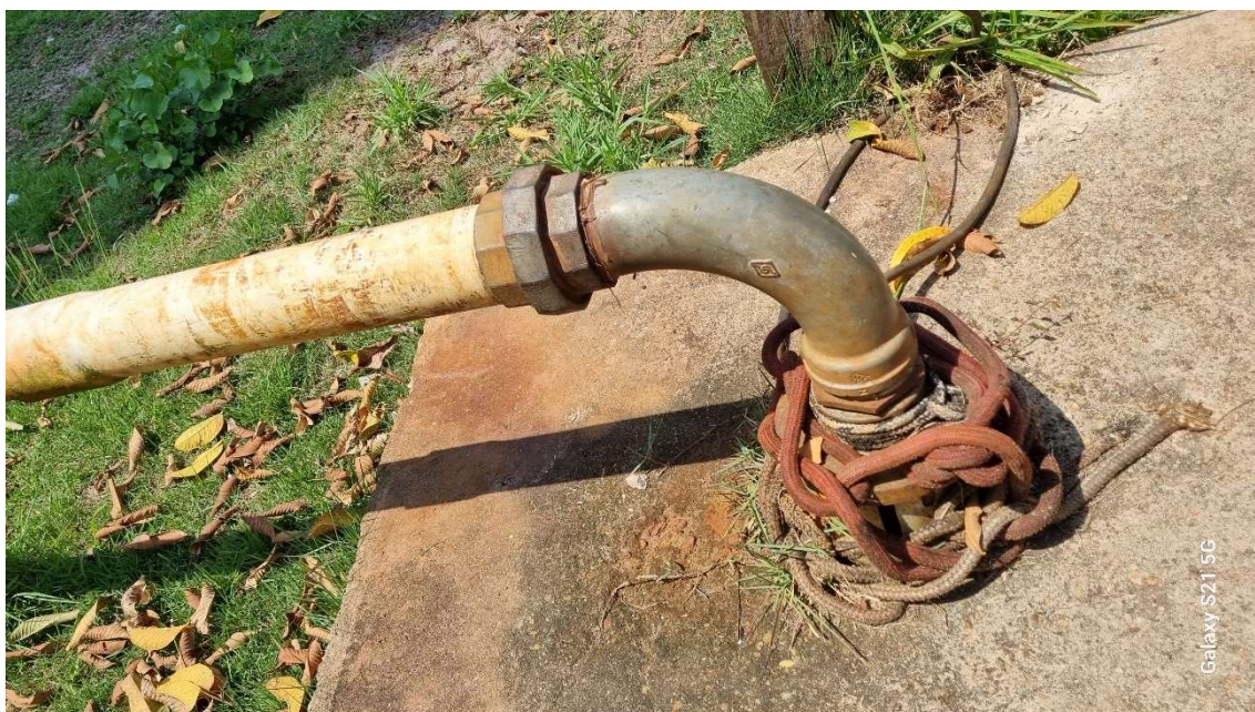
Figura 18. STI10-CAPTAÇÃO01, subterrânea (poço tubular)
