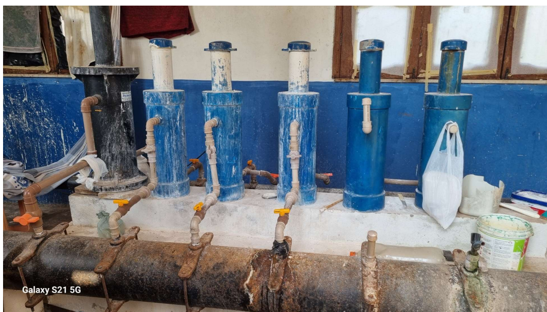
Figura 38. STI01-TRATQUÍMICO, (dosador de cloro)
