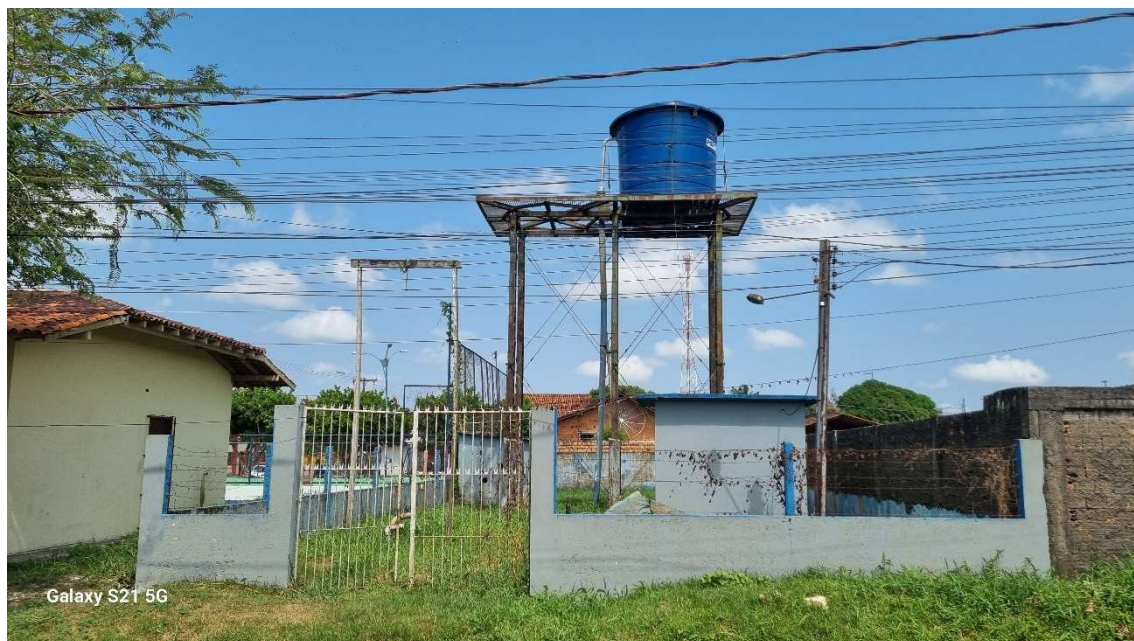
Figura 48. ST107-REL, (reservatório elevado)
