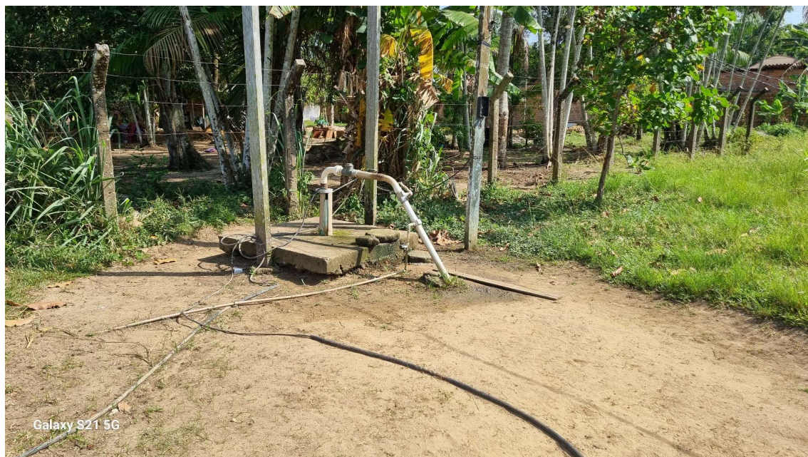
Figura 7. STI02-CAPTAÇÃO004, subterrânea (poço tubular) Fonte: Consórcio, 2023.
