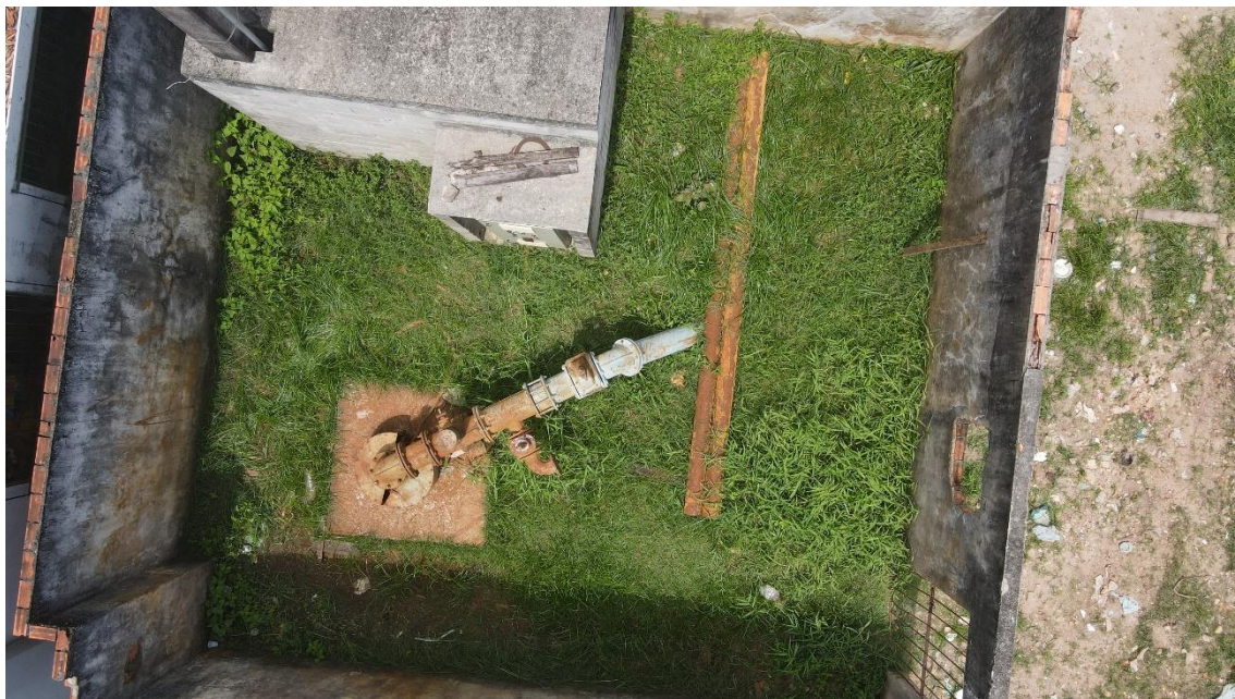
Figura 12. Poço Tubular de ABT06 (Panorâmica).
