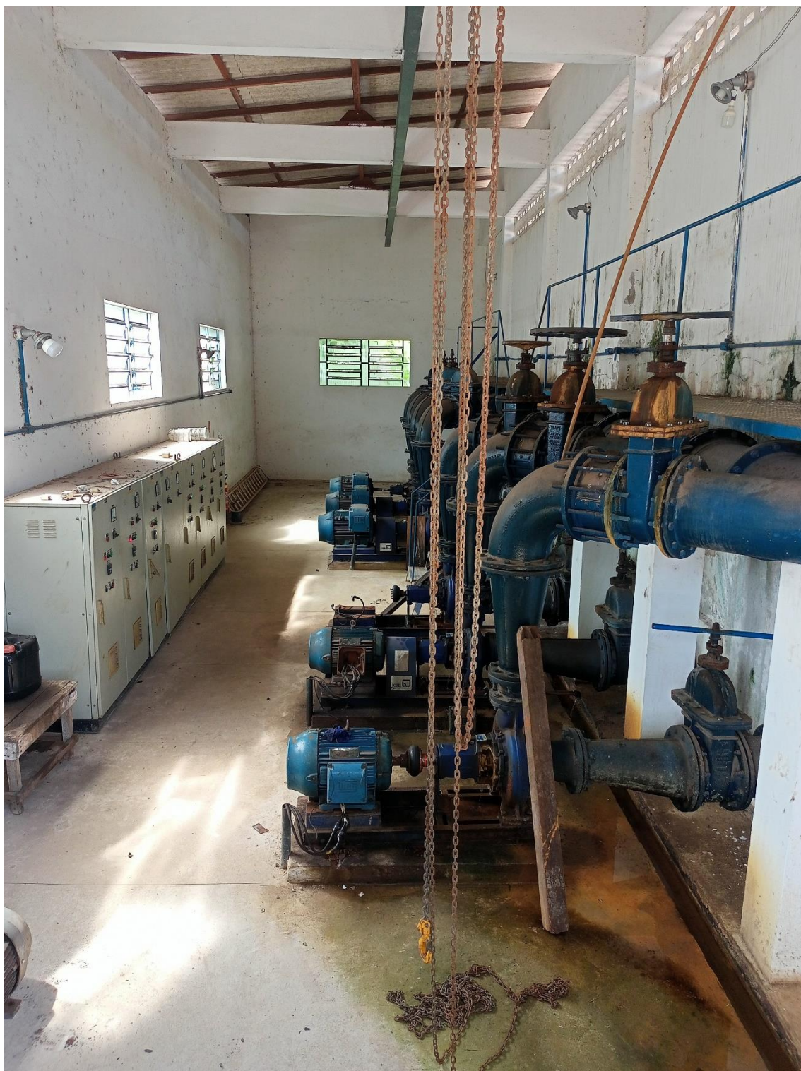
Figura 24. Conjuntos de Motobombas da EEAT01, EEAT02 e EELF01
