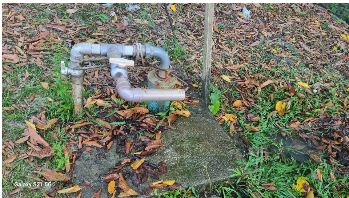
Figura 7. ACA02 - CAPTAÇÃO 02 (poço subterrâneo). Fonte: Consórcio, 2023.
