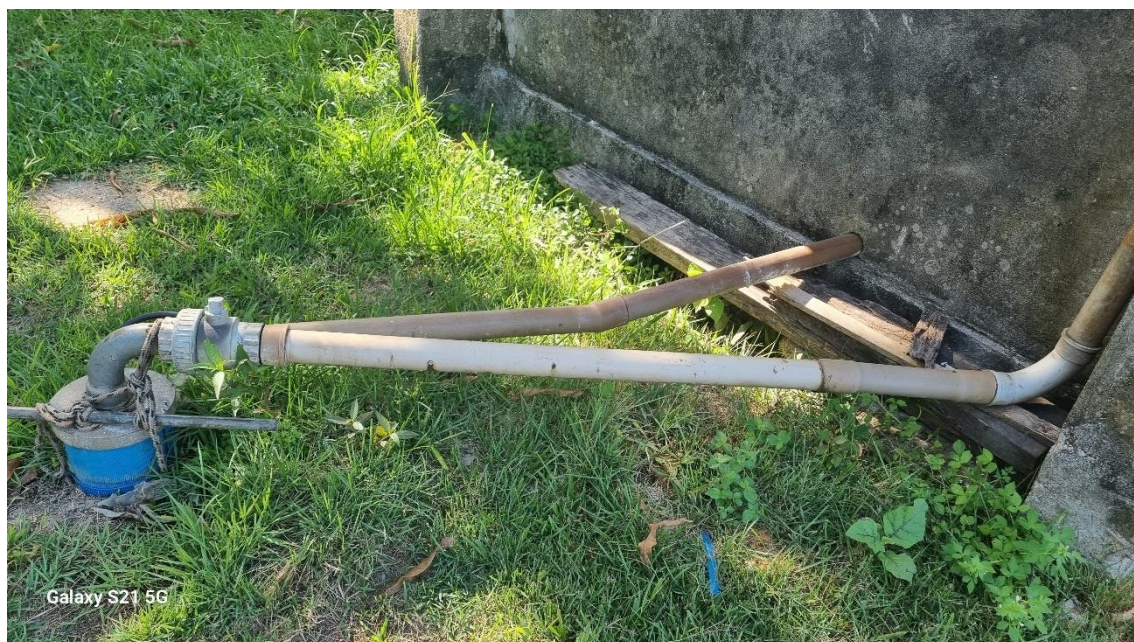
Figura 9. ACA03 - CAPTAÇÃO 01 (poço subterrâneo).
