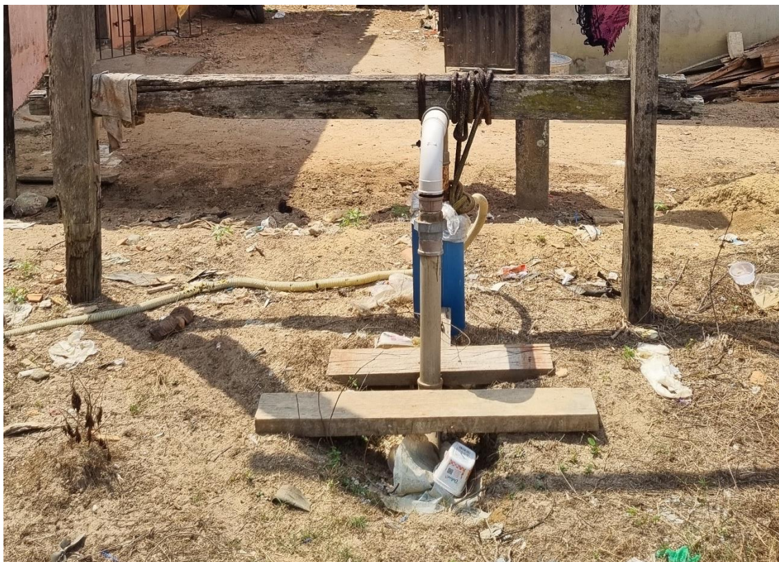
Figura 27. ACA13 - CAPTAÇÃO 01 (poço subterrâneo).
