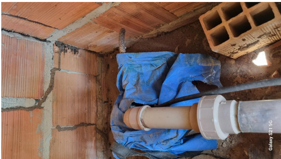
Figura 31. ACA14 - CAPTAÇÃO 01 (poço subterrâneo). Fonte: Consórcio, 2023.
