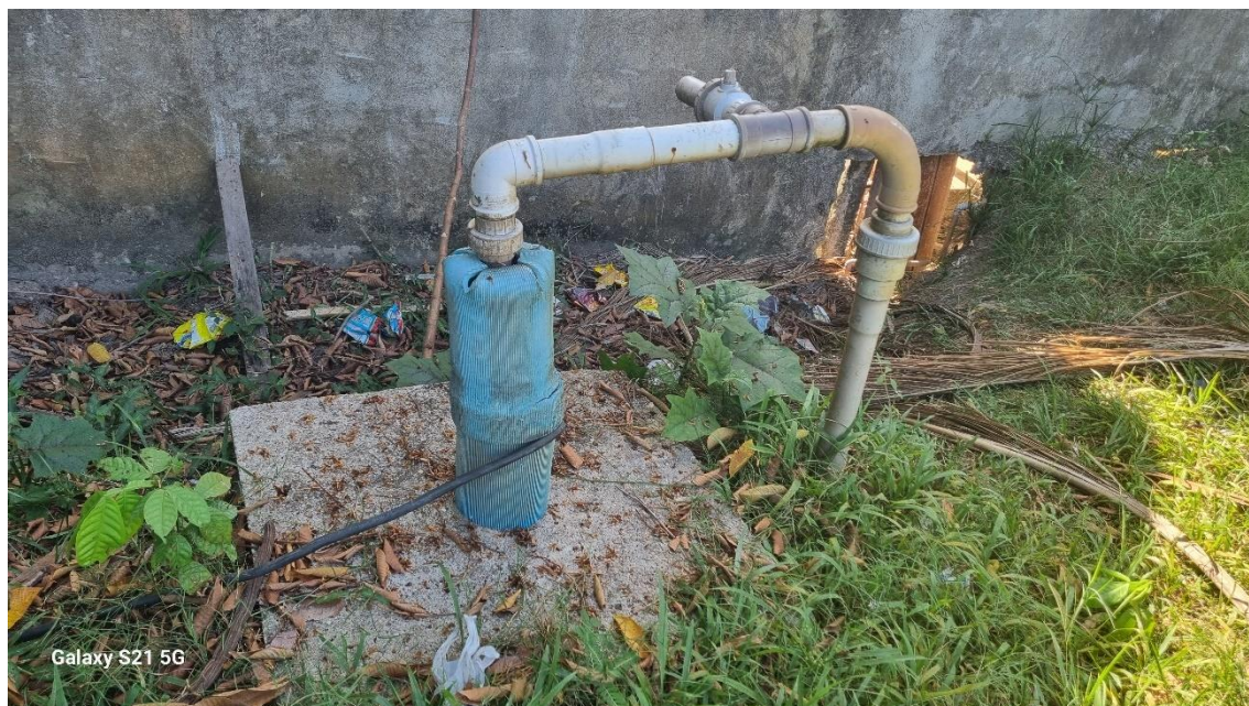
Figura 6. ACA02 - CAPTAÇÃO 01 (poço subterrâneo). Fonte: Consórcio, 2023.
