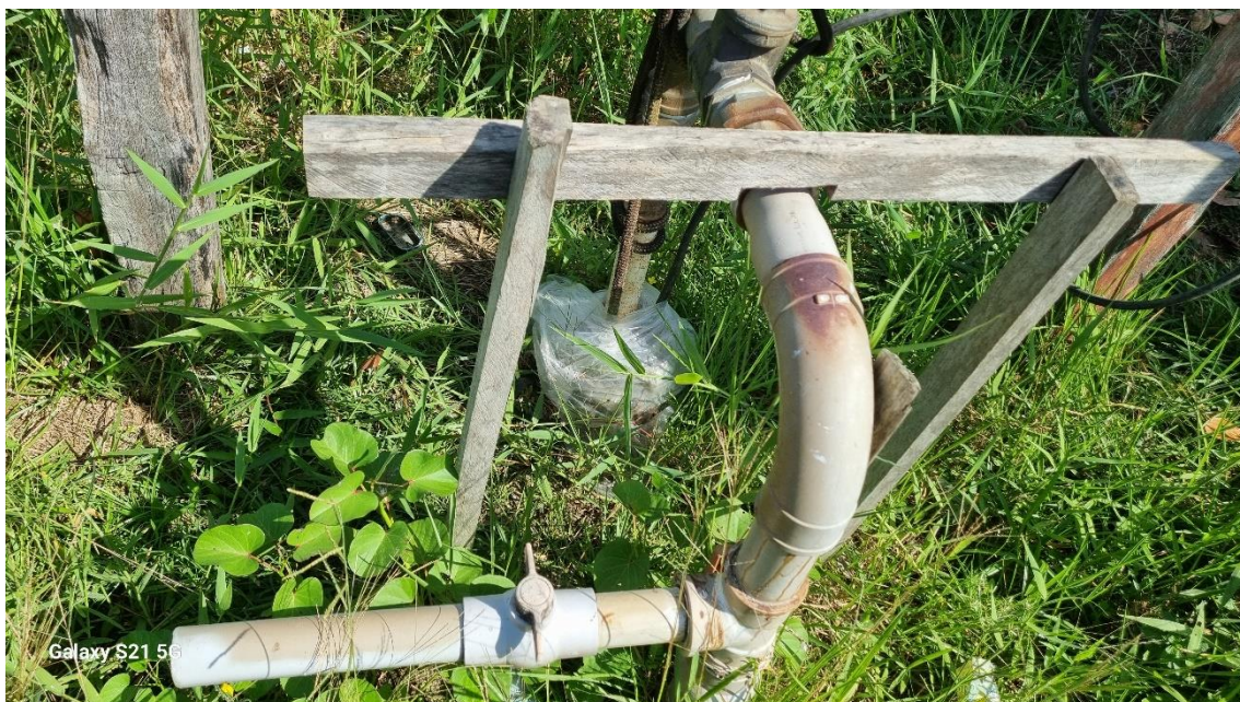
Figura 11. ACA4 - CAPTAÇÃO 01 (poço subterrâneo).
