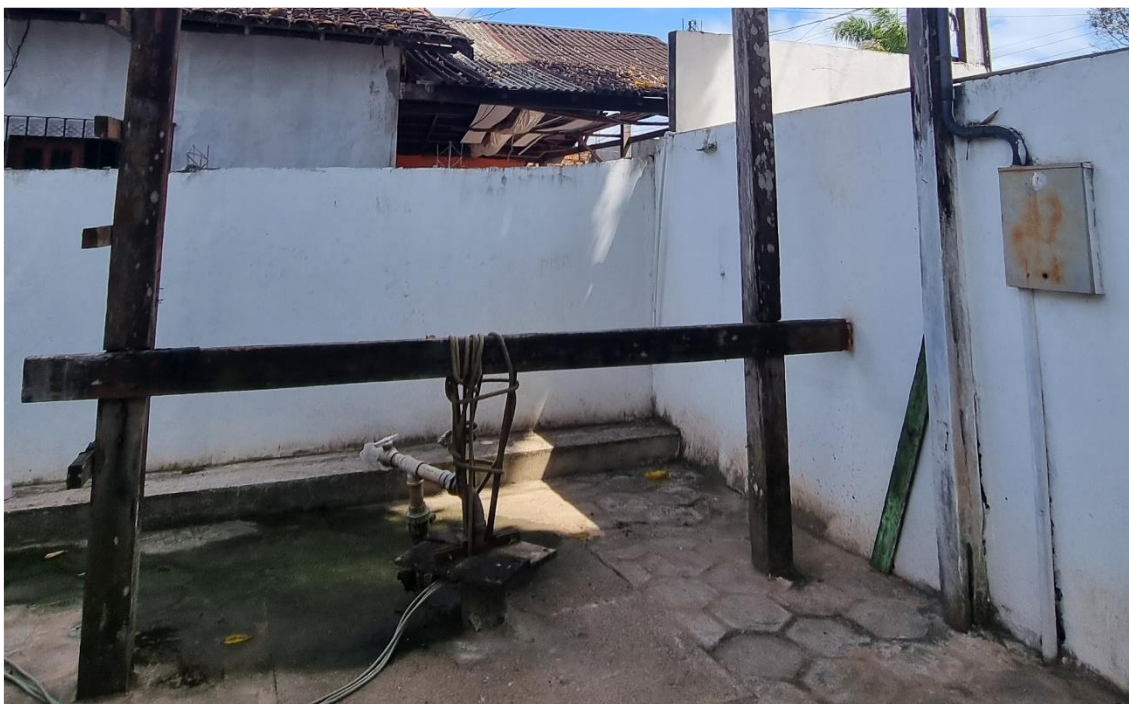
Figura 18. ACA8 - CAPTAÇÃO 02 (poço subterrâneo).
