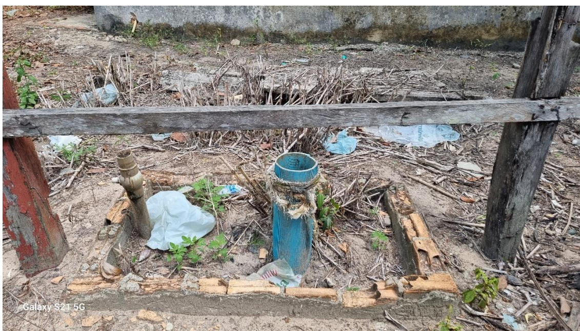
Figura 28. ACA13 - CAPTAÇÃO 02 (poço subterrâneo).
