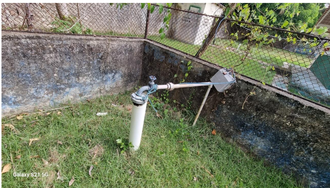
Figura 34. ACA15 - CAPTAÇÃO 02 (poço subterrâneo). Fonte: Consórcio, 2023.
