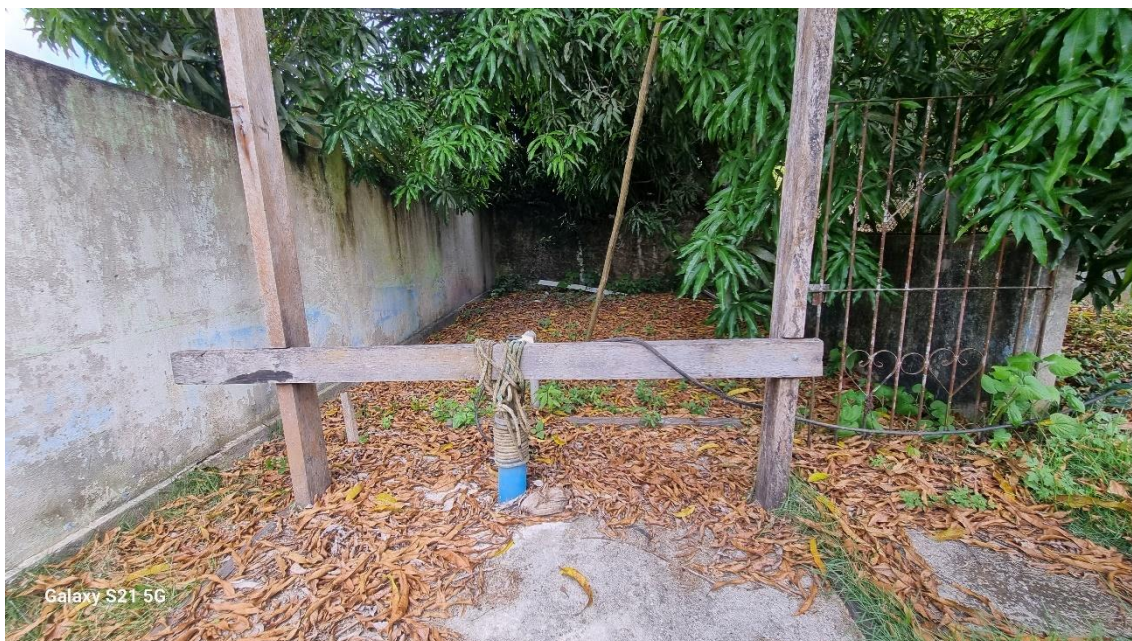
Figura 33. ACA15 - CAPTAÇÃO 01 (poço subterrâneo). Fonte: Consórcio, 2023.
