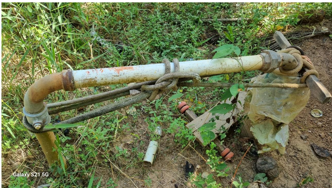
Figura 13. ACA5 - CAPTAÇÃO 01 (poço subterrâneo).
