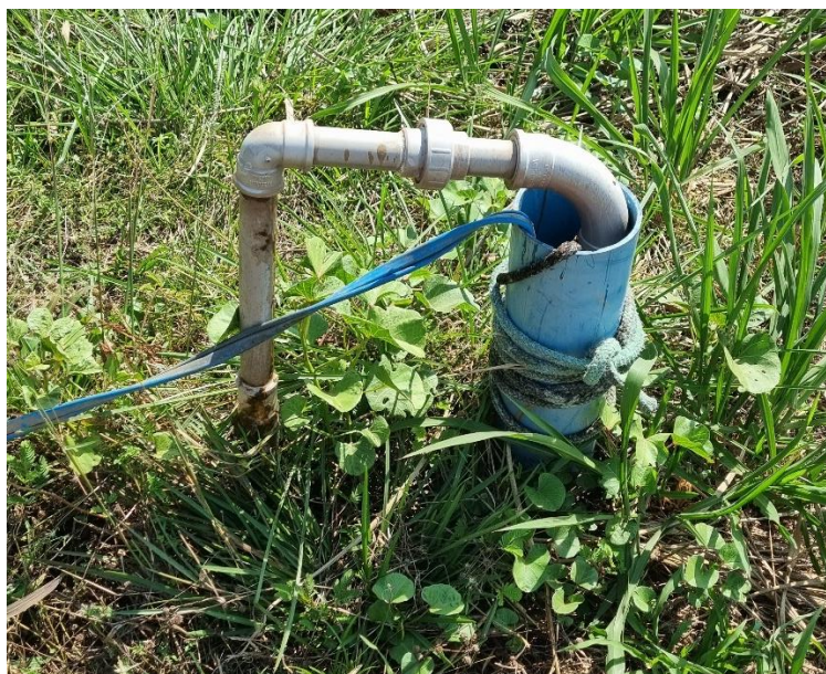
Figura 37. ACA17 - CAPTAÇÃO 01 (poço subterrâneo).
