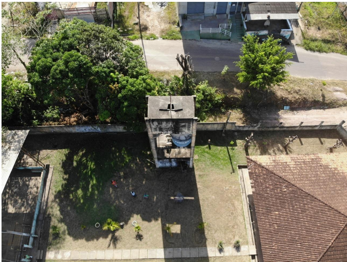
Figura 10. ACA03-CAPTAÇÃO, poço subterrâneo ( panorâmica).
