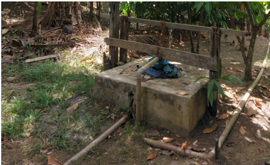
Figura 22. ACA11 - CAPTAÇÃO 01 (poço subterrâneo).
