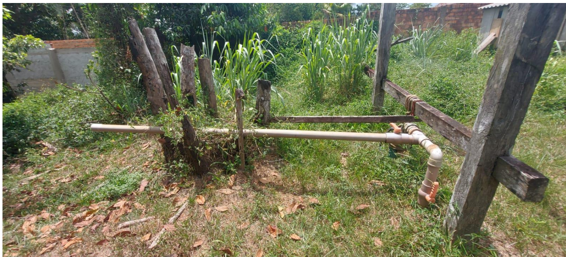
Figura 24. ACA12 - CAPTAÇÃO 02 (poço subterrâneo).
