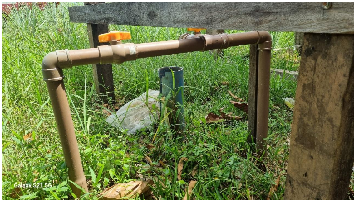
Figura 21. ACA10 - CAPTAÇÃO 01 (poço subterrâneo).
