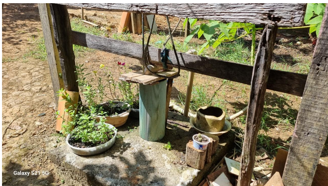
Figura 15. ACA7 - CAPTAÇÃO 01 (poço subterrâneo).
