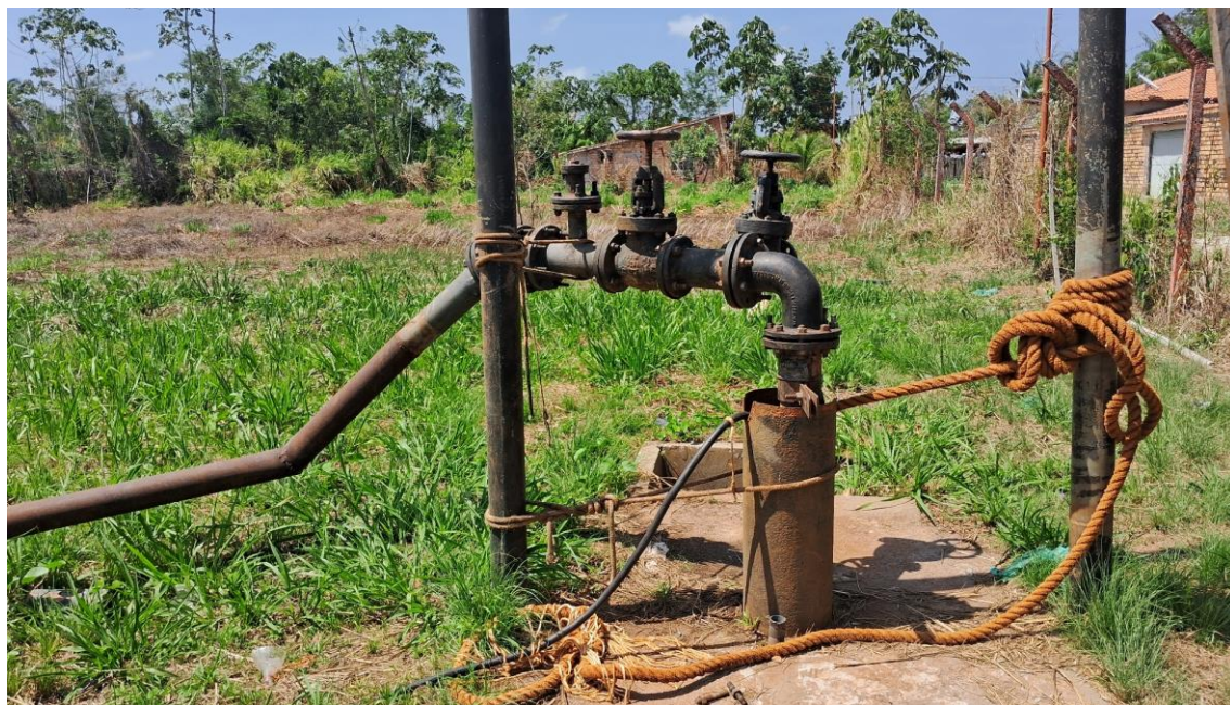
Figura 8. Poço de BAI04 (Aproximado).
