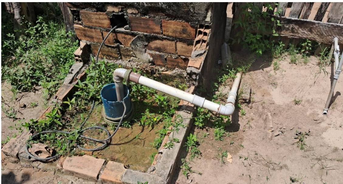
Figura 12. Poço de BAI07 (Aproximado).
