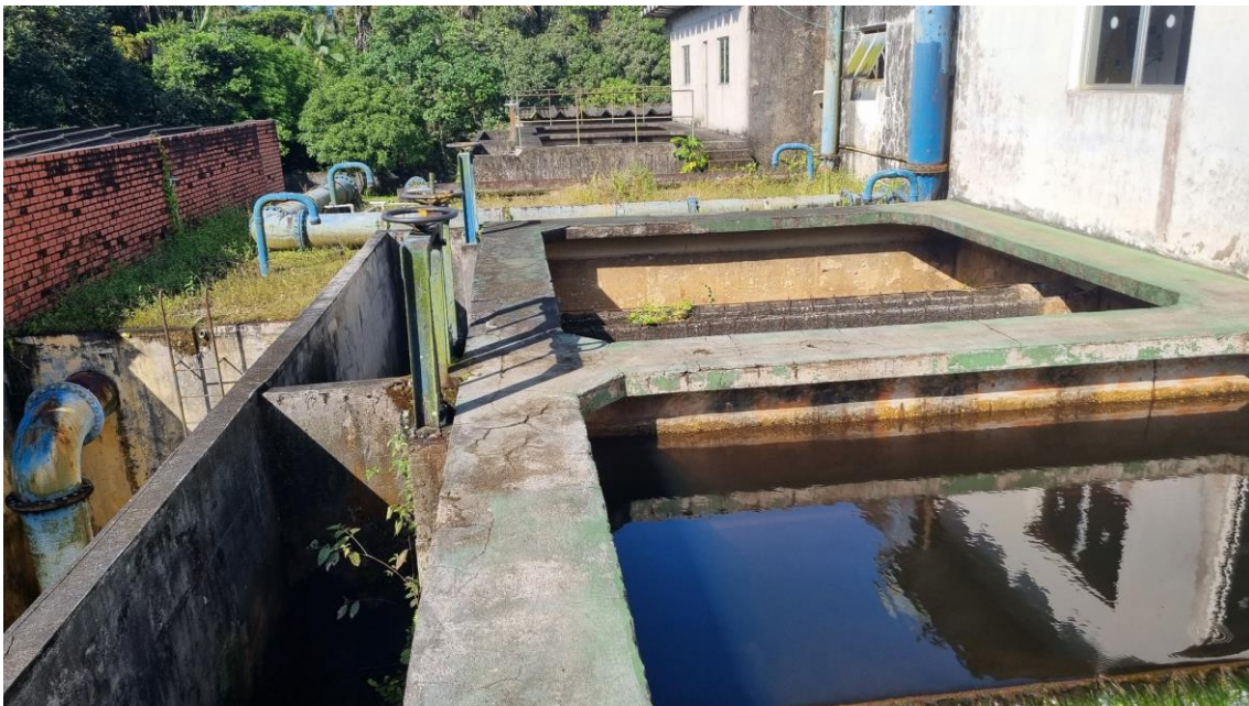
Figura 7. BRA01-ETA, Estação de Tratamento de Água (floculador). Fonte: Consórcio, 2023.
