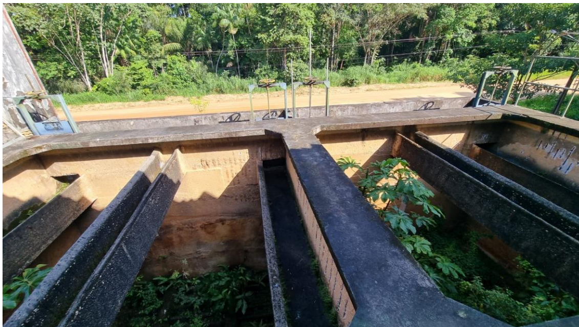
Figura 8. BRA01-ETA, Estação de Tratamento de Água (filtros).
