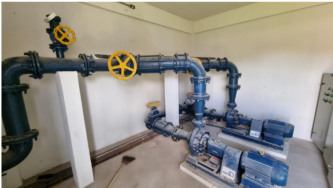
Figura 11. BRA07-BOOSTER, Estação Elevatória de Água Tratada (BOOSTER).
