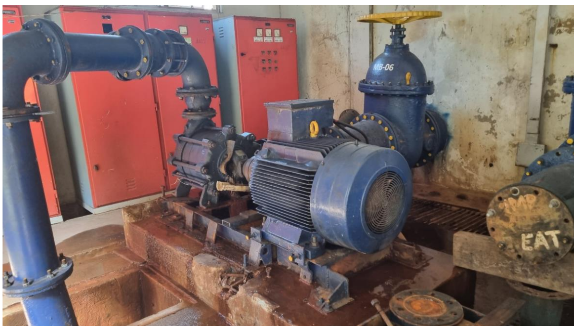
Figura 10. BRA01-EELF, Estação elevatória de Água tratada (lavagem de filtros). Fonte: Consórcio, 2023.
