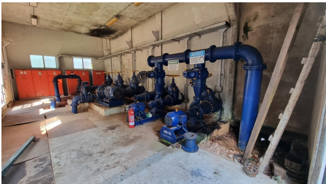
Figura 9. BRA01-EEAT, Estação Elevatória de Água Tratada (conjunto de motobombas). Fonte: Consórcio, 2023.
