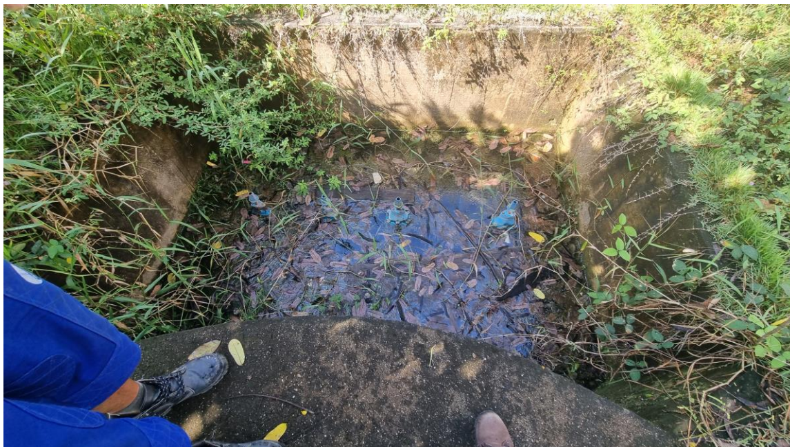
Figura 46. EEE 01, inoperante - Caixa de areia.
