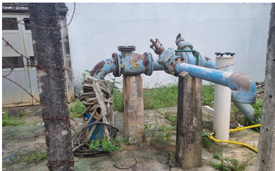
Figura 6. Captação - CAP02, poço tubular (aproximada).
