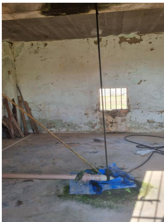
Figura 20. Captação – CAP12, poço tubular (aproximada).
