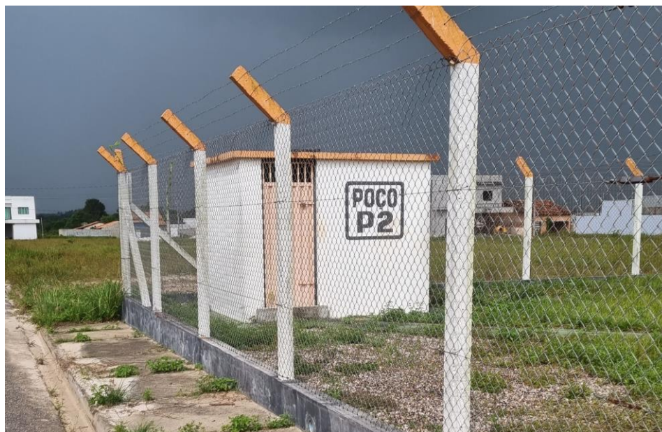
Figura 13. Captação - CAP08, poço tubular P02 (aproximada).
