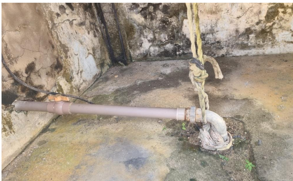
Figura 22. Captação – CAP13, poço tubular (aproximada).
