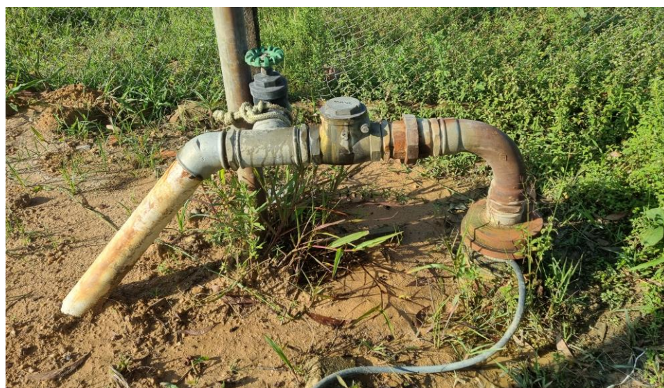
Figura 10. Captação - CAP07, poço tubular (aproximada).
