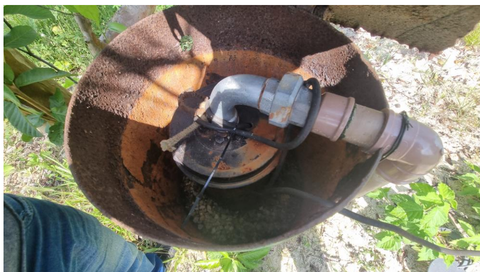
Figura 24. Captação – CAP14, poço tubular (aproximada).
