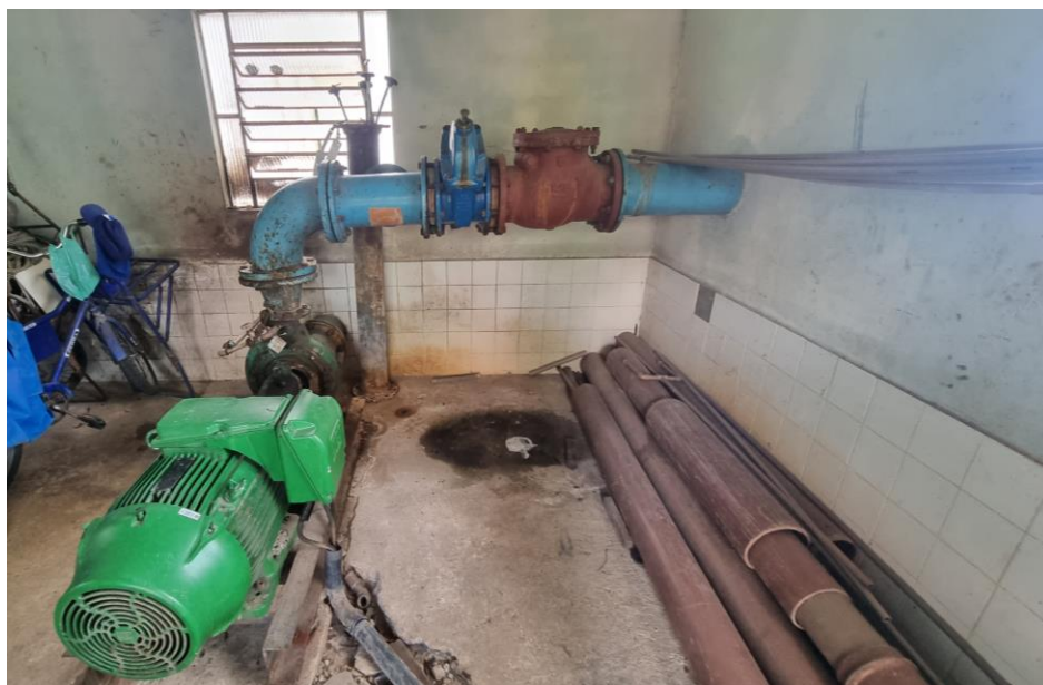
Figura 27. EEAT – CAP01, conjunto de motobombas.
