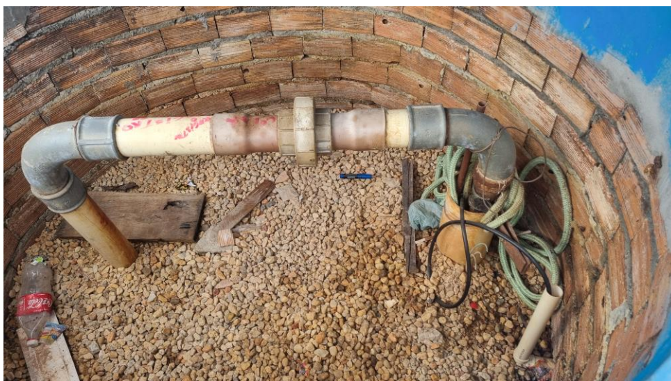
Figura 8. Captação - CAP03, poço tubular (aproximada).
