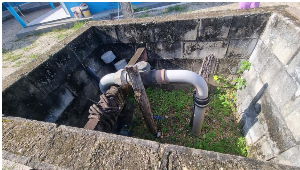
Figura 17. Captação – CAP10, poço tubular (aproximada).
