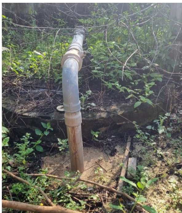
Figura 18. Captação – CAP11, poço tubular.
