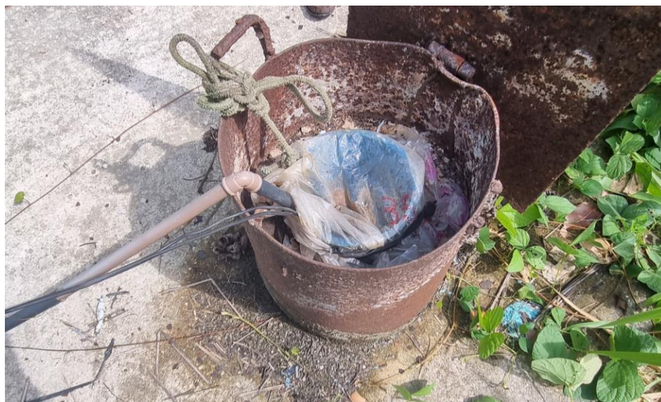
Figura 26. Captação – CAP15, poço tubular (aproximada).
