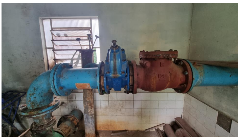
Figura 28. EEAT – CAP01, conjunto de motobombas.
