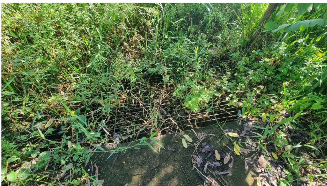
Figura 47. EEE 01, inoperante - Gradeamento.
