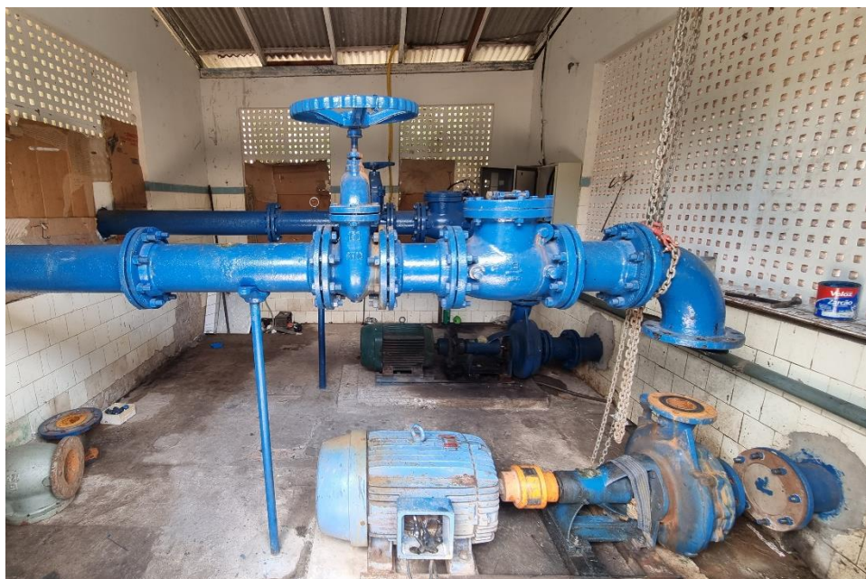
Figura 15. CRC02-EEAB, (Estação Elevatória de Água Bruta).
