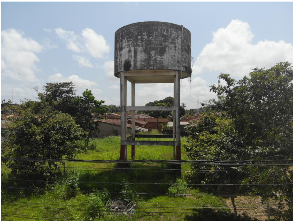
Figura 16. CRC01-REL, (reservatório elevado).
