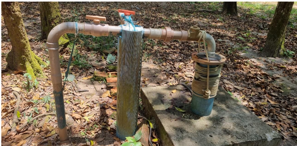
Figura 9. CRC05-CAPTAÇÃO, (poço tubular).
