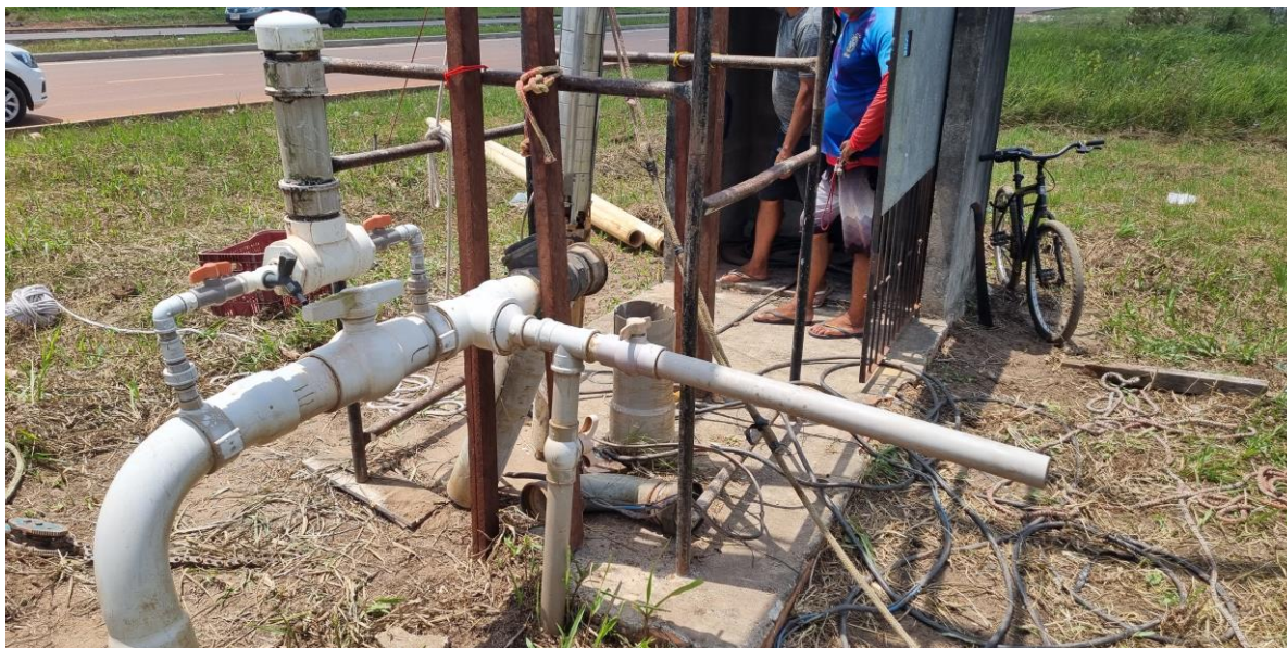
Figura 14. CRC04-TRATQUÍMICO, (dosador de cloro).
