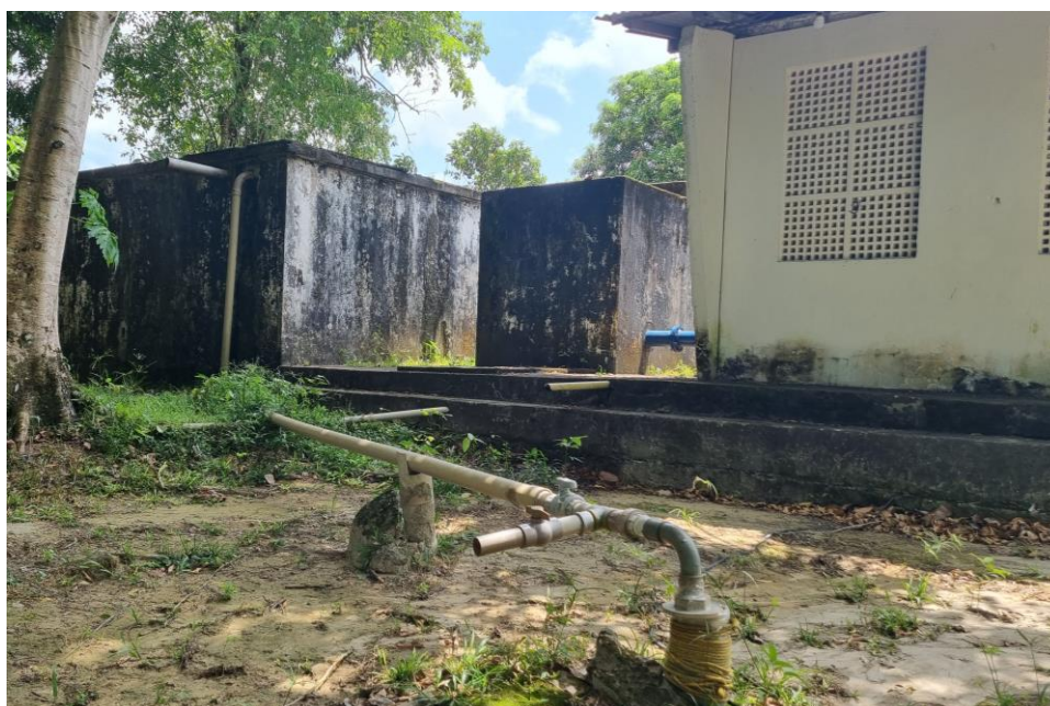
Figura 4. CRC02-CAPTAÇÃO, bateria de poços subterrâneos (poço tubular). Fonte: Consórcio, 2023.
