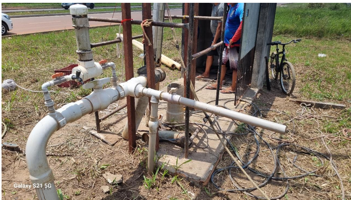
Figura 8. CRC04-CAPTAÇÃO, (poço tubular).
