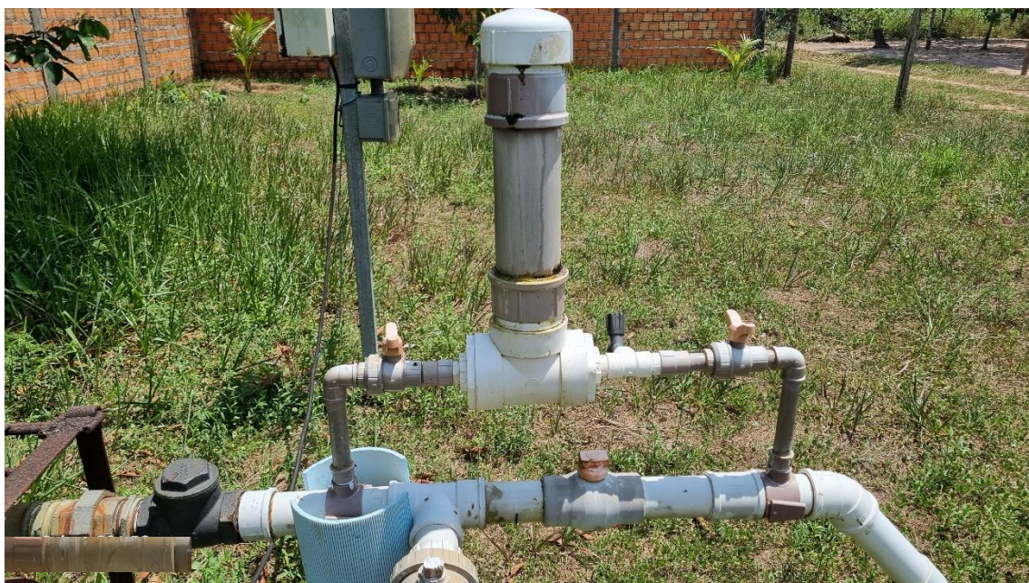
Figura 13. CRC03-TRATAMENTO QUÍMICO, (dosador de cloro).
