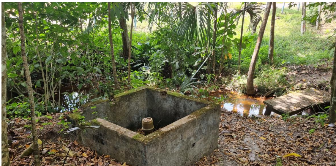
Figura 5. CRC02-CAPTAÇÃO, bateria de poços subterrâneos (poço tubular).
