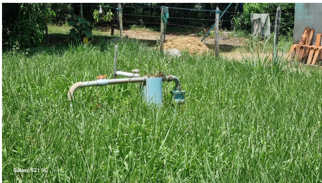
Figura 10. CRC06-CAPTAÇÃO, (poço tubular).
