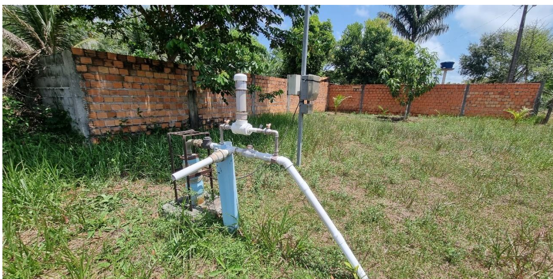
Figura 6. CRC03-CAPTAÇÃO, (poço tubular).
