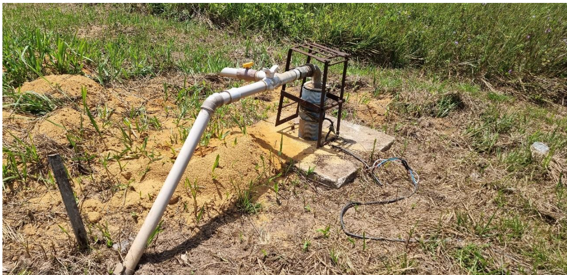
Figura 7. CRC04-CAPTAÇÃO, (poço tubular).
