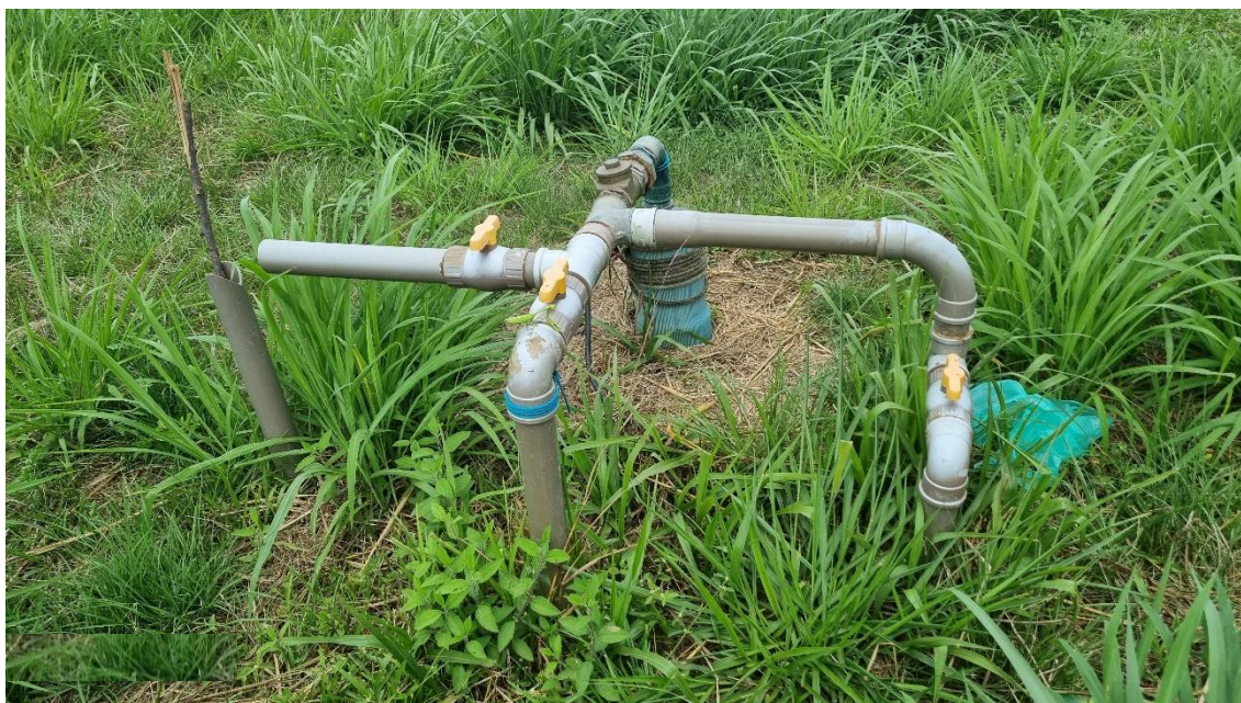
Figura 11. CRC07-CAPTAÇÃO, (poço tubular).
