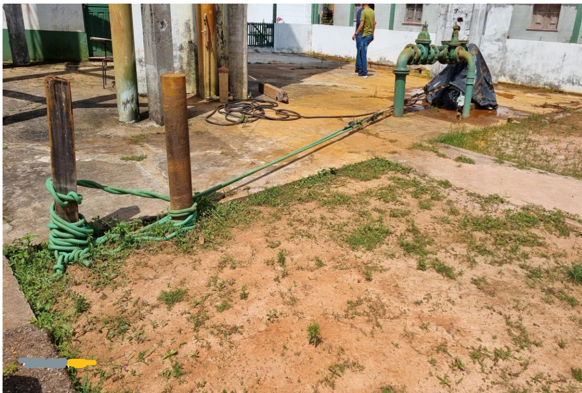
Figura 7. IGA02-CAPTAÇÃO, subterrâneo, (poço tubular).
