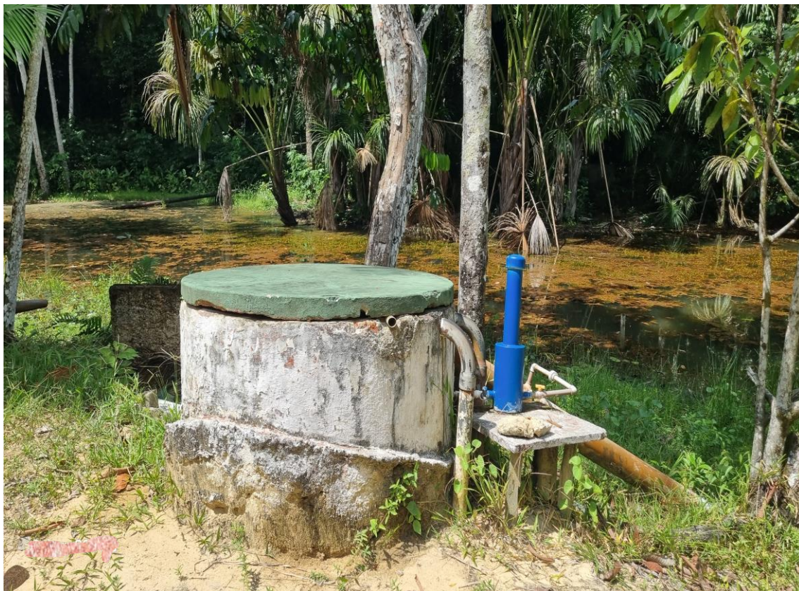
Figura 20. IGA01-RAP01, (reservatório apoiado).
