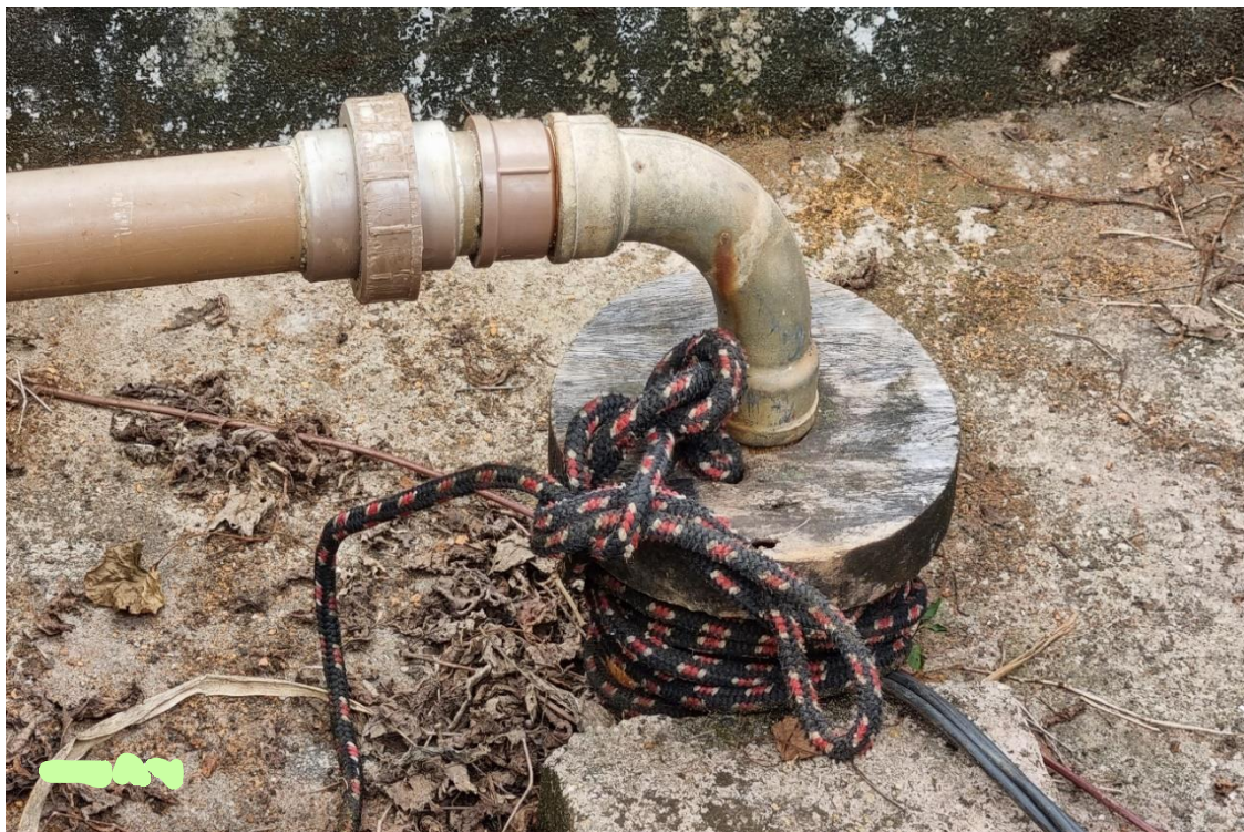
Figura 12 - IGA07-CAPTAÇÃO, subterrâneo (poço tubular).
