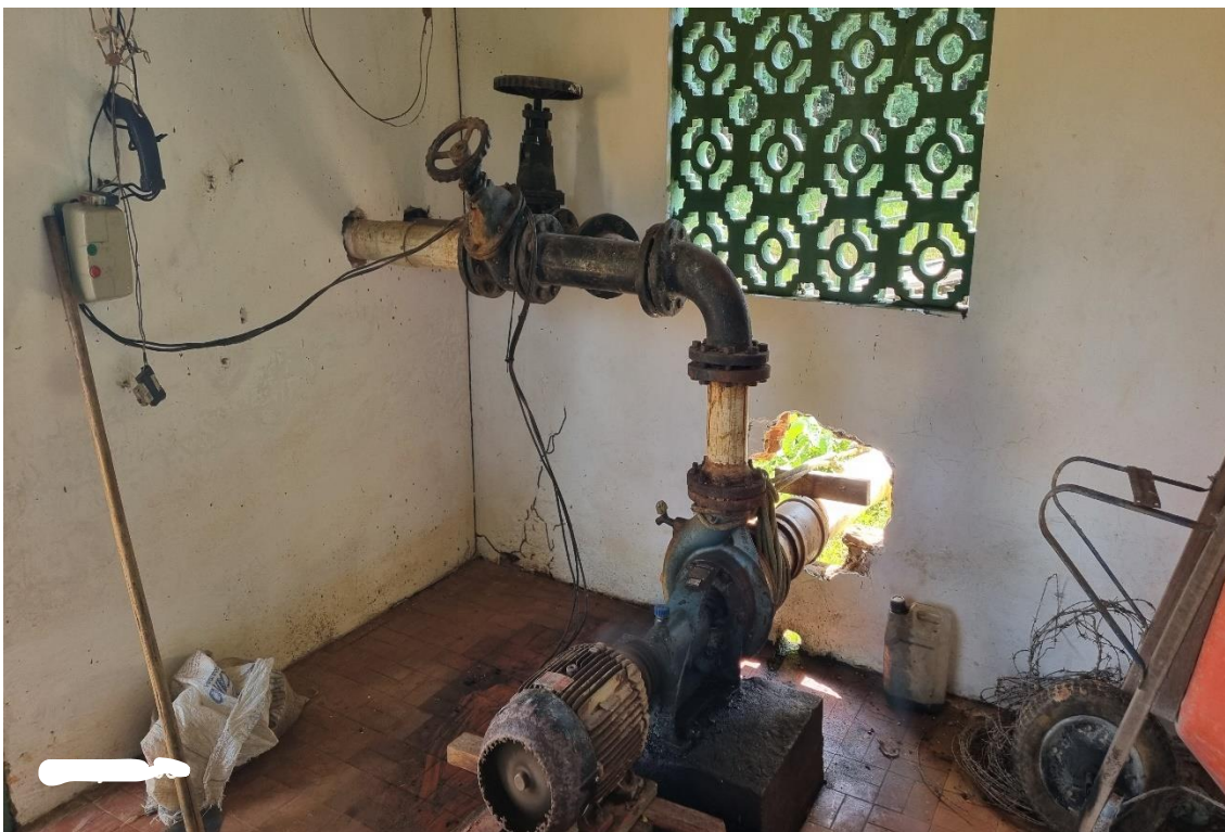
Figura 5. IGA01-CAPTAÇÃO001, subterrâneo (sistema a vácuo).
