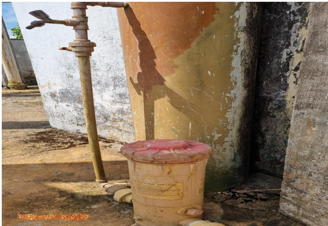
Figura 17. IGA02-TRATQUÍMICO, (dosador de cloro).
