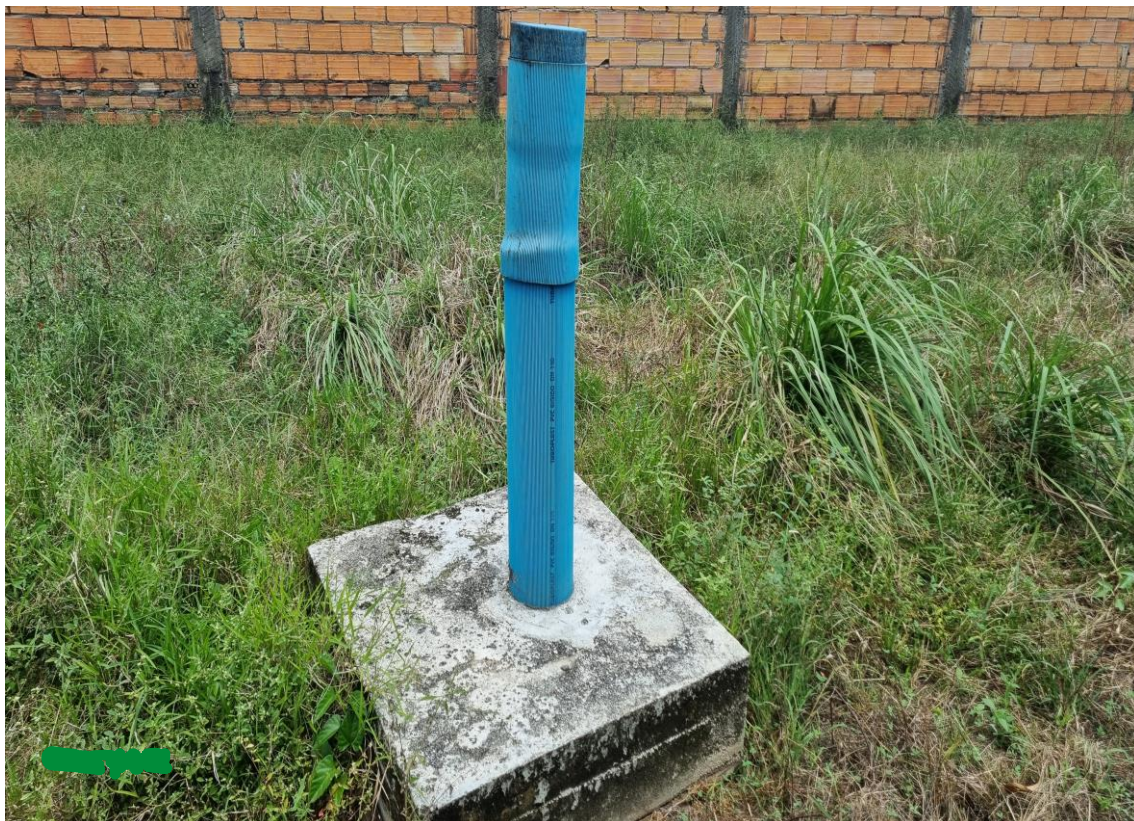
Figura 10. IGA05-CAPTAÇÃO, subterrâneo (poço tubular).
