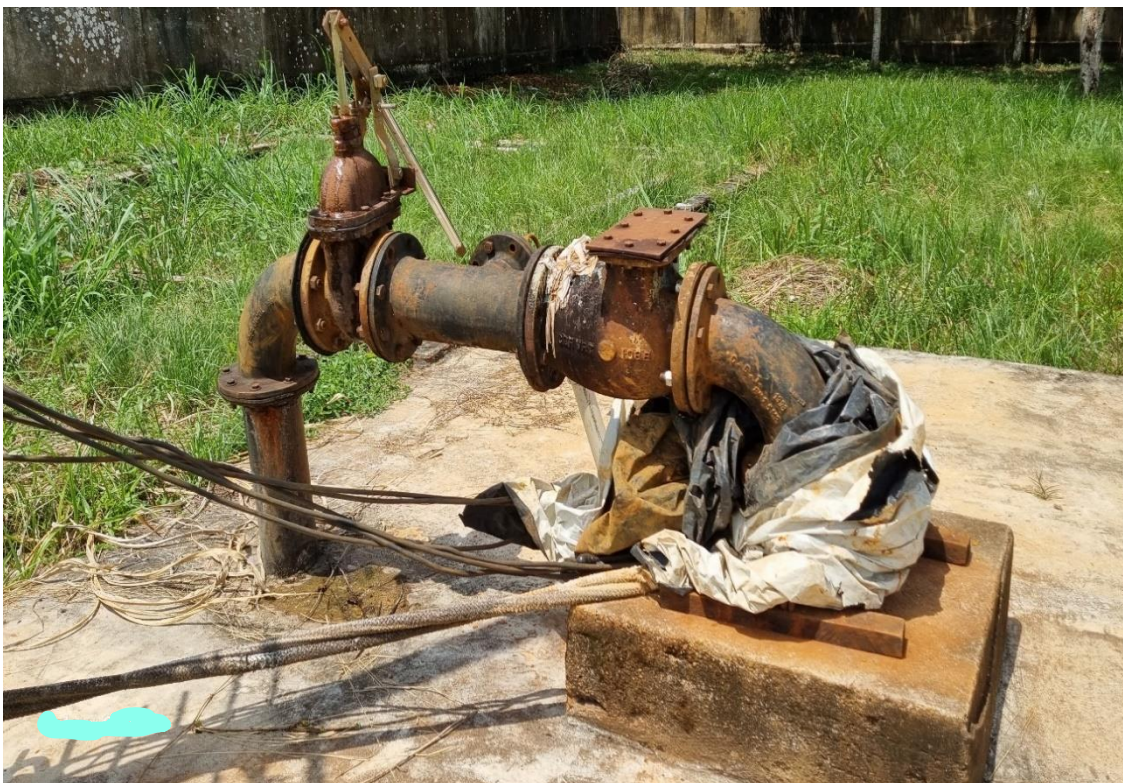
Figura 13. IGA08-CAPTAÇÃO, subterrâneo (poço tubular).
