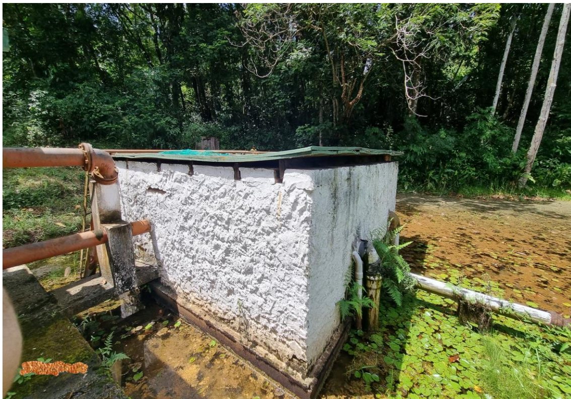
Figura 21. IGA01-RAP02, (reservatório apoiado).
