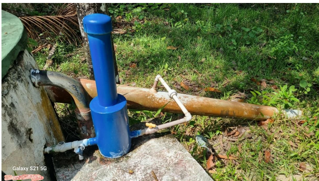
Figura 16. IGA01-TRATQUÍMICO, (dosador de cloro).
