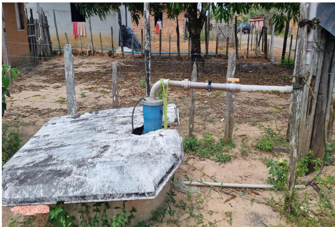
Figura 18. IGA03-TRATQUÍMICO, (dosador de cloro).
