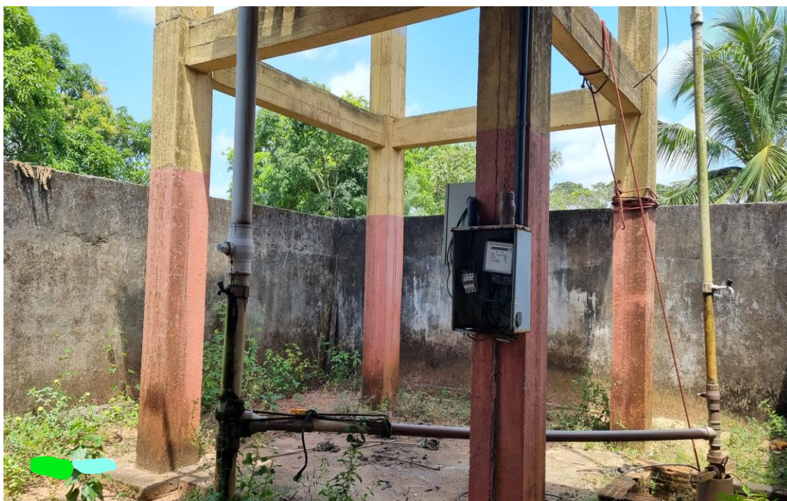
Figura 9. IGA04-CAPTAÇÃO, subterrâneo (poço tubular).
