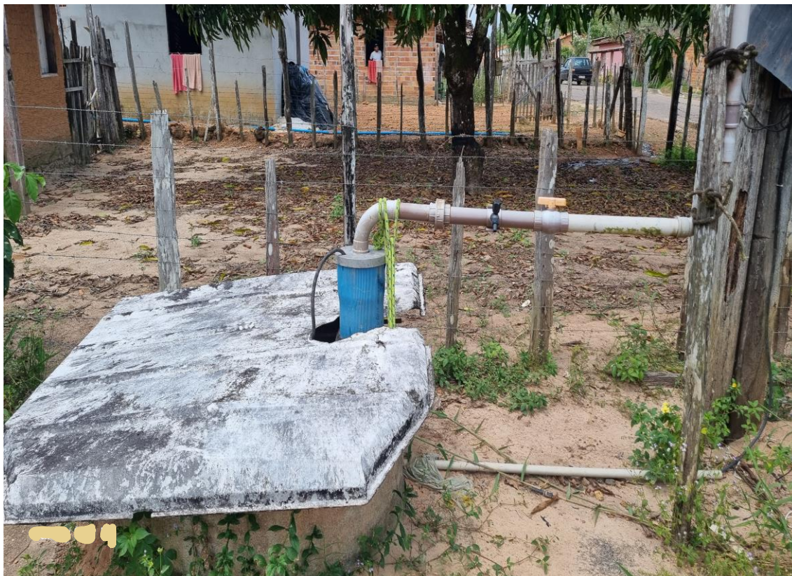
Figura 8. IGA03-CAPTAÇÃO, subterrâneo (poço tubular).
