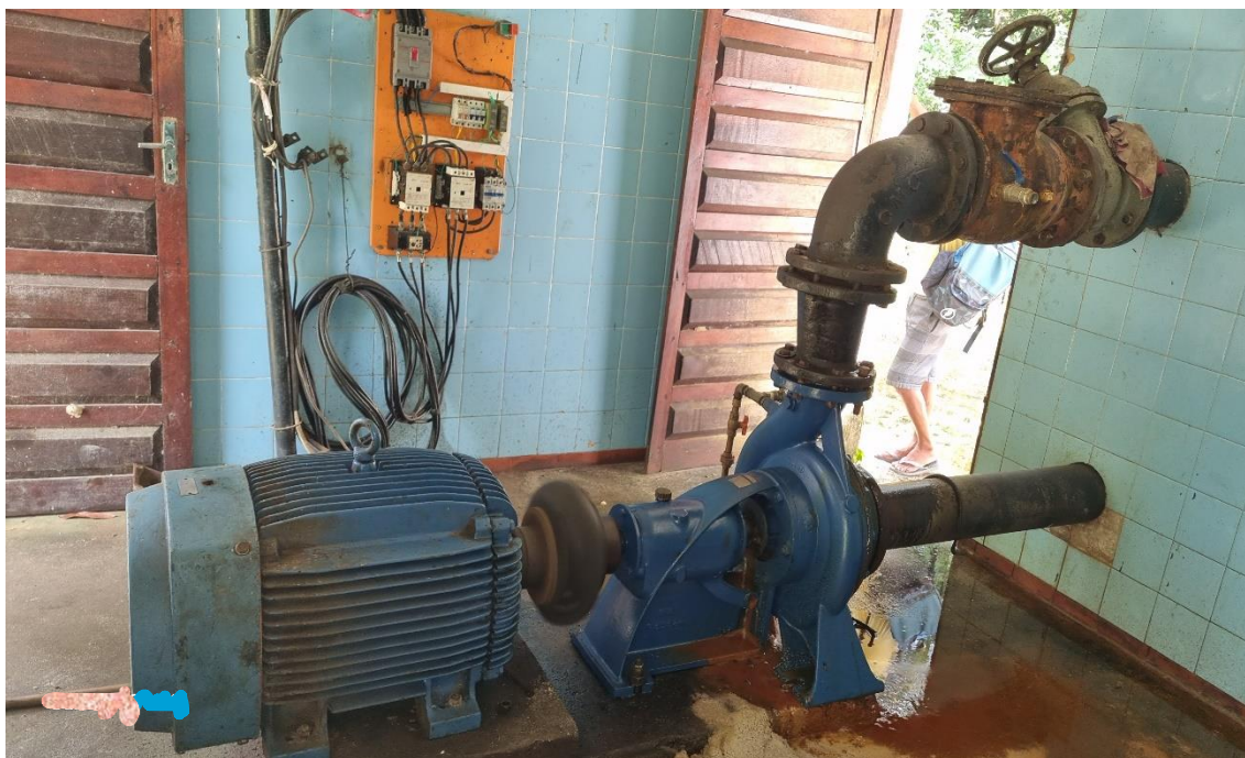
Figura 19. IGA01-EEAT, Estação Elevatória de Água Tratada (conjunto motobomba).
