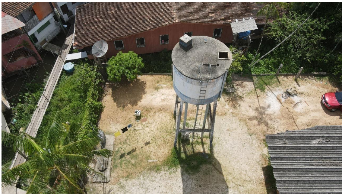
Figura 9. IGA01-REL, reservatório elevado, localizado na Vila Maiauatá. Fonte: Consórcio, 2023.
