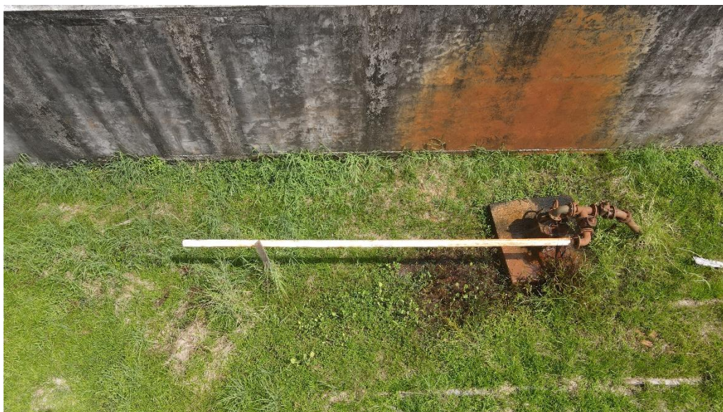
Figura 4. IGA01-CAPTAÇÃO, poço subterrâneo (aproximada).
