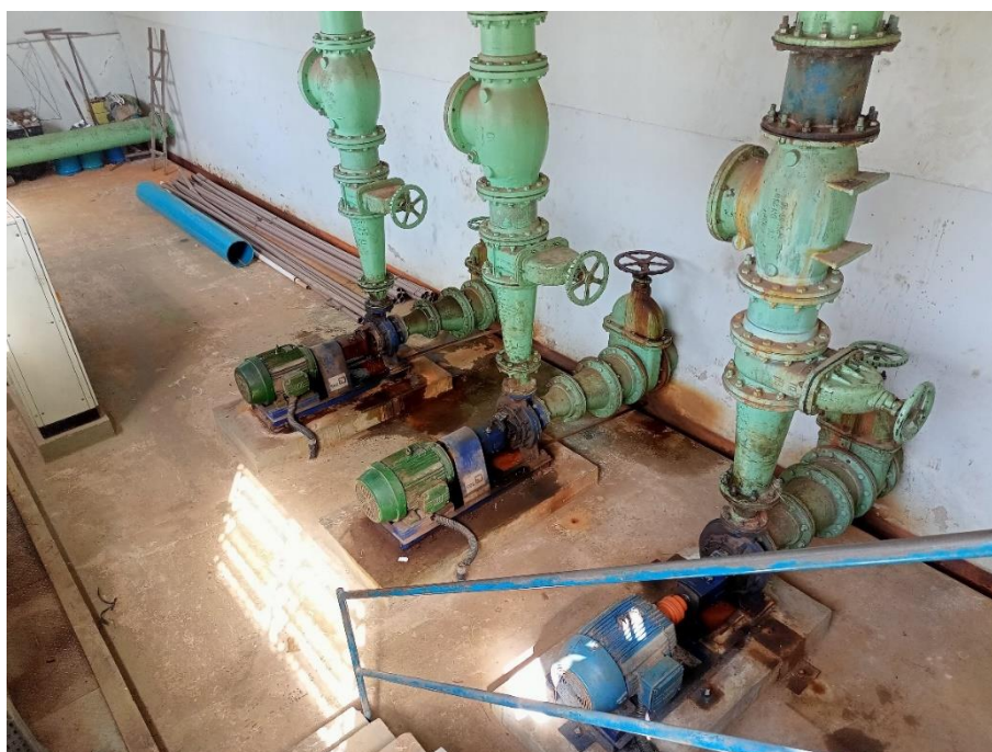
Figura 8. IGA02-EEAT, conjunto de motobombas.
