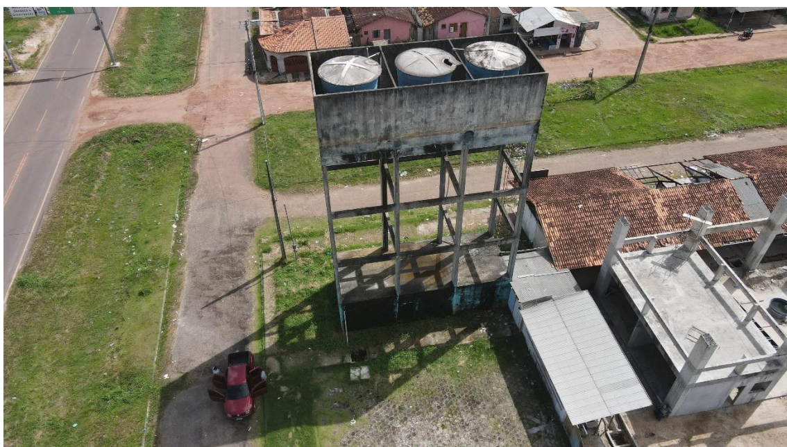
Figura 12. IGA04-REL, reservatório elevado, operado pela prefeitura e responsável pelo abastecimento do Conj. Açaila I. Fonte: Consórcio, 2023.
