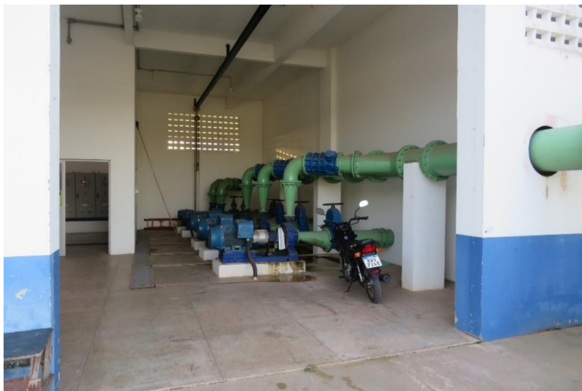
Figura 13. EEAT- MOJ02, Conjunto de motobombas.
