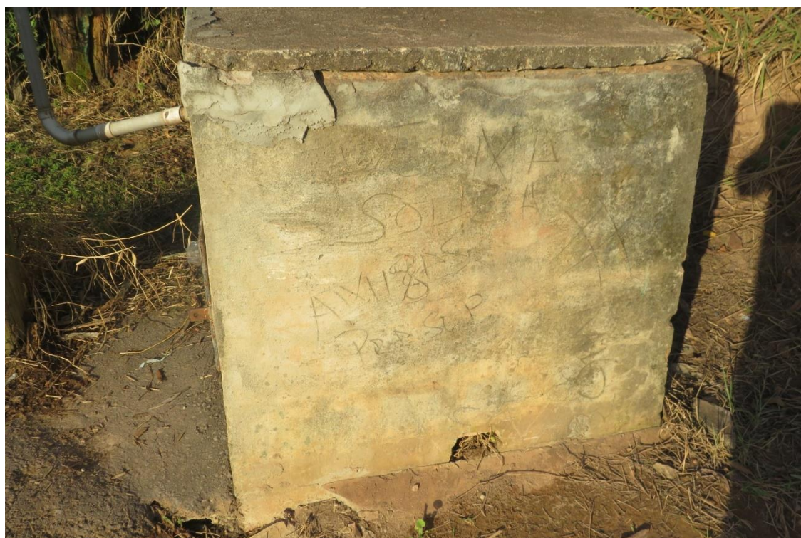
Figura 8. Captação-MOJ14, Poço tubular.
