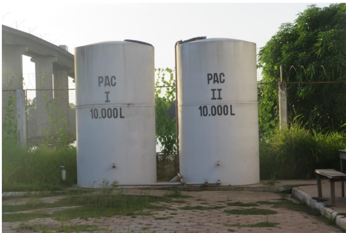
Figura 11. ETA-MOJ02- Tratamento Químico PAC.
