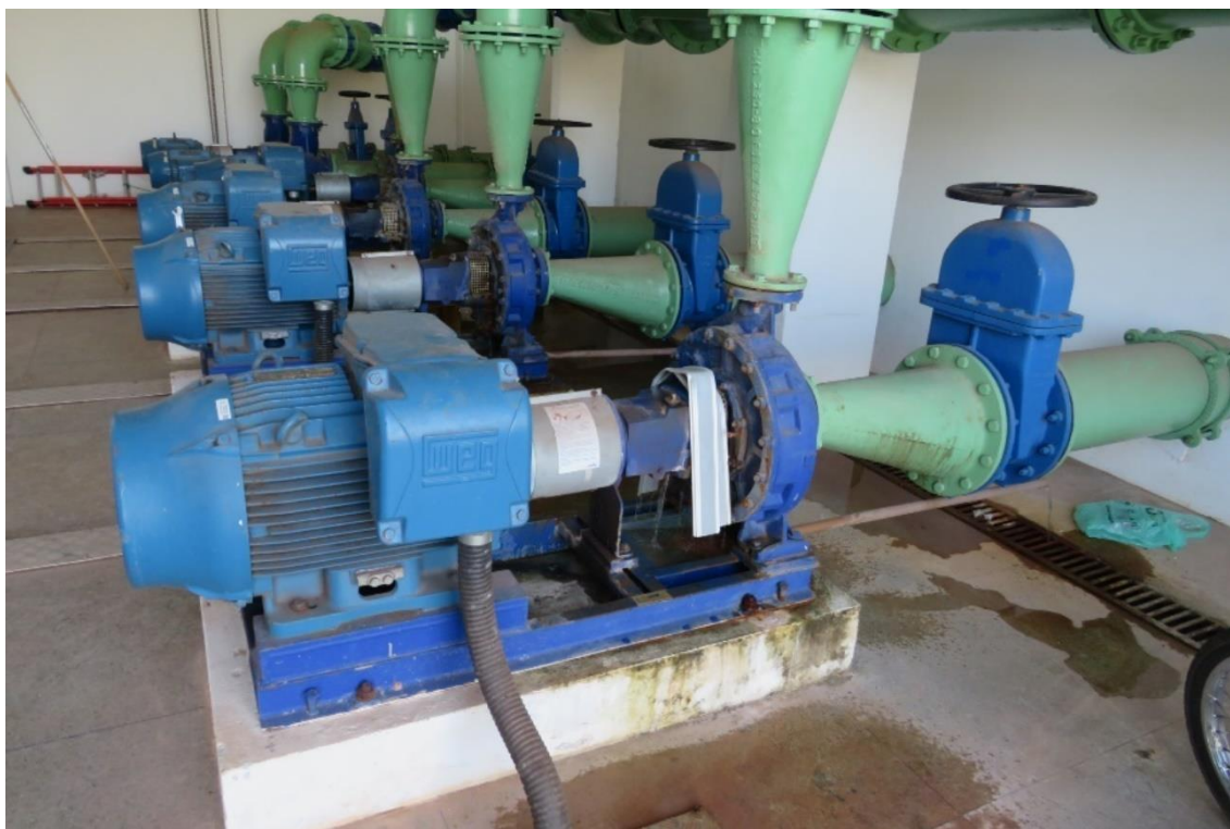
Figura 14. EEAT- MOJ02, estrutura.
