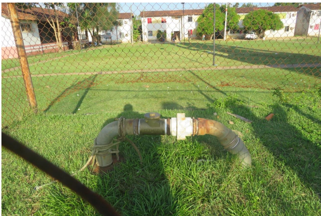
Figura 4. Captação-MOJ06, Poço tubular.
