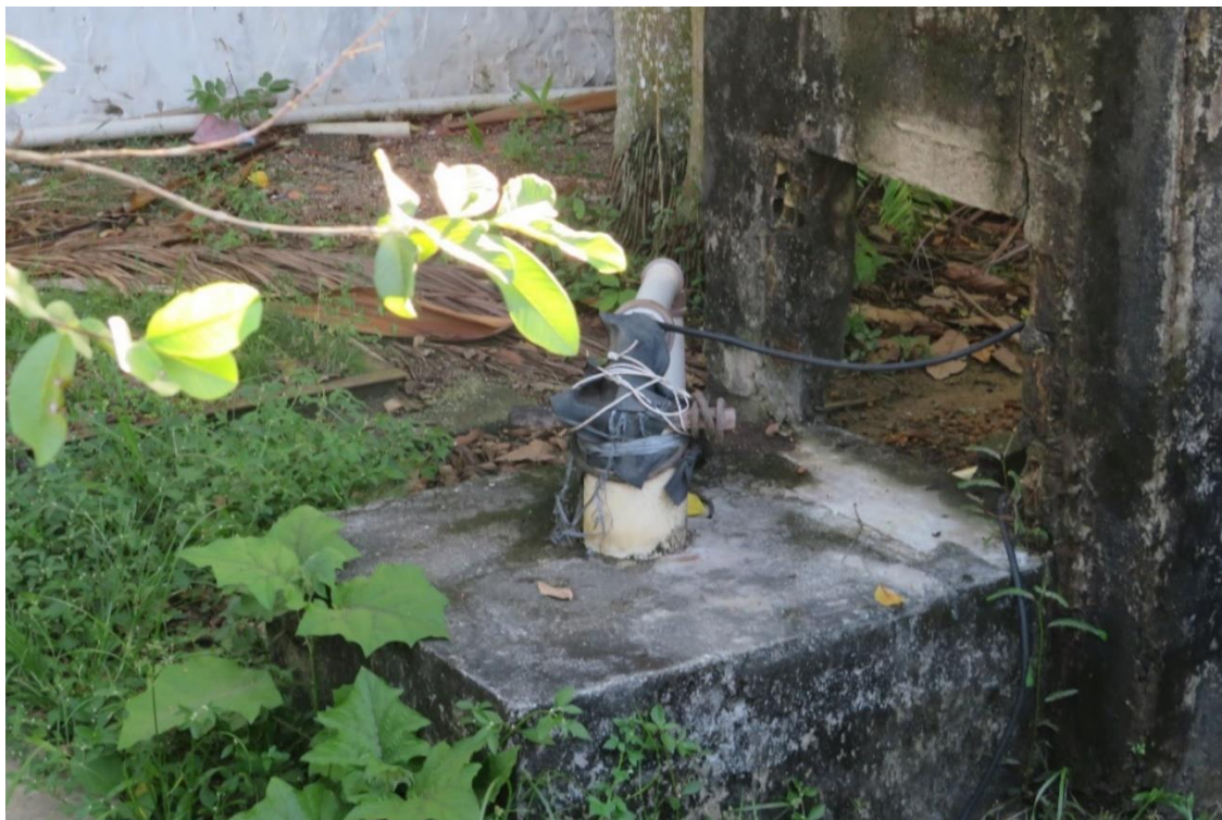
Figura 7. Captação-MOJ13, Poço tubular.
