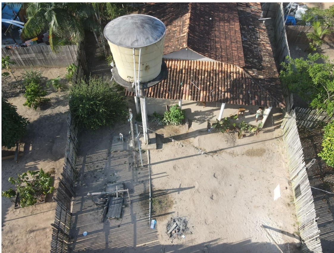
Figura 6. Captação-MOJ10, Poço tubular vista aérea. Fonte: Consórcio, 2023.
