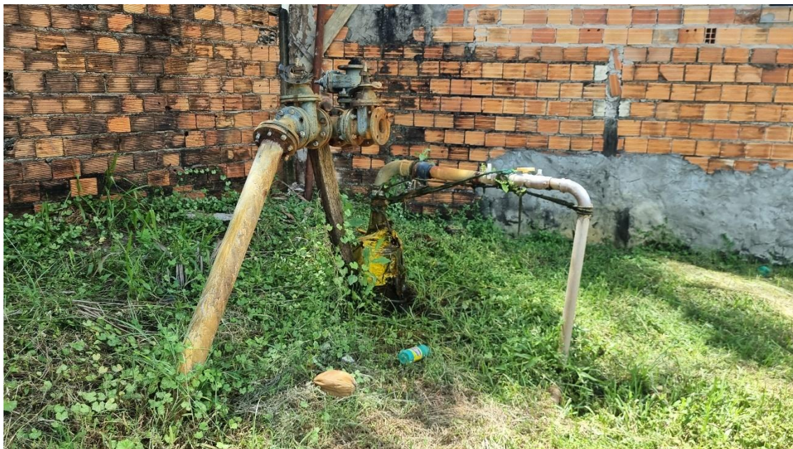
Figura 29. SAL019-CAPTAÇÃO001, poço tubular. Fonte: Consórcio, 2023.
