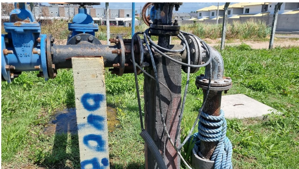
Figura 26. SAL017-CAPTAÇÃO001, poço tubular. Fonte: Consórcio, 2023.
