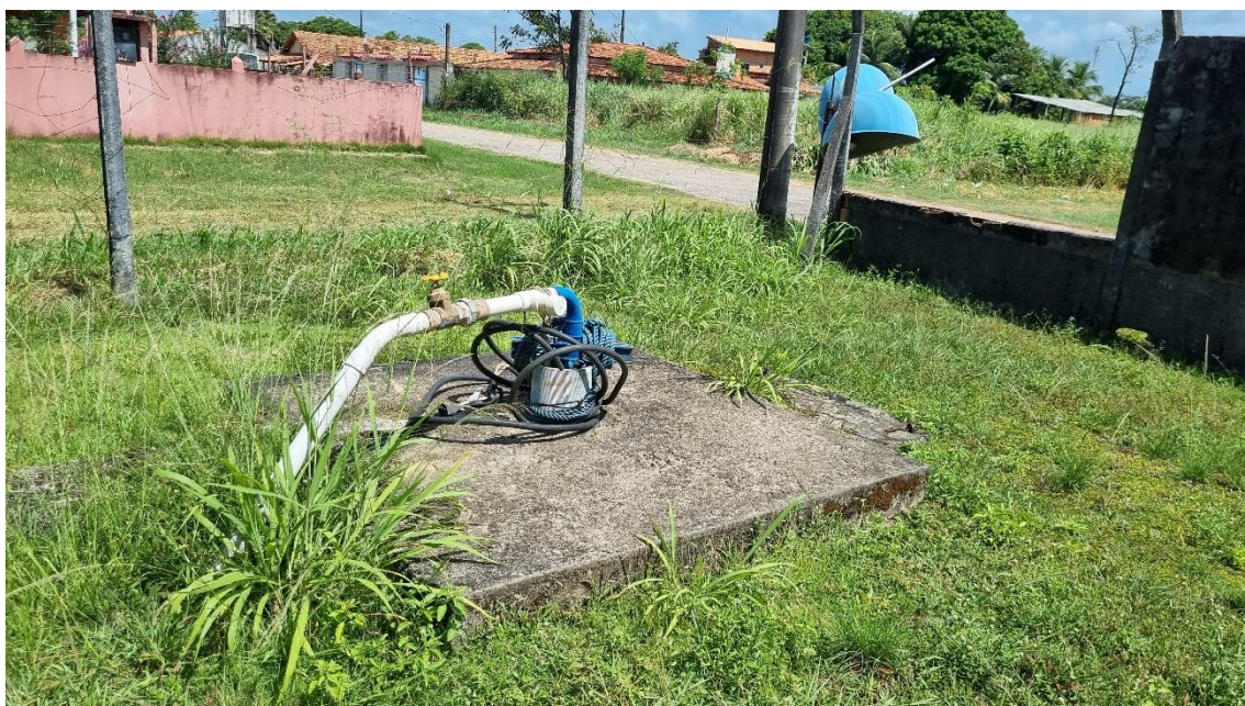
Figura 16. SAL08-CAPTAÇÃO002, poço tubular. Fonte: Consórcio, 2023.
