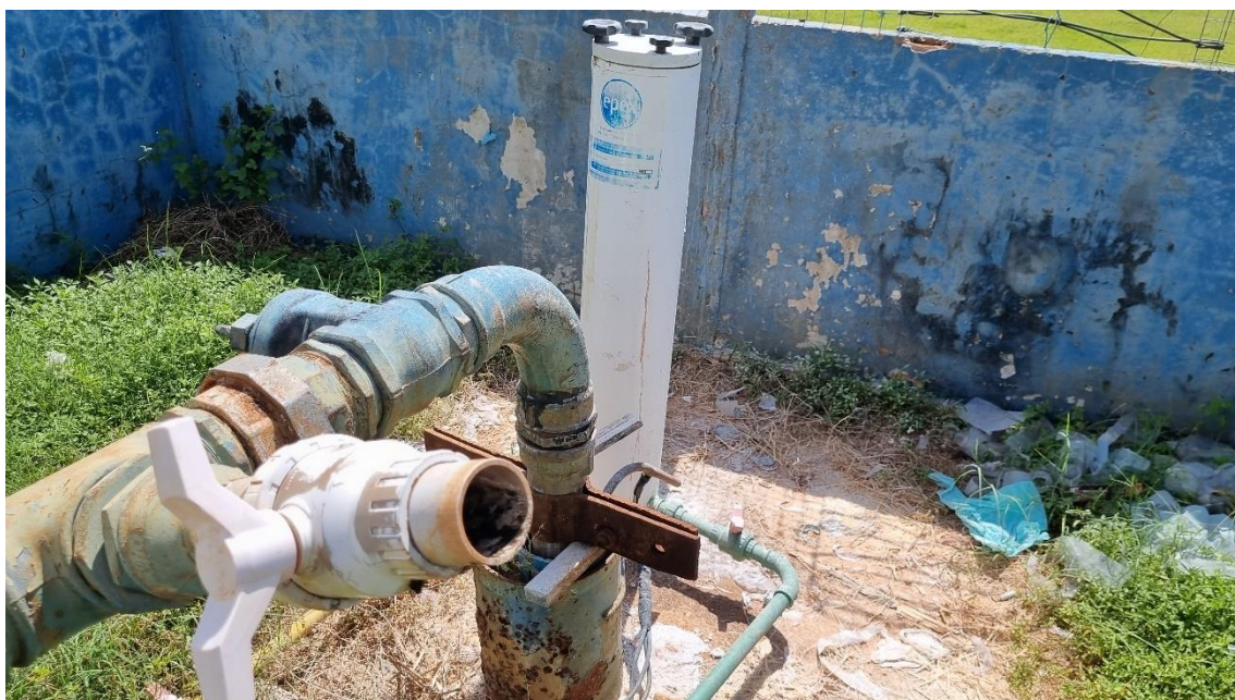
Figura 39. SAL12-TRATAMENTO01, Tratamento de desinfecção (cloro pastilha). Fonte: Consórcio, 2023.
