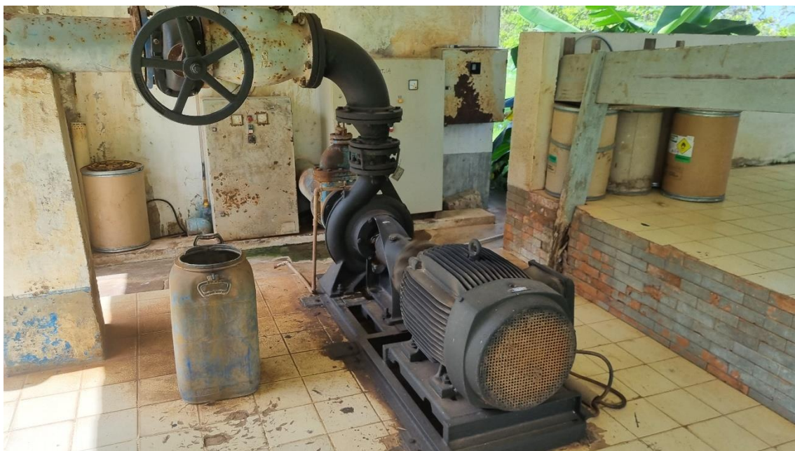
Figura 43. SAL01-EEAT, Estação Elevatória de Água Tratada. Fonte: Consórcio, 2023.
