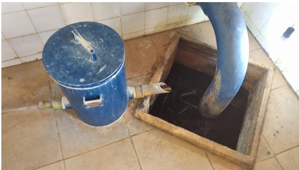
Figura 34. SAL04-TRATAMENTO, Tratamento de desinfecção (cloro pastilha). Fonte: Consórcio, 2023.
