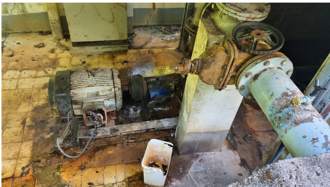
Figura 46. SAL05-EEAT, Estação Elevatória de Água Tratada. Fonte: Consórcio, 2023.
