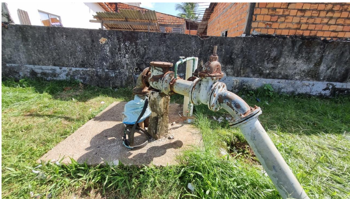
Figura 25. SAL016-CAPTAÇÃO, poço tubular. Fonte: Consórcio, 2023.
