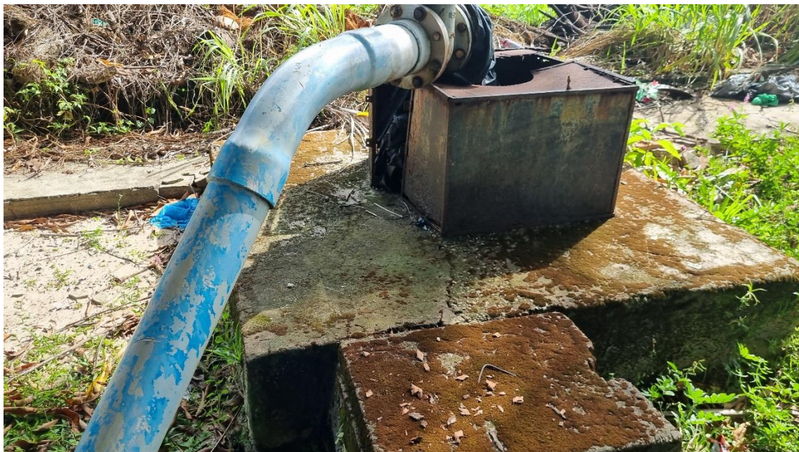
Figura 11. SAL05-CAPTAÇÃO001, poço tubular. Fonte: Consórcio, 2023.
