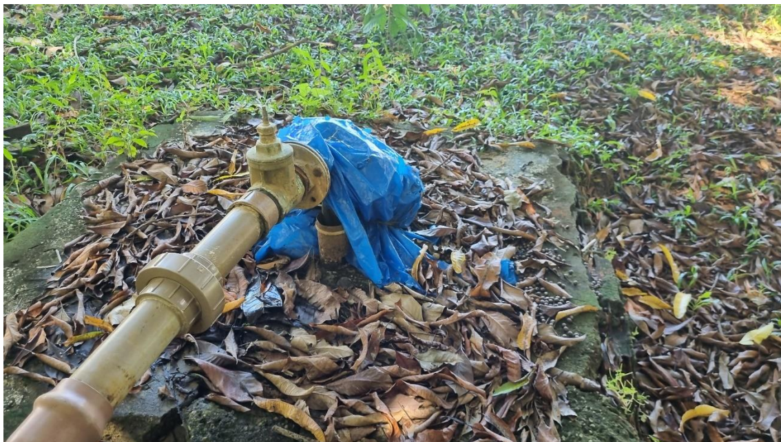
Figura 7. SAL03-CAPTAÇÃO002, poço tubular. Fonte: Consórcio, 2023.
