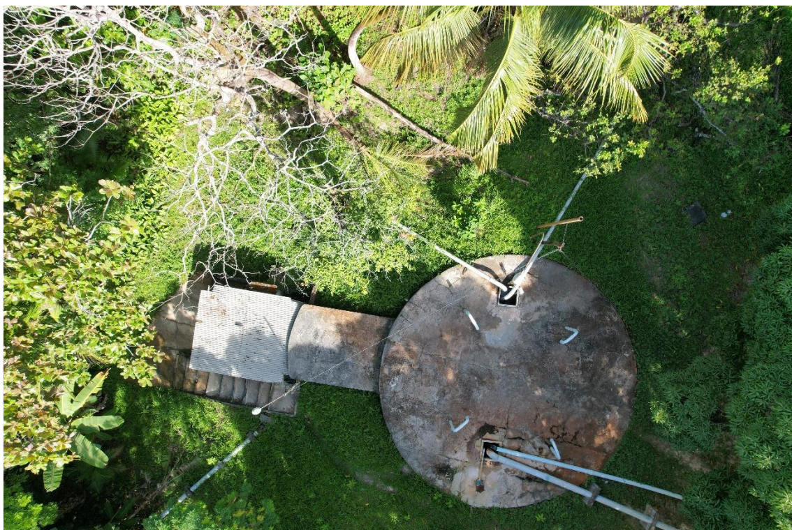
Figura 53. SAL05-RAP (reservatório apoiado).
