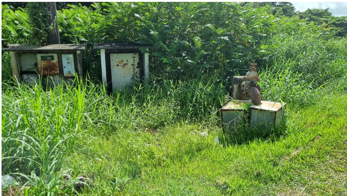
Figura 13. SAL06-CAPTAÇÃO001, poço tubular. Fonte: Consórcio, 2023.
