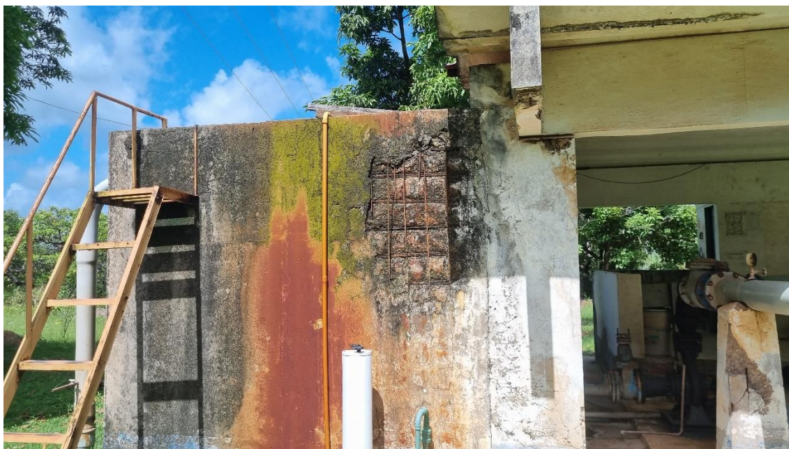
Figura 49. SAL01-RAP (reservatório apoiado).
