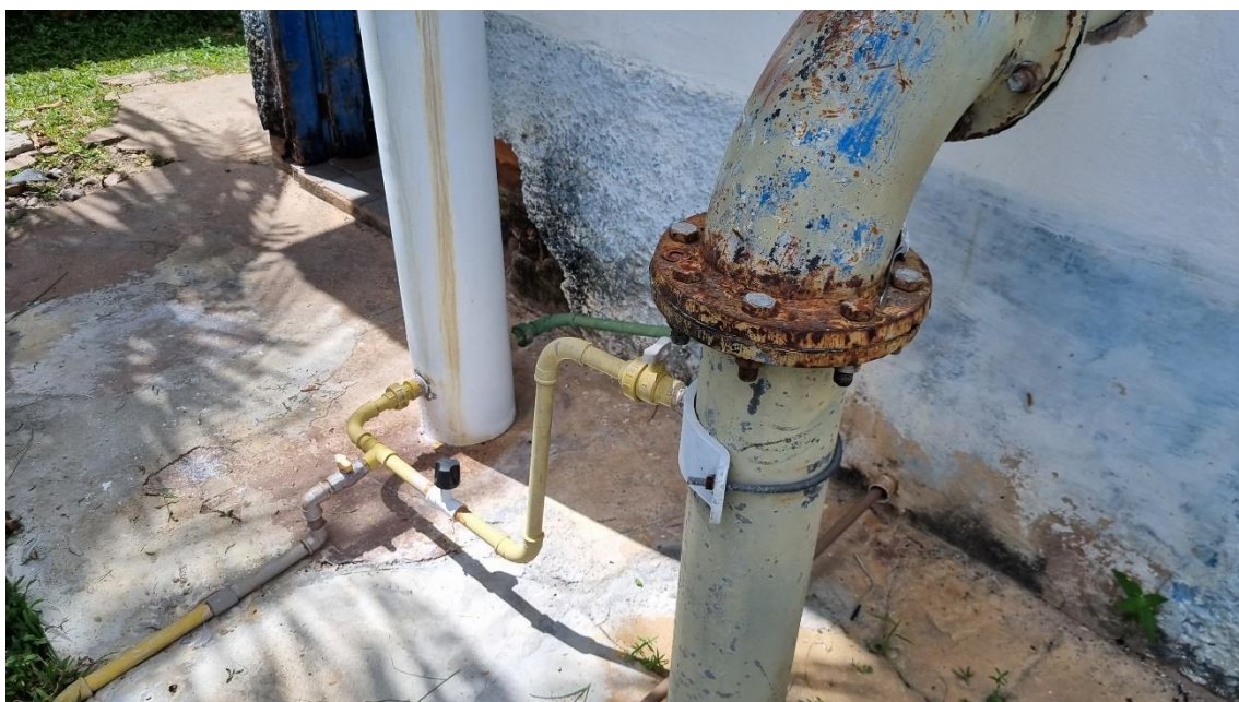
Figura 37. SAL08-TRATAMENTO, Tratamento de desinfecção (cloro pastilha). Fonte: Consórcio, 2023.
