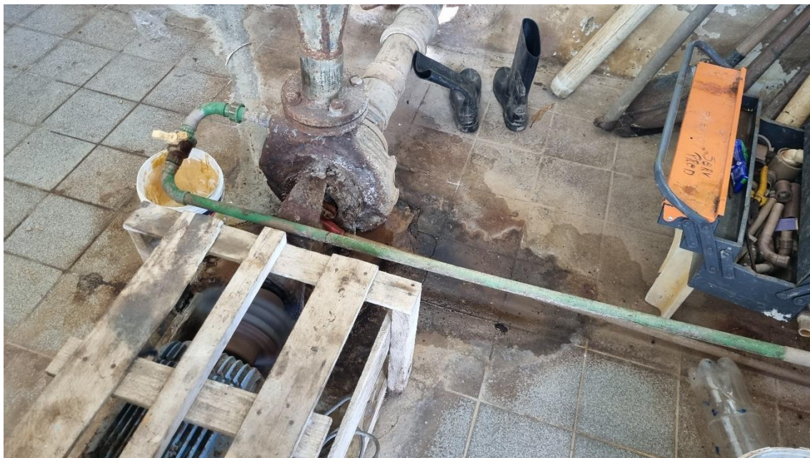
Figura 47. SAL08-EEAT, Estação Elevatória de Água Tratada. Fonte: Consórcio, 2023.
