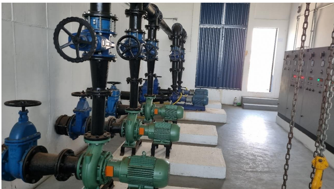
Figura 48. SAL017-EEAT, EELF, Estação Elevatória de Água Tratada. Fonte: Consórcio, 2023.
