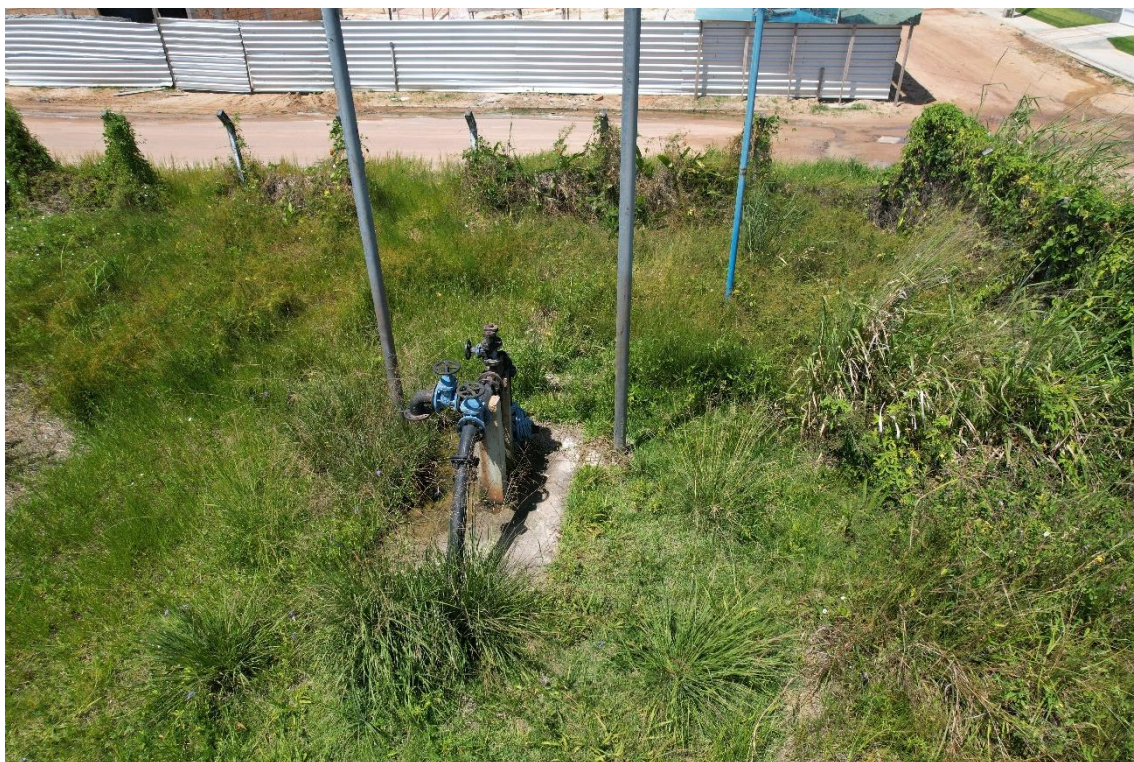
Figura 27. SAL017-CAPTAÇÃO002, poço tubular.
