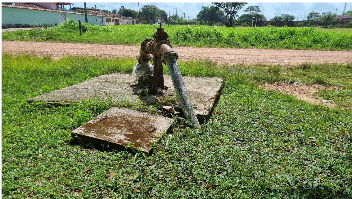
Figura 3. SAL01-CAPTAÇÃO001, poço tubular. Fonte: Consórcio, 2023.
