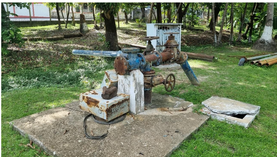
Figura 10. SAL04-CAPTAÇÃO, poço tubular. Fonte: Consórcio, 2023.
