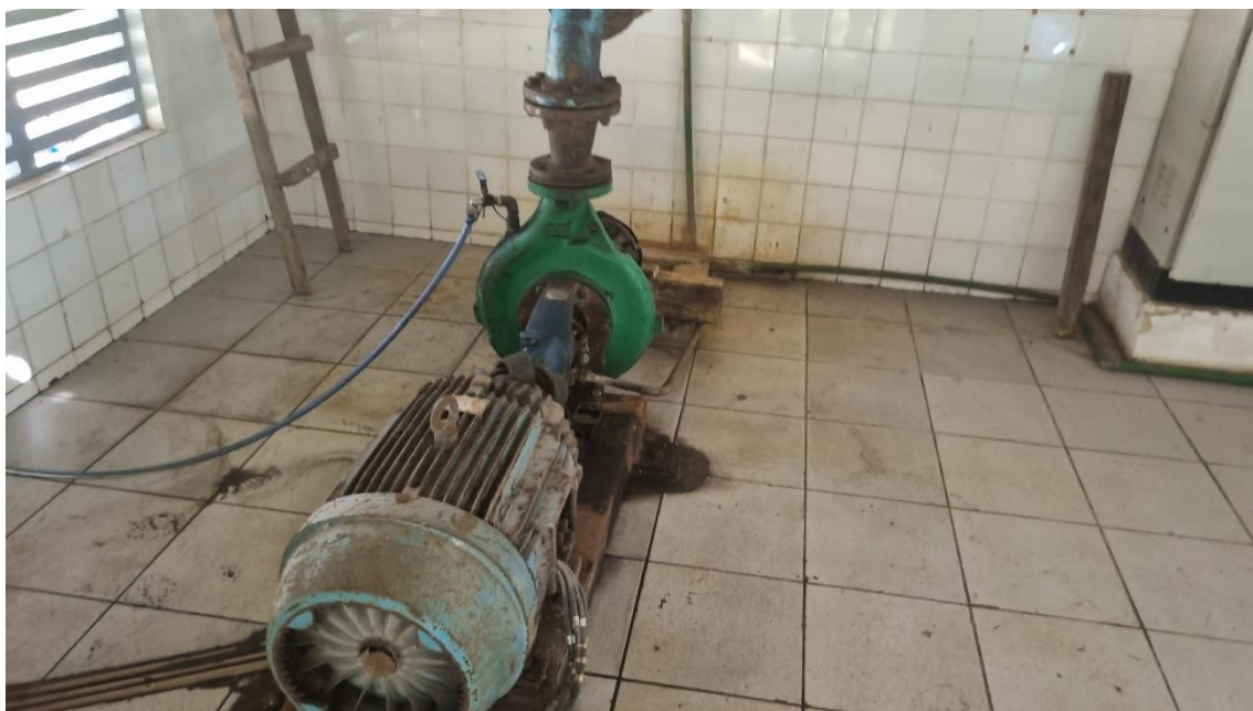
Figura 45. SAL04-EEAT, Estação Elevatória de Água Tratada. Fonte: Consórcio, 2023.
