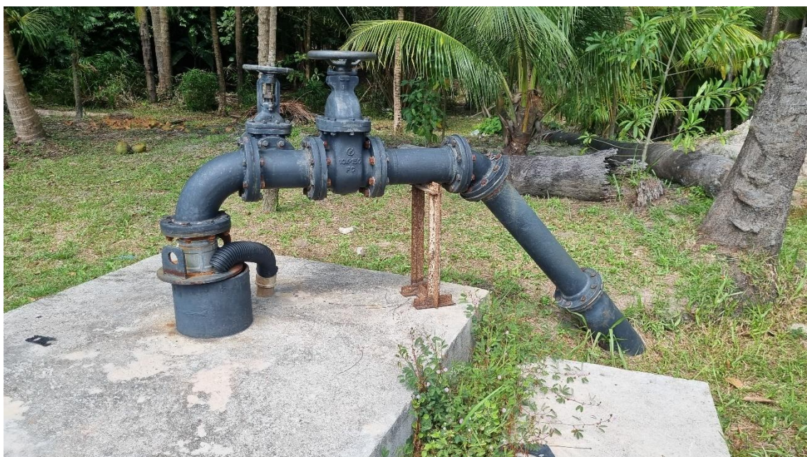
Figura 6. SAL03-CAPTAÇÃO001, poço tubular. Fonte: Consórcio, 2023.
