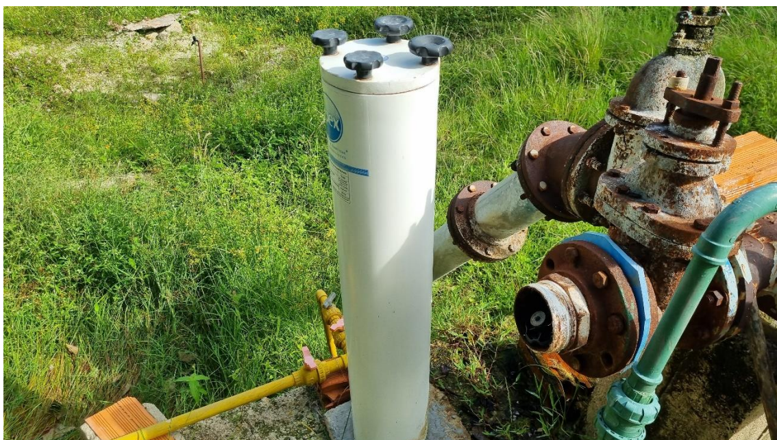
Figura 33. SAL02-TRATAMENTO, Tratamento de desinfecção (cloro pastilha). Fonte: Consórcio, 2023.
