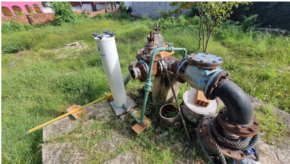
Figura 5. SAL02-CAPTAÇÃO, poço tubular. Fonte: Consórcio, 2023.
