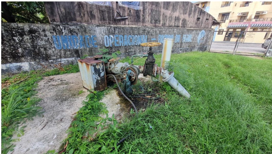
Figura 19. SAL09-CAPTAÇÃO, poço tubular. Fonte: Consórcio, 2023.
