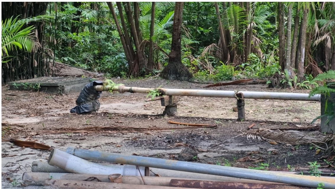
Figura 9. SAL03-CAPTAÇÃO004, poço tubular. Fonte: Consórcio, 2023.
