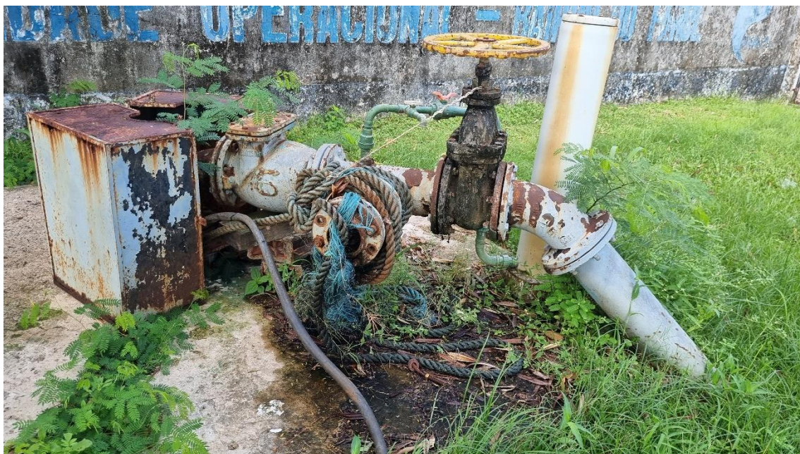
Figura 38. SAL09-TRATAMENTO, Tratamento de desinfecção (cloro pastilha). Fonte: Consórcio, 2023.
