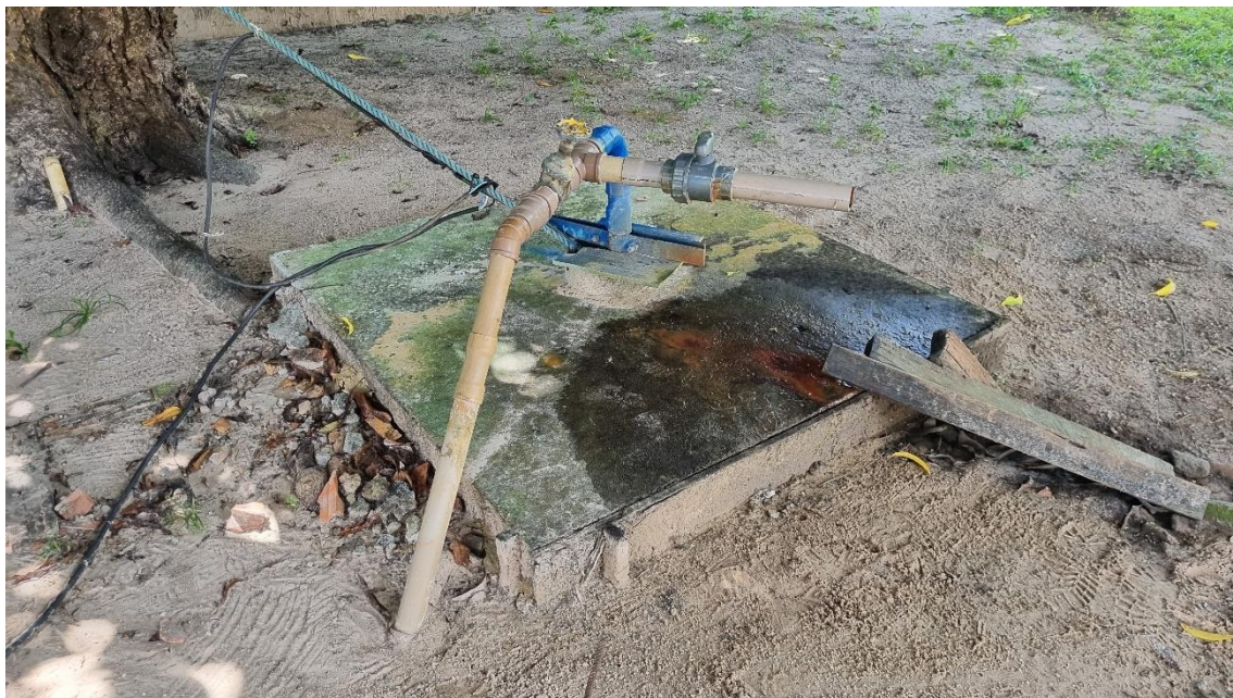
Figura 15. SAL08-CAPTAÇÃO001, poço tubular. Fonte: Consórcio, 2023.
