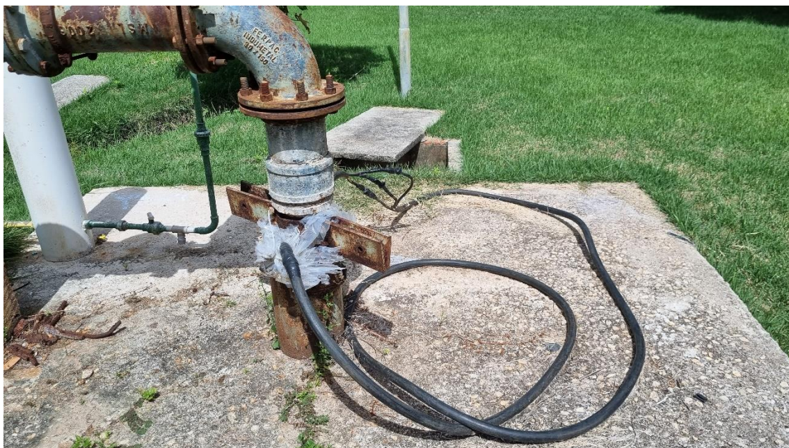
Figura 21. SAL11-CAPTAÇÃO, poço tubular. Fonte: Consórcio, 2023.
