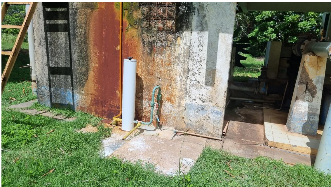
Figura 32. SAL01-TRATAMENTO, Tratamento de desinfecção (cloro pastilha). Fonte: Consórcio, 2023.
