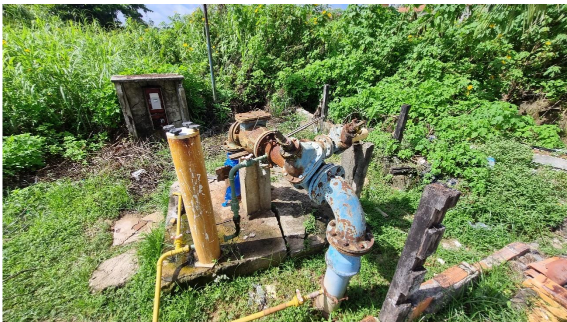
Figura 24. SAL015-CAPTAÇÃO, poço tubular.
