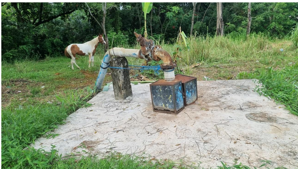
Figura 14. SAL06-CAPTAÇÃO002, poço tubular. Fonte: Consórcio, 2023.
