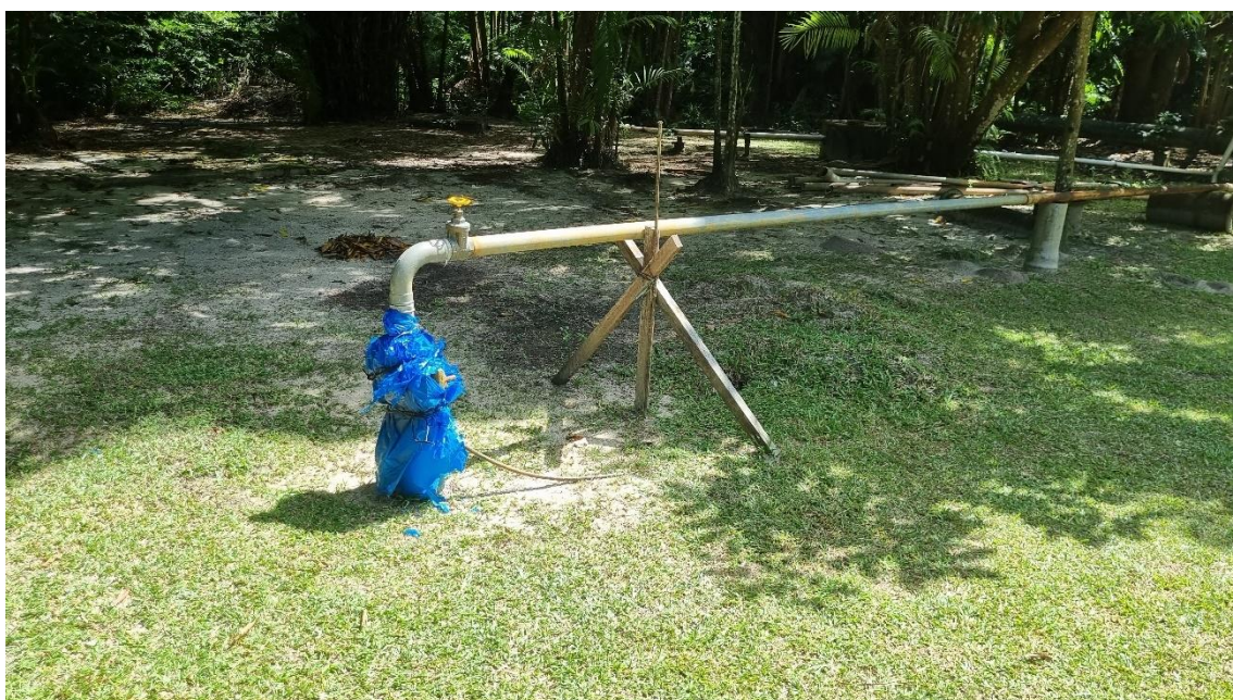
Figura 8. SAL03-CAPTAÇÃO003, poço tubular. Fonte: Consórcio, 2023.
