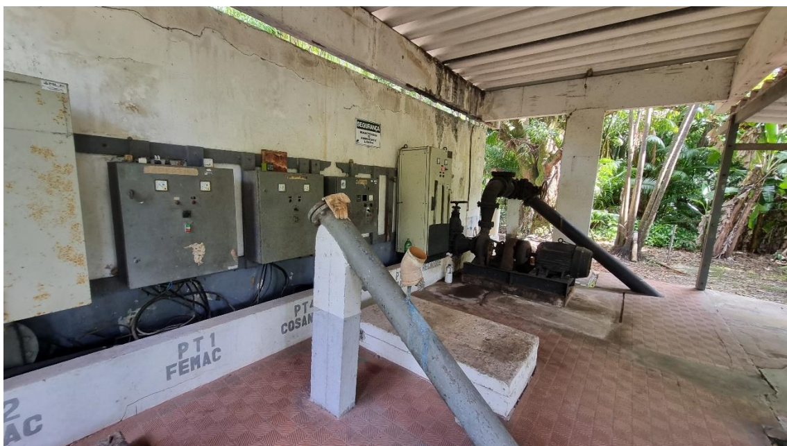
Figura 44. SAL03-EEAT, Estação Elevatória de Água Tratada. Fonte: Consórcio, 2023.
