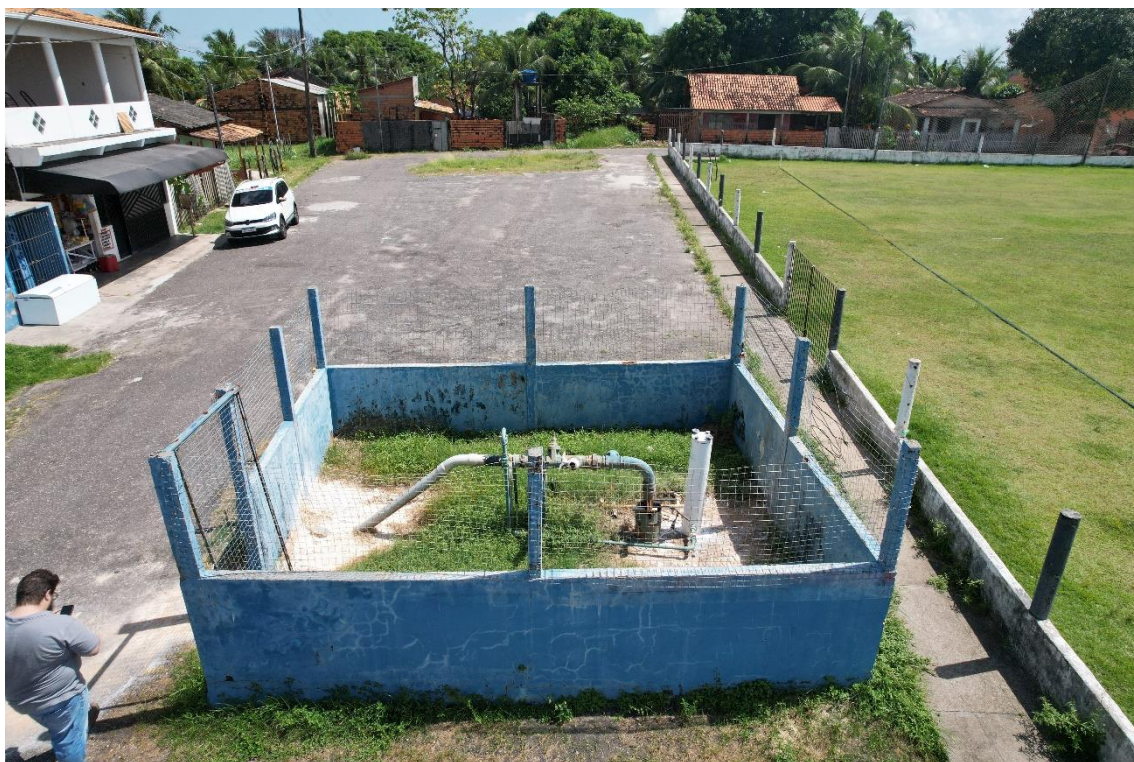
Figura 23. SAL012-CAPTAÇÃO002, poço tubular.
