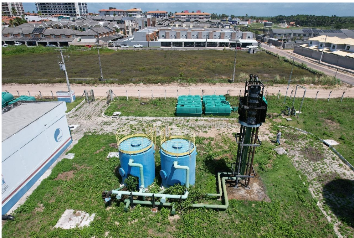
Figura 42. SAL17-ETA, Estação de Tratamento de Água (desferrização).
