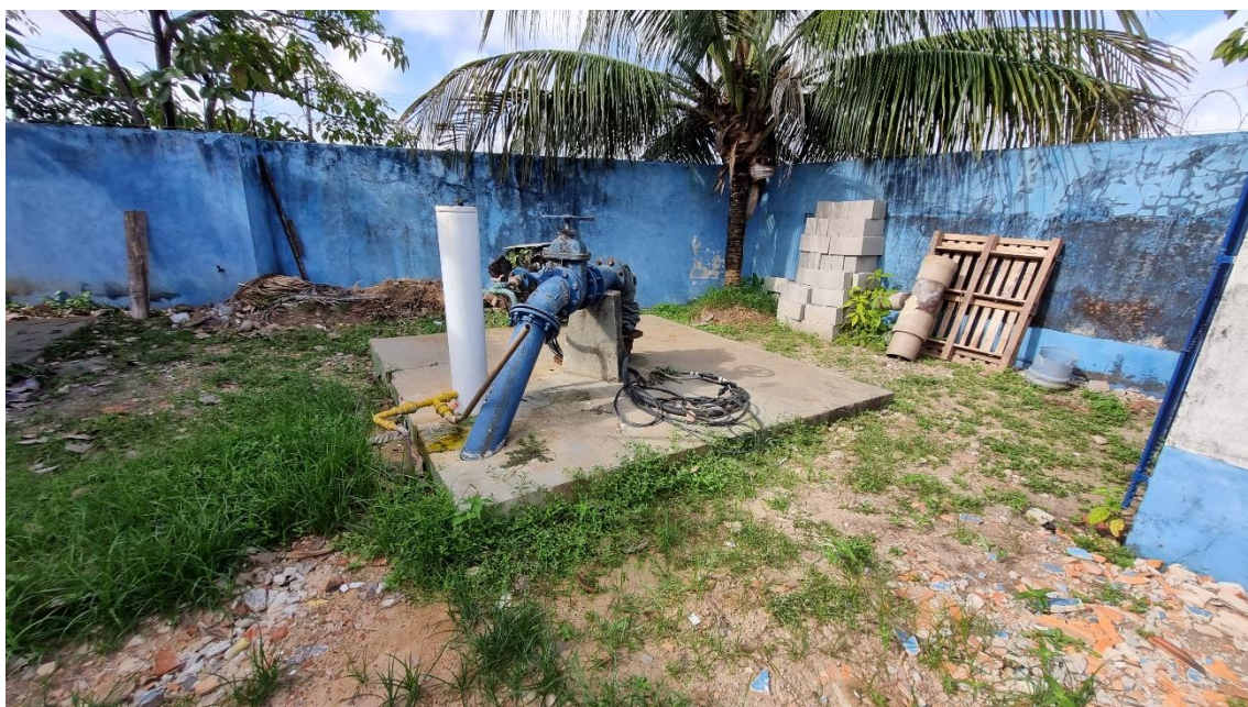
Figura 20. SAL10-CAPTAÇÃO, poço tubular. Fonte: Consórcio, 2023.
