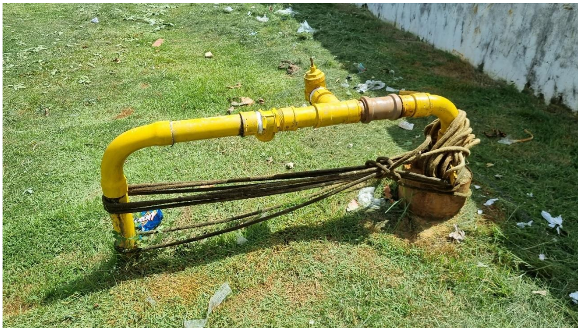
Figura 31. SAL20-CAPTAÇÃO, poço tubular.
