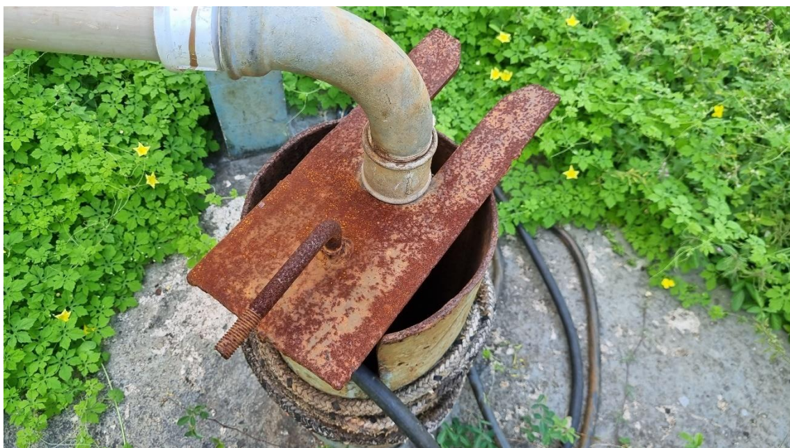
Figura 22. SAL12-CAPTAÇÃO001, poço tubular. Fonte: Consórcio, 2023.
