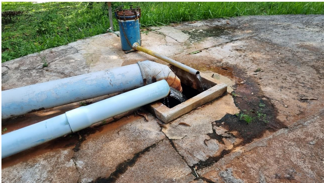
Figura 36. SAL05-TRATAMENTO, Tratamento de desinfecção (cloro pastilha). Fonte: Consórcio, 2023.
