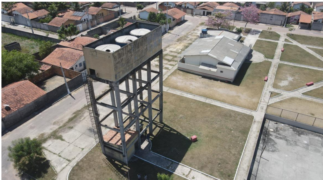
Figura 25. TAI06-REL, (reservatório elevado).
