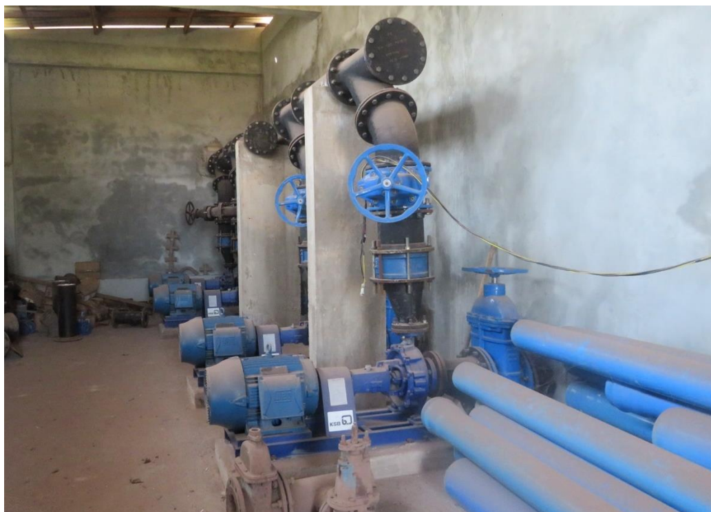
Figura 19. TAI01-EEAT02, (Estação Elevatória de Água Tratada).
