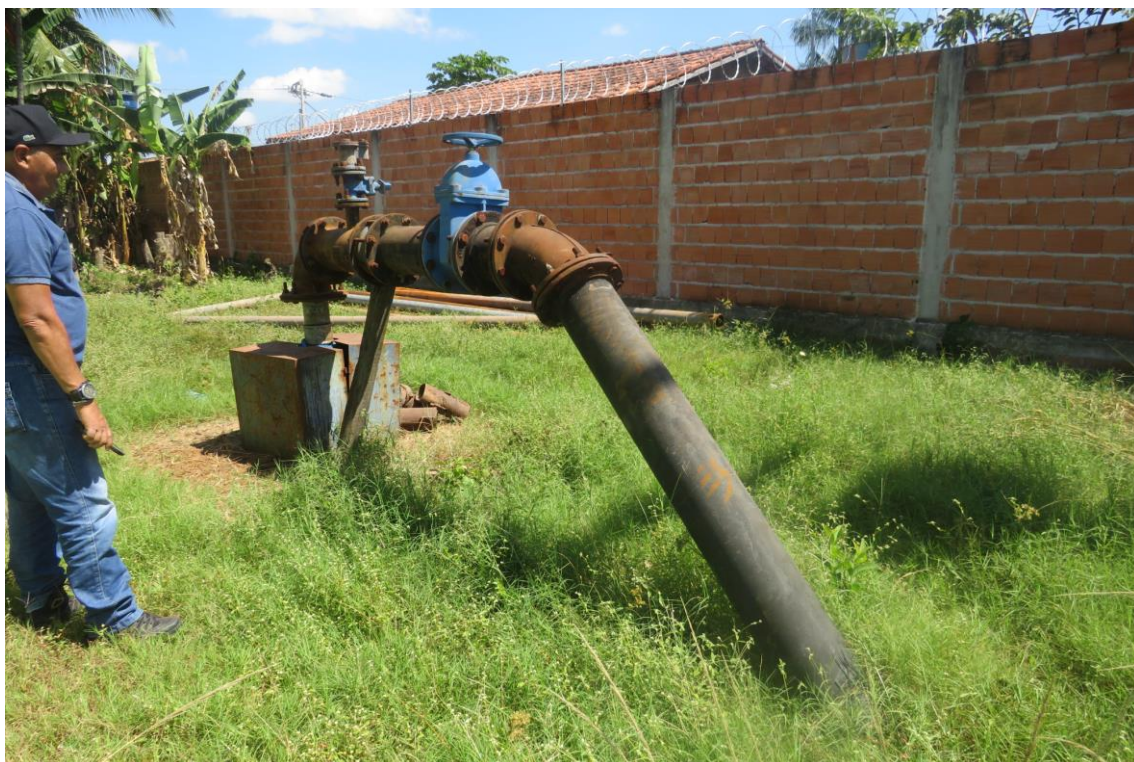
Figura 10. TAI03-CAPTAÇÃO, poço tubular.
