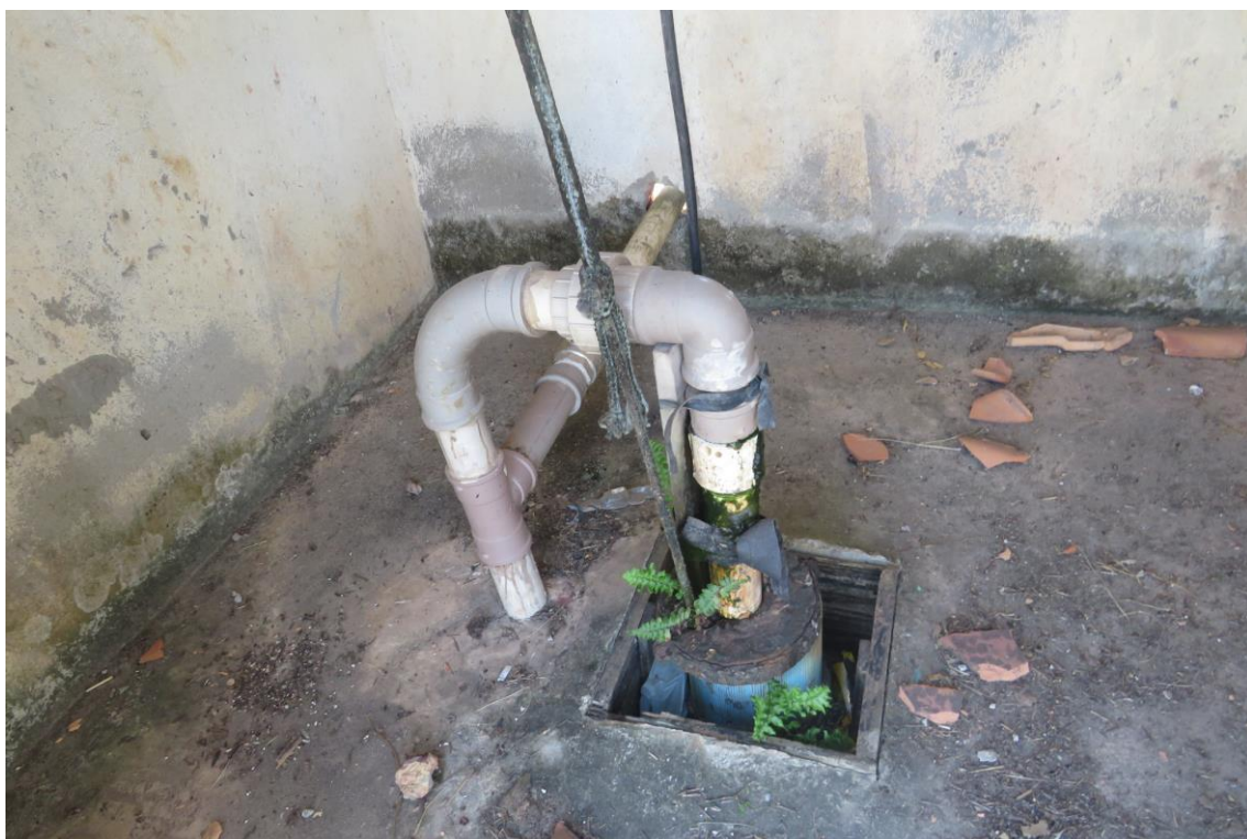
Figura 13. TAI06-CAPTAÇÃO, poço tubular.
