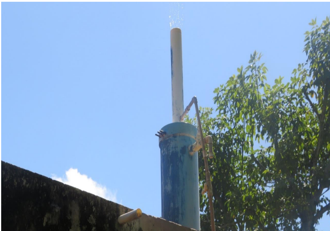
Figura 17. TAI01-TRATQUÍMICO, (dosador de cloro).
