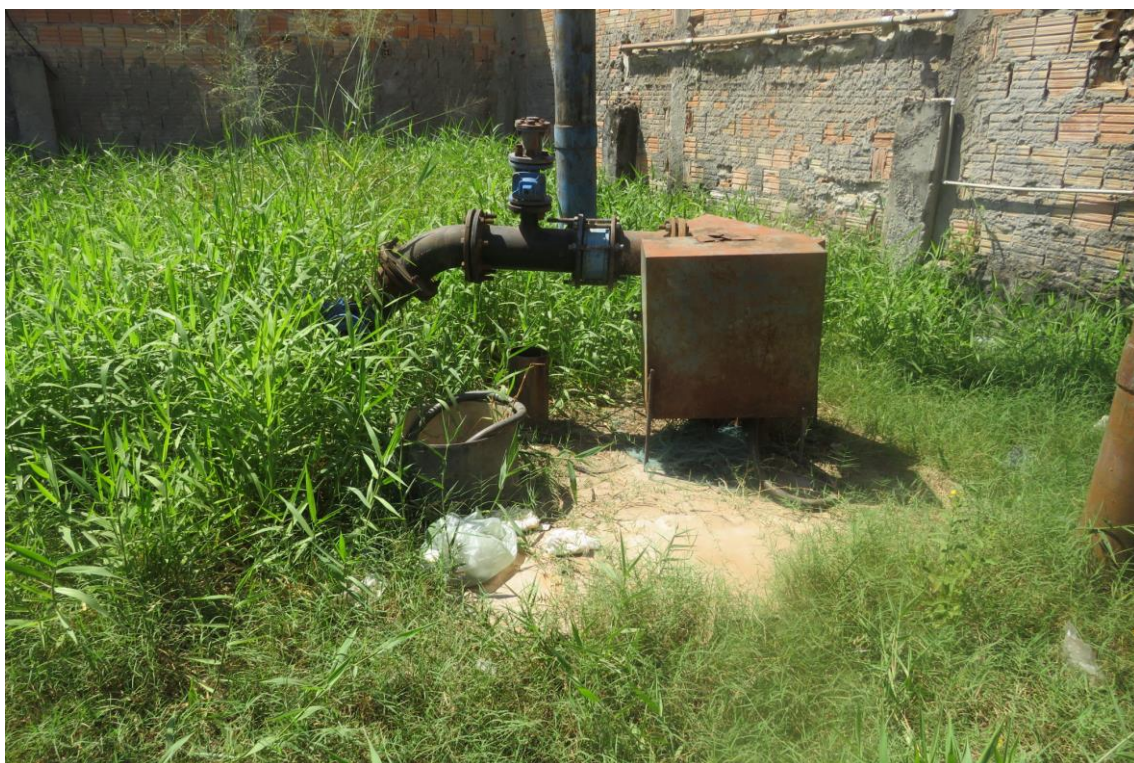
Figura 11. TAI04-CAPTAÇÃO, poço tubular.
