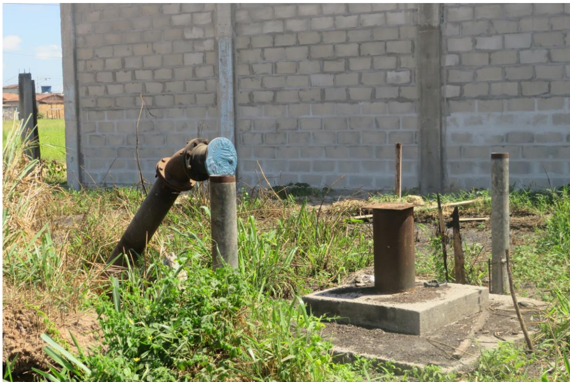
Figura 14. TAI07-CAPTAÇÃO, poço tubular.
