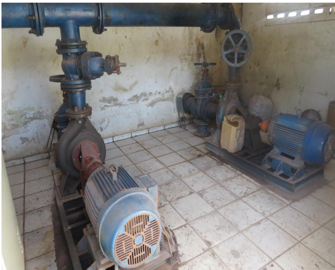
Figura 18. TAI01-EEAT01, (Estação Elevatória de Água Tratada).
