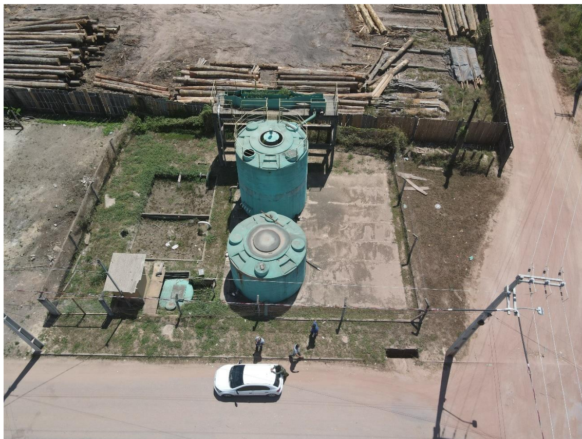
Figura 29. TAI10-ETE, (Estação de Tratamento de Esgoto).
