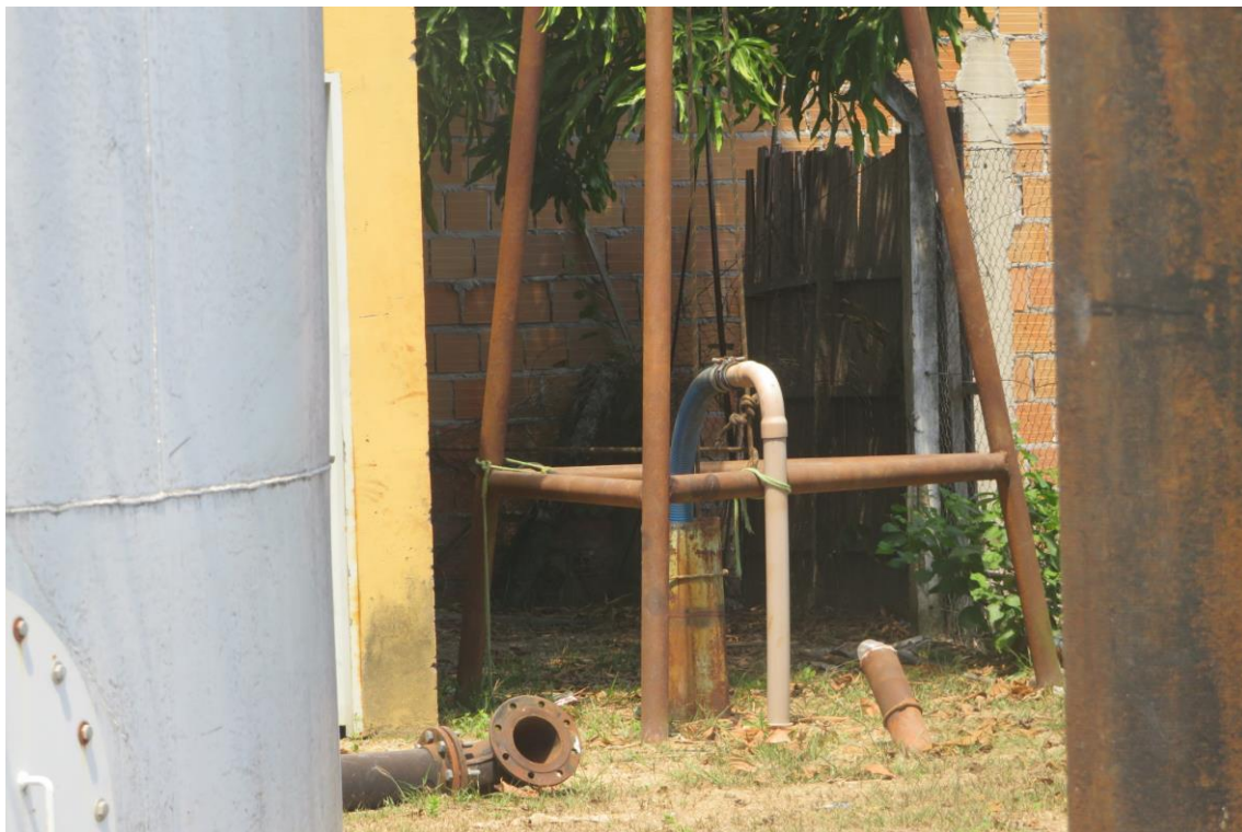
Figura 12. TAI05-CAPTAÇÃO, poço tubular.
