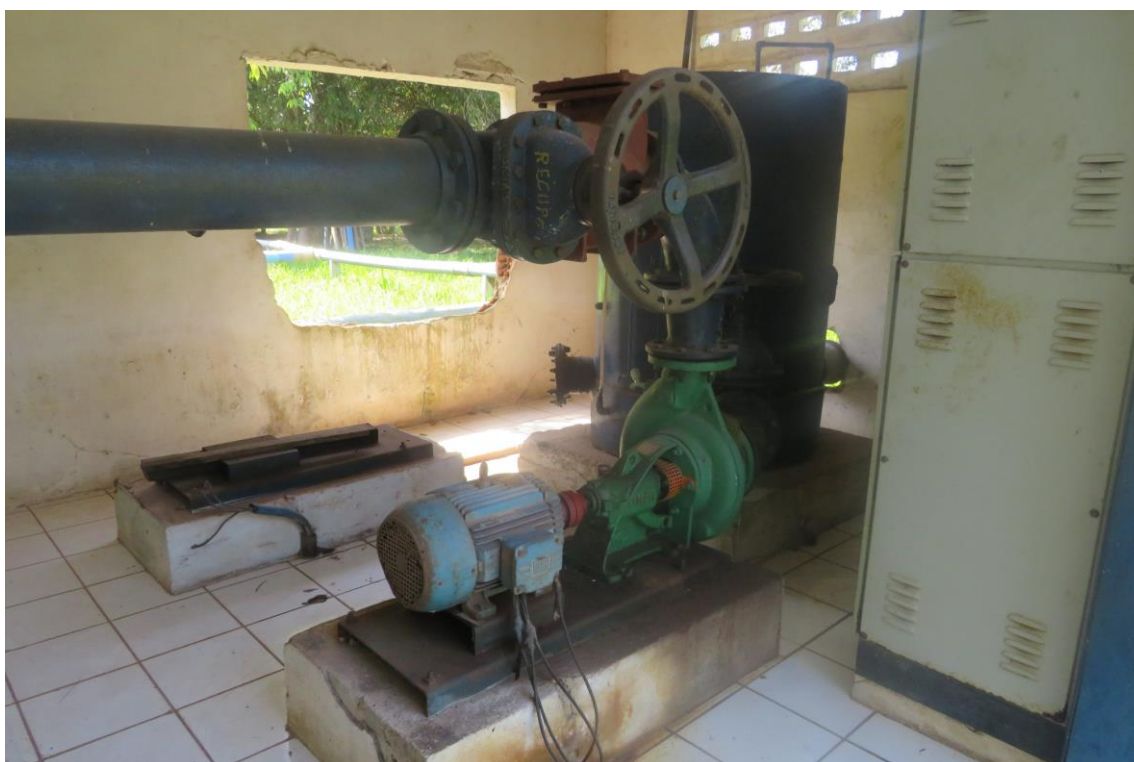
Figura 5. TAI01-CAPTAÇÃO001, sistema a vácuo (aproximada).
