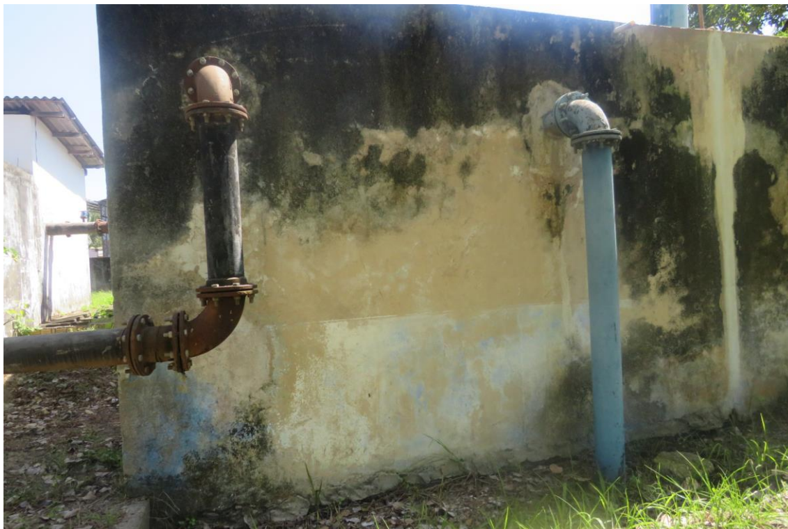
Figura 21. TAI01-RAP02, reservatório apoiado (tanque de contato).
