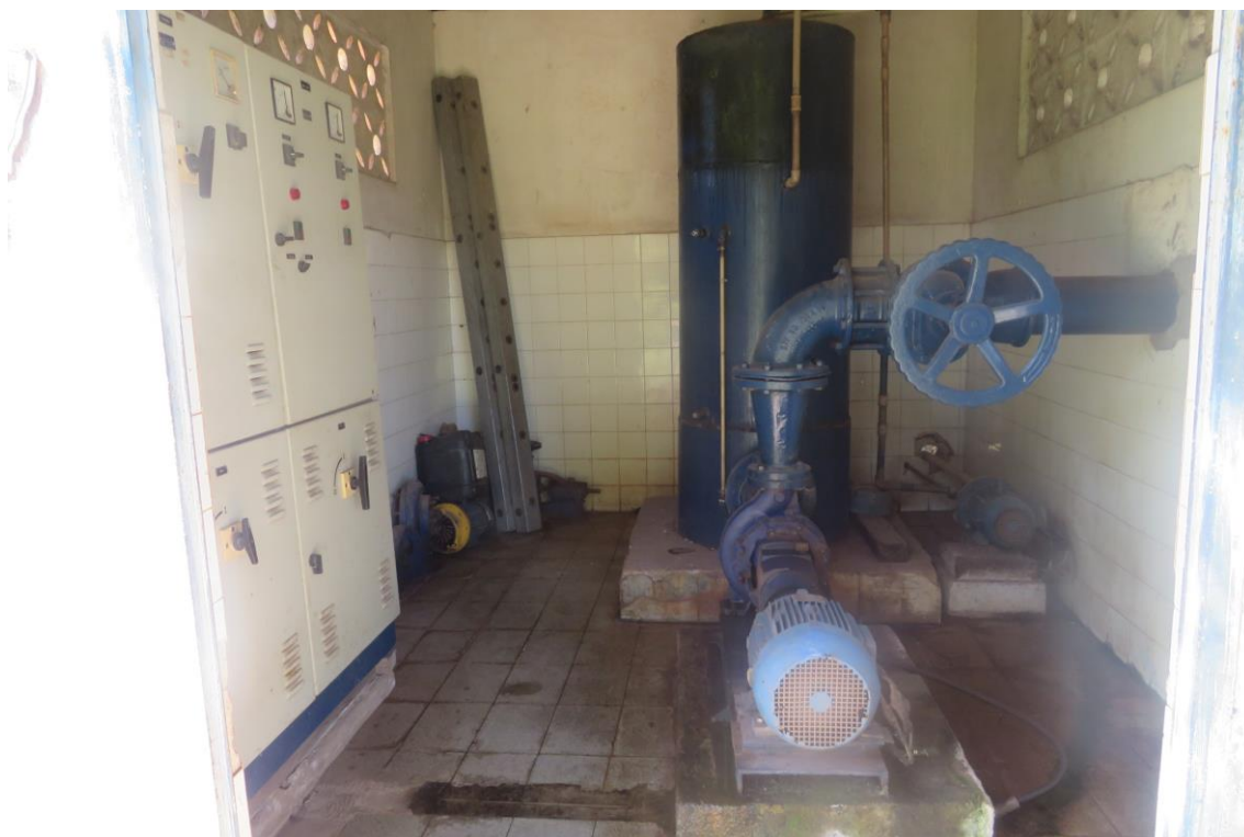
Figura 9. TAI01-CAPTAÇÃO002, sistema a vácuo (aproximada).
