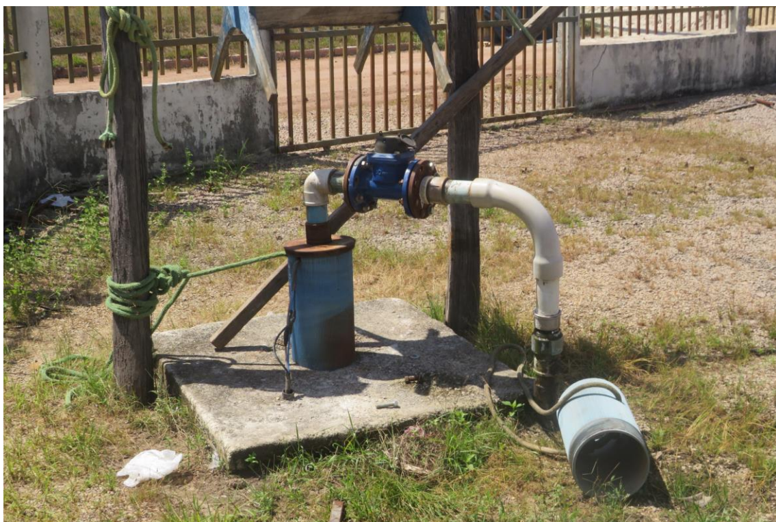
Figura 15. TAI08-CAPTAÇÃO, poço tubular.
