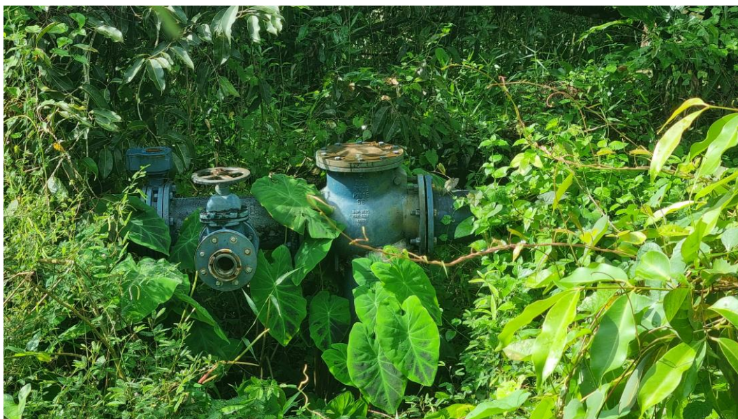
Figura 3. VIG02 - captação, Poço tubular (Aproximado). Fonte: Consórcio, 2023.
