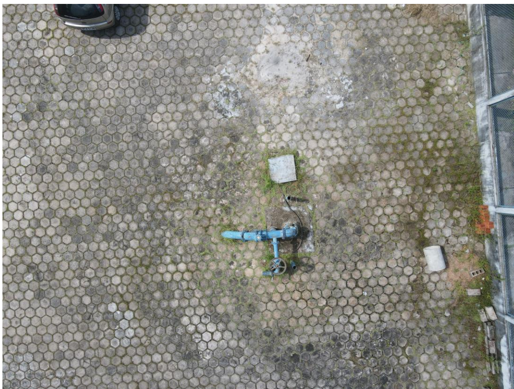
Figura 5. VIG03- captação, Poço tubular 01. Fonte: Consórcio, 2023.
