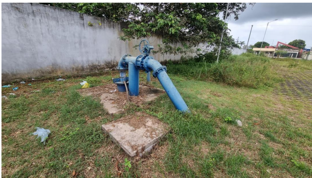
Figura 6. VIG03- captação, Poço tubular 02. Fonte: Consórcio, 2023.
