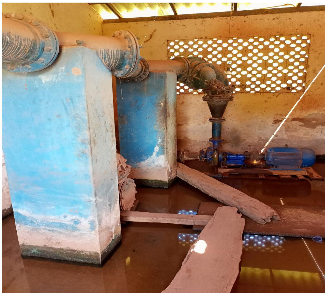
Figura 7. ALQ03-EEAT (Estação Elevatória de Água Tratada).
