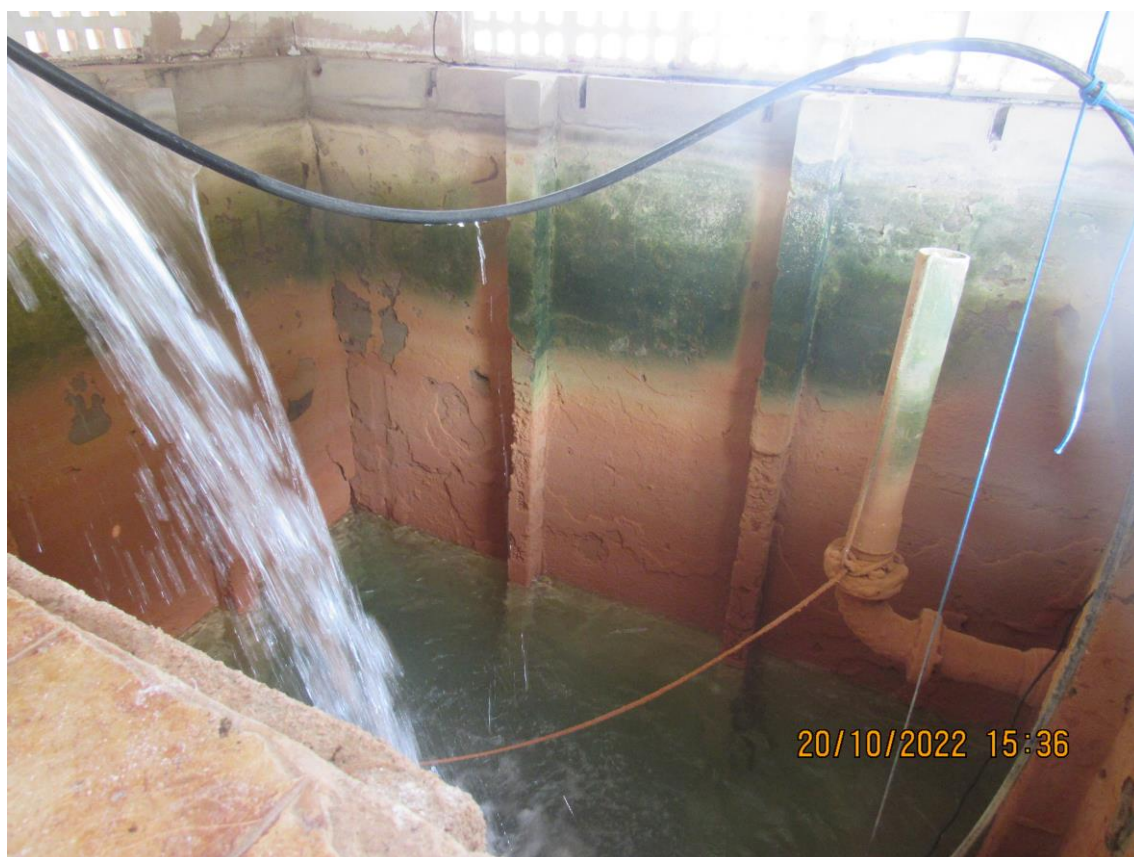
Figura 8. ALQ01-RAP01 (reservatório apoiado).
