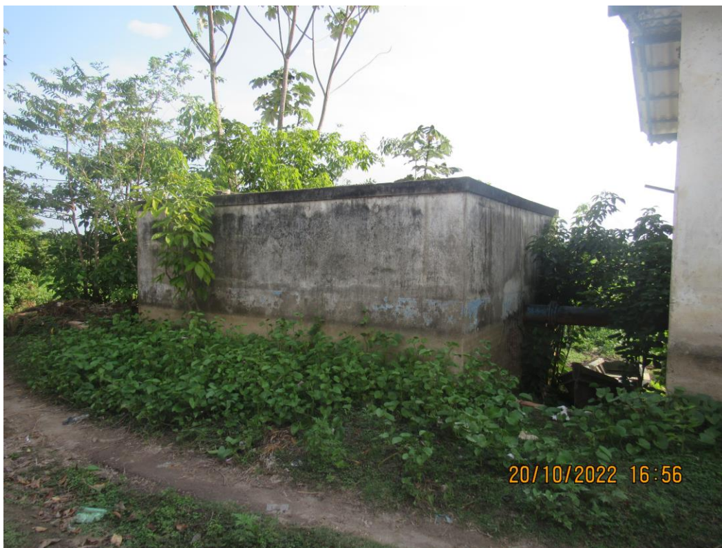
Figura 11. ALQ04-RAP (reservatório apoiado).
