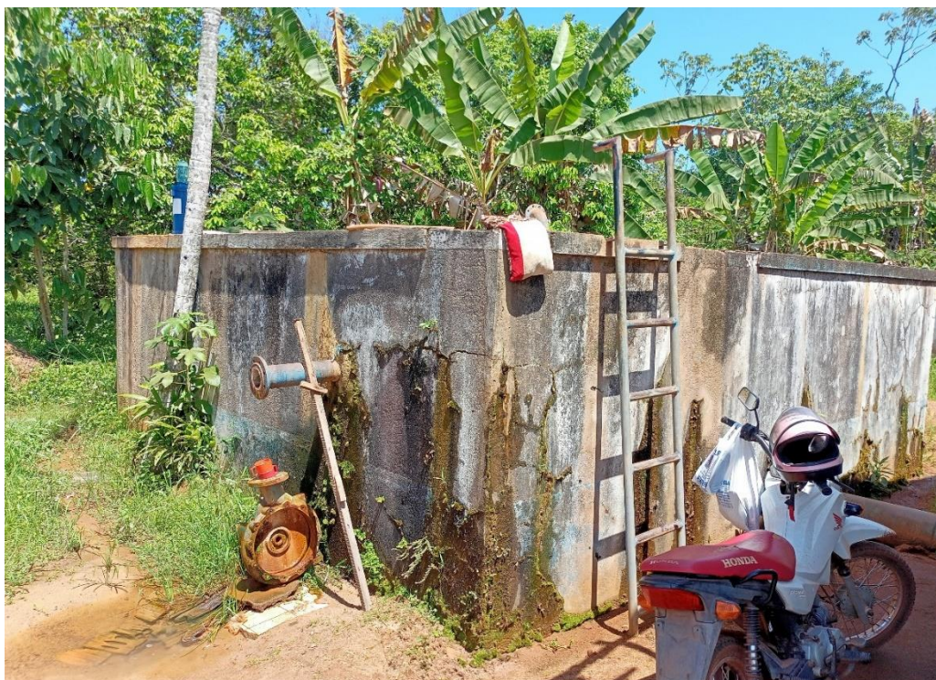
Figura 10. ALQ03-RAP (reservatório apoiado).
