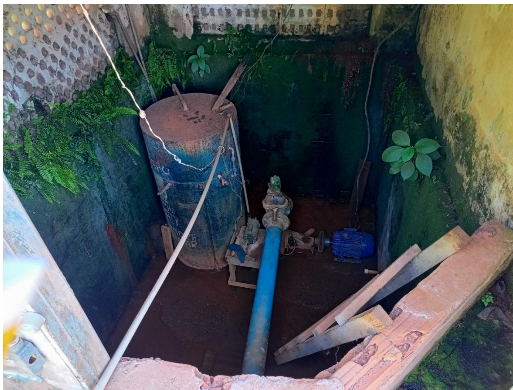
Figura 4. ALQ03-CAPTAÇÃO, poço subterrâneo (aproximada).
