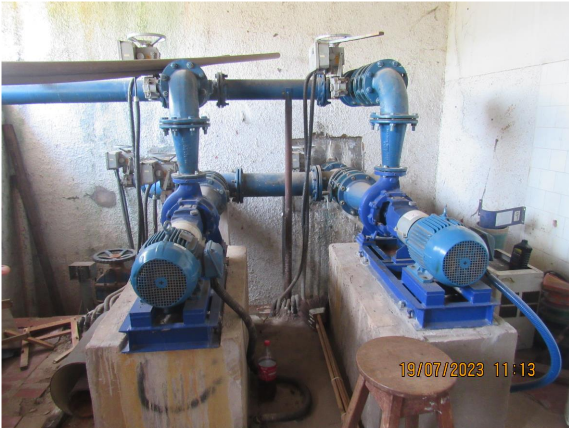
Figura 15. MON02-EEAT 02, conjunto de motobombas.
