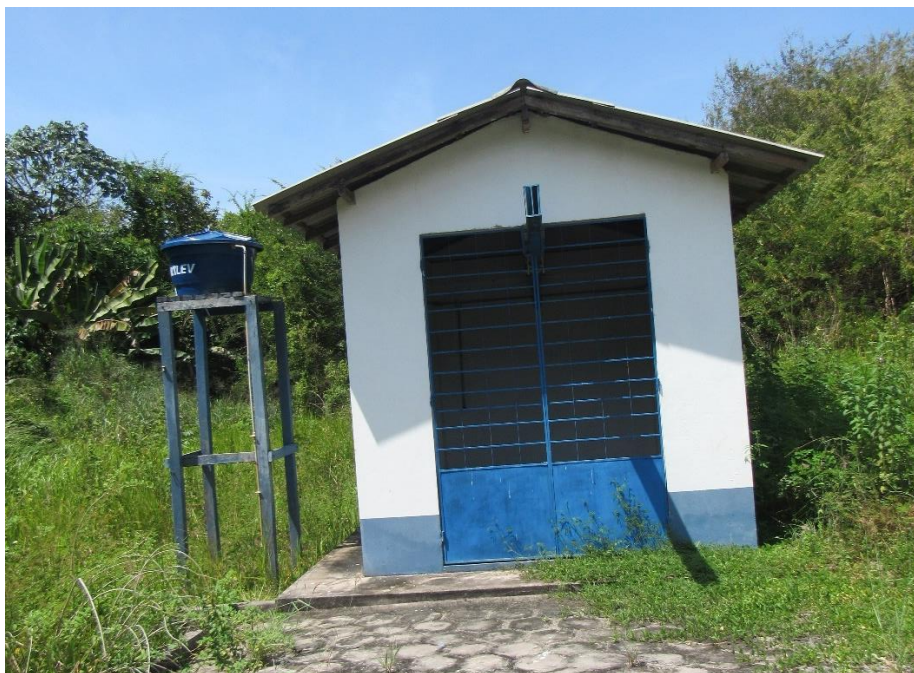
Figura 8. Captação - MON01, sistema de vácuo 05 (inoperante).
