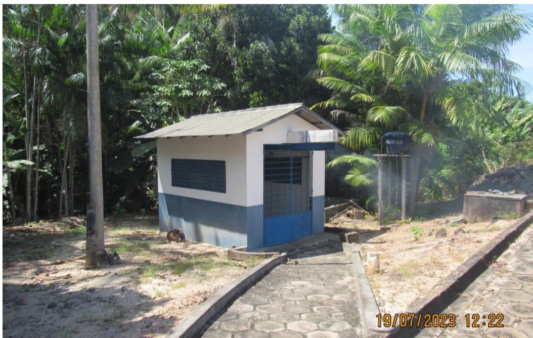
Figura 5. Captação - MON01, sistema de vácuo 02 (inoperante).
