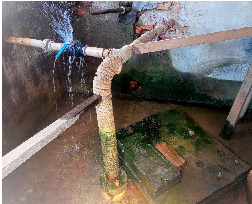
Figura 13. Captação - MON06, poço tubular (bomba). Fonte: Consórcio, 2023.
