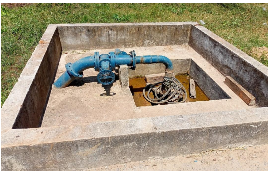
Figura 4. OBI02 – Captação, poço 02. Fonte: Consórcio, 2023
