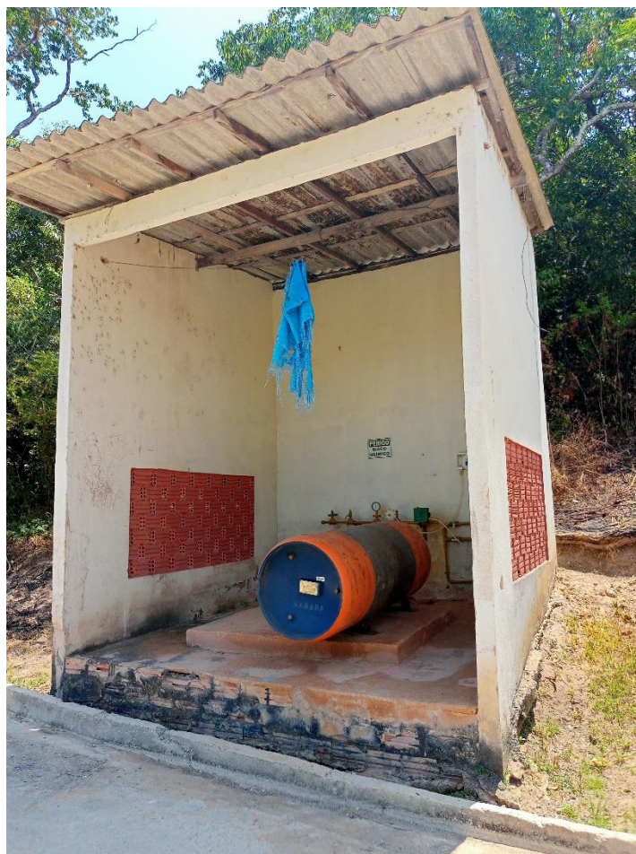
Figura 14. OBI02 – Tratamento Químico a cloro gás Fonte: Consórcio, 2023.
