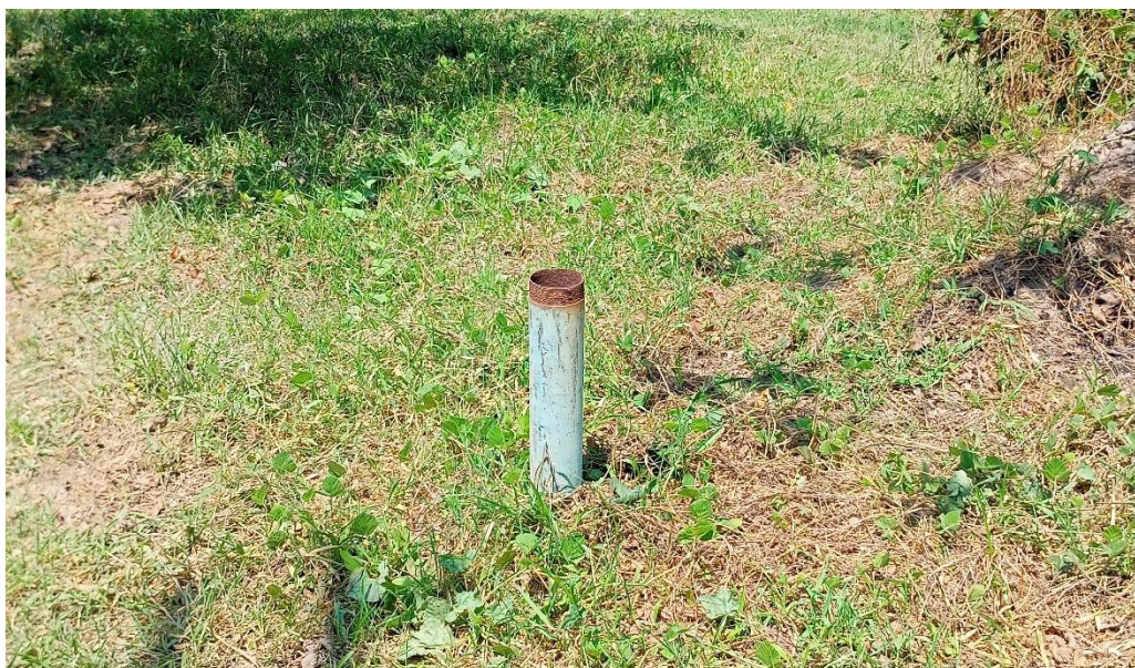
Figura 5. Captação – OBI02, poço 03 (inoperante).
