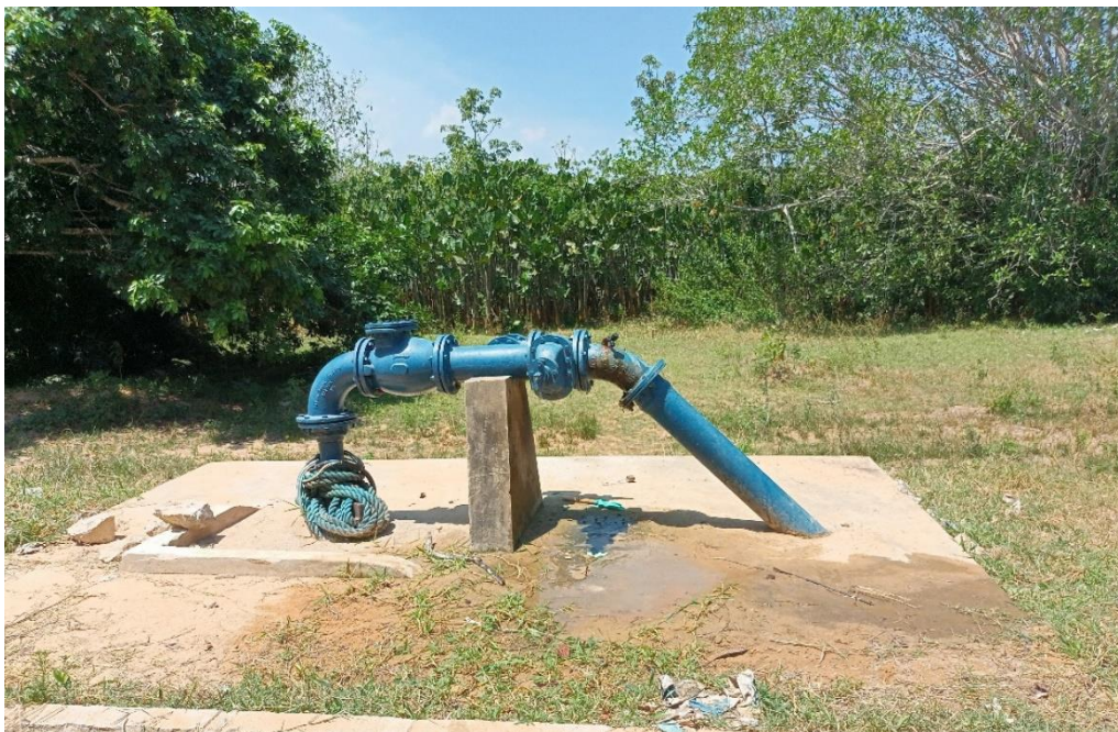
Figura 3. OBI02 - Captação –, poço 01 Fonte: Consórcio, 2023
