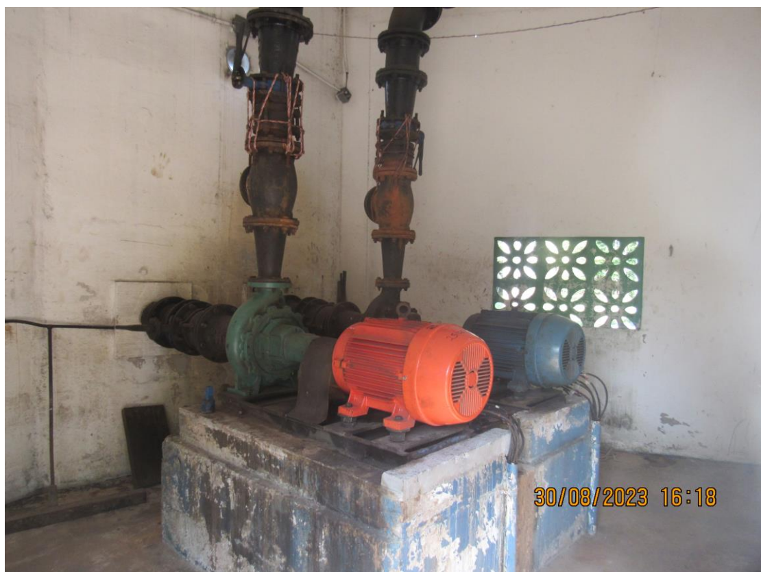
Figura 18. PDM01 - EEAT, SAA Conjunto de motobombas (dois motores).
