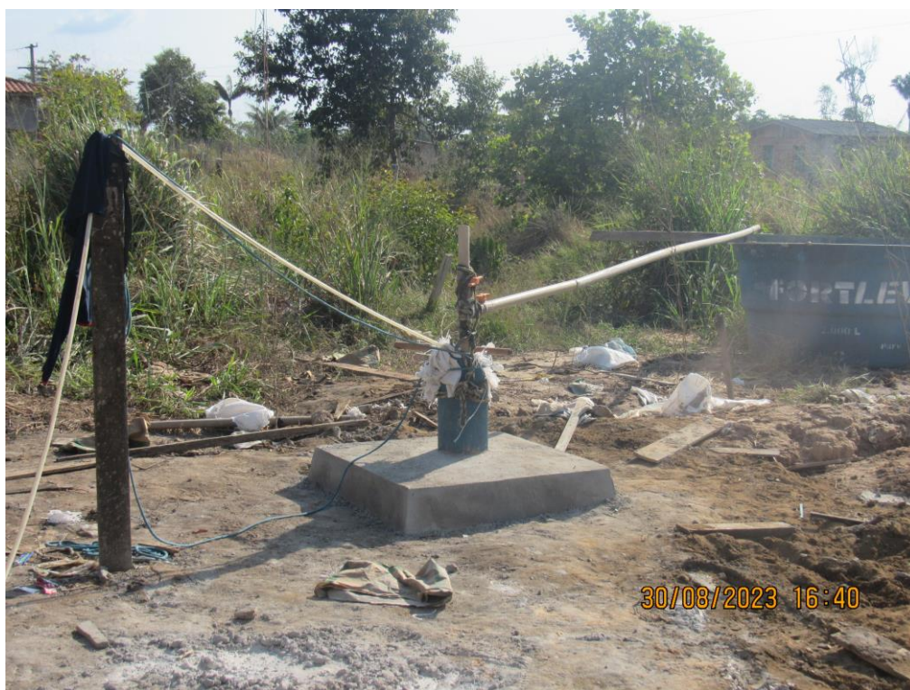
Figura 11. PDM03 - Captação, Poço Profundo (92m).
