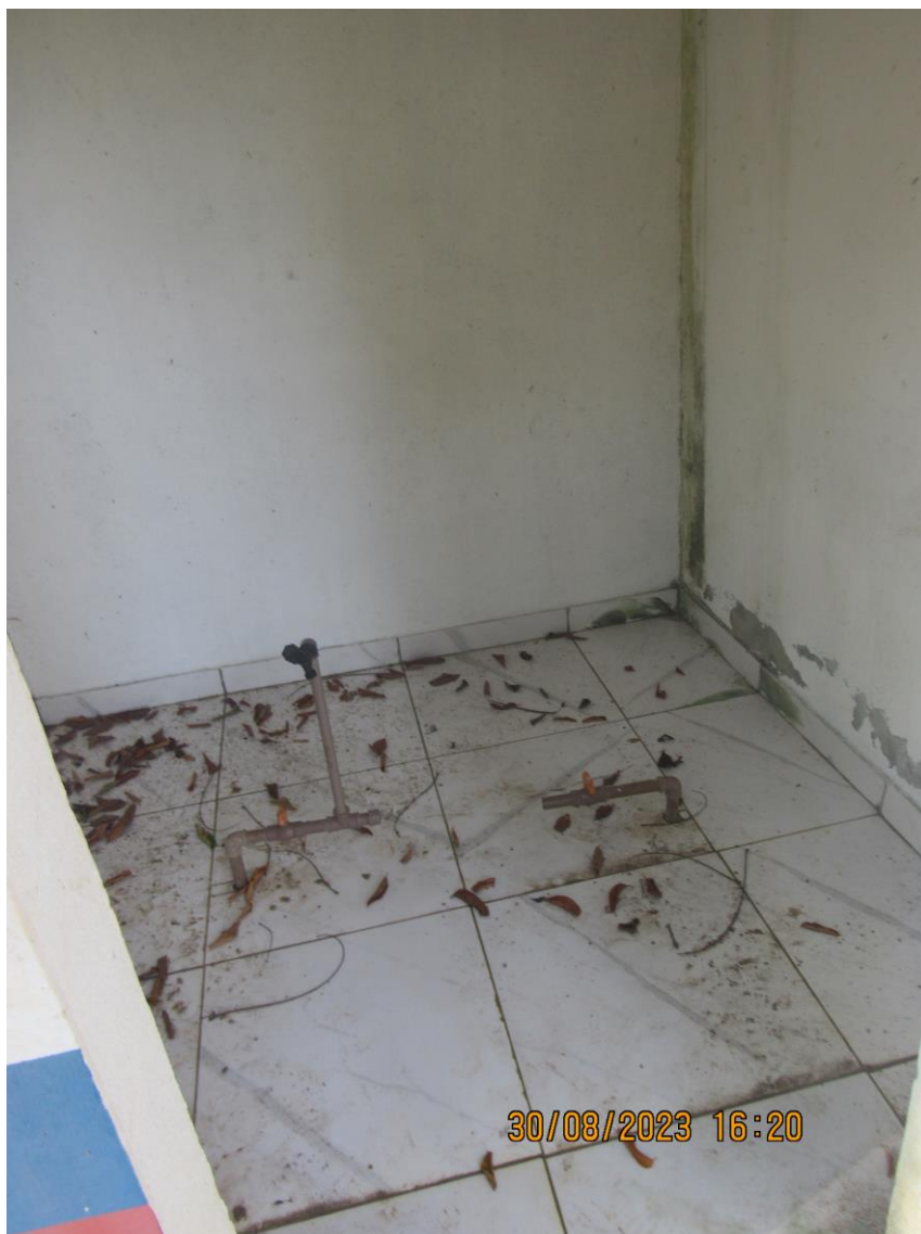
Figura 17. PDM01 - SAA Tratamento interrompido a cloro pastilha, do Poço 03.
