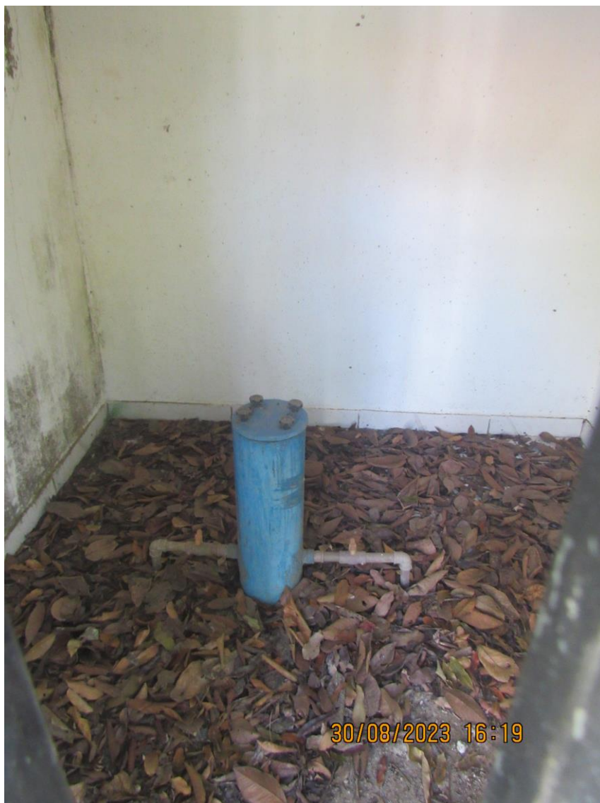
Figura 16. PDM01 - SAA Tratamento a cloro pastilha, do Poço 02. Fonte: Consórcio, 2023.
