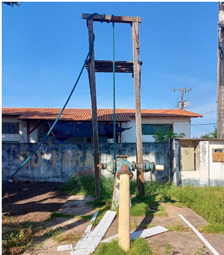
Figura 4. PRA01 – Captação, poço tubular. Fonte: Consórcio, 2023.
