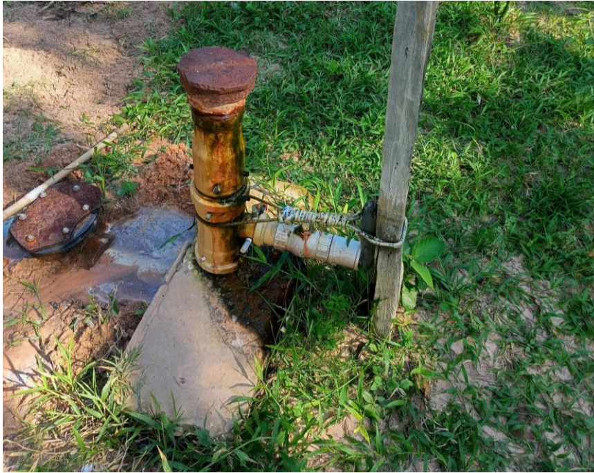
Figura 5. PRA02 – Captação, poço tubular.
