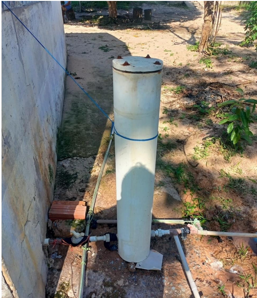
Figura 8. PRA02 – Tratamento Químico, aplicação de cloro pastilha.
