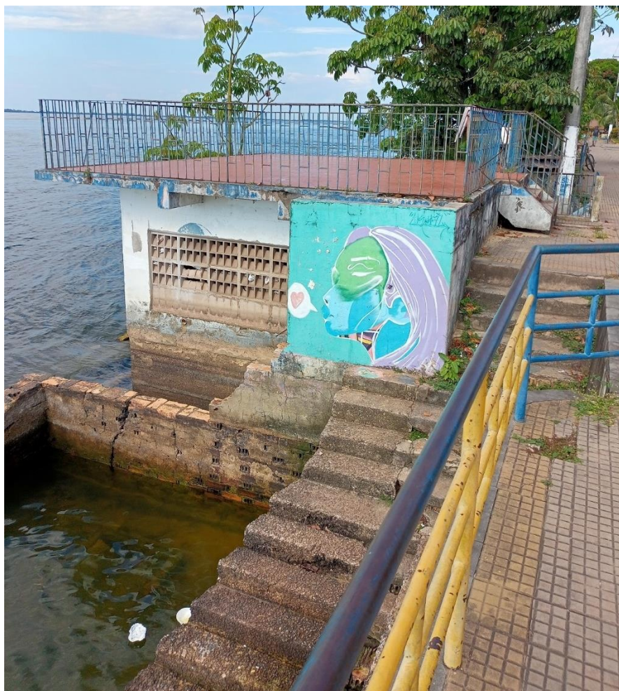
Figura 46. Captação – STM036 (inoperante).
