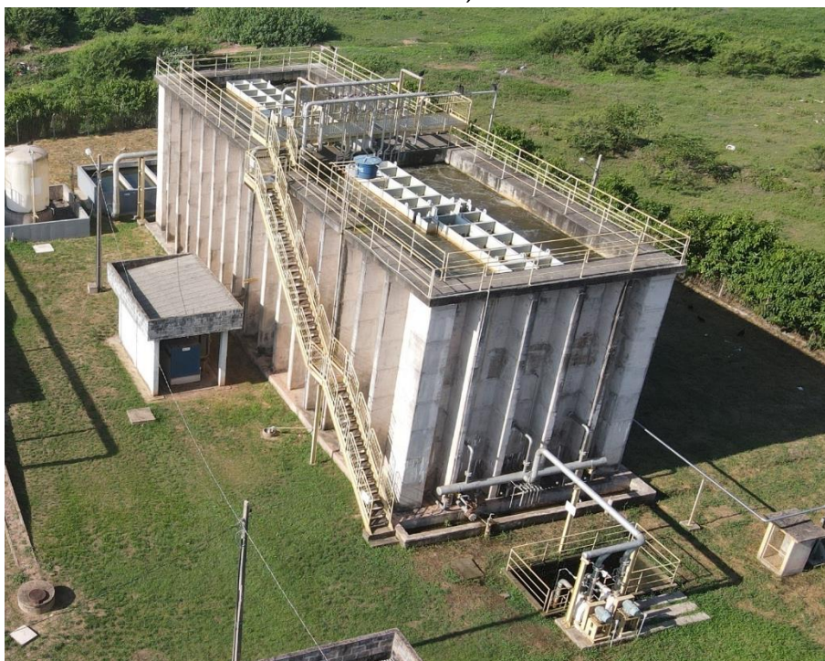
Figura 120. STM17-ETE Urumari, elevatória e módulo UBOX.
