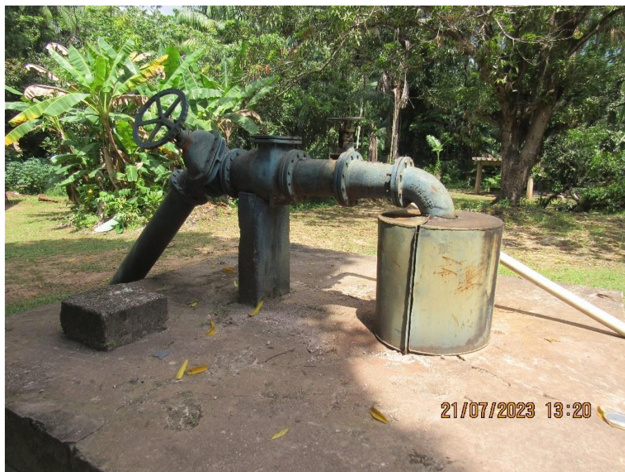
Figura 3. Captação – STM001, poço 01.
