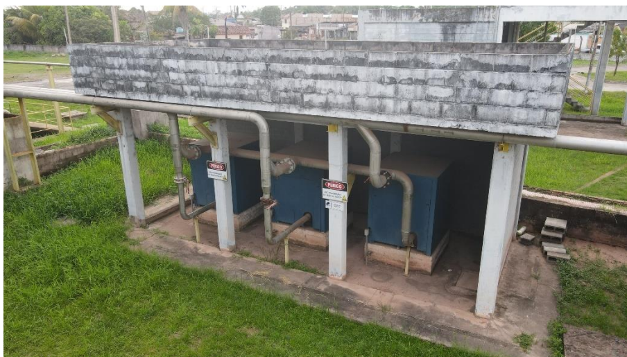
Figura 115. STM16-ETE Irurá, Sopradores.
