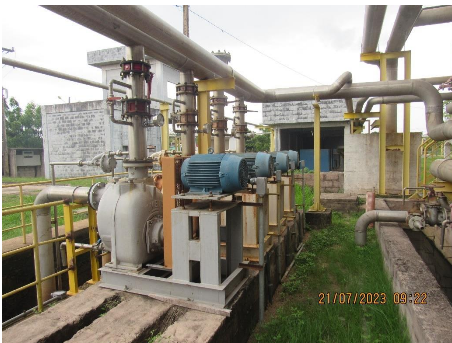
Figura 113. STM16-ETE Irurá, elevatória dos reatores.
