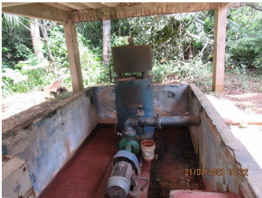
Figura 5. Captação – STM001, poço 02 (bomba).
