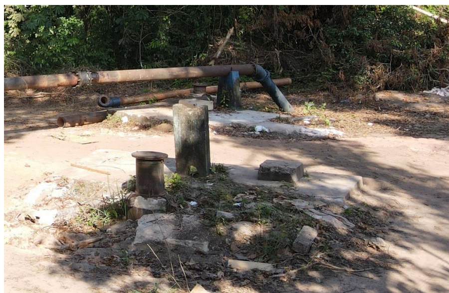
Figura 11. Captação – STM003 (inoperante).
