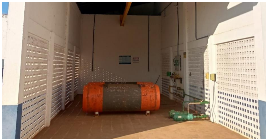
Figura 51. Tratamento Químico – STM015, cloro gás.
