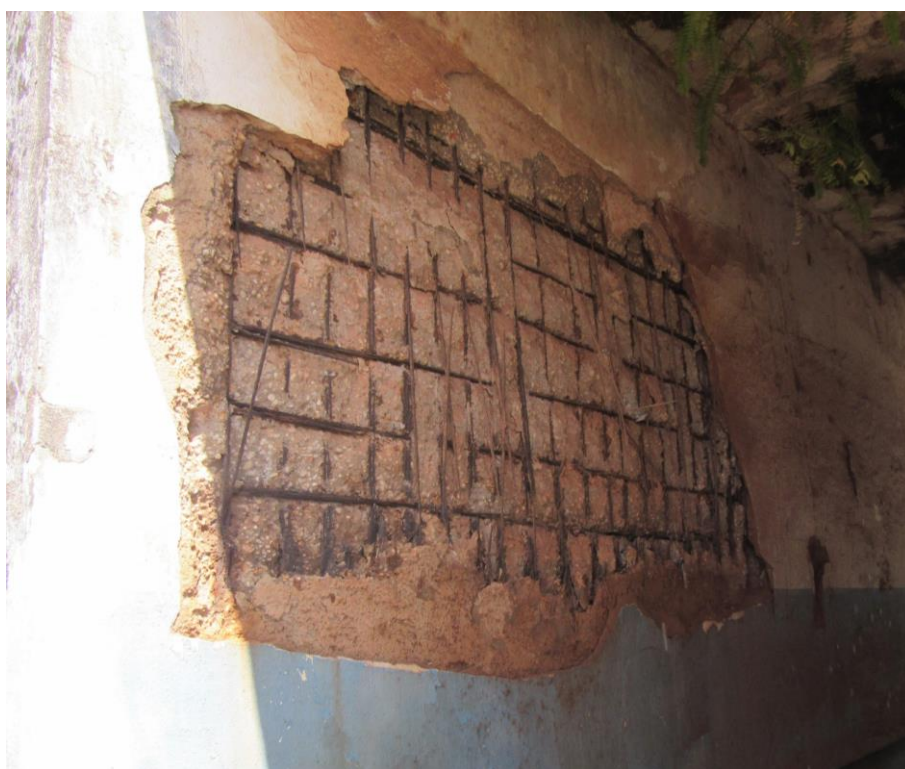
Figura 70. RAP2-02, armaduras expostas.
