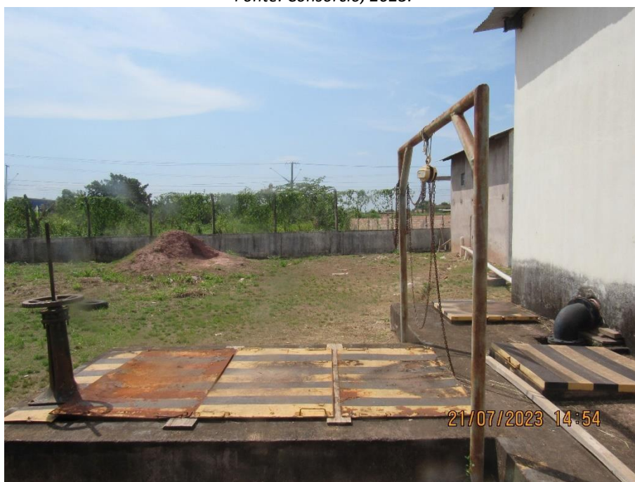
Figura 104. STM18-EEE, chegada do esgoto e coluna de sucção.
