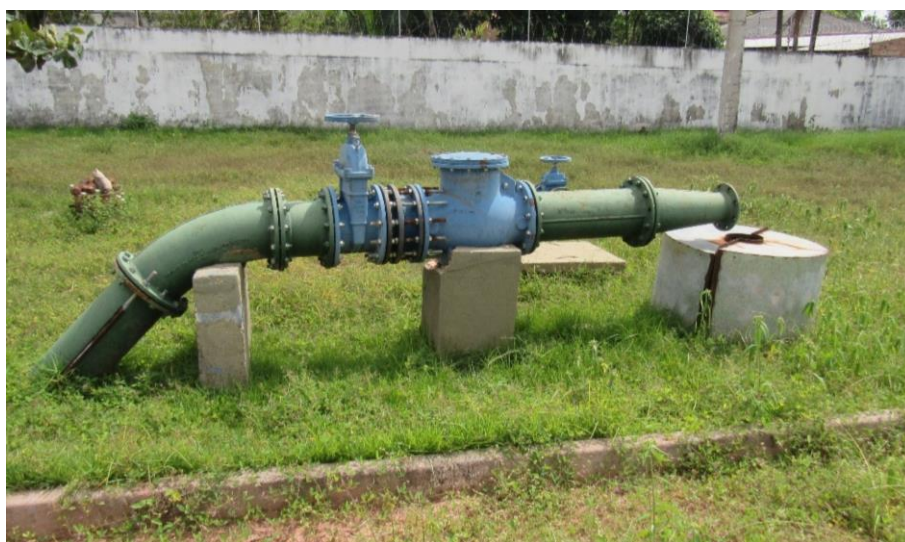
Figura 43. Captação – STM021 (inoperante).
