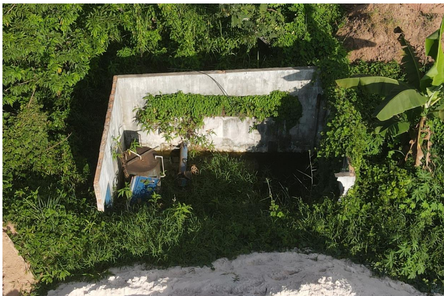
Figura 45. Captação – STM035 (inoperante).
