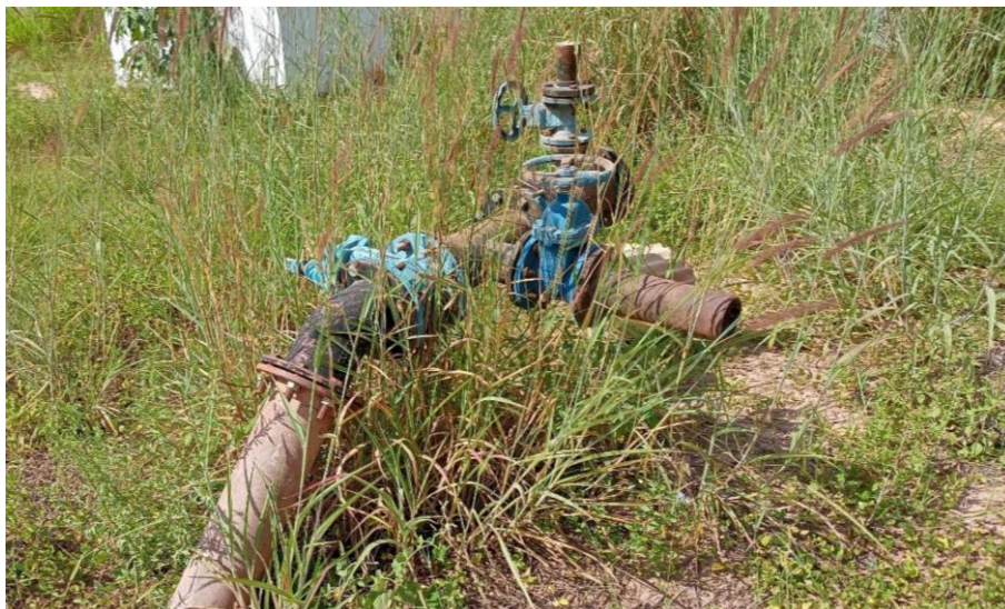
Figura 40. Captação – STM020 (inoperante).
