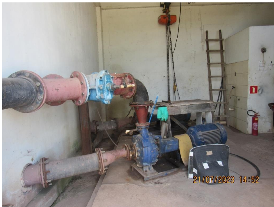
Figura 103. STM18-EEE, CMB's instalados.
