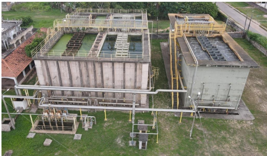
Figura 114. STM16-ETE Irurá, Módulos UBOX e vista superior do reator aeróbio.
