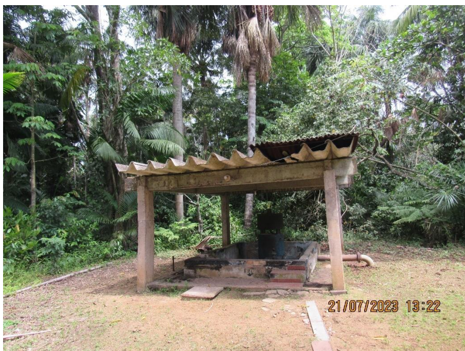
Figura 4. Captação – STM001, poço 02 (abrigo).
