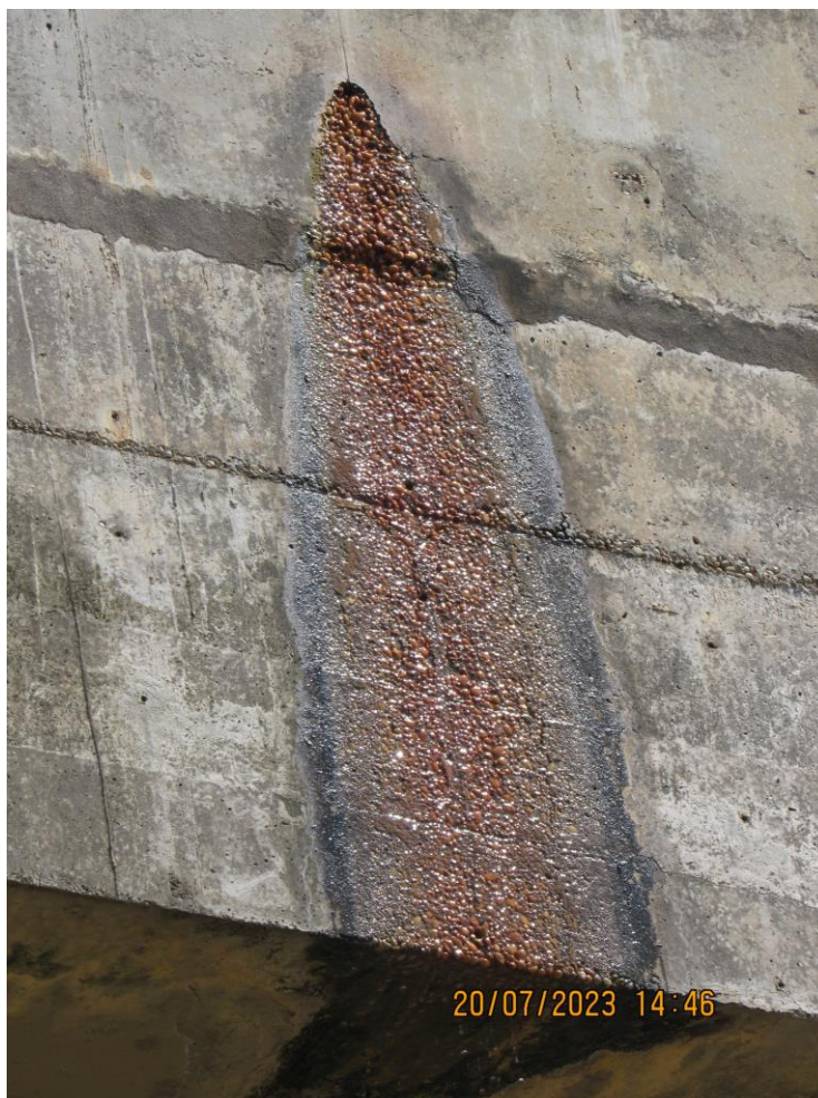
Figura 76. REL-07, vazamento na estrutura de concreto.
