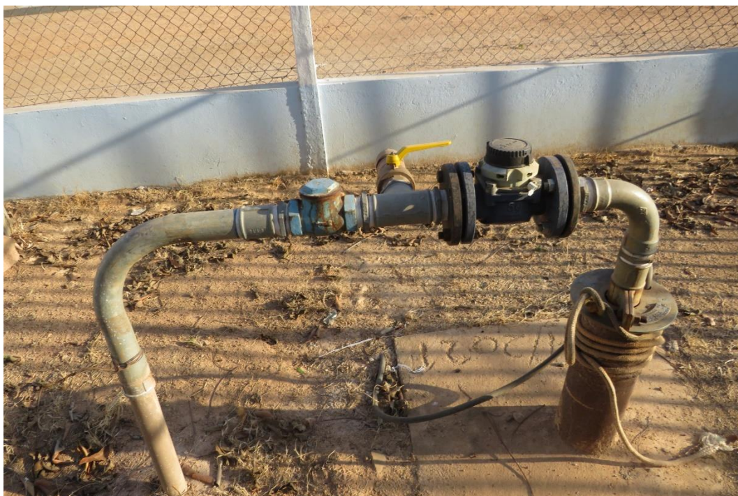
Figura 59. Captação de Água - CNA76 Fonte: Consórcio, 2023.
