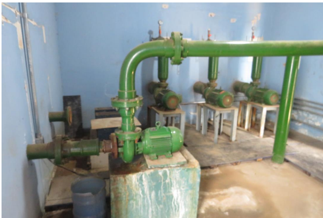
Figura 64. EEAT's de CN11, conjunto de motobombas.
