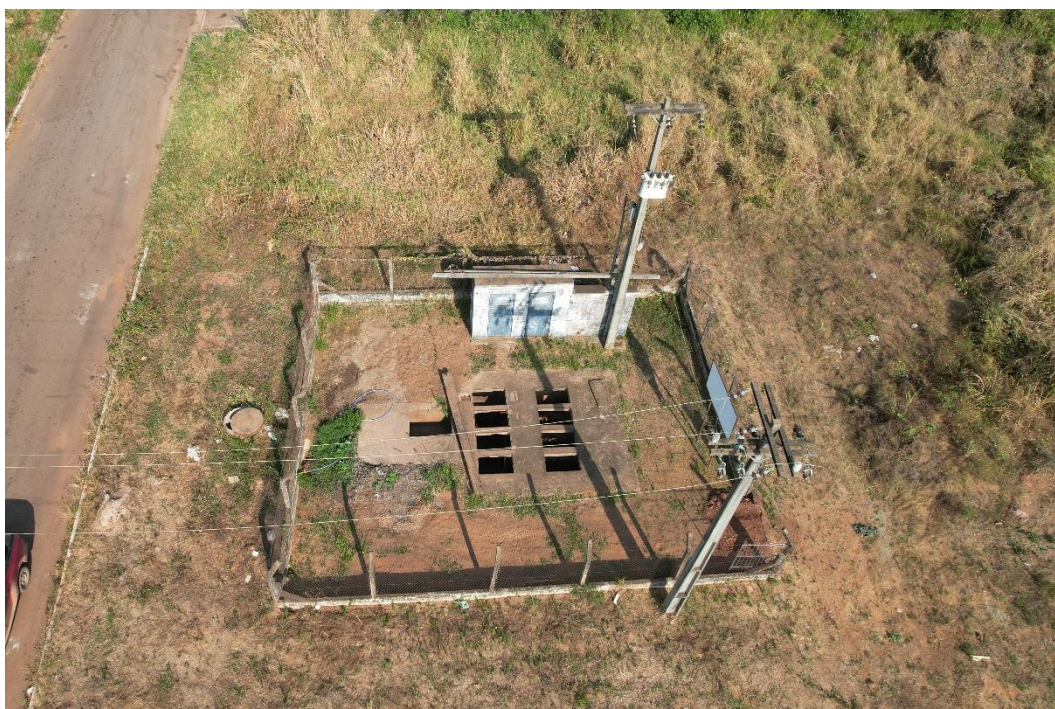
Figura 85. Estação Elevatória de Esgoto (CNA02 - EEEB), (panorâmica).
