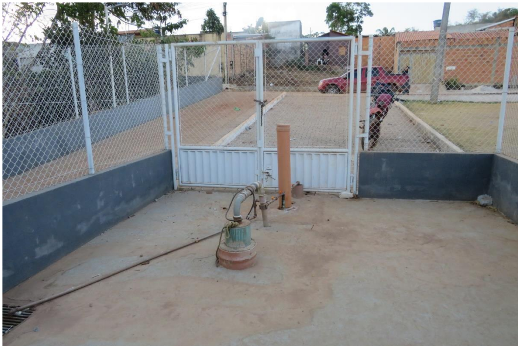
Figura 60. Captação de Água - CNA78 Fonte: Consórcio, 2023.
