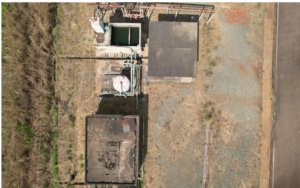
Figura 62. CNA50-ETA02-ETA- Estação de Tratamento de Água
