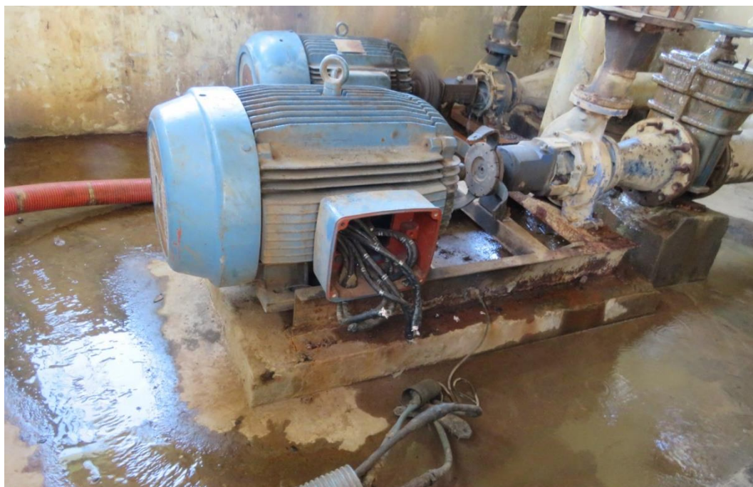
Figura 8. EEAT 01, conjunto de motobombas.
