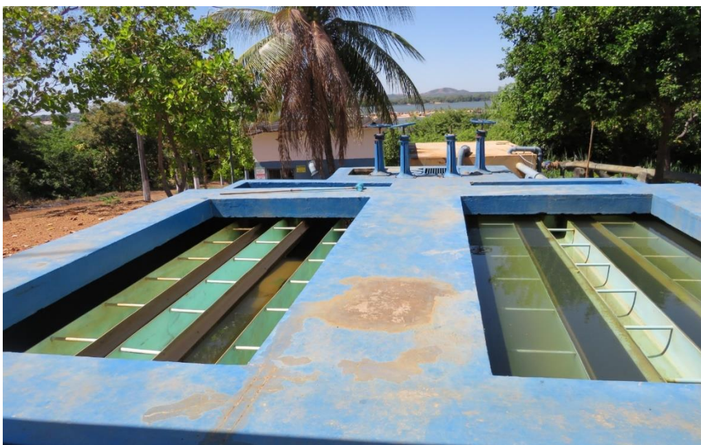
Figura 5. CNC01-ETA01, (Estação de Tratamento de Água).
