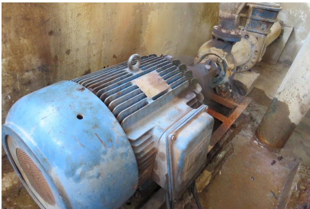
Figura 9. CNC01-EELF, (moto bomba de bombeamento da lavagem de filtros).
