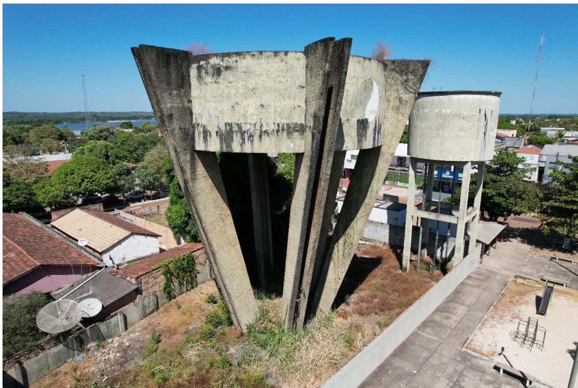
Figura 12. CNC03-REL01 e CNC03-REL02, Reservatórios elevados.
