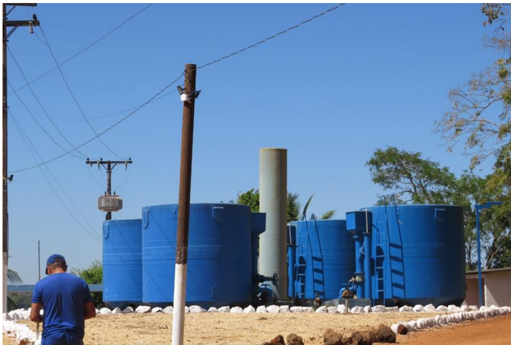
Figura 6. CNC01-ETA02, (Estação de Tratamento de Água).
