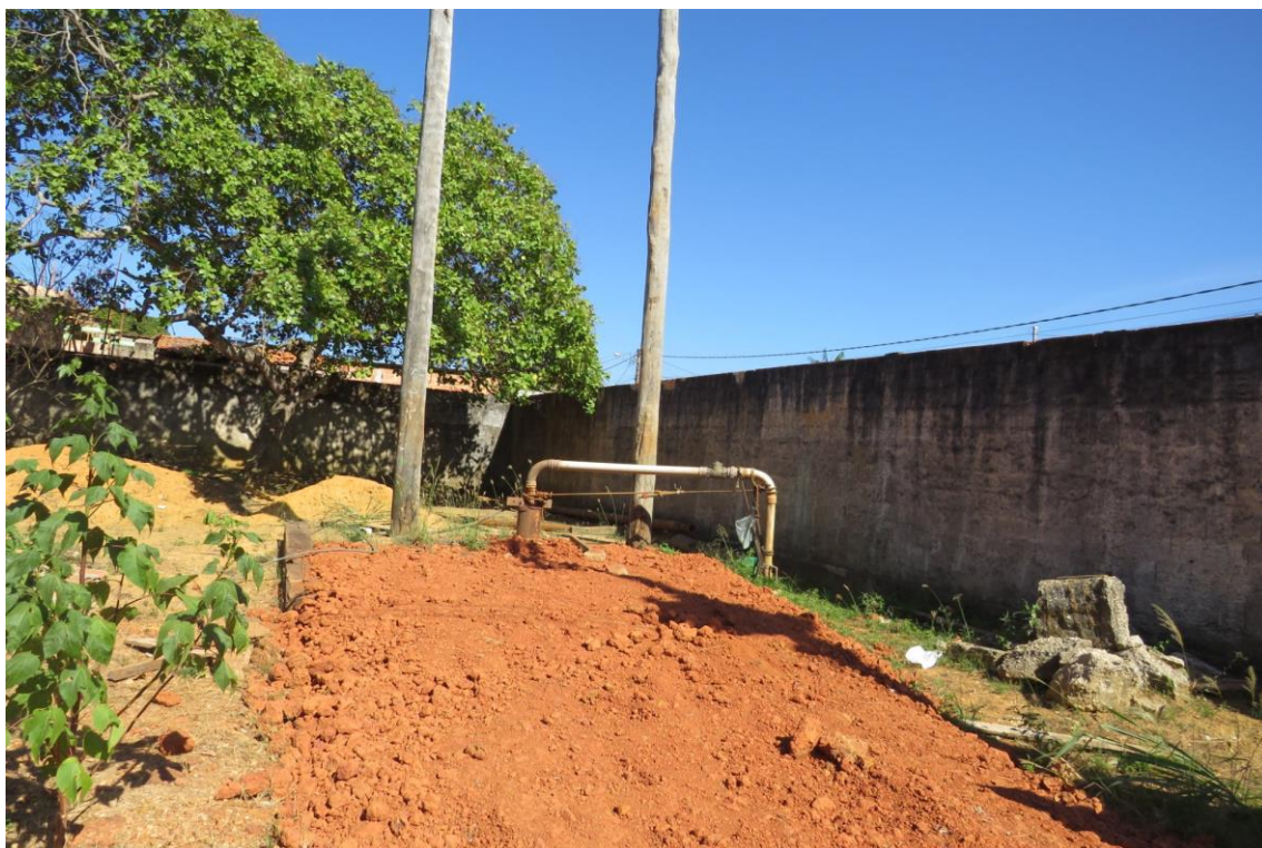
Figura 11. DOM07-CAPTAÇÃO, subterrâneo (poço tubular).
