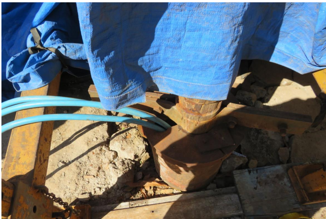
Figura 19. DOM16-CAPTAÇÃO, subterrâneo (poço tubular).
