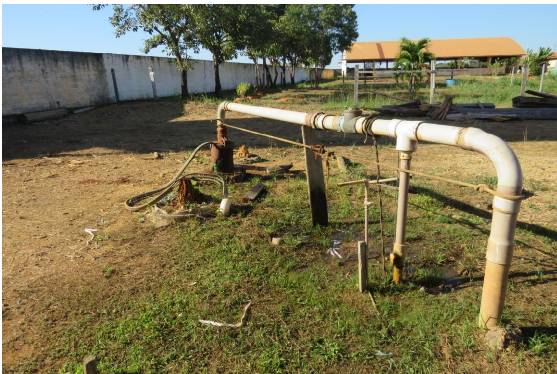
Figura 17. DOM14-CAPTAÇÃO, subterrâneo (poço tubular).
