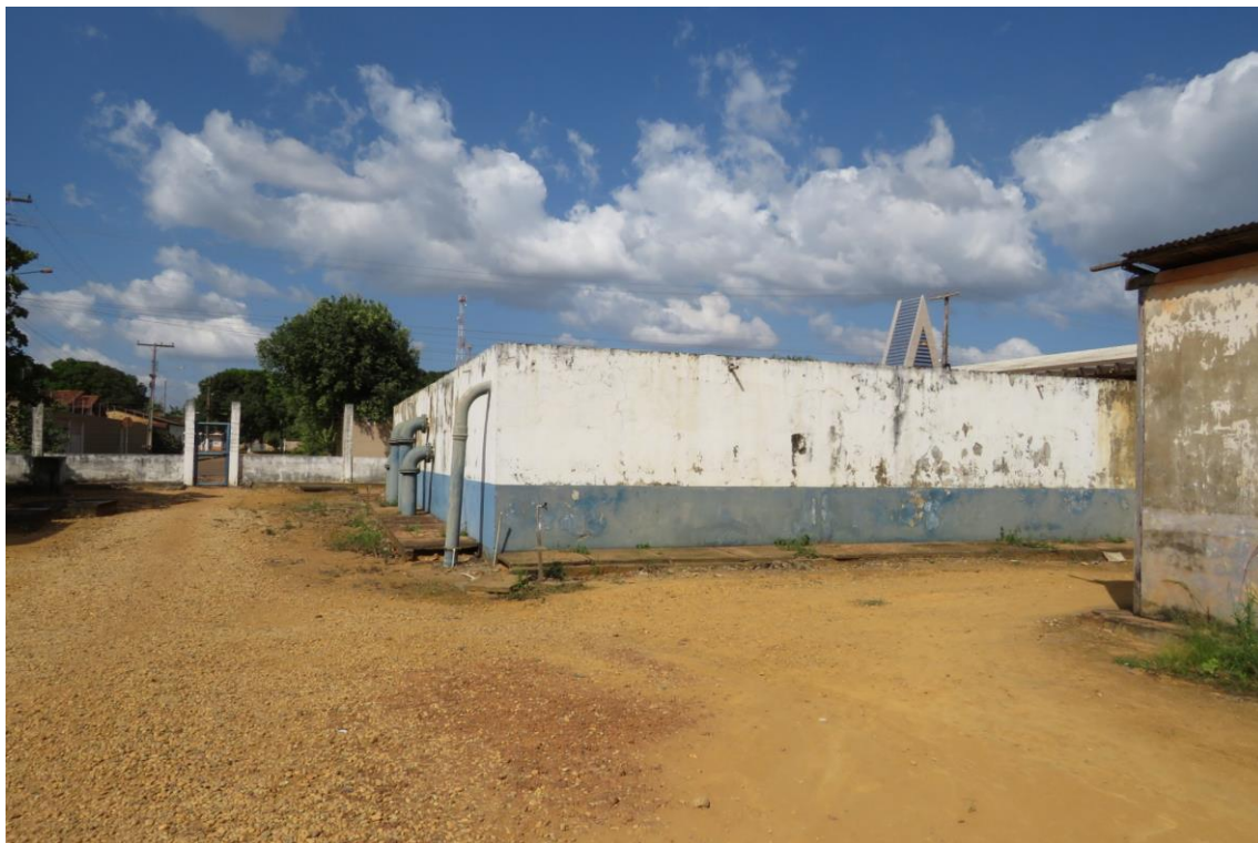
Figura 30. DOM02-RAP, (reservatório apoiado).
