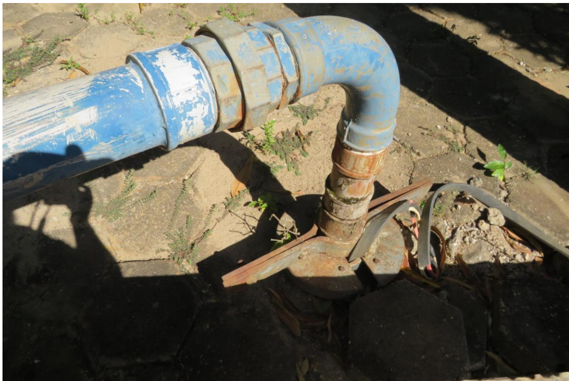
Figura 18. DOM15-CAPTAÇÃO, subterrâneo (poço tubular).
