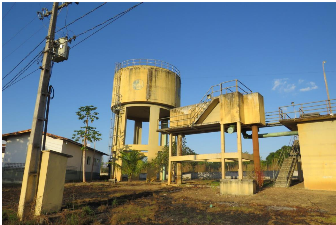
Figura 28. DOM01-REL, reservatório elevado (lavagem de filtros).
