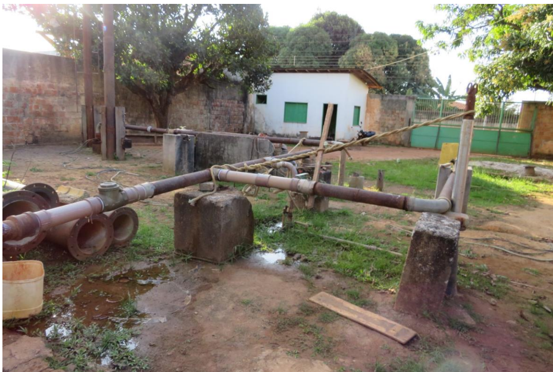
Figura 15. DOM12-CAPTAÇÃO, subterrâneo (poço tubular).
