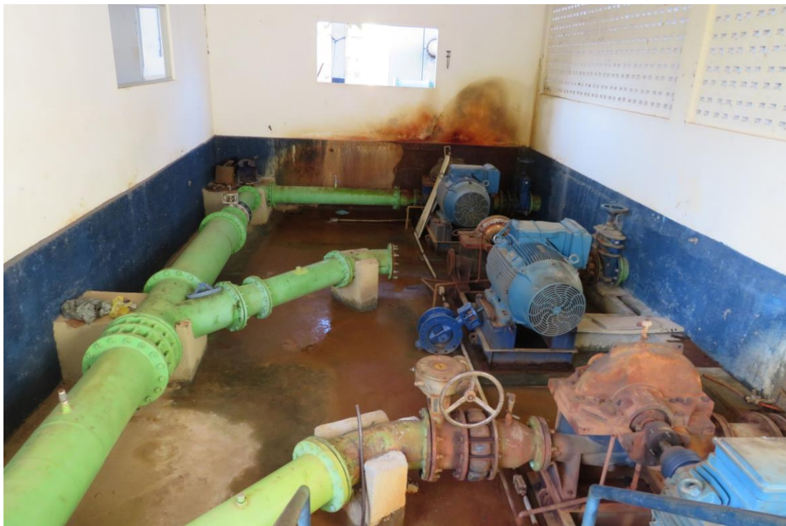
Figura 24. DOM01-EEAT, Estação Elevatória de Água Tratada (conjunto de Motobombas).
