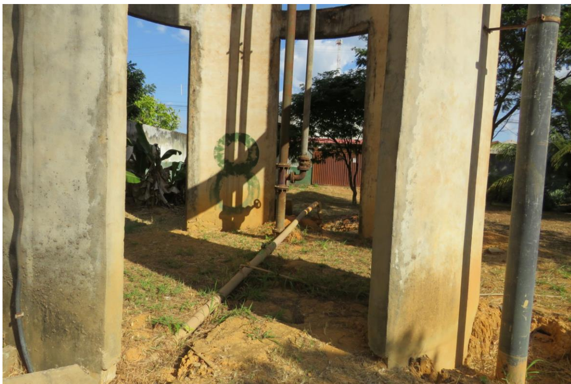
Figura 7. DOM03-CAPTAÇÃO, subterrâneo (poço tubular).
