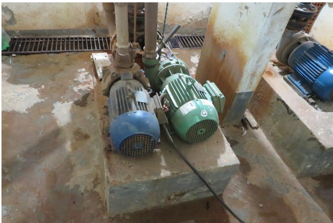
Figura 27. DOM08-EEAB, Estação Elevatória de Água Bruta (conjunto de motobombas).
