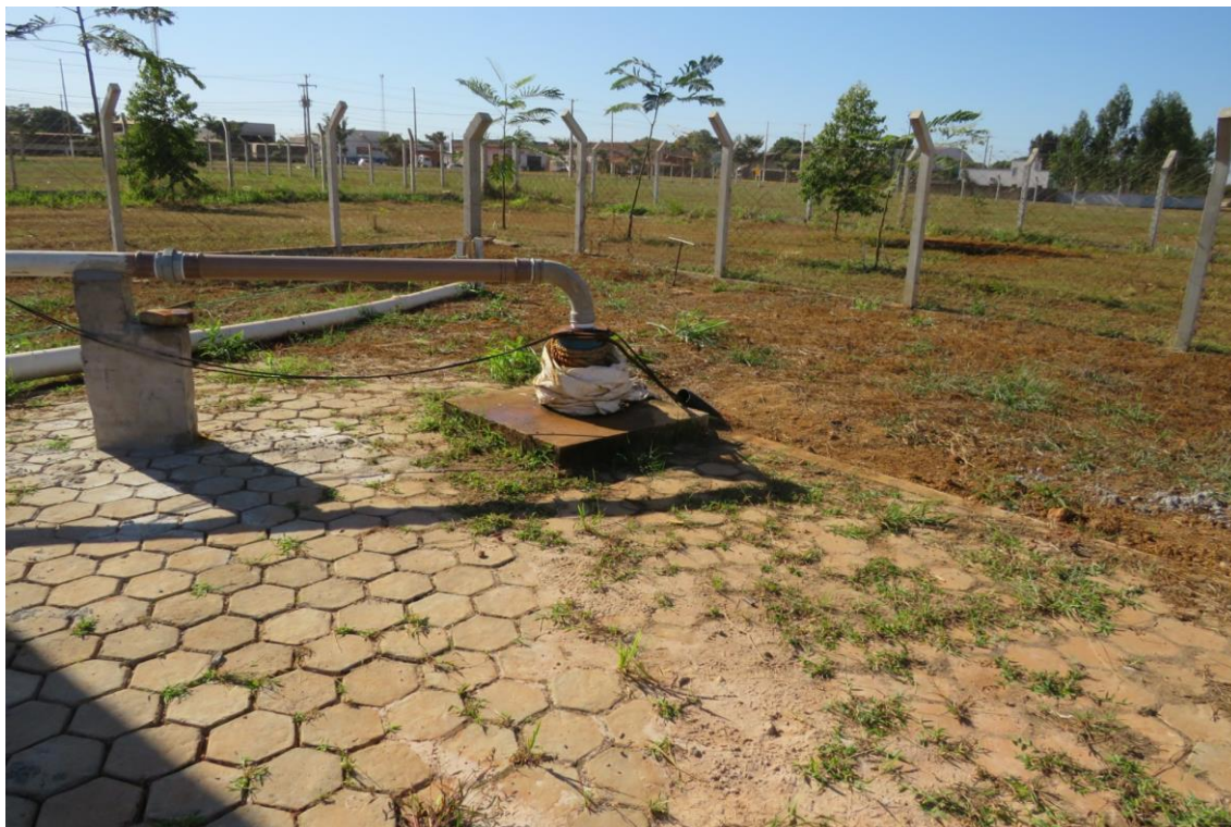
Figura 20. DOM18-CAPTAÇÃO, subterrâneo (poço tubular).
