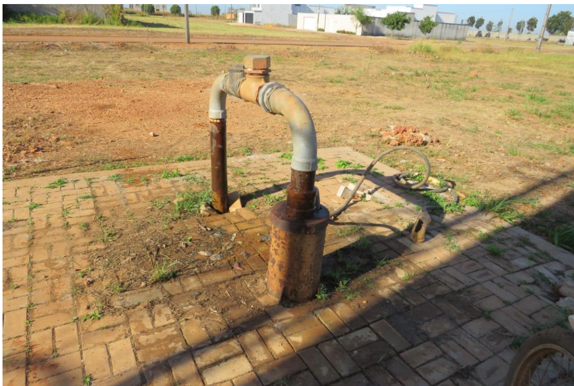
Figura 14. DOM11-CAPTAÇÃO, subterrâneo (poço tubular).
