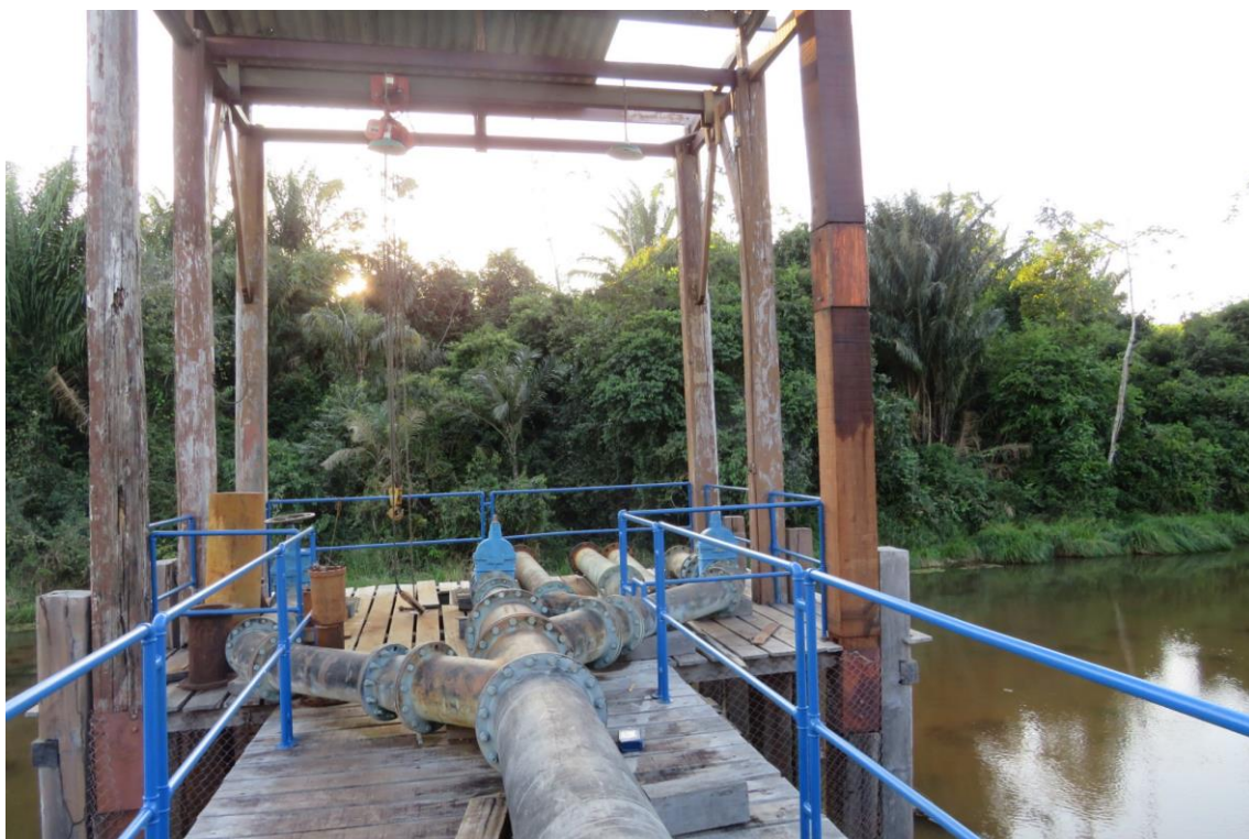
Figura 5. DOM01-CAPTAÇÃO, superficial (tomada D'água).
