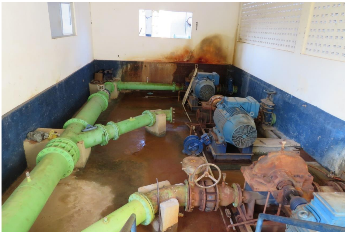
Figura 25. DOM01-EELF, Estação Elevatória de Água Tratada (lavagem de filtros).
