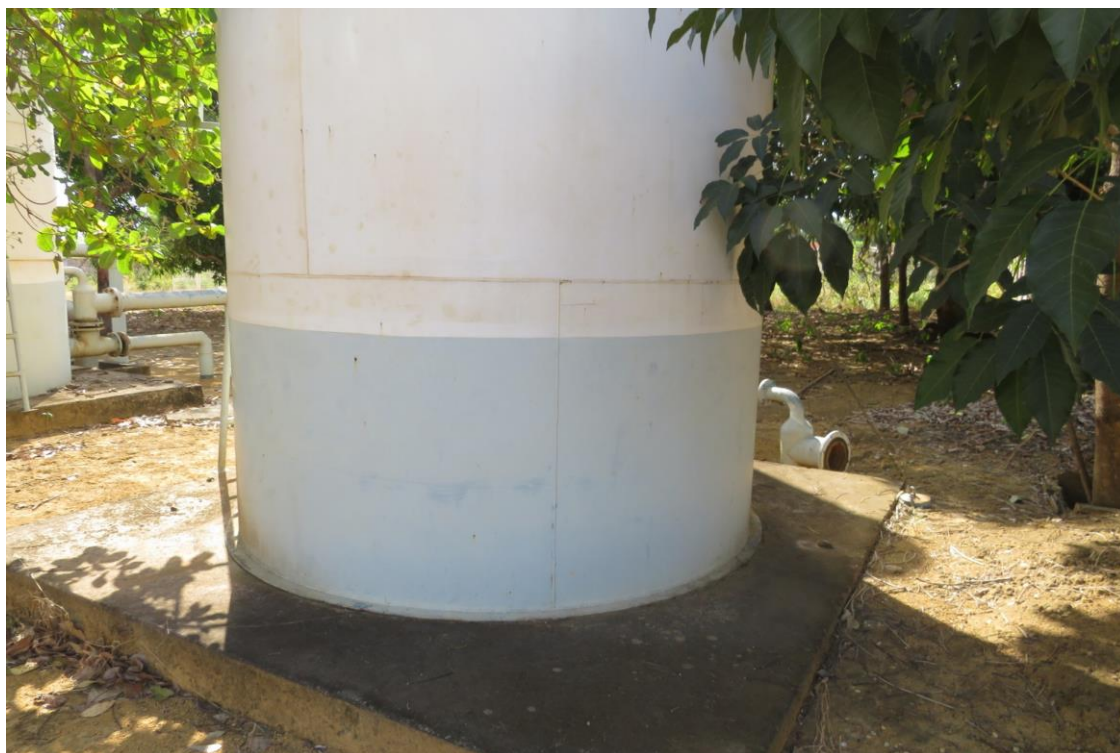
Figura 23. DOM02-ETA, Estação de Tratamento de Água (compacta).
