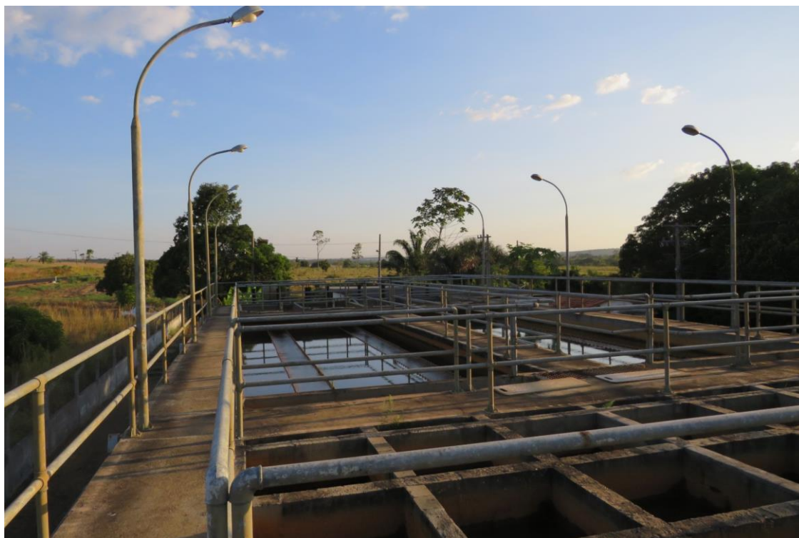
Figura 22. DOM01-ETA, Estação de Tratamento de Água (convencional).
