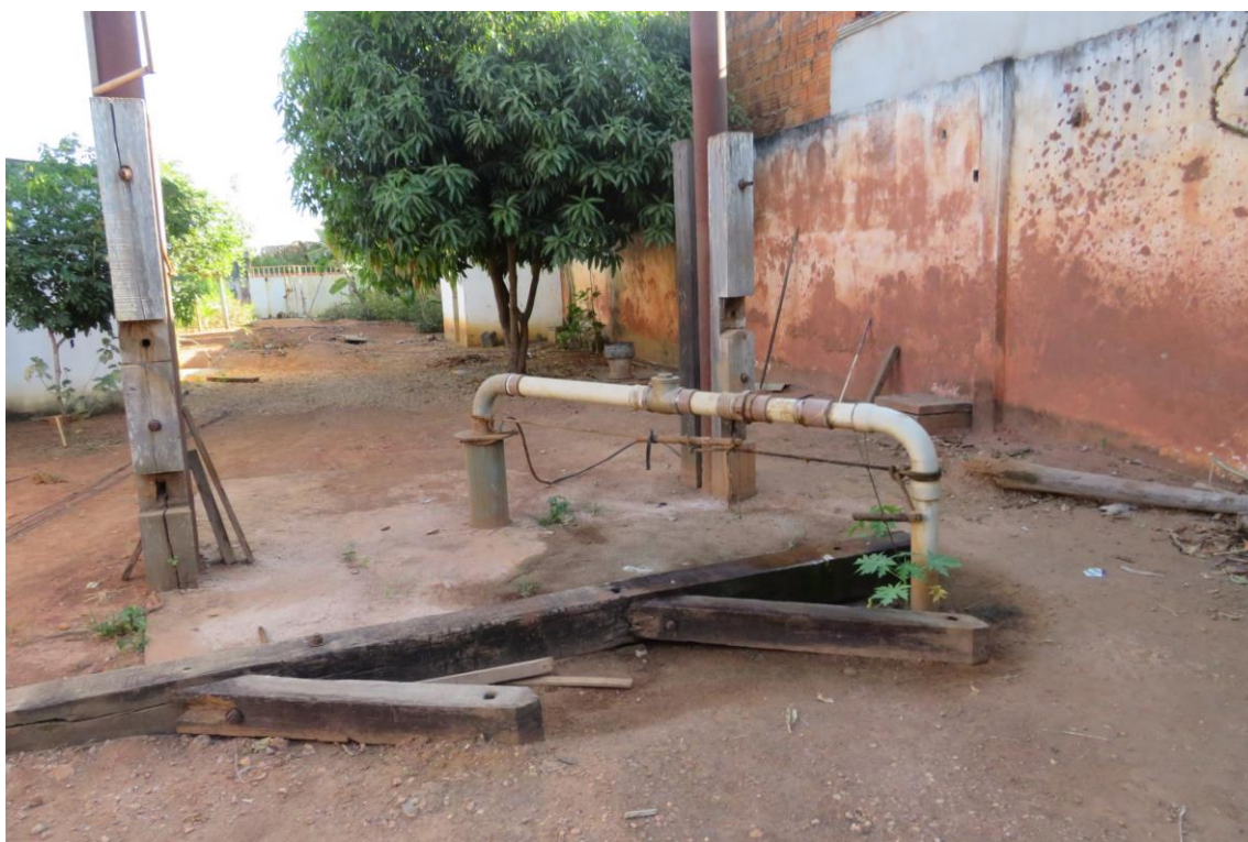
Figura 9. DOM05-CAPTAÇÃO, subterrâneo (poço tubular).
