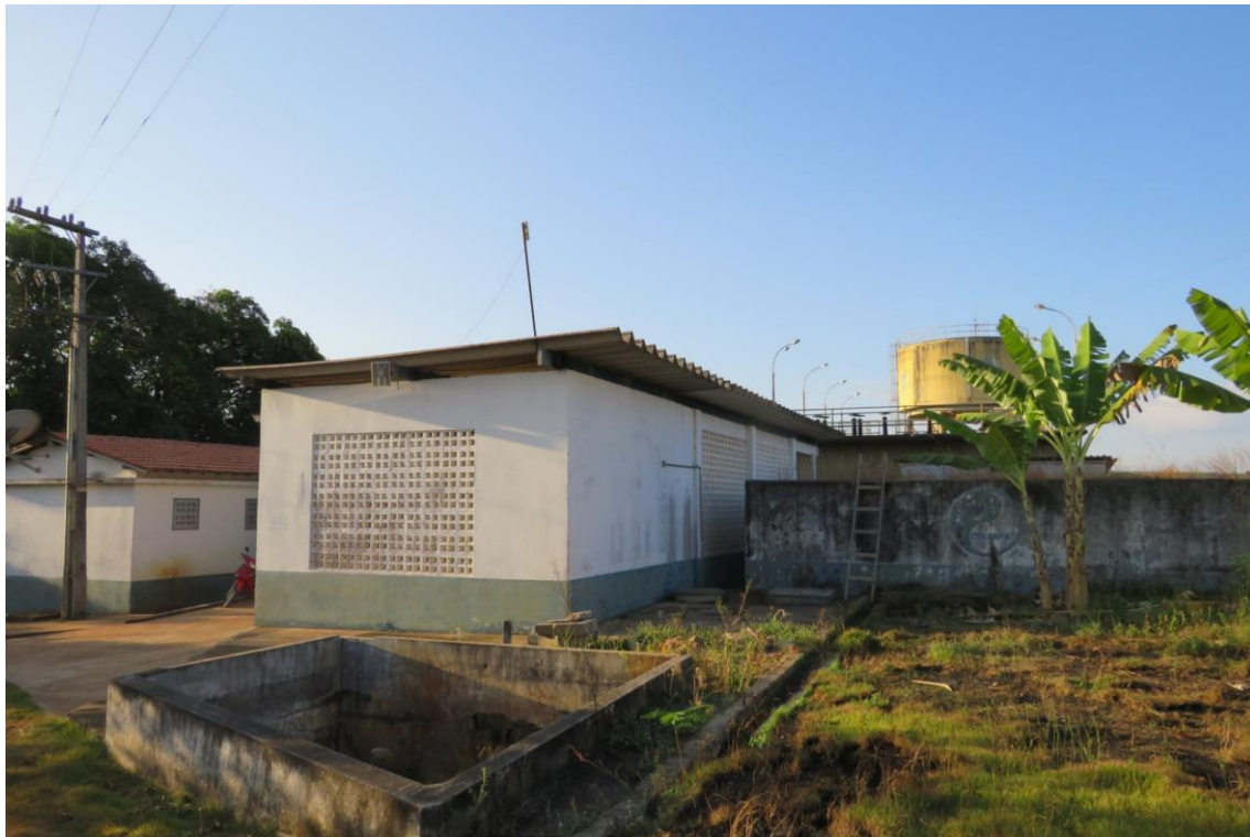
Figura 29. DOM01-RAP, (reservatório apoiado)
