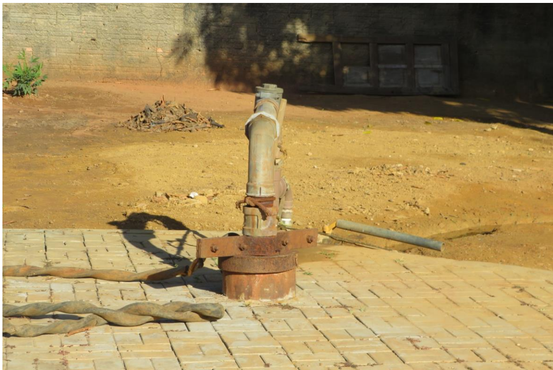
Figura 10. DOM06-CAPTAÇÃO, subterrâneo (poço tubular).
