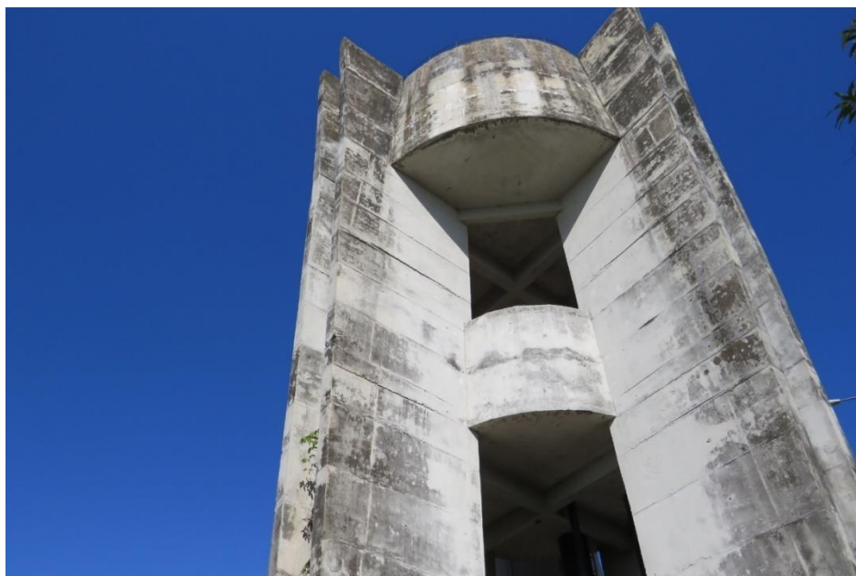
Figura 12. MRB01-REL, reservatório elevado. (lavagem de filtros)
