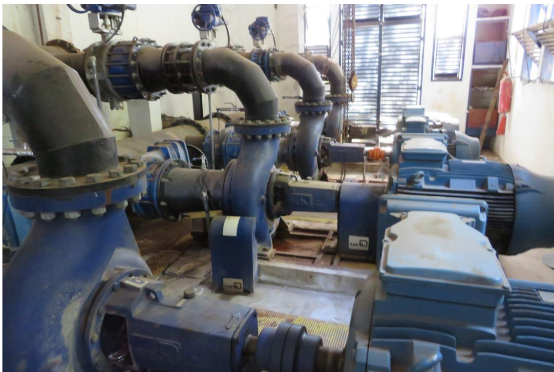
Figura 10. MRB03-EEAT Cidade Nova, conjunto de motobombas.
