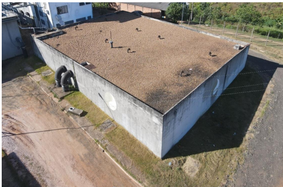
Figura 13. MRB01-RAP, reservatório Apoiado. (tanque de contato)
