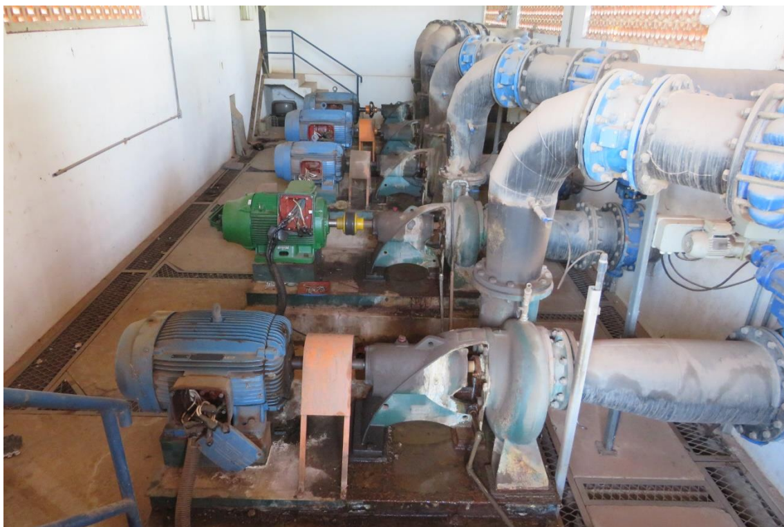
Figura 11. MRB04- EEAT Folha 29, conjunto de motobombas.
