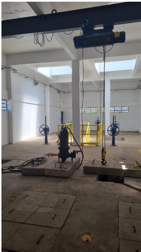
Figura 32. MRB11- Barrilete da Estação Elevatória de Esgoto (EEE – GROTA). Fonte: Consórcio, 2023
