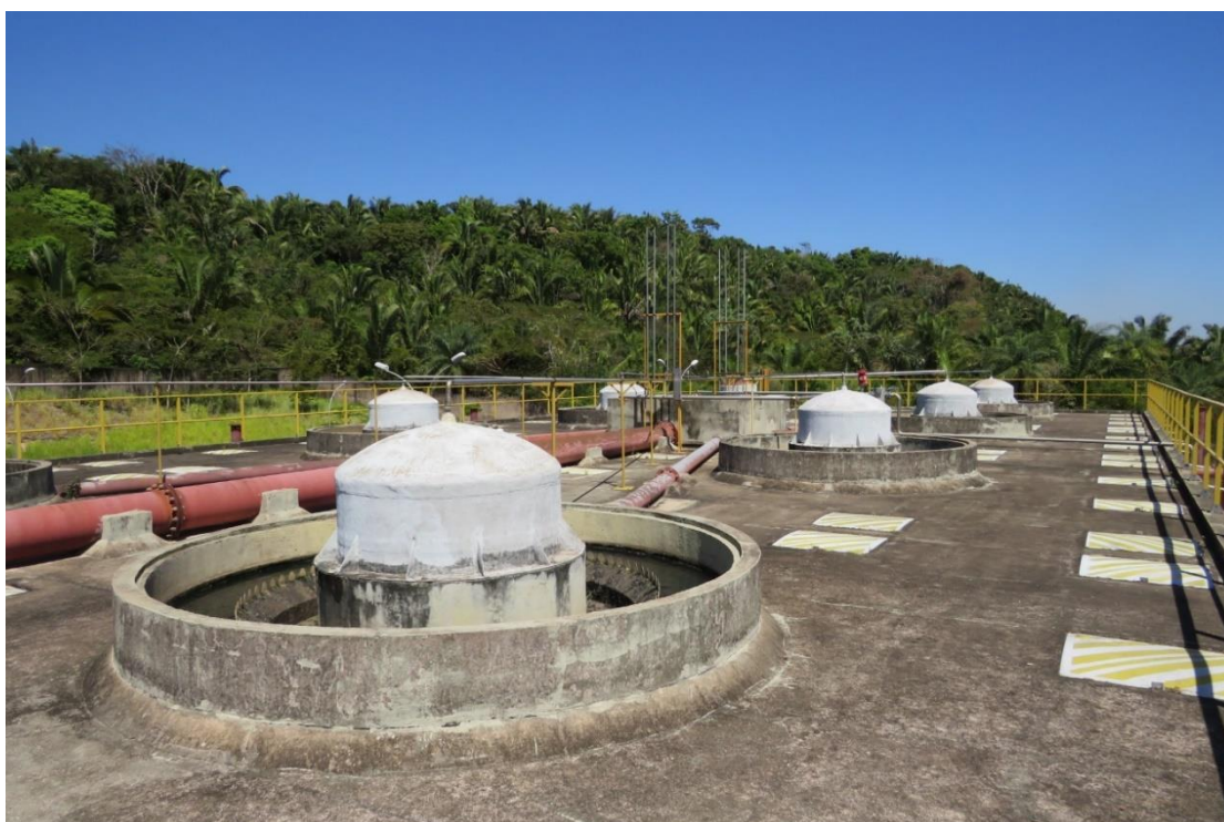
Figura 37. MRB10 – Reator Anaeróbico da Estação de Tratamento de Esgoto (ETE).
