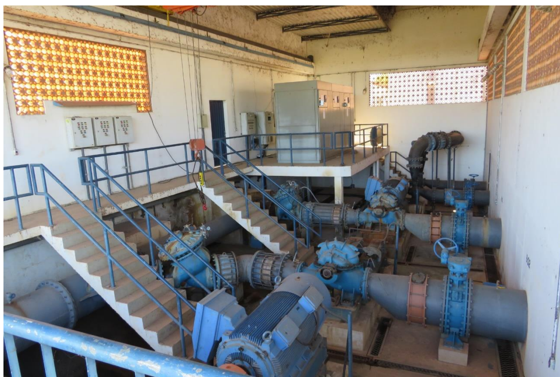
Figura 8. MRB01- EEAT, conjunto de motobombas.
