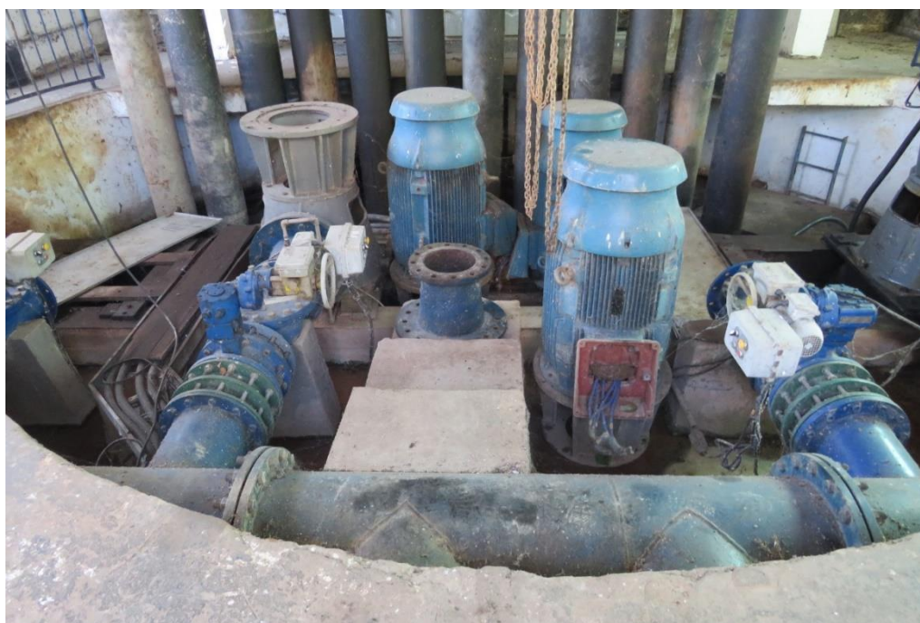
Figura 4. MRB01-CAPTAÇÃO-02, Poço tubular.
