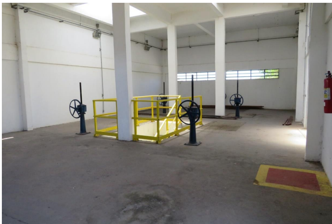
Figura 34. MRB12-Barrilete da Estação Elevatória de Esgoto (EEE - ITACAIUNAS).
