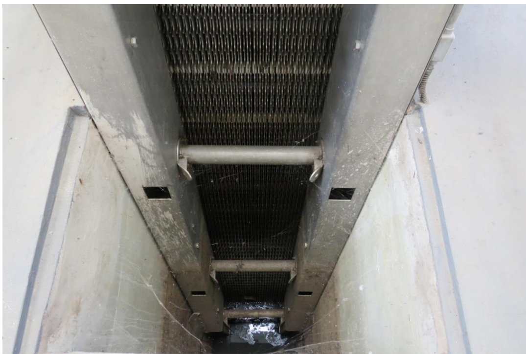
Figura 26. MRB06- Sistema de Gradeamento Estação Elevatória de Esgoto (EEE – A) Fonte: Consórcio, 2023
