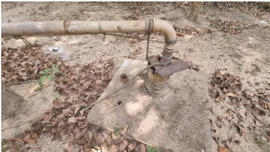
Figura 21. RON12-CAPTAÇÃO002, captação subterrânea (bairro Jaderlândia/Matadouro).
