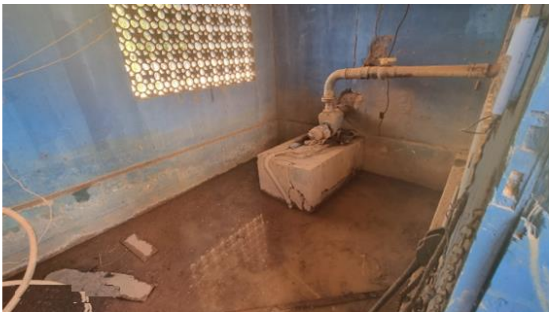
Figura 29. RON12-EEAT, conjunto de motobombas, sem bomba reserva.
