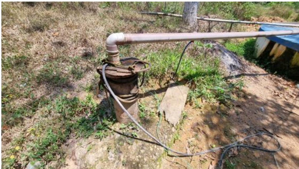
Figura 5. RON02-CAPTAÇÃO001, captação subterrânea (bairro Centro).
