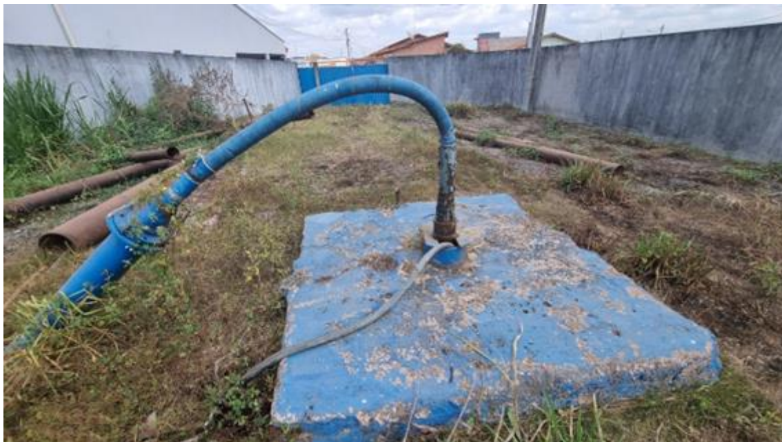
Figura 15. RON10-CAPTAÇÃO002, captação subterrânea (bairro Recanto Azul/Alto Recalque).
