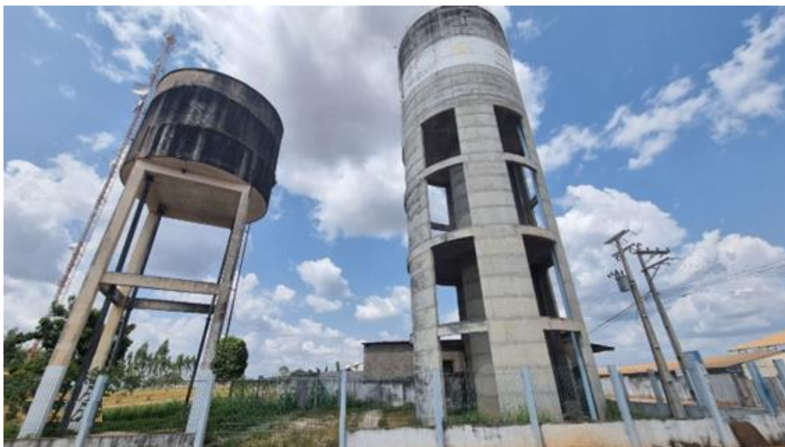
Figura 36. Reservatórios elevados (RON09-REL01 e RON09-REL02, respectivamente, da esquerda para a direita), estruturas.
