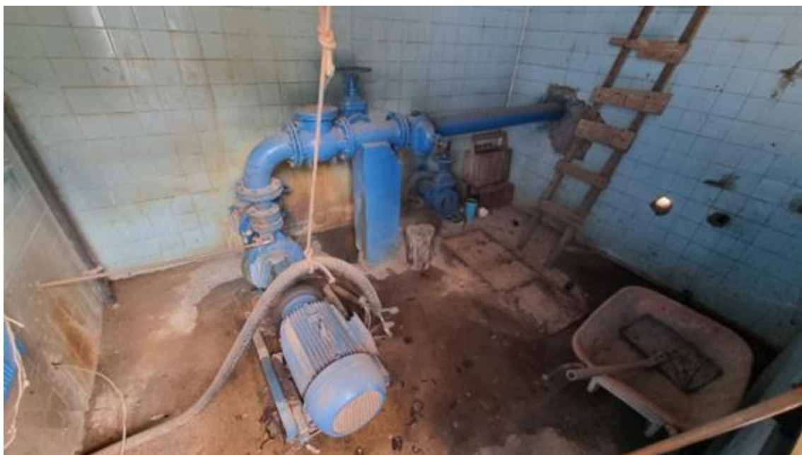
Figura 27. RON10-EEAT01, conjunto de motobombas, sem bomba reserva. Fonte: Consórcio, 2023.
