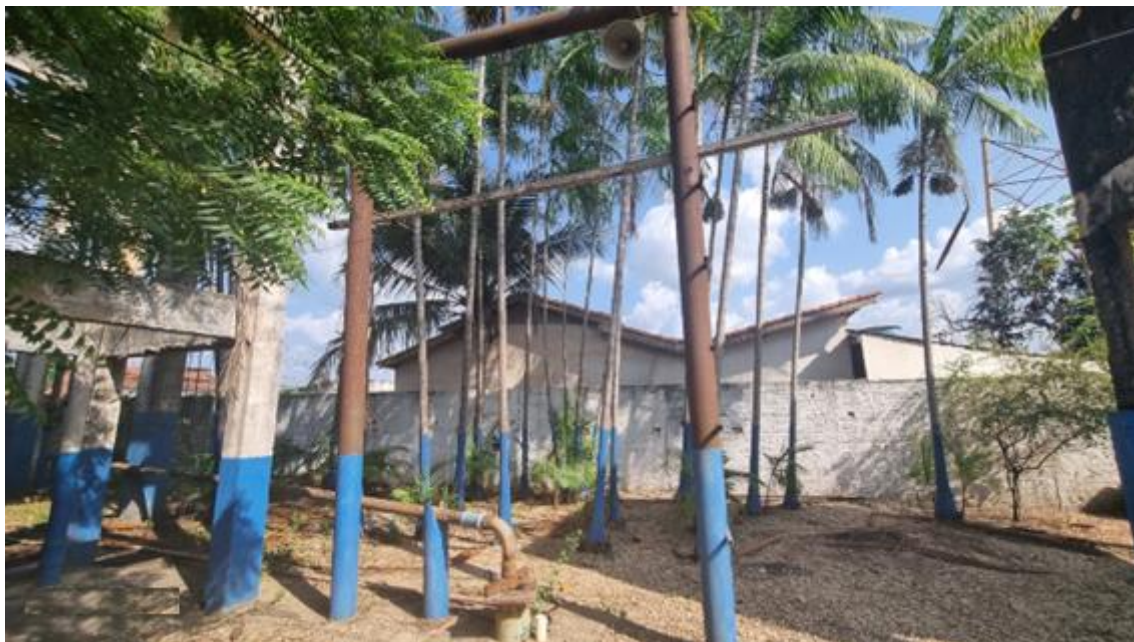
Figura 23. RON13-CAPTAÇÃO, captação subterrânea (bairro Jaderlândia/Lucíulo). Fonte: Consórcio, 2023.
