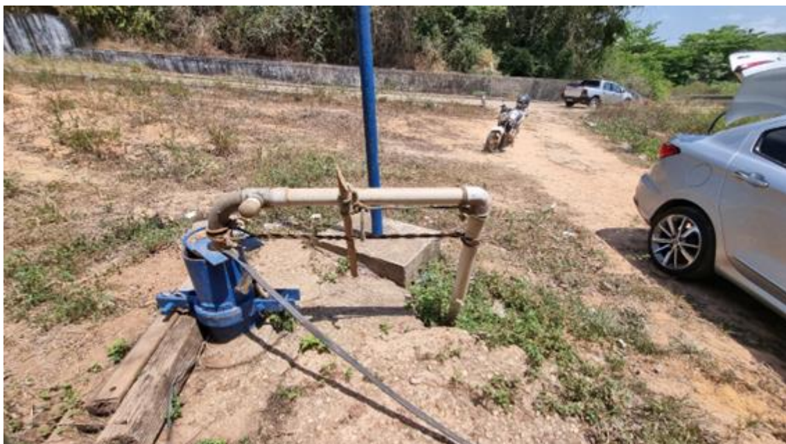
Figura 6. RON02-CAPTAÇÃO002, captação subterrânea (bairro Centro).
