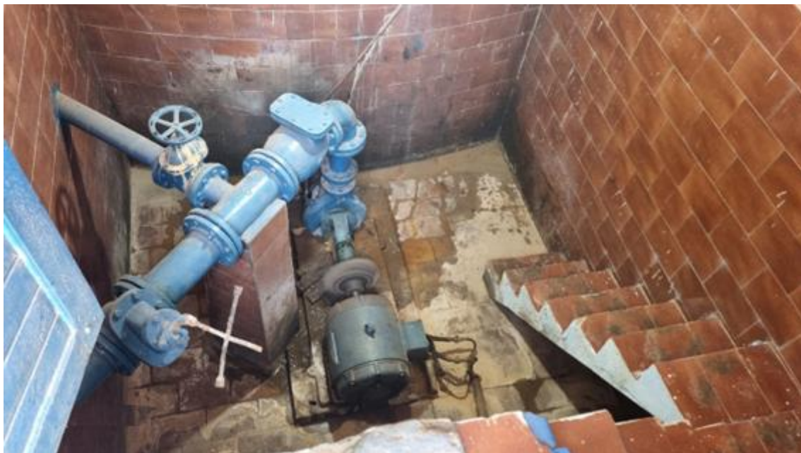
Figura 25. RON01-EEAT, conjunto de motobomba, sem bomba reserva. Fonte: Consórcio, 2023.
