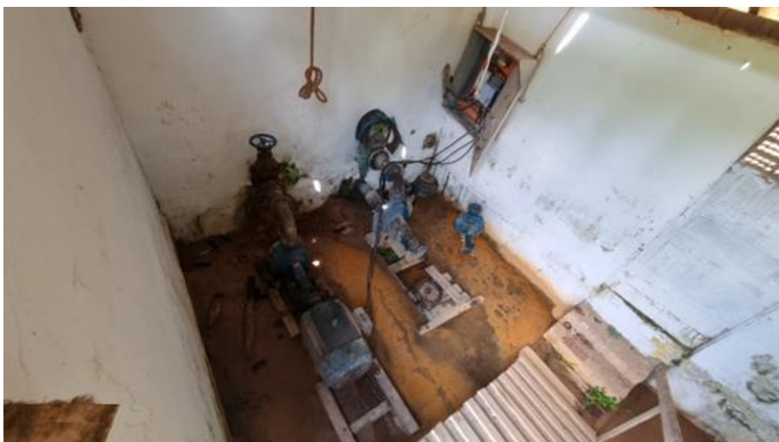
Figura 26. RON02-EEAT, conjunto de motobombas. Fonte: Consórcio, 2023.
