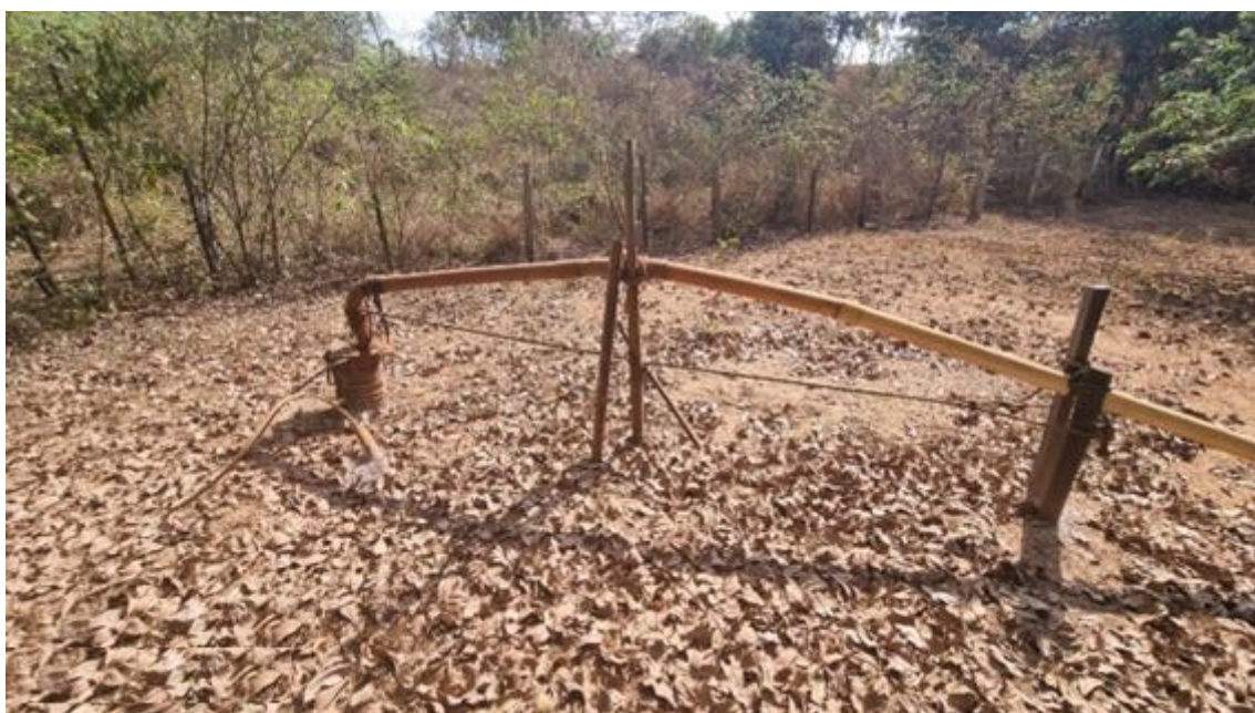
Figura 20. RON12-CAPTAÇÃO001, captação subterrânea (bairro Jaderlândia/Matadouro).
