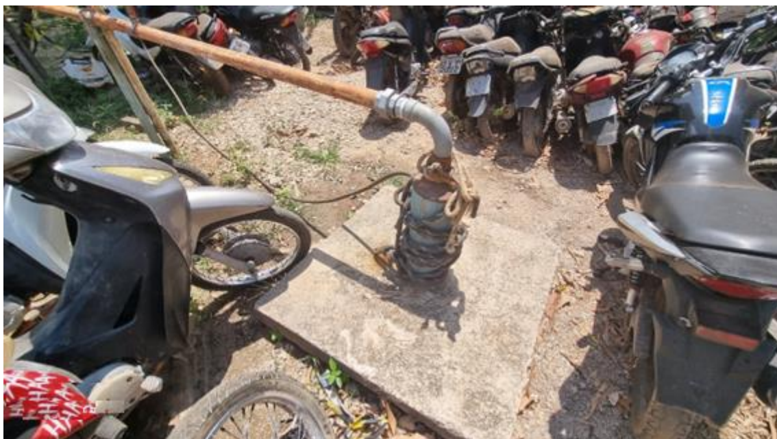
Figura 8. RON04-CAPTAÇÃO, captação subterrânea (bairro João Miranda/Demutran). Fonte: Consórcio, 2023.
