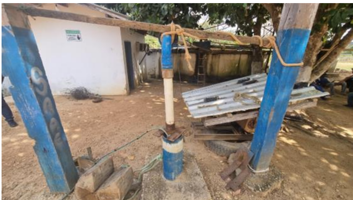
Figura 16. RON11-CAPTAÇÃO001, captação subterrânea (bairro Jaderlândia/Baixo Recalque).
