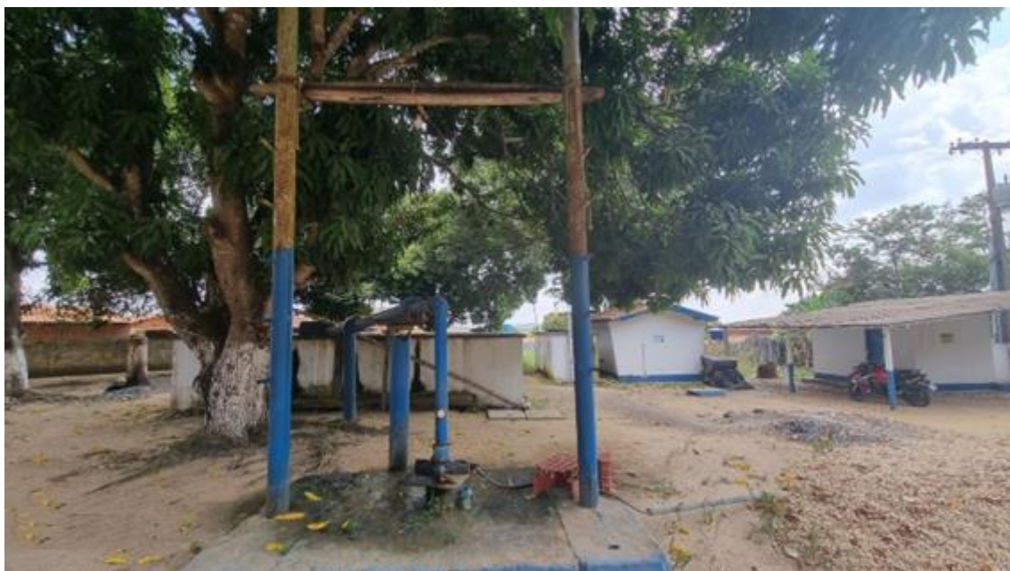
Figura 14. RON10-CAPTAÇÃO001, captação subterrânea (bairro Recanto Azul/Alto Recalque). Fonte: Consórcio, 2023.
