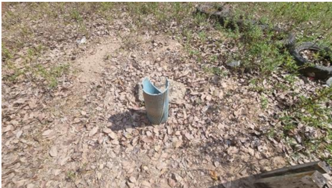
Figura 19. RON11-CAPTAÇÃO004 (desativado), captação subterrânea (bairro Jaderlândia/Baixo Recalque).
