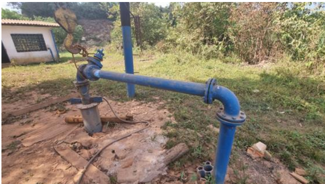
Figura 22. RON12-CAPTAÇÃO003, captação subterrânea (bairro Jaderlândia/Matadouro).
