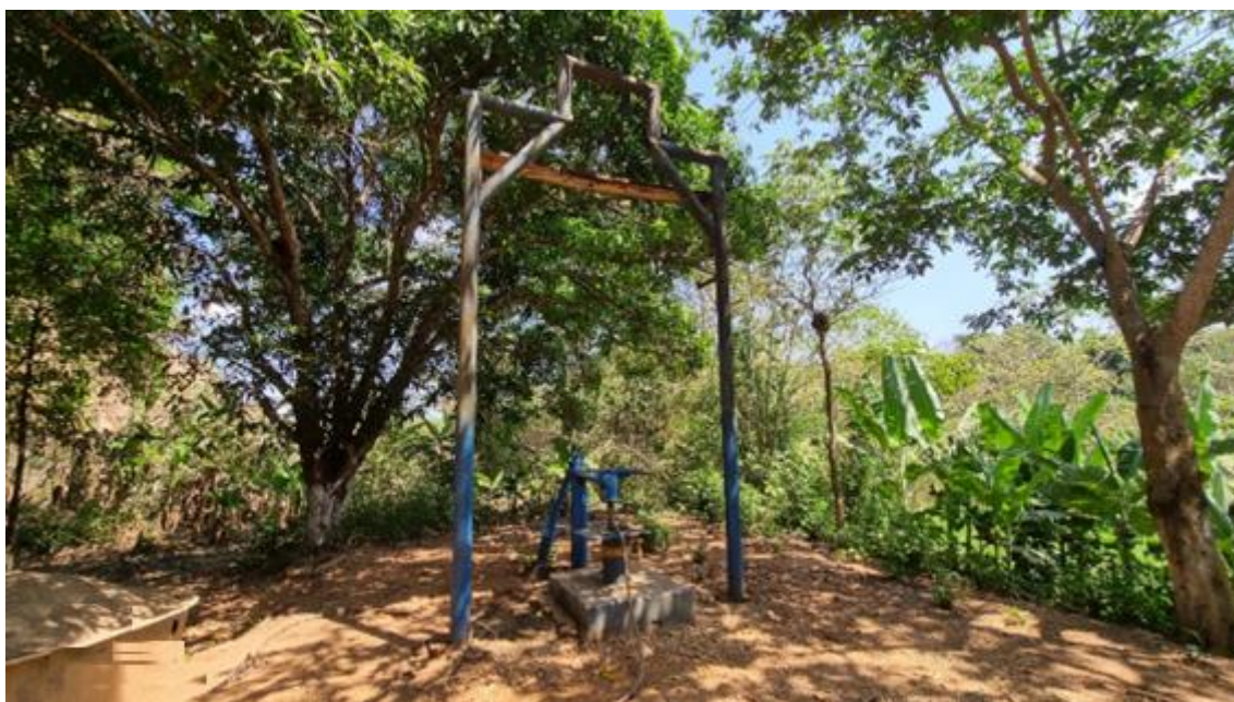
Figura 4. RON01-CAPTAÇÃO002, captação subterrânea (bairro Centro).
