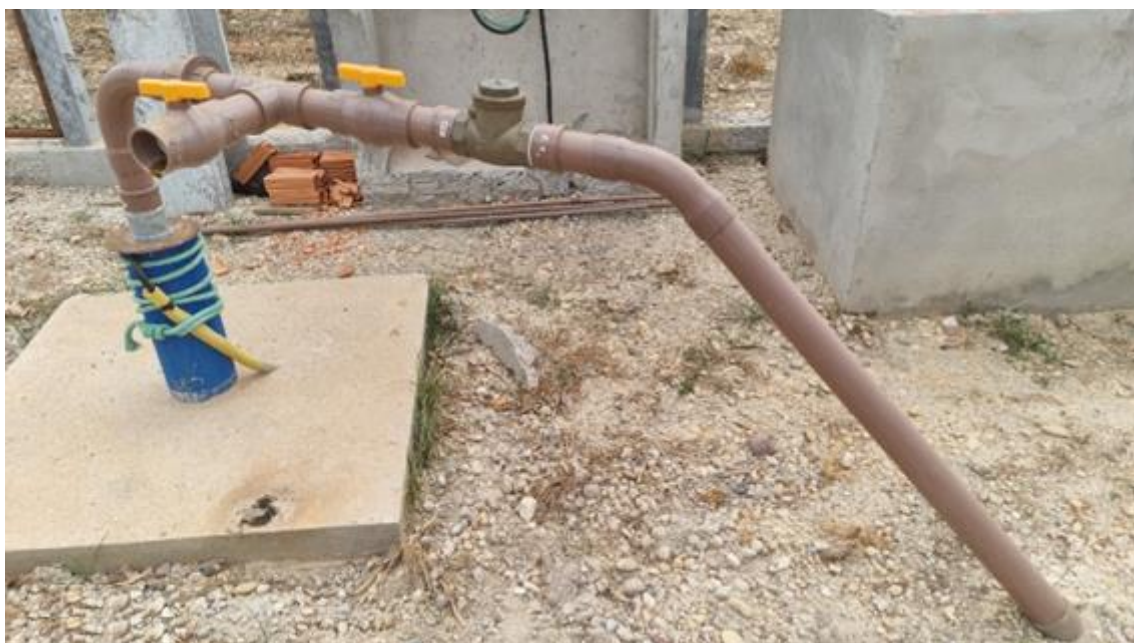
Figura 12. RON08-CAPTAÇÃO (em implantação), captação subterrânea (bairro Gusmão).
