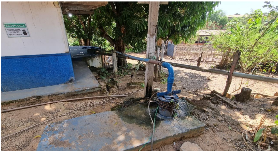
Figura 3. RON01-CAPTAÇÃO001, captação subterrânea (bairro Centro).
