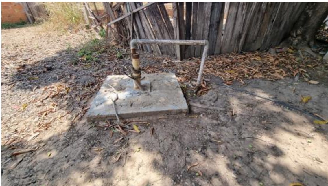
Figura 7. RON03-CAPTAÇÃO, captação subterrânea (bairro Nova Rondon). Fonte: Consórcio, 2023.
