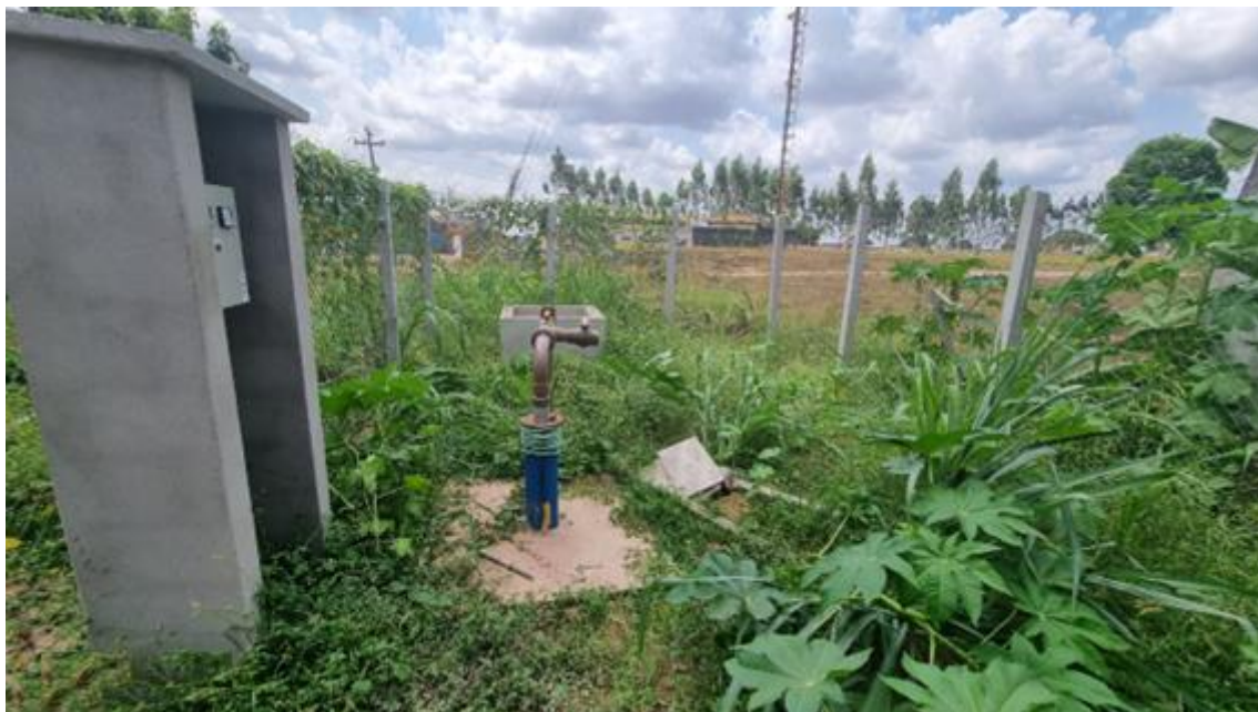
Figura 13. RON09-CAPTAÇÃO, captação subterrânea (bairro Novo Horizonte). Fonte: Consórcio, 2023.
