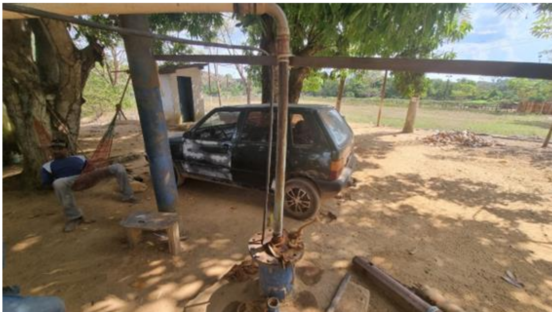
Figura 17. RON11-CAPTAÇÃO002, captação subterrânea (bairro Jaderlândia/Baixo Recalque).
