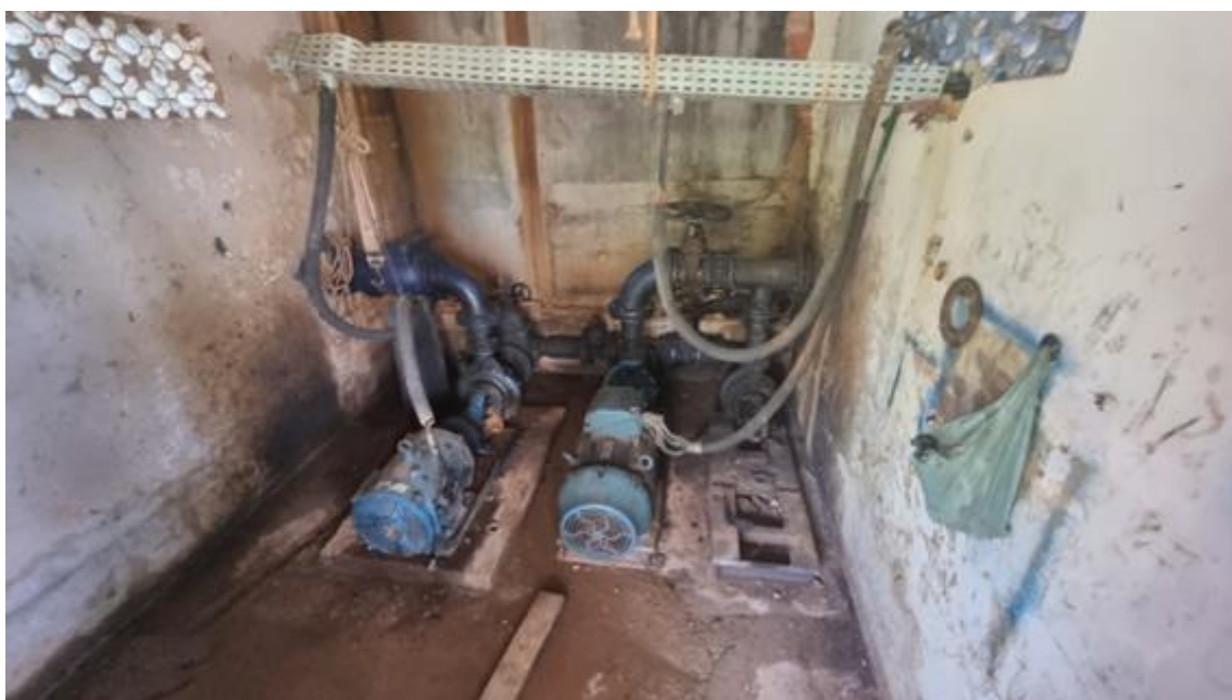
Figura 28. RON11-EEAT01 e RON11-EEAT02, conjuntos de motobombas, sem bombas reservas. Fonte: Consórcio, 2023.
