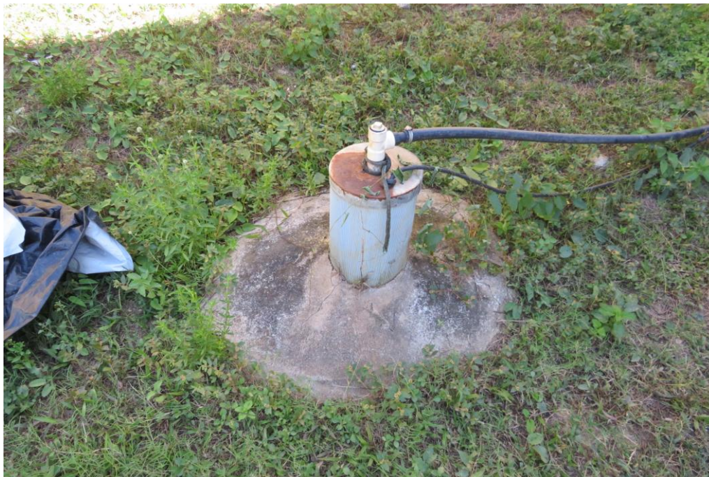
Figura 5. Captação – SFX03, poço tubular.
