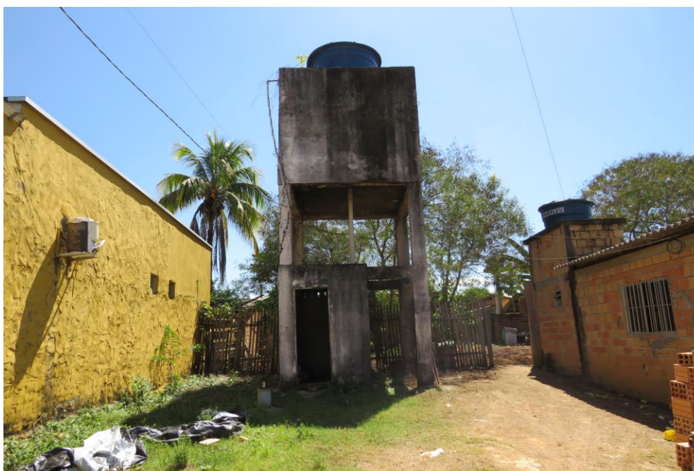
Figura 16. REL – SFX03, estrutura (vista frontal).
