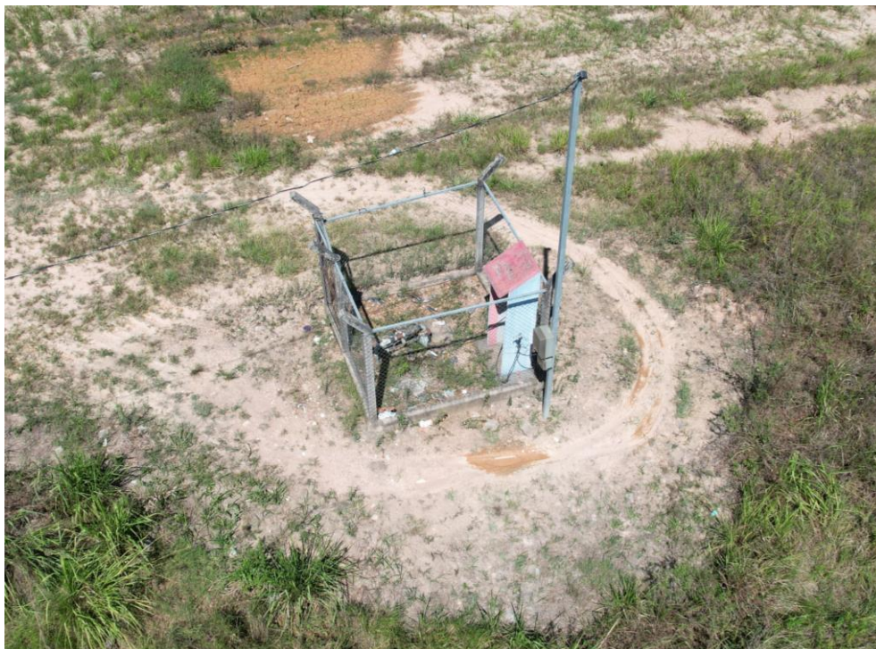
Figura 9. Captação – SFX10, poço tubular.
