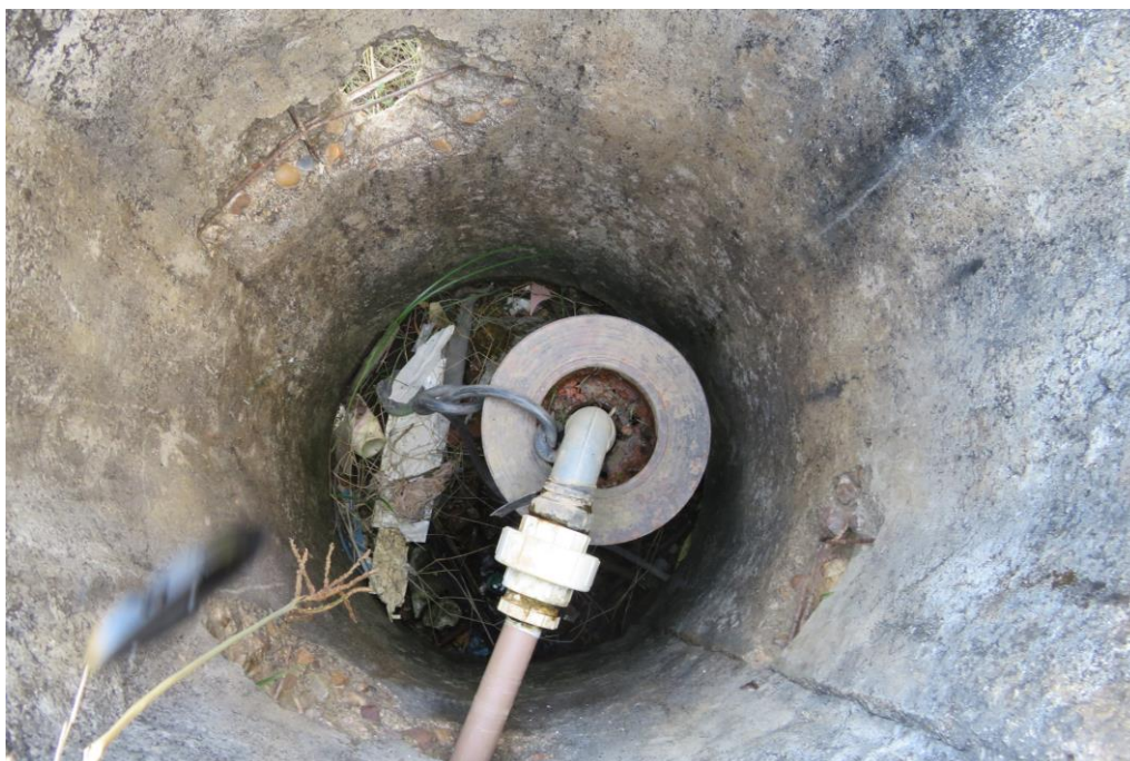
Figura 6. Captação – SFX04, poço tubular.
