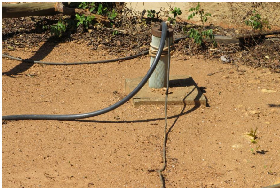
Figura 7. Captação – SFX06, poço tubular.
