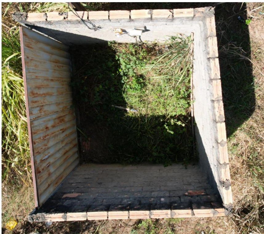
Figura 8. Captação – SFX07, poço tubular.
