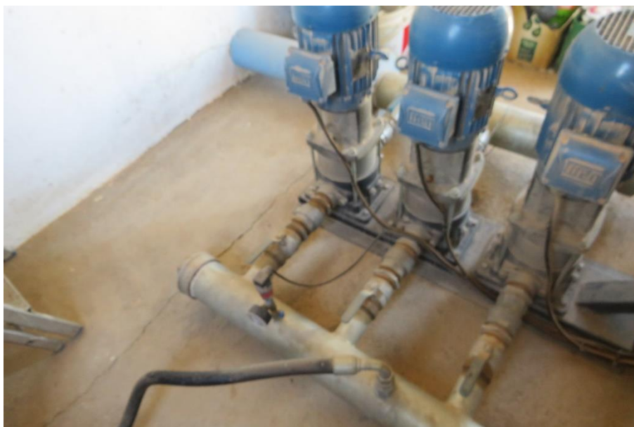
Figura 14. Booster SFX09, conjunto de motobombas.
