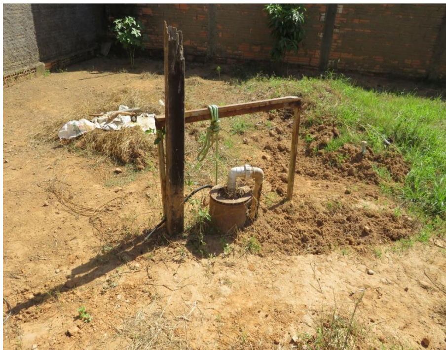
Figura 13. Captação – SFX15. Poço Tubular
