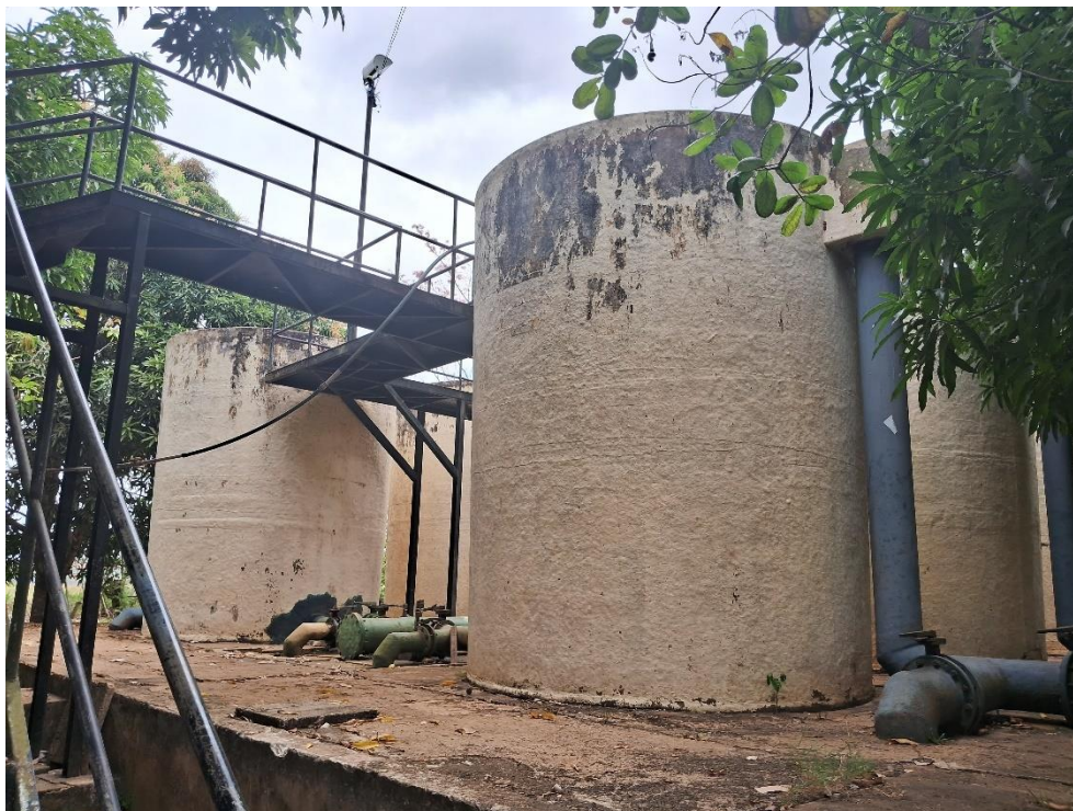
Figura 16. ETA – TUI01, Filtros.
