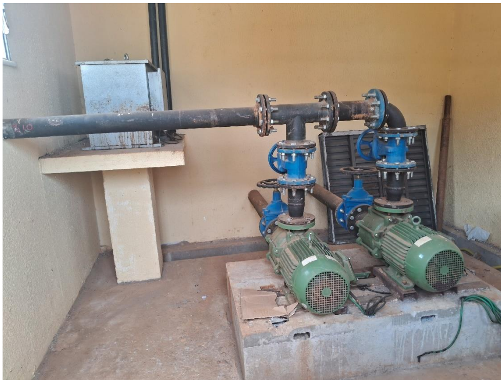
Figura 8. EEAB – TUI07 – Conjunto de motobombas.
