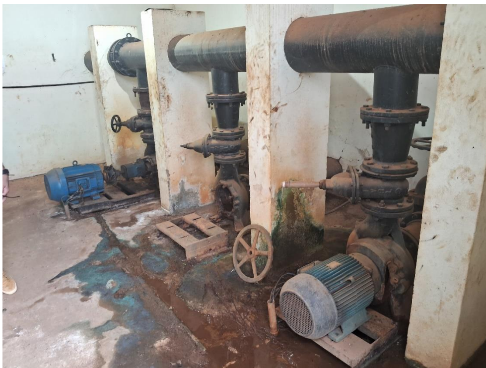
Figura 22. EEAT – TUI01, Conjuntos de motobomba.
