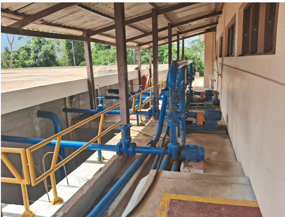
Figura 28. EEAT – TUI11, Conjuntos de motobomba.
