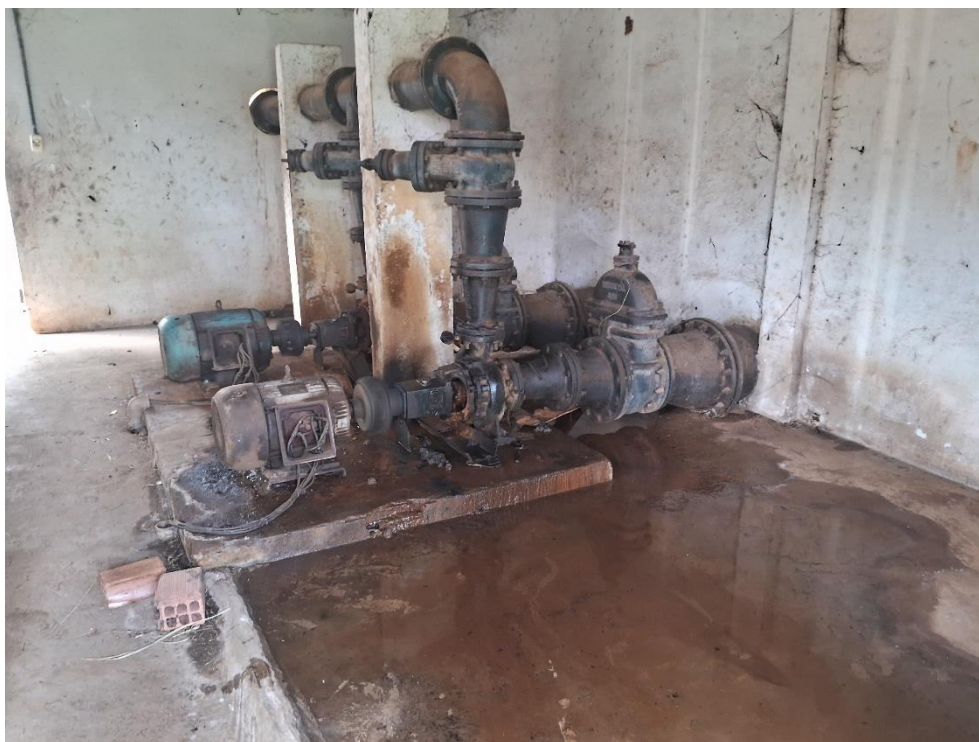
Figura 23. EEAT01– TUI02, Conjuntos de motobombas.
