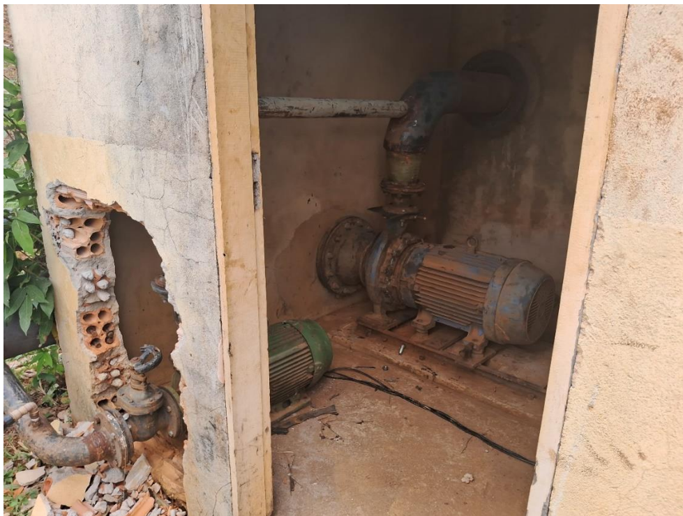
Figura 24. EEAT02 – TUI02, Conjuntos de motobombas.
