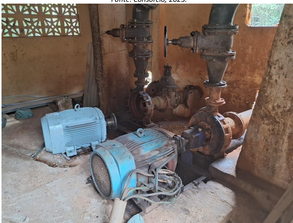
Figura 7. Captação - TUI04, Conjunto de motobomba desativado.
