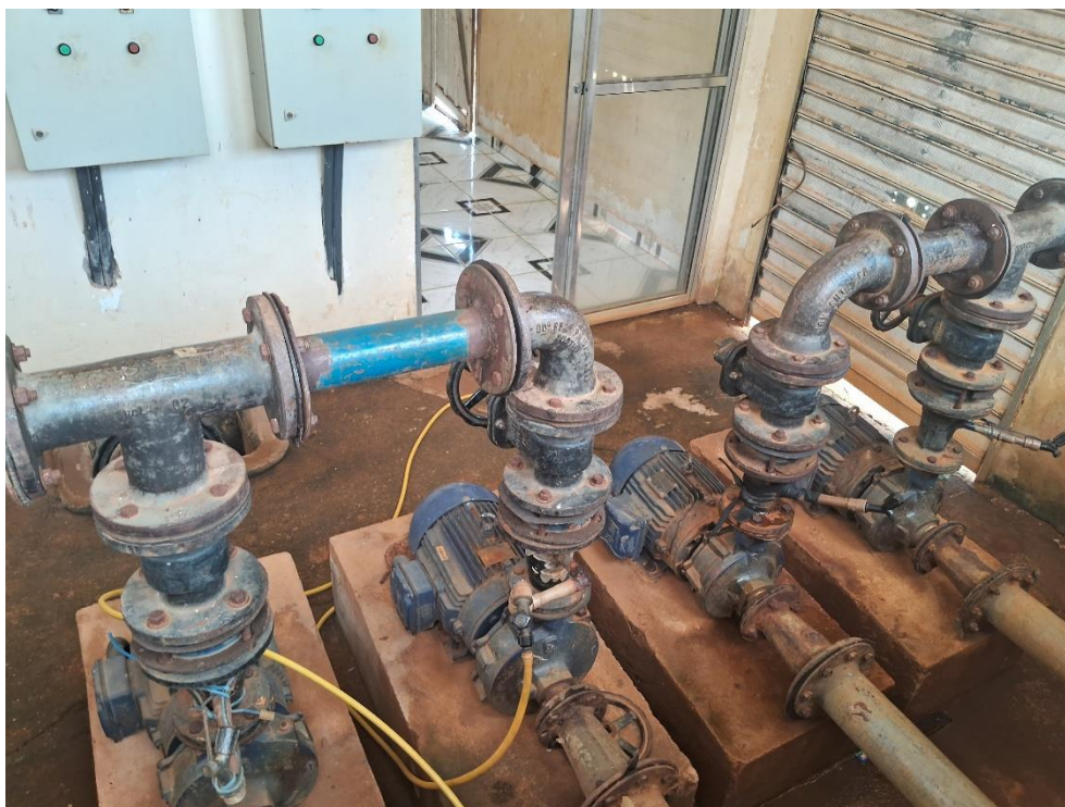
Figura 25. EEAT – TUI03, Conjuntos de motobomba.
