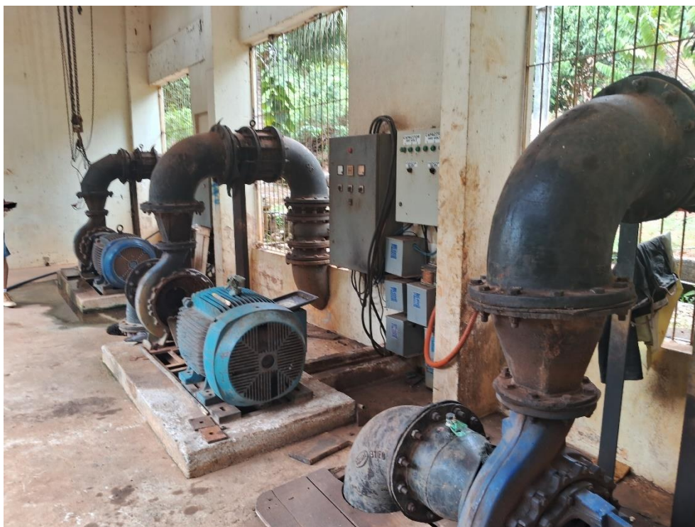
Figura 5. Captação - TUI01, Conjuntos de motobomba.
