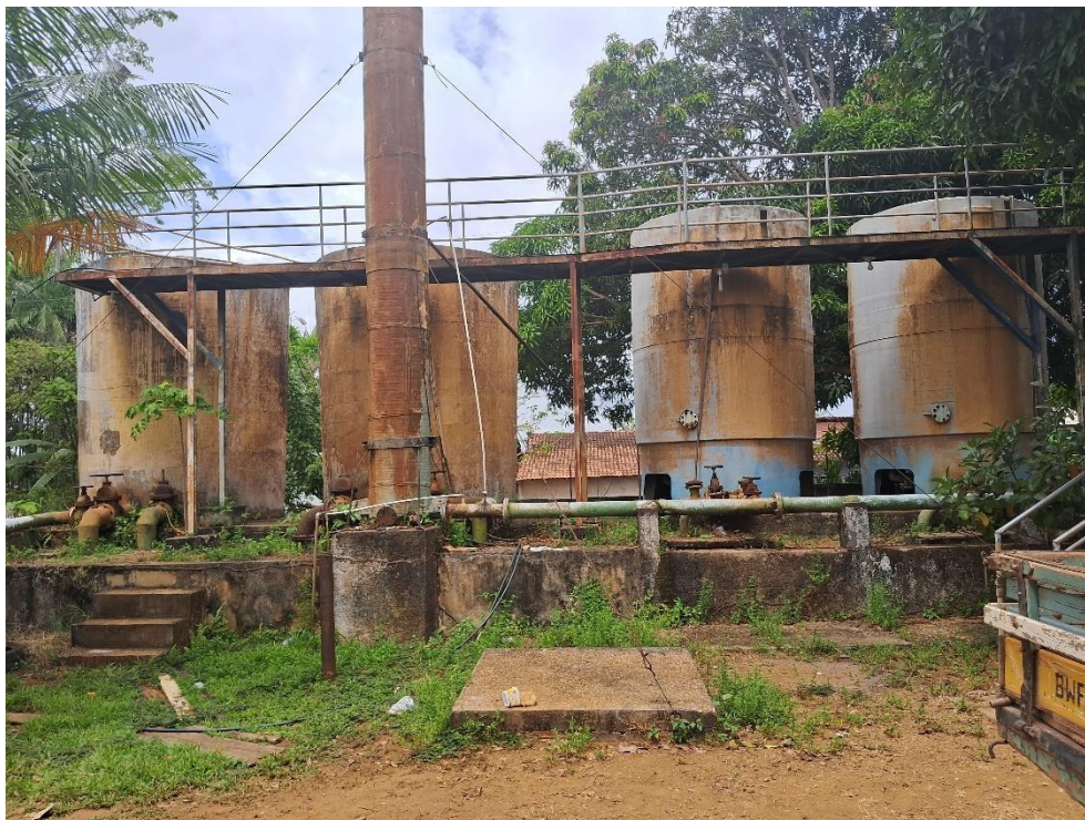
Figura 18. ETA – TUI05, Filtros.
