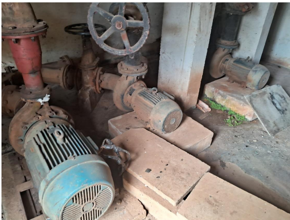
Figura 26. EEAT – TUI05, Conjuntos de motobombas.
