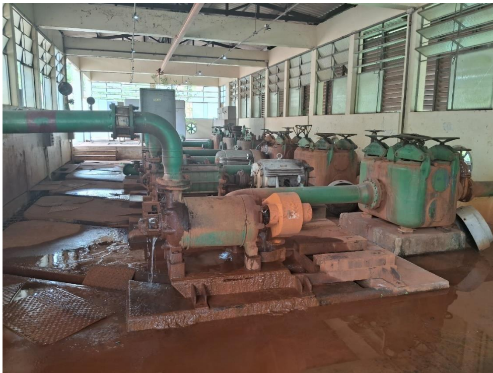
Figura 11. EEAB – TUI09 - Conjuntos de motobomba.
