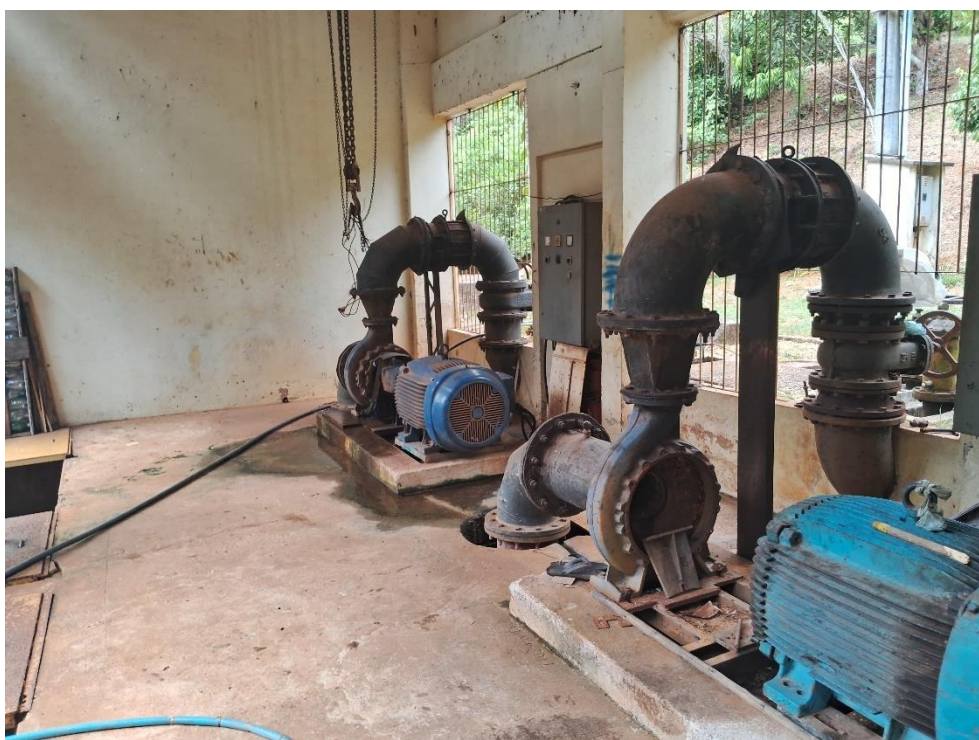
Figura 4. Captação - TUI01, Conjunto de motobomba desativado.
