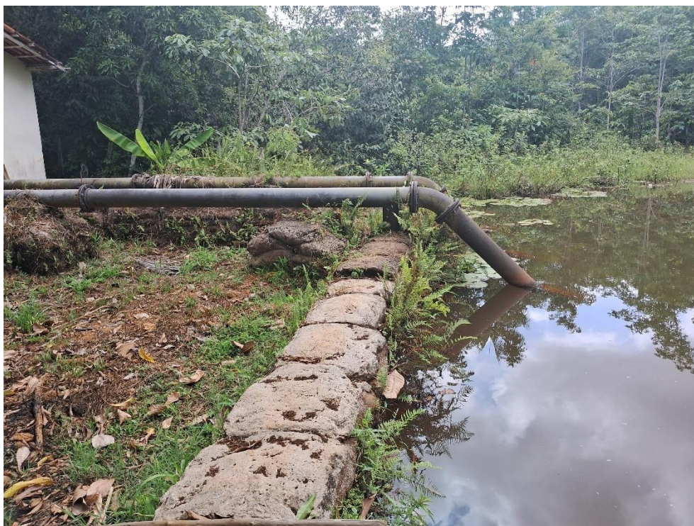
Figura 6. Captação – TUI04, Igarapé Santana.
