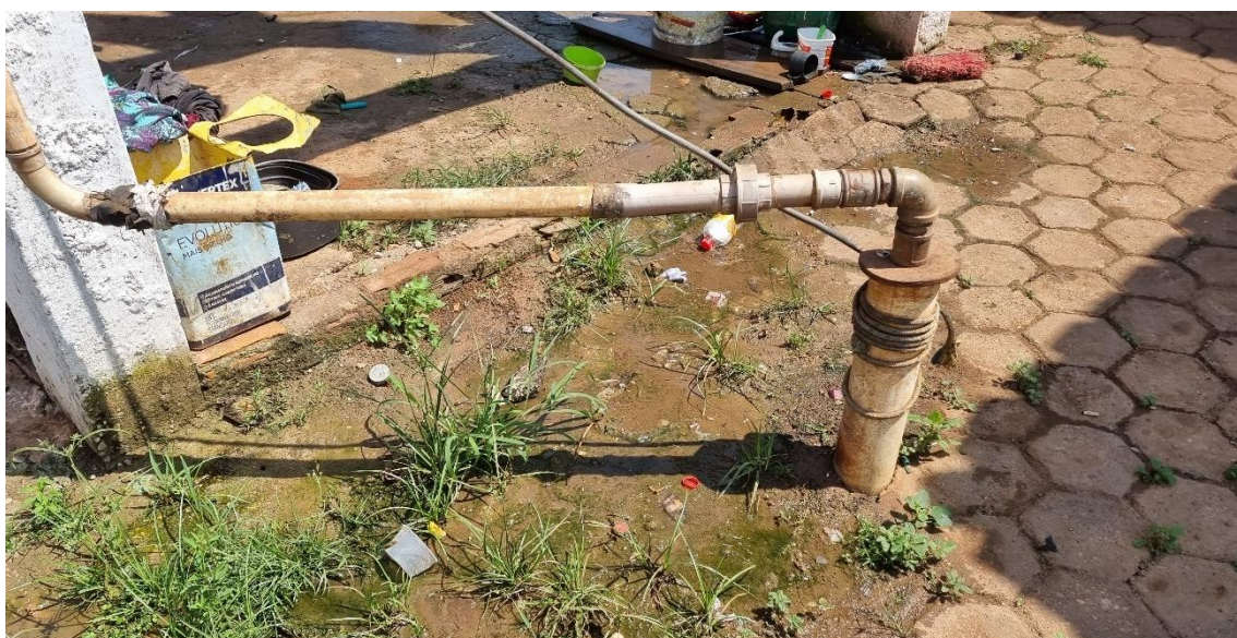
Figura 12. ULI10-CAPTAÇÃO. Captação subterrânea (bairro Boa Vista). Fonte: Consórcio, 2023.
