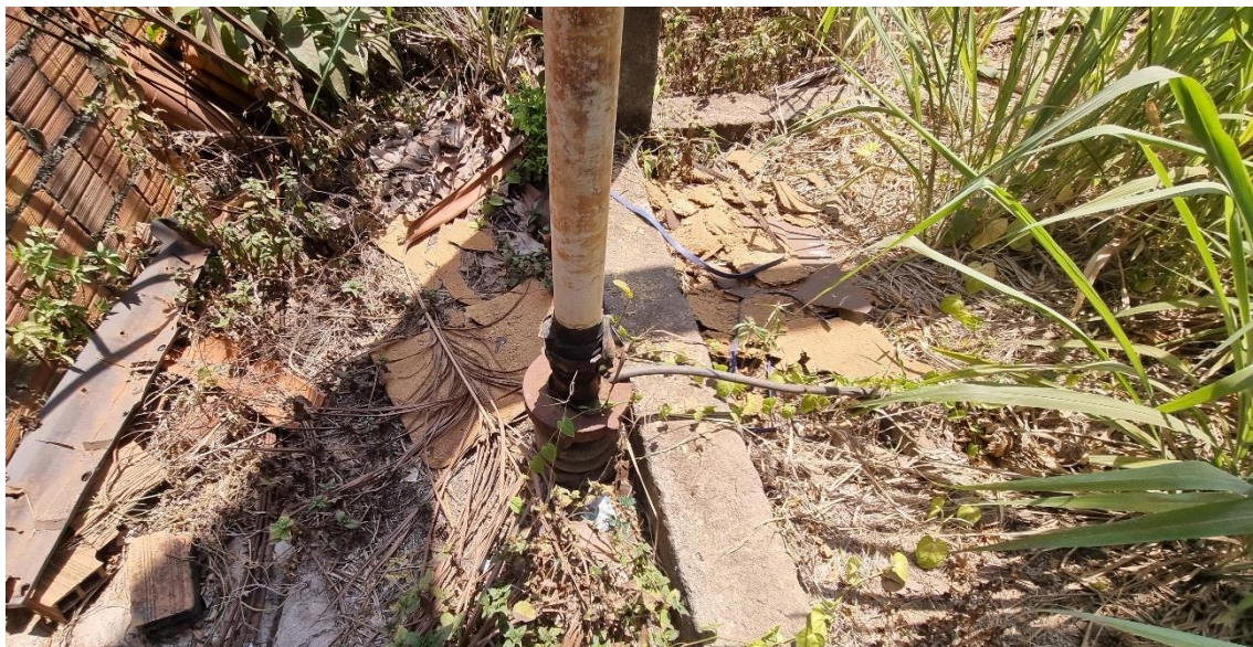
Figura 17. ULI15-CAPTAÇÃO. Captação subterrânea (bairro Rezende II).
