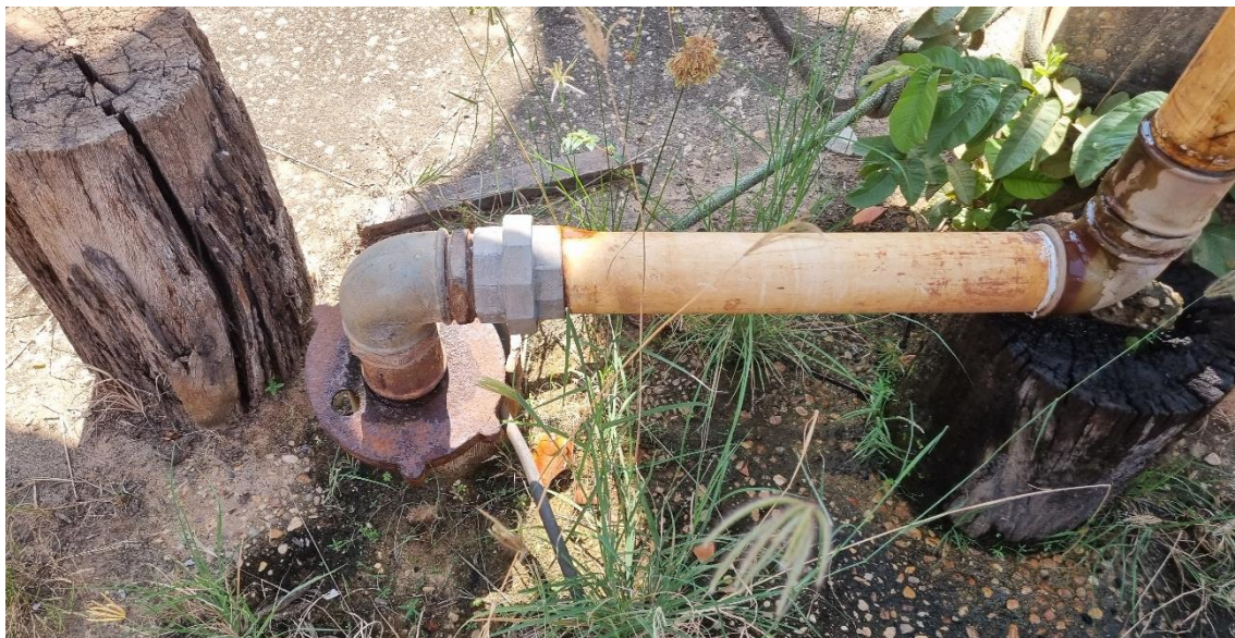
Figura 7. ULI05-CAPTAÇÃO. Captação subterrânea (bairro Rezende I). Fonte: Consórcio, 2023.
