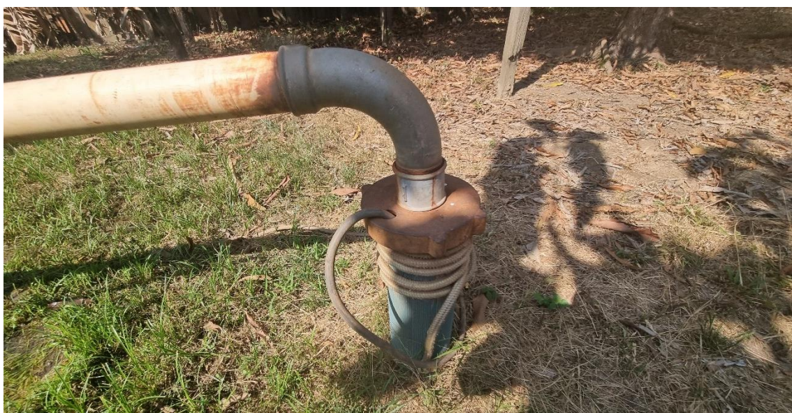
Figura 6. ULI04-CAPTAÇÃO. Captação subterrânea (bairro Rezende I). Fonte: Consórcio, 2023.
