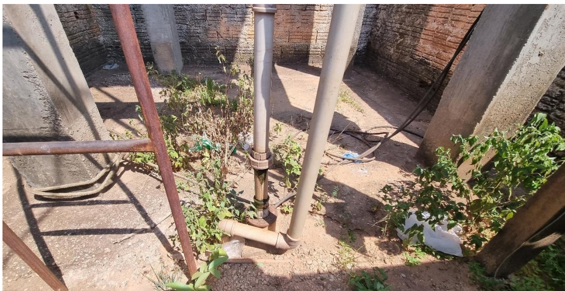
Figura 11. ULI09-CAPTAÇÃO. Captação subterrânea (bairro Boa Vista). Fonte: Consórcio, 2023.
