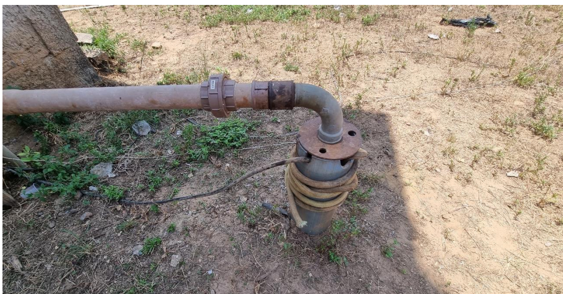
Figura 18. ULI16-CAPTAÇÃO. Captação subterrânea (bairro Davinópolis).
