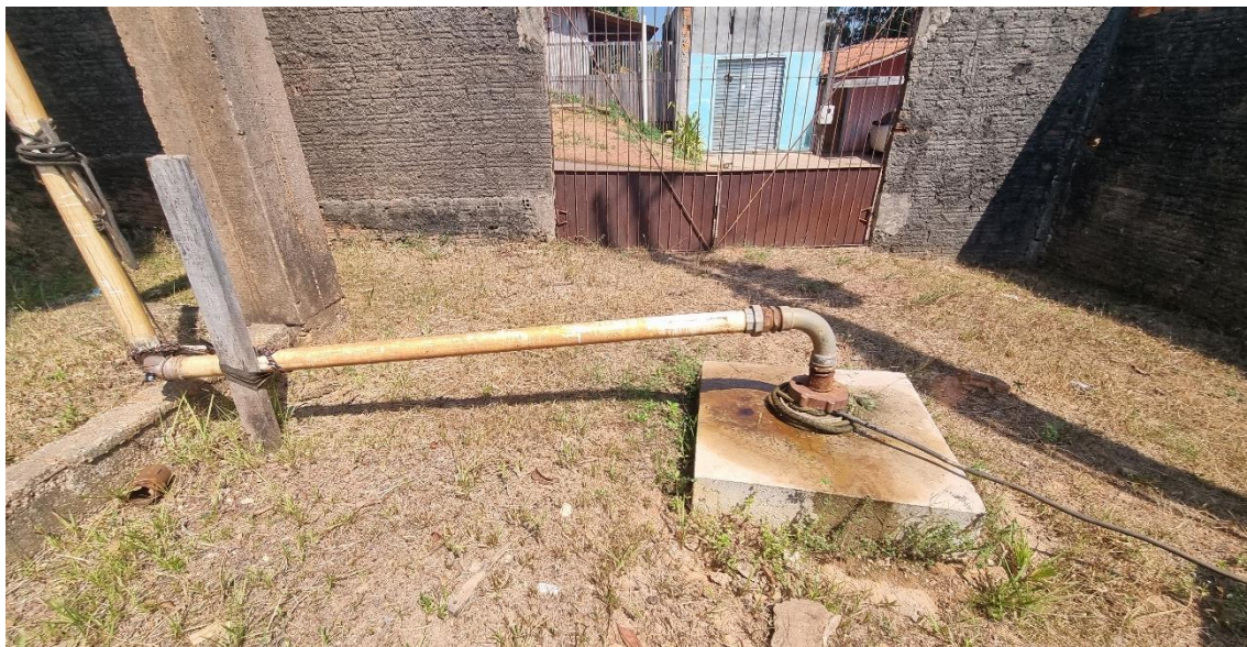
Figura 5. ULI03-CAPTAÇÃO. Captação subterrânea (bairro Rezende I). Fonte: Consórcio, 2023.
