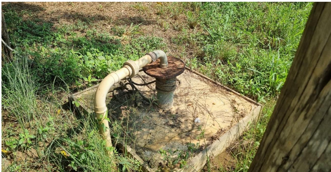
Figura 9. ULI07-CAPTAÇÃO. Captação subterrânea (bairro Bela Vista).
