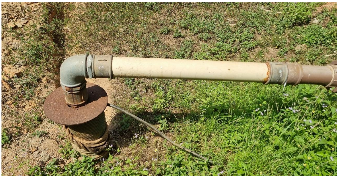
Figura 10. ULI08-CAPTAÇÃO. Captação subterrânea (bairro Caminho das Águas).
