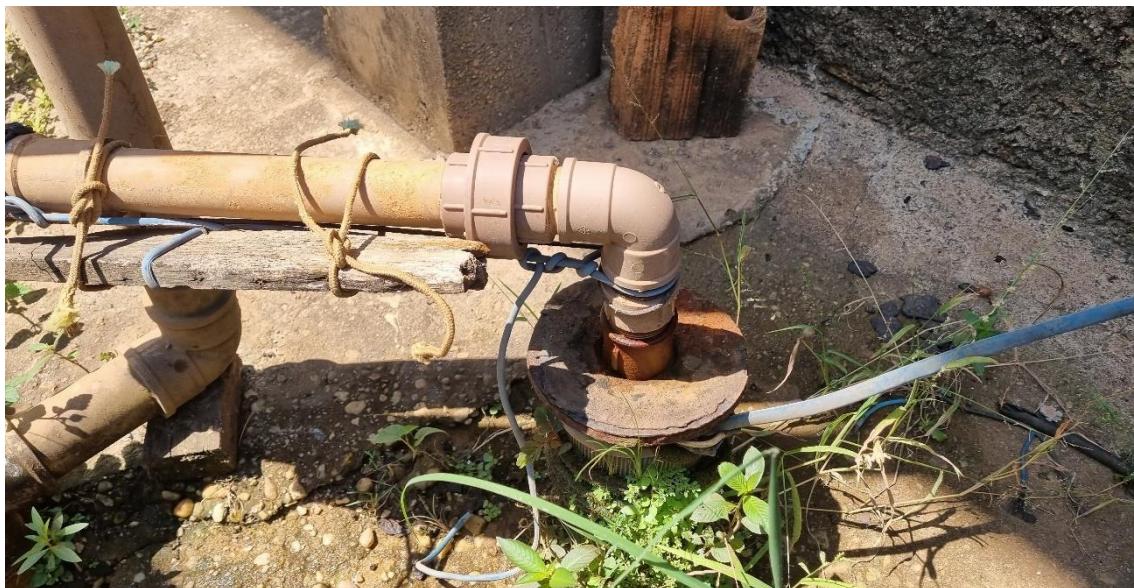
Figura 13. ULI11-CAPTAÇÃO. Captação subterrânea (bairro Boa Vista).
