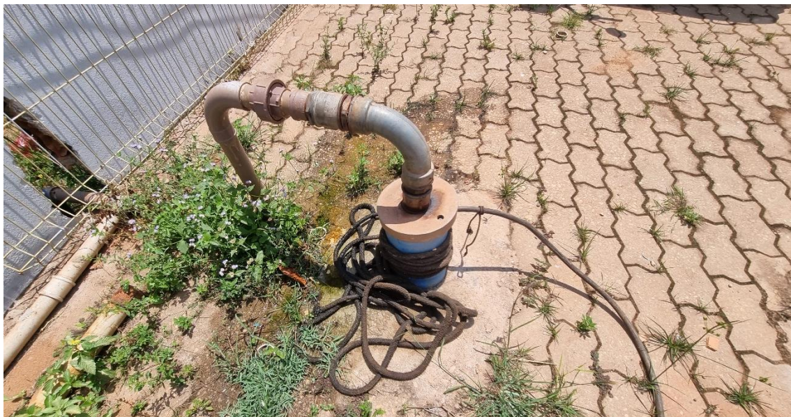
Figura 19. ULI17-CAPTAÇÃO. Captação subterrânea (bairro Davinópolis). Fonte: Consórcio, 2023.
