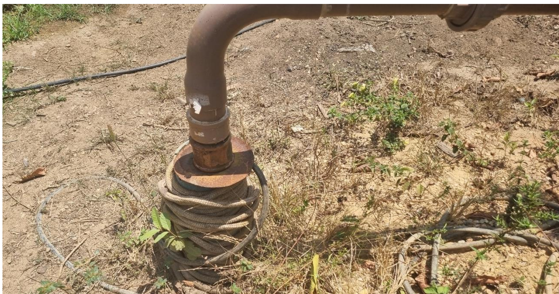
Figura 20. ULI18-CAPTAÇÃO. Captação subterrânea (bairro Rezende II). Fonte: Consórcio, 2023.
