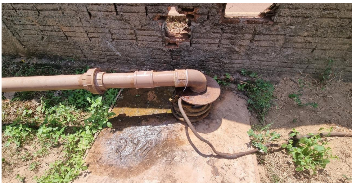
Figura 16. ULI14-CAPTAÇÃO. Captação subterrânea (bairro Rezende II).
